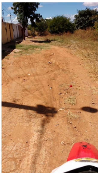
Figura 4.9 - Erosão de via pública não pavimentada.
