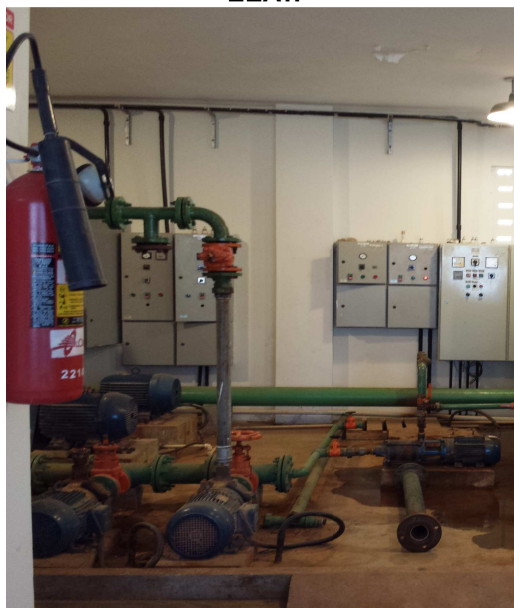
Figura 4.3.7: Conjuntos motobomba da EAT.
