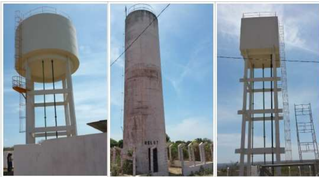
Figura 4.3.17: Reservatórios Elevados do sistema de abastecimento do distrito Quatiguaba.
