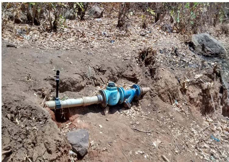
Figura 4.3.15: Macromedidor de água tratada.
