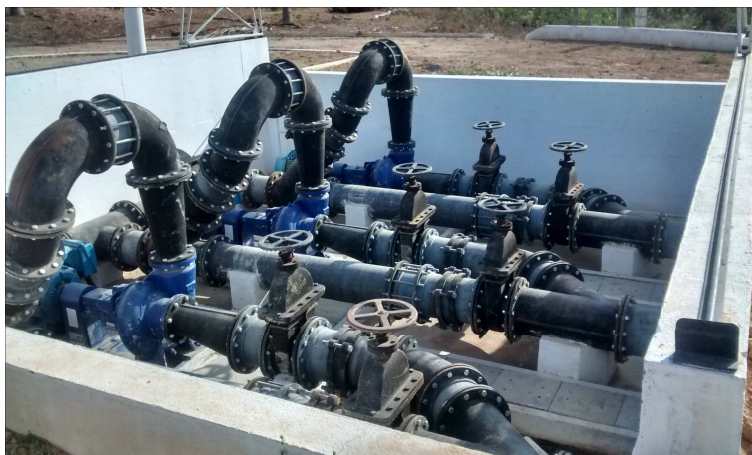
Figura 4.3.2: Conjunto motobomba da EEAB no Açude Jaburu I.
