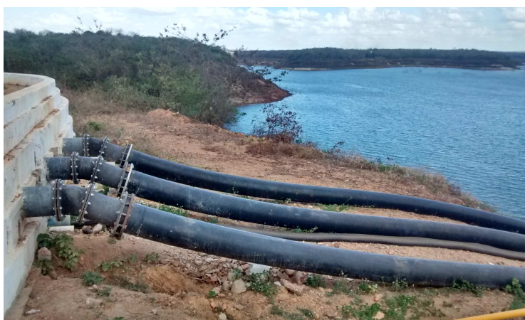
Figura 4.3.3: Adutora de Água Bruta do Açude Jaburu I.
