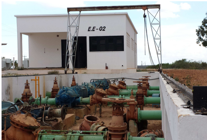
Figura 4.3.6: Conjuntos motobomba da EEAT-02.
