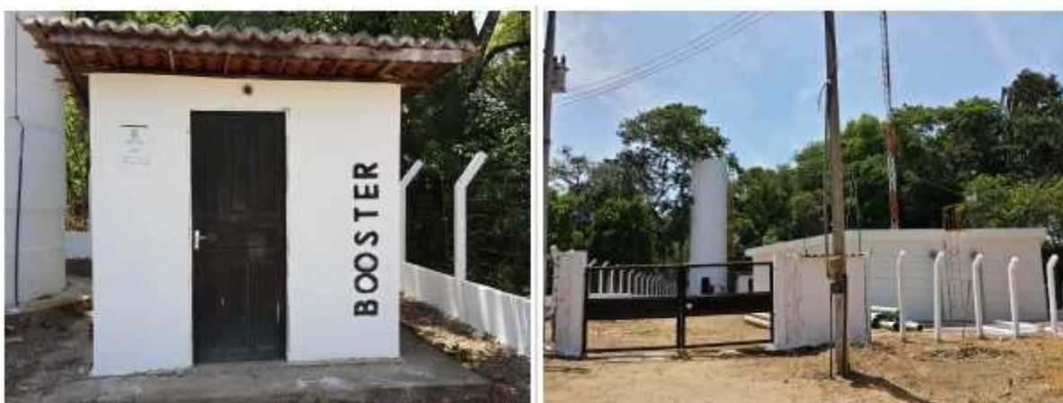
Figura 4.3.8: Booster no bairro Brejo Grande.
