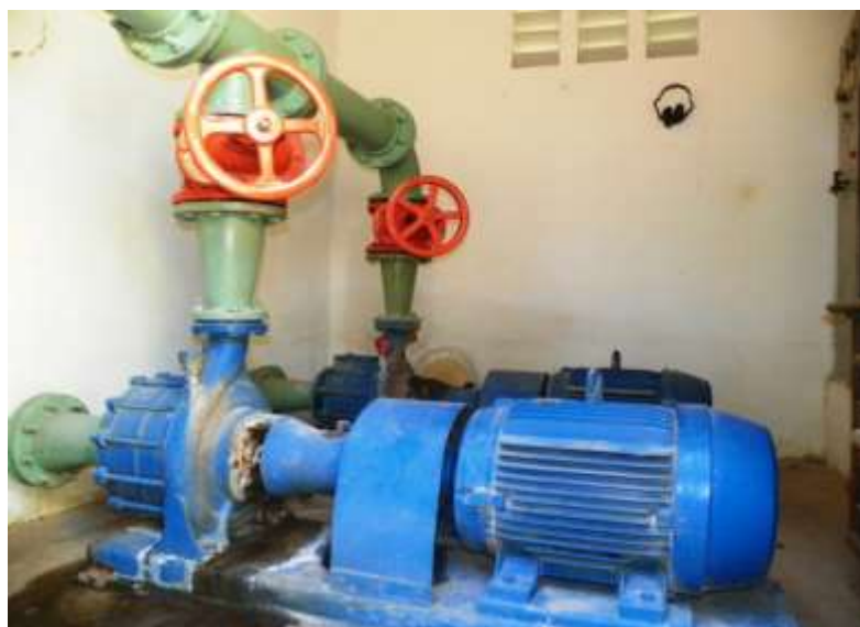
Figura 7.14 – Vista da estação elevatória de água tratada (EEAT-01) localizada na área da ETA da sede de Farias Brito.
