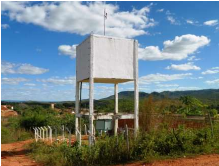
Figura 7.19 – Vista do reservatório elevado de 50 m 3 responsável pelo abastecimento de água do distrito de Cariutaba.
