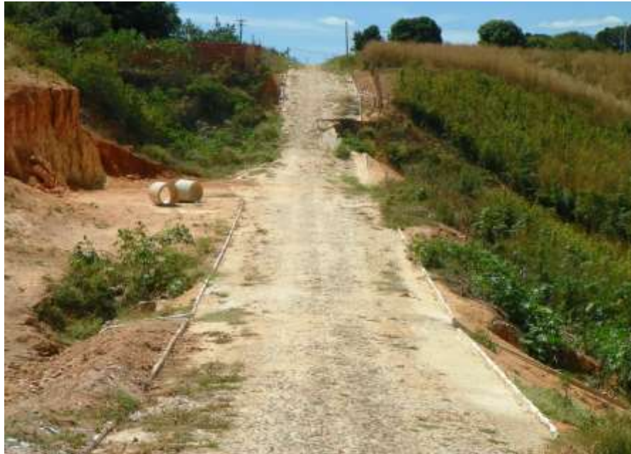
Figura 7.75 – Vista geral da erosão na Rua José Gonçalves. Fonte: Consórcio DGH-Cariri (2011).
