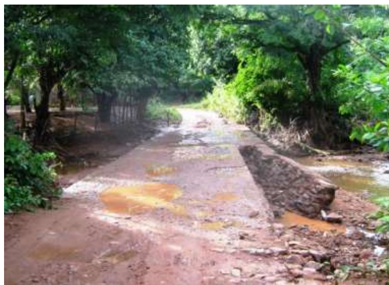
Figura 7.77 – Erosão de via na localidade de Bananeira. Fonte: Consórcio DGH-Cariri (2011).
