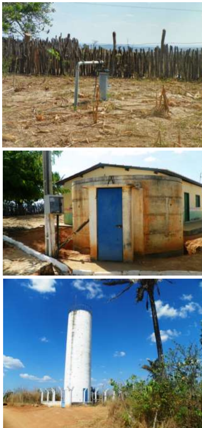
Figura 7.39 – Vista do poço ( Q = 15,8 \text{ m}^3/\text{h} ), tanque de reunião e reservatório elevado de 30 \text{ m}^3 da localidade de Lagoa Seca, no município de Farias Brito, de responsabilidade do SISAR.
