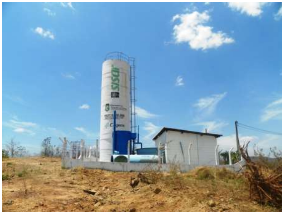
Figura 7.28 – Vista do manancial de água e reservatório elevado de 60 m 3 da localidade de Contendas, no município de Farias Brito, de responsabilidade do SISAR.
