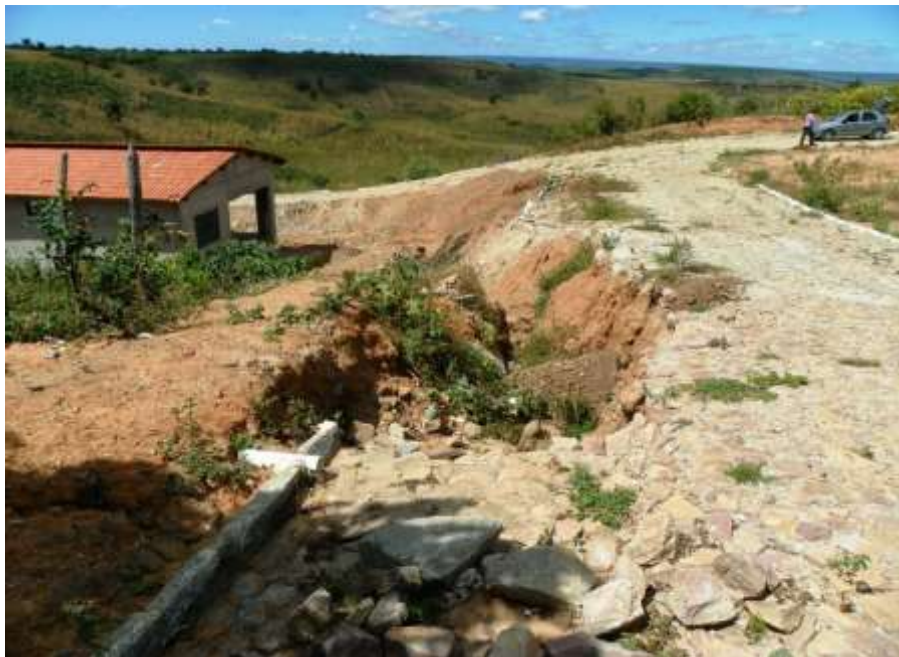
Figura 7.72 – Erosão na Rua Pedro Ângelo em zona de encosta a nordeste da cidade de Altaneira.
