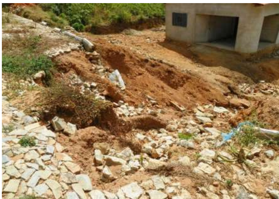
Figura 7.73 – Erosão na Rua Pedro Ângelo.
