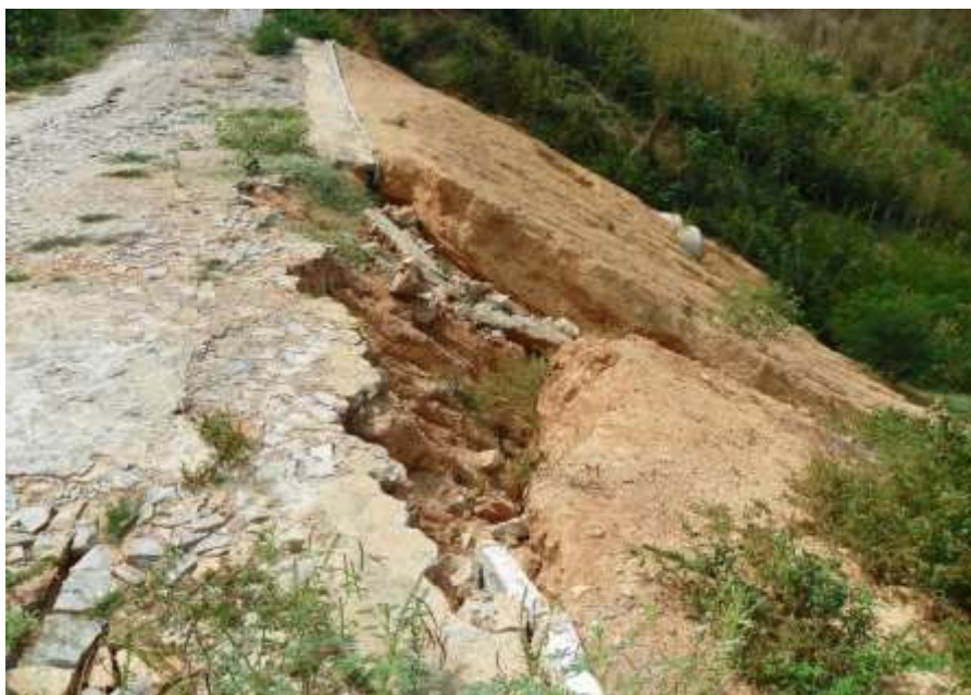
Figura 7.74 – Erosão na Rua José Gonçalves. Fonte: Consórcio DGH-Cariri (2011).
