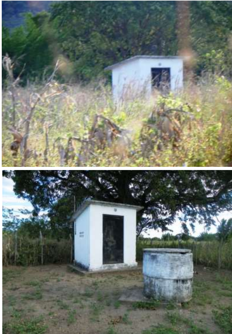
Figura 7.18 – Vista dos poços tubulares PT-01 e PT-02 que abastecem o distrito de Cariutaba.
