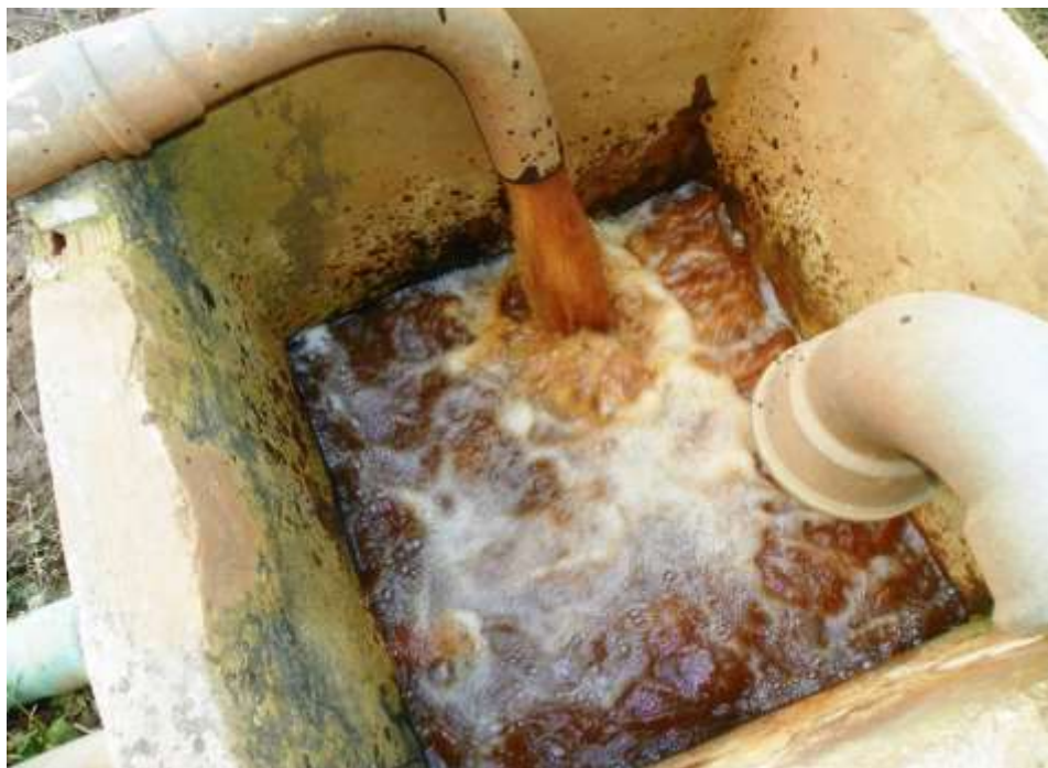
Figura 7.9 – Vista da chegada de água bruta na ETA e cor causada pela elevada concentração de ferro.
