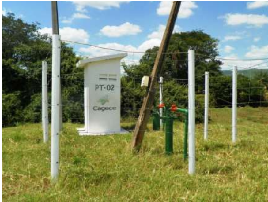
Figura 7.3 – Vista do PT-02 que faz parte do manancial da sede de Farias Brito. Fonte: Consórcio DGH-Cariri (2011).
