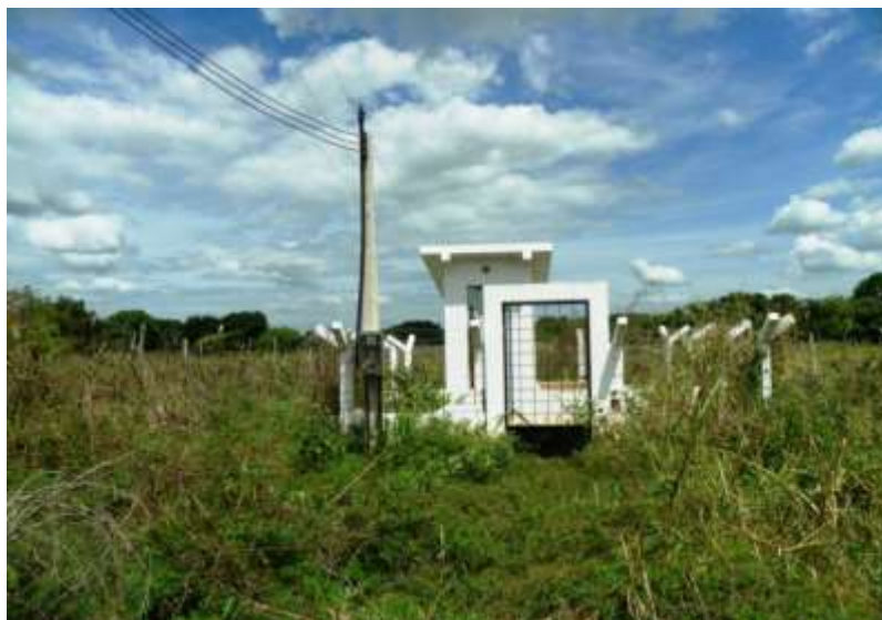
Figura 7.41 – Vista do poço ( Q = 8,0 \text{ m}^3/\text{h} ) utilizado como manancial de abastecimento de água do distrito de Nova Betânia, no município de Farias Brito, de responsabilidade atual da Prefeitura.
