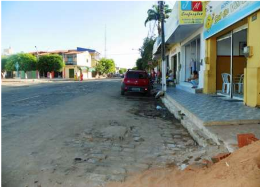
Figura 7.45 – Rede de esgoto na Av. Cel. Manoel Pinheiro de Almeida, sede de Farias Brito.
