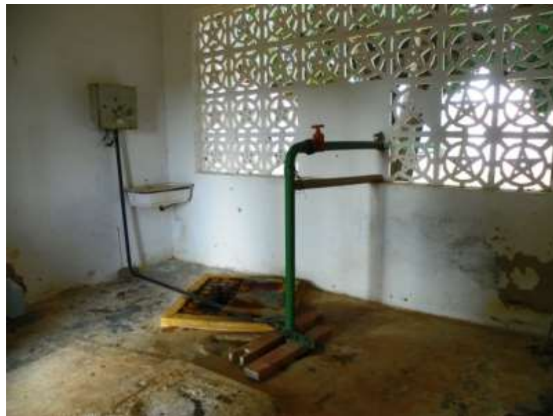
Figura 7.2 – Vista do poço amazonas (PA) que faz parte do manancial da sede de Farias Brito.
