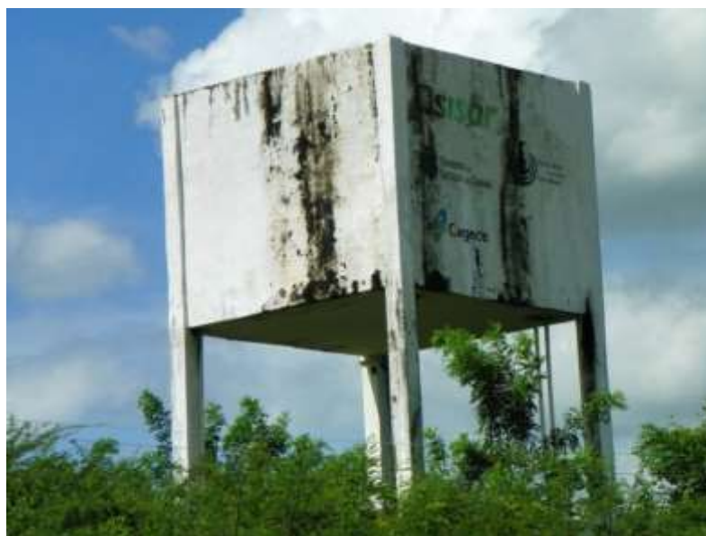
Figura 7.42 – Vista do reservatório elevado de 50 \text{ m}^3 , pertencente ao sistema de abastecimento de água do distrito de Nova Betânia, no município de Farias Brito, de responsabilidade atual da Prefeitura.
