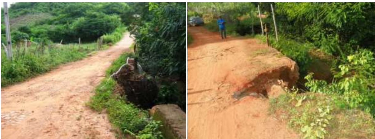
Figura 7.76 – Erosão de vias na localidade de Cachimbo. Fonte: Consórcio DGH-Cariri (2011).
