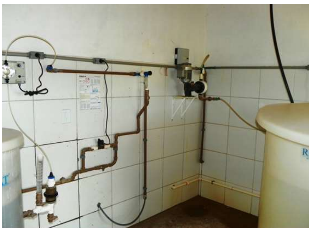
Figura 7.12 – Vista do sistema de desinfecção (Fábrica de cloro) localizado na Estação de Tratamento de Água (ETA) da sede de Farias Brito.
