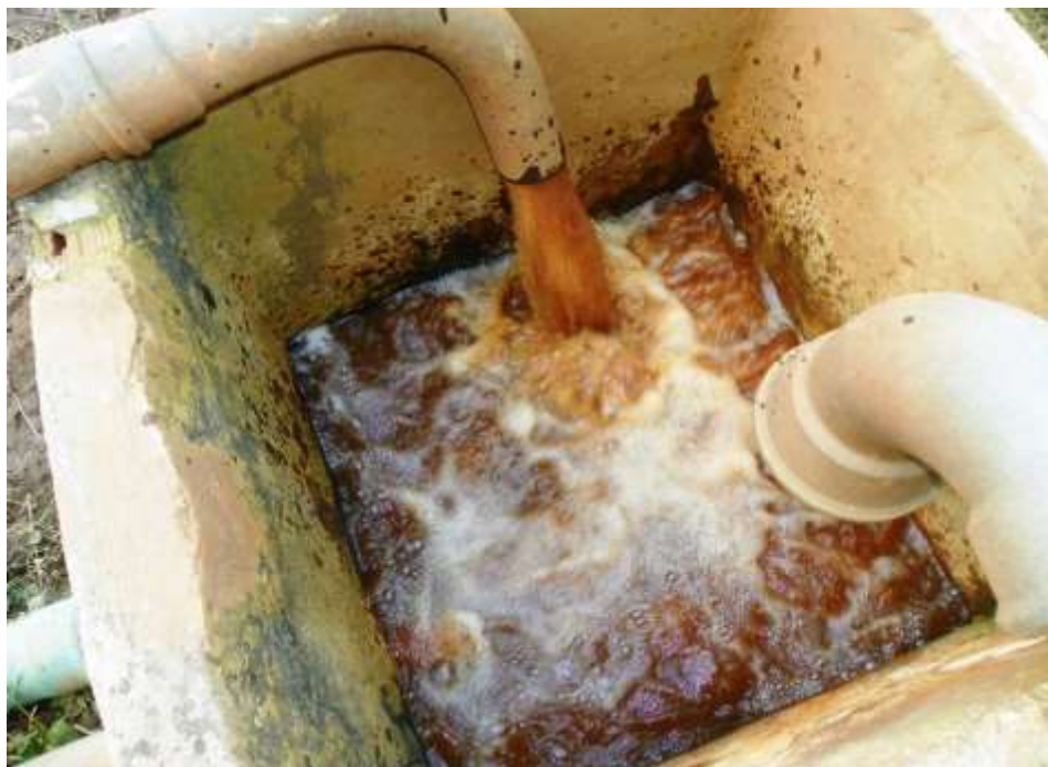
Figura 5.2 – Vista da chegada de água bruta na ETA e cor causada pela elevada concentração de ferro.
