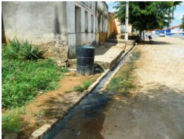
Figura 5.15 – Esgoto a céu aberto no distrito de Nova Betânia. Fonte: Consórcio DGH-Cariri (2011).
