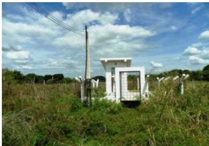
Figura 5.6 – Vista do poço ( Q = 8,0 \text{ m}^3/\text{h} ) utilizado como manancial de abastecimento de água do distrito de Nova Betânia, no município de Farias Brito, de responsabilidade atual da Prefeitura.
