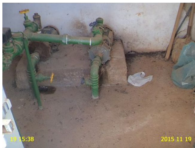
Foto 3 - EERD-05: CMB fixado na base e com pintura adequada.
