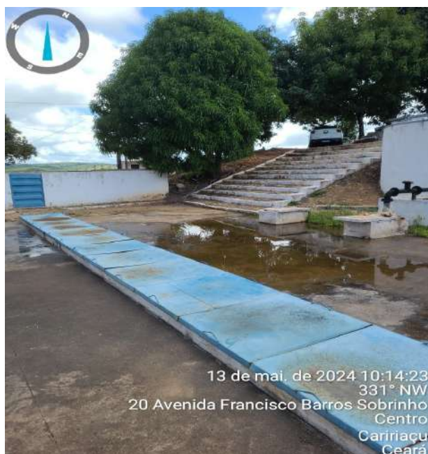
Foto 3 - ETA - área dos filtros alagada.
