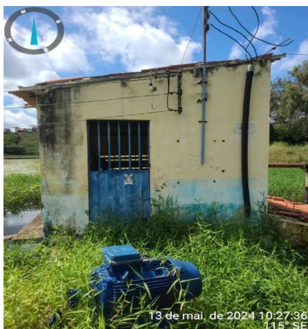
Foto 1 - EEAB - bomba reserva armazenada em local inadequado.
