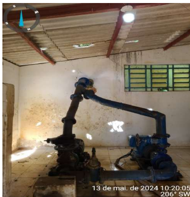
Foto 4 - ETA - telhado deteriorado.
