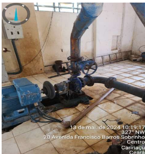
Foto 5 - ETA - vazamento na bomba.
