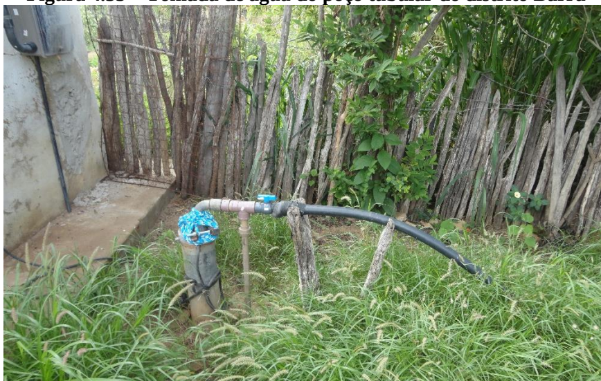
Figura 4.35 – Tomada de água do poço tubular do distrito Barra
