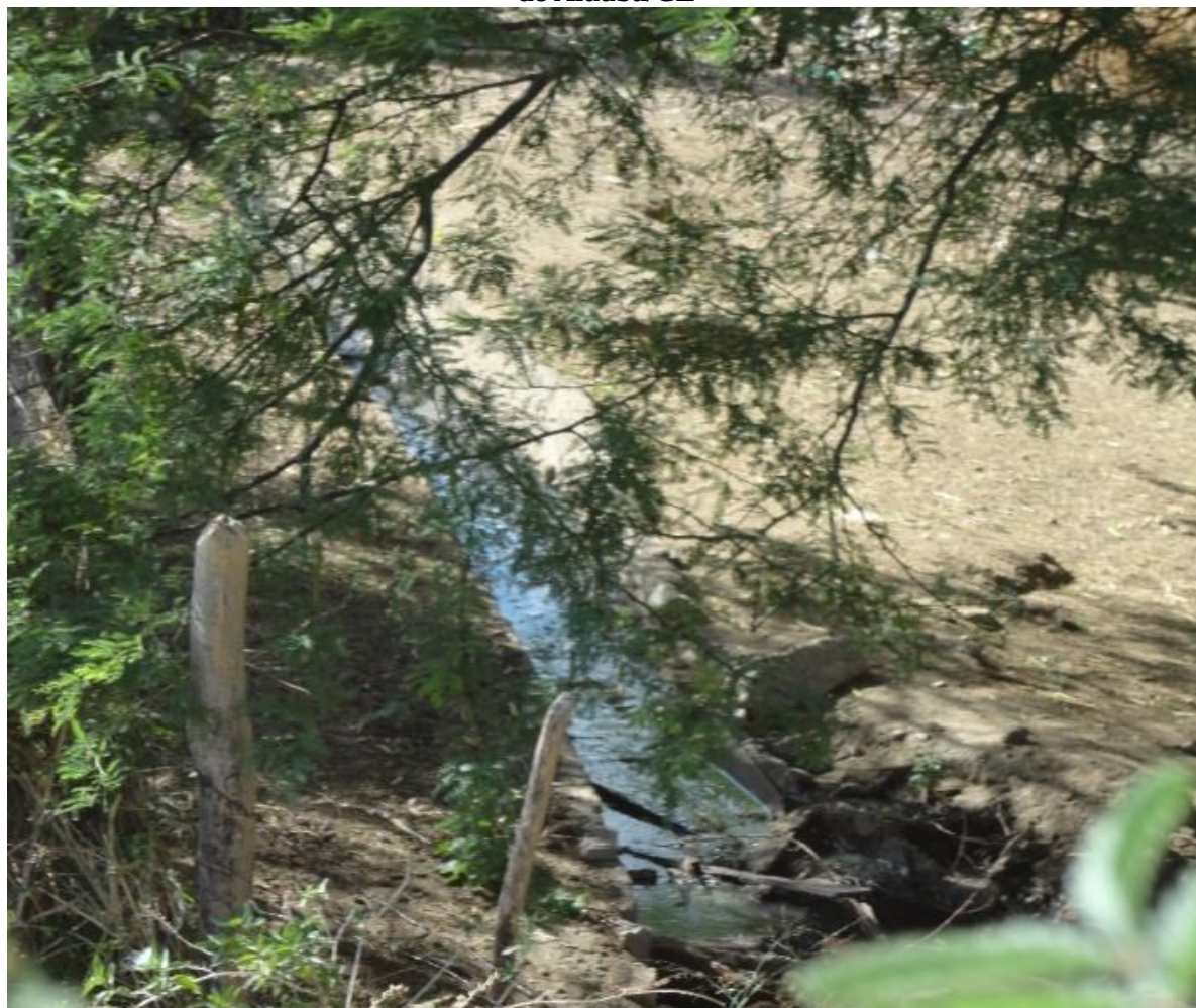
Figura 5.7 – Efluentes da rede coletora direcionados para o sumidouro do SES da zona urbana de Aiuaba/CE
