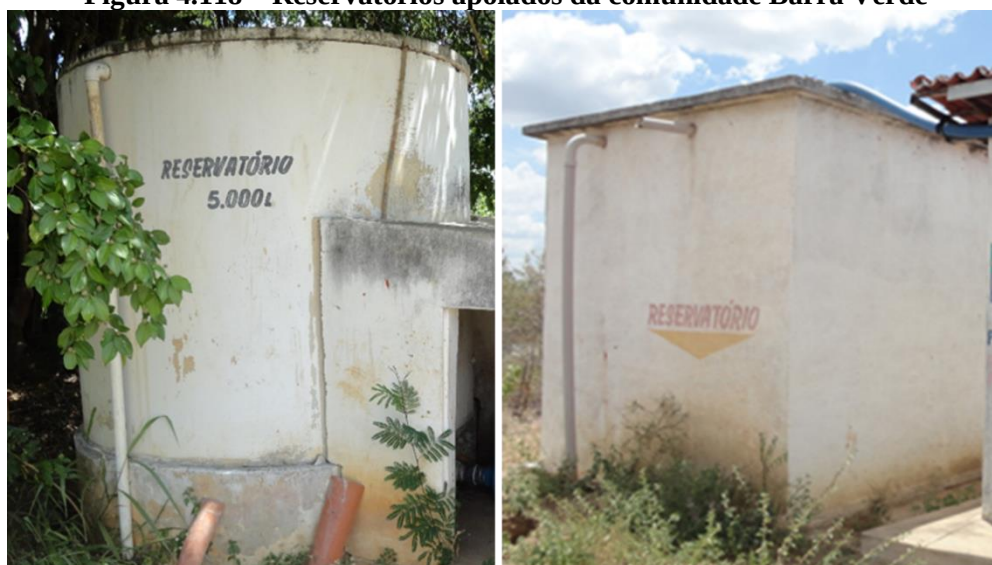
Figura 4.118 – Reservatórios apoiados da comunidade Barra Verde
