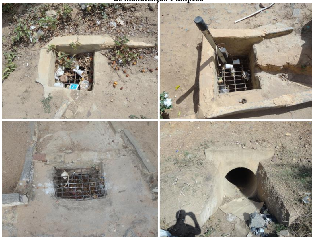
Figura 6.35 – Dispositivos de drenagem urbana da sede municipal que precisam de programas de manutenção e limpeza
