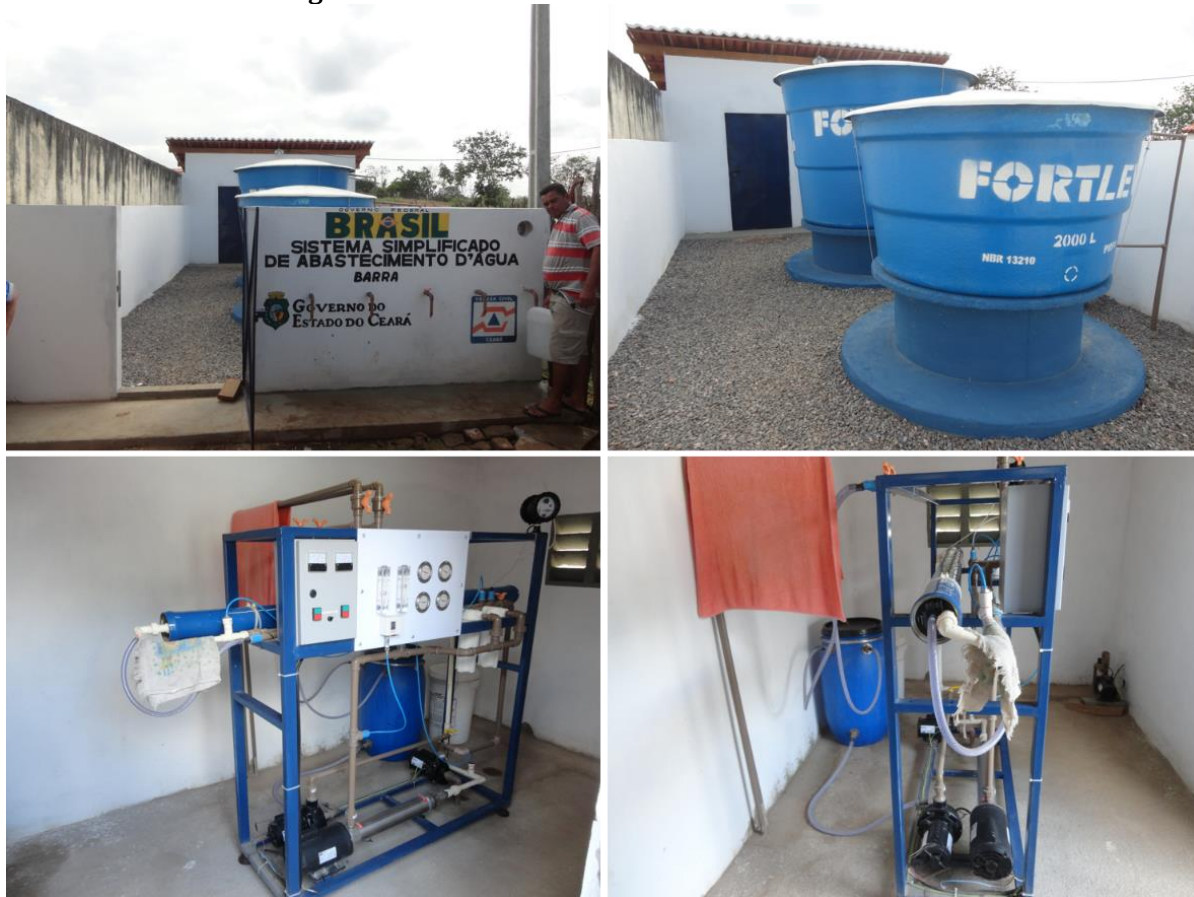
Figura 4.55 – Dessalinizador ativo do distrito Barra
