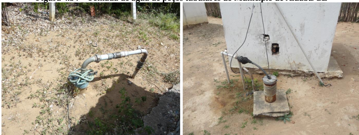
Figura 4.34 – Tomada de água de poços tubulares do Município de Aiuaba/CE
