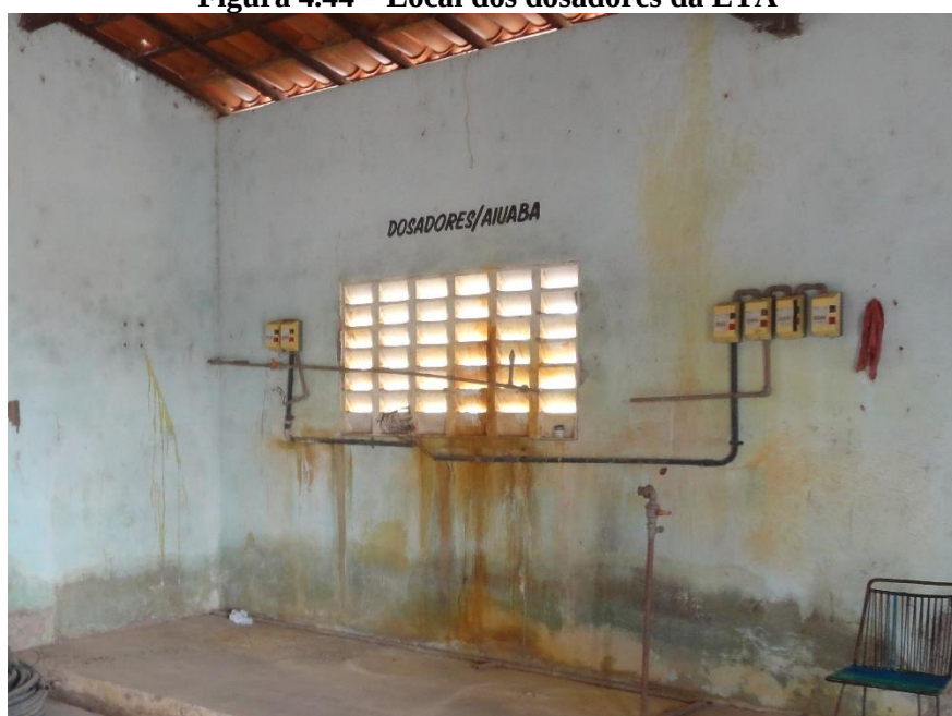
Figura 4.44 – Local dos dosadores da ETA
