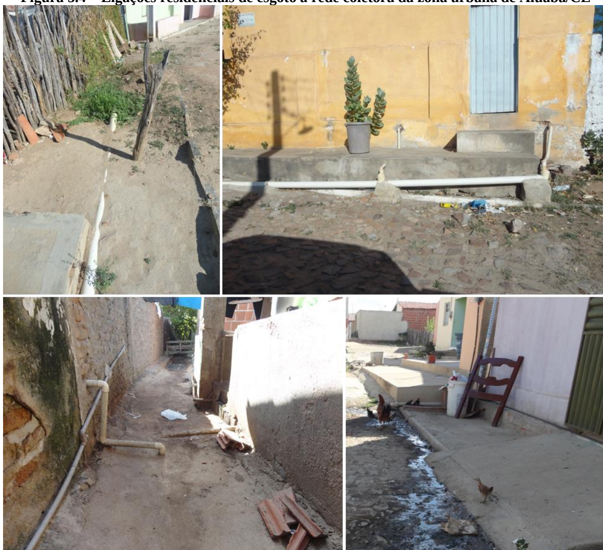
Figura 5.4 – Ligações residenciais de esgoto a rede coletora da zona urbana de Aiuaba/CE
