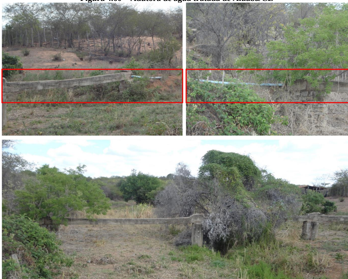
Figura 4.60 – Adutora de água tratada de Aiuaba/CE
