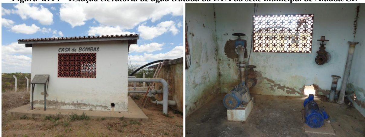
Figura 4.114 – Estação elevatória de água tratada da ETA da sede municipal de Aiuaba/CE
