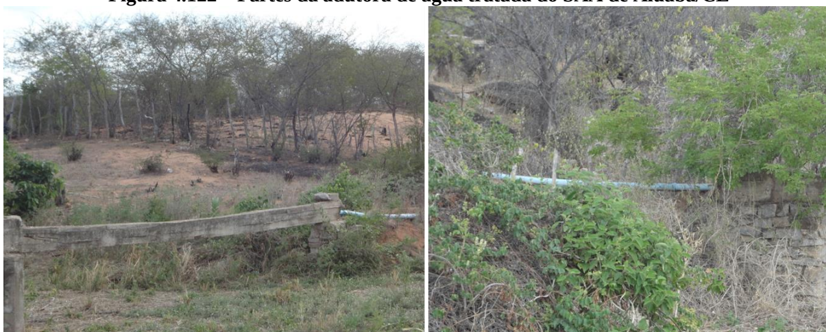
Figura 4.122 – Partes da adutora de água tratada do SAA de Aiuaba/CE
