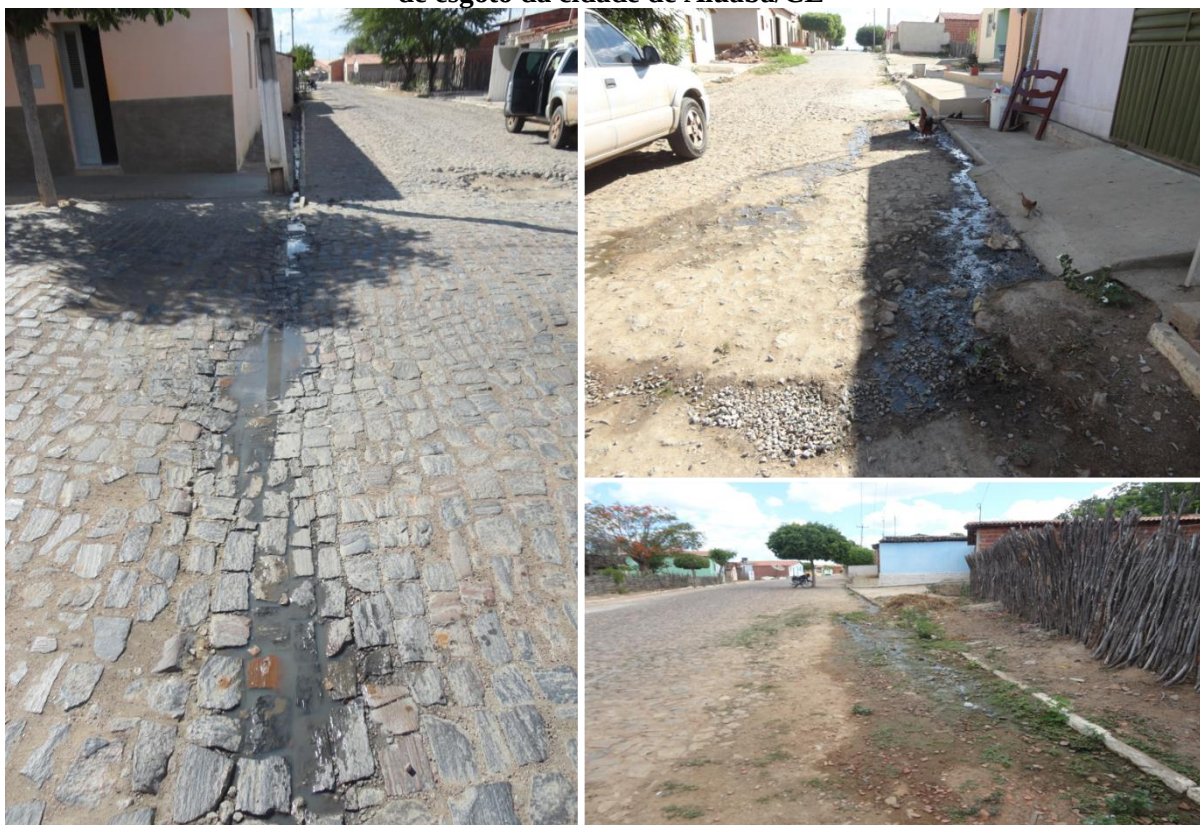
Figura 5.5 – Extravasamentos de esgotos devido a entupimentos e rompimentos da rede coletora de esgoto da cidade de Aiuaba/CE
