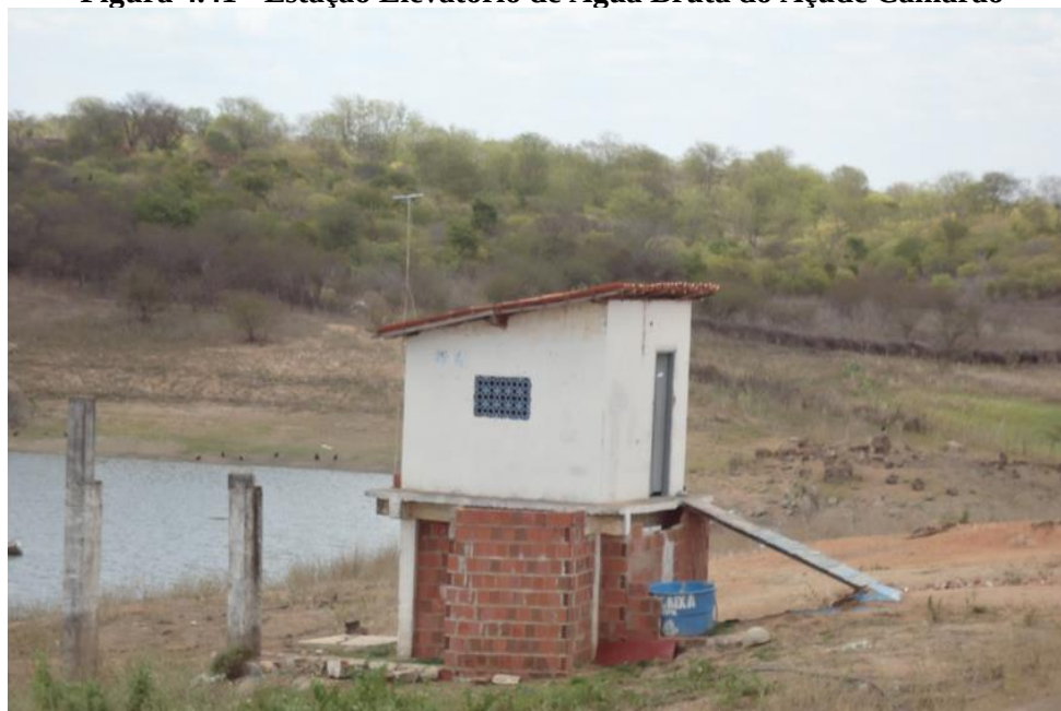
Figura 4.41 - Estação Elevatório de Água Bruta do Açude Camarão
