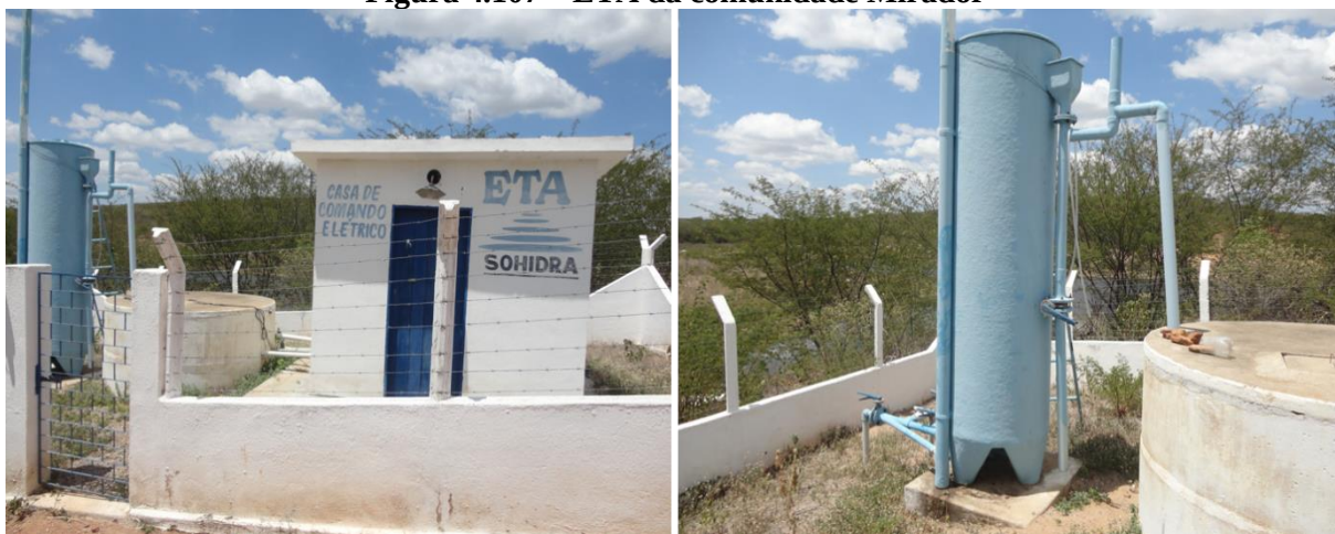
Figura 4.107 – ETA da comunidade Mirador
