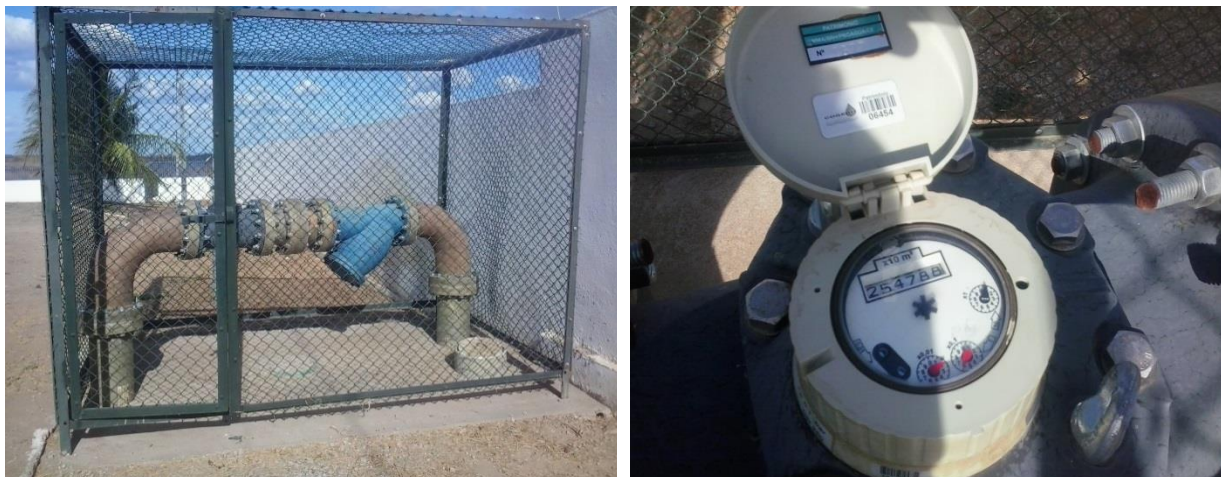
Figura 3.9 – Tubulação de entrada da água bruta e hidrômetro para medir a vazão de entrada.
