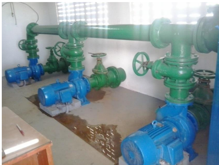
Figura 3.19 – Bombas utilizadas na lavagem dos filtros.
