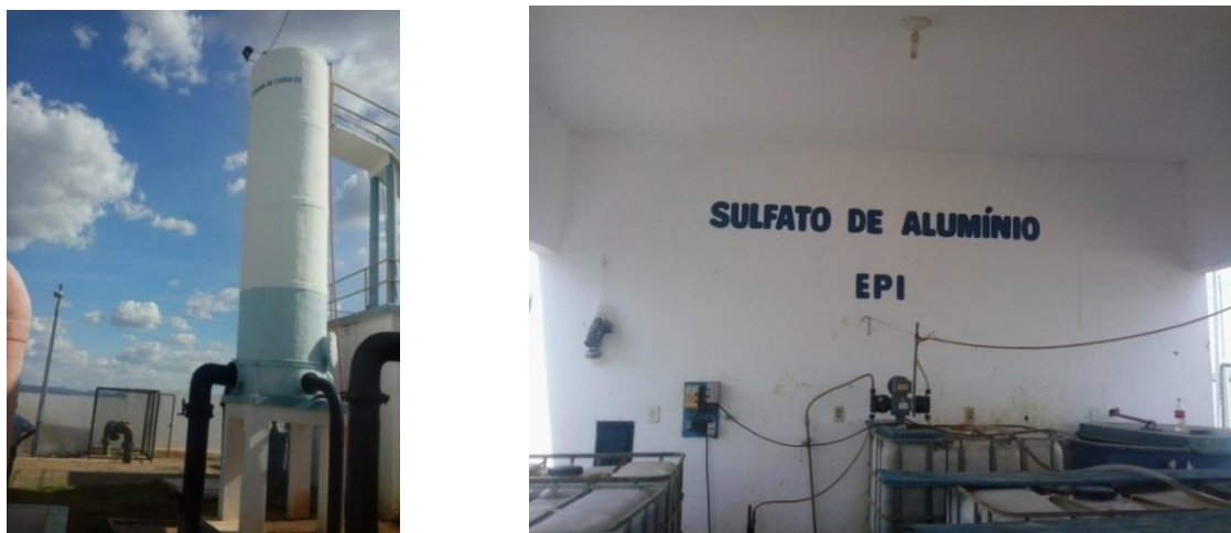
Figura 3.10 – Câmara de carga e armazenamento/dosagem do sulfato de alumínio.
