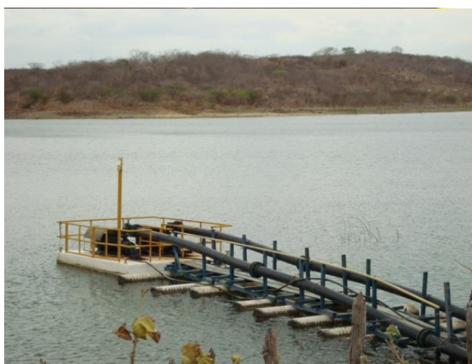
Figura 3.5 – Bomba de captação flutuante no açude Vieirão.
