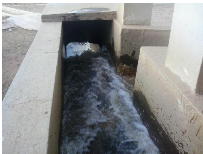
Figura 3.12 – Descarga dos filtros. Fonte: Conducto Engenharia (2018).
