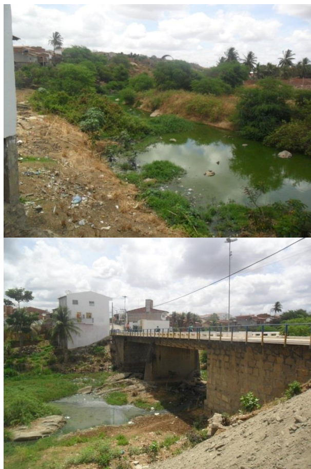
Figura 6.4 – Leito do rio Boa Viagem (assoreamento) na sede do município de Boa Viagem. Fonte: Conduto Engenharia (2015).
