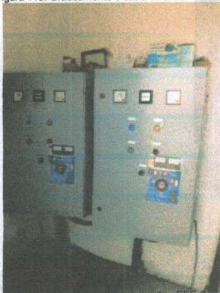
Figura 121: Quadros de comando - EEE-3.
