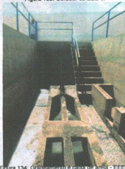
Figura 134: Gradeamento e caixa de areia - EEE-7.
