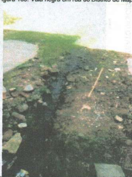
Figura 167: Vaia negra em rua do Distrito de Mapuá.
