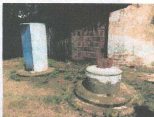
Figura 88: Poço e quadro de comando
