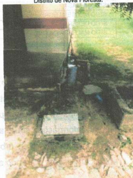
Figura 181: Estrutura do sistema coletor em logradouro do Distrito de Nova Floresta.
