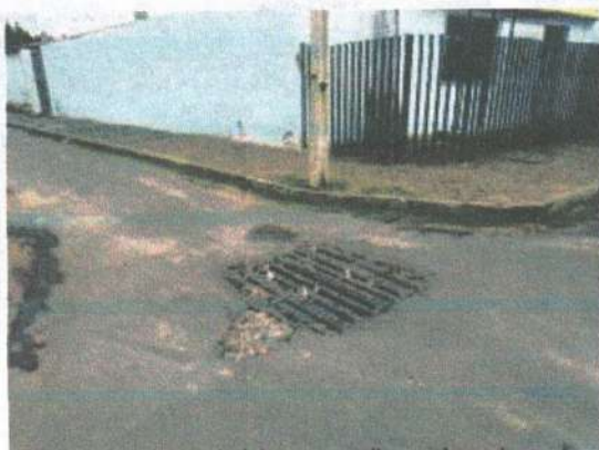
Figura 200: Boca-de-lobo com grelha em logradouro do Distrito Sede..
