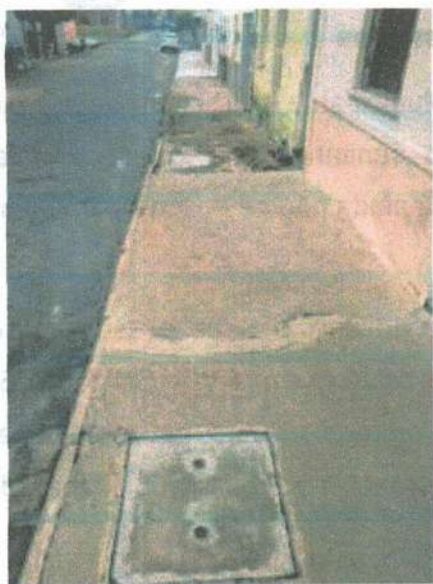
Figura 103: Caixa de passagem em passeio do Distrito Sede.
