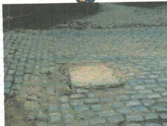
Figura 179: Estrutura do sistema coletor em logradouro do Distrito de Nova Floresta.
