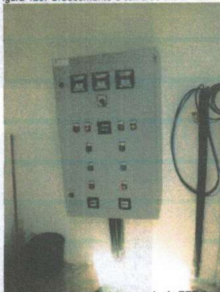
Figura 131: Quadro de comando da EEE-6.
