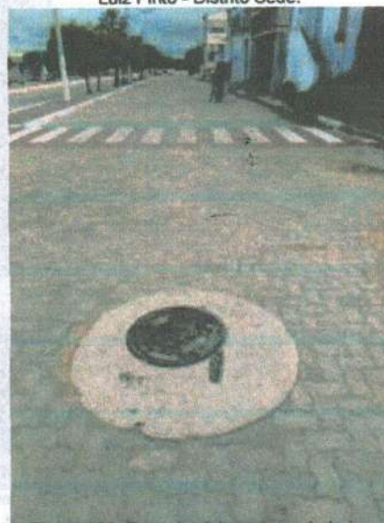
Figura 106: Poço de visita em rua do bairro Centro - Distrito Sede.
