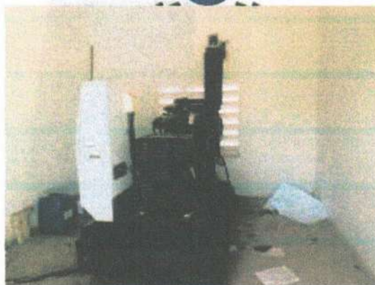
Figura 136: Gerador da EEE-7.
