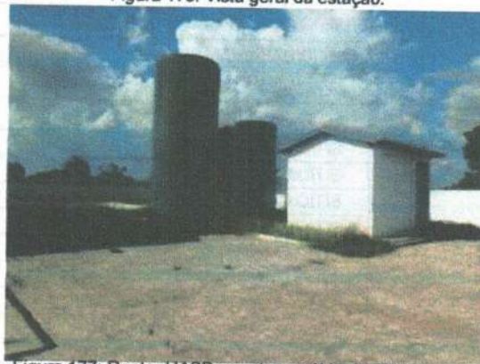
Figura 177: Reator UASB e reator aeróbio da ETE Mapuá.
