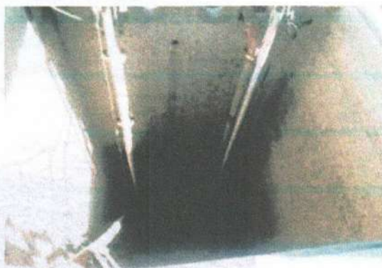
Figura 113: Poço de sucção – EEE-1.
