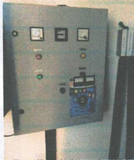
Figura 126: Quadro de comando – EEE-4
