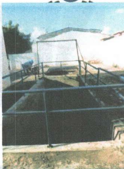
Figura 120: Poço de sucção da EEE-3 ao fundo.
