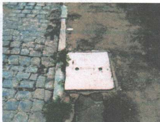
Figura 102: Caixa de passagem em passeio do Distrito Sede.
