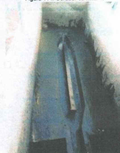
Figura 116: Gradeamento e caixa de areia - EEE-2.
