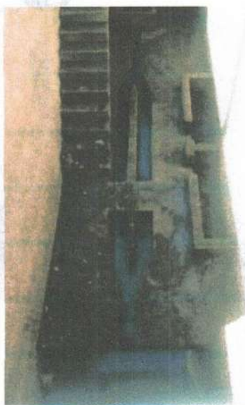
Figura 137: Marca do nível d'água no pré-tratamento da EEE-1.
