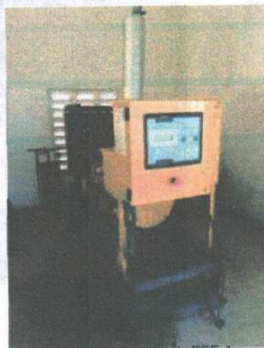
Figura 127: Gerador da EEE-4.
