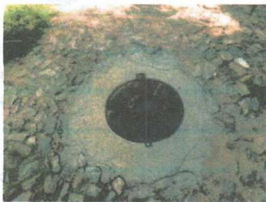
Figura 159: Poço de visita - Distrito de Mapua.
