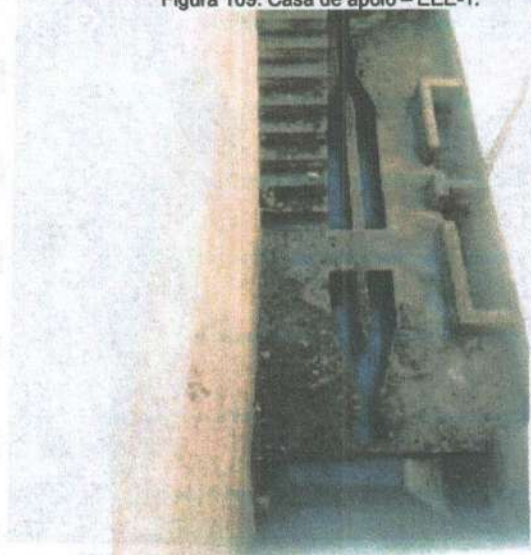
Figura 111: Gradeamento e caixa de areia - EEE-1.
