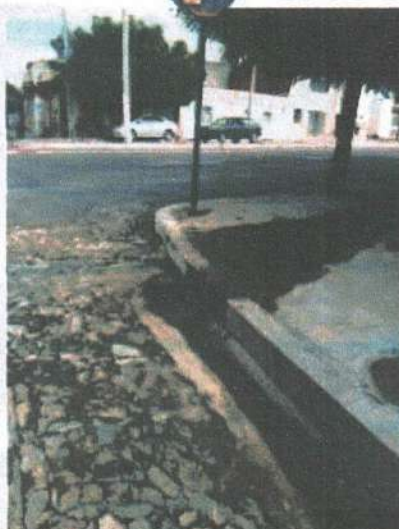
Figura 199: Sarjeta e bueiro em rua do Distrito Sede.
