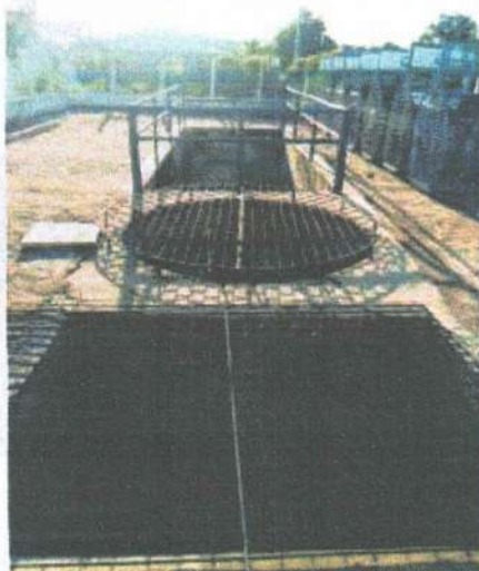
Figura 125: Poço de sucção – EEE-4
