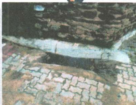
Figura 203: Boca-de-lobo com grelha em logradouro do Distrito Sede.
