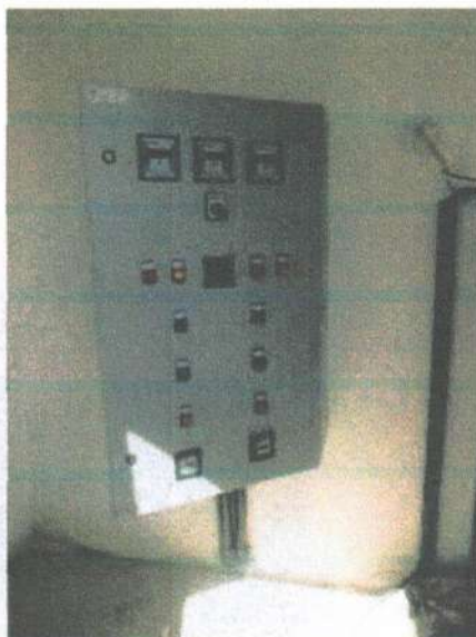
Figura 135: Quadro de comando da EEE-7.
