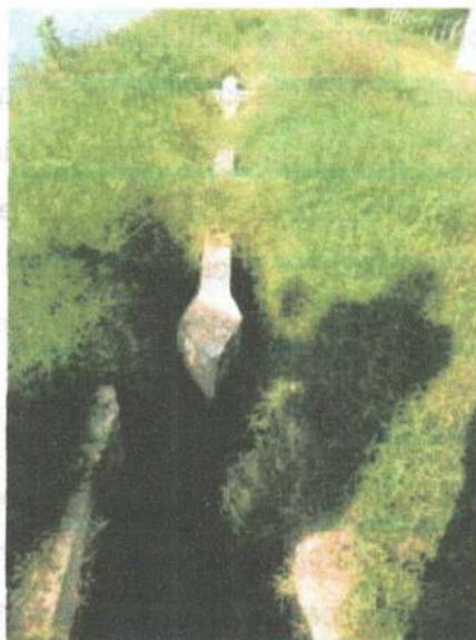
Figura 155: Vegetação nas unidades do tratamento preliminar – ETE Jaguaribe.
