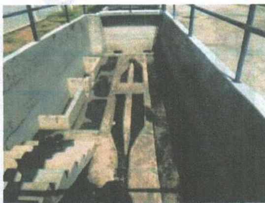
Figura 129: Gradeamento e caixa de areia - EEE-6.
