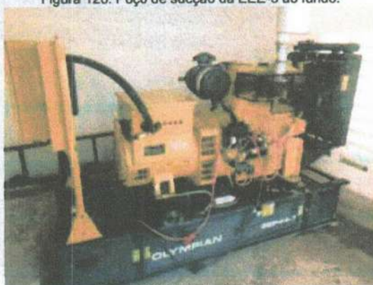
Figura 122: Gerador da EEE-3.
