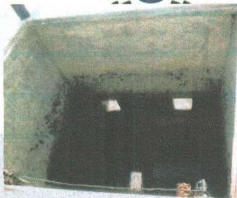
Figura 130: Poço de sucção da EEE-6.
