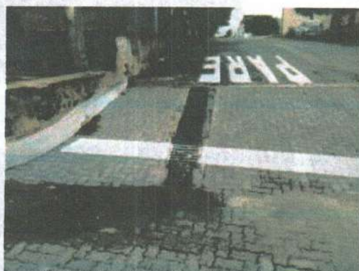
Figura 204: Sarjetão em logradouro do Distrito Sede.
