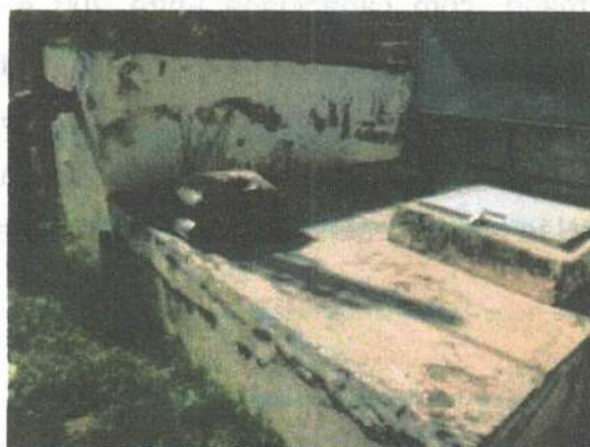
Figura 31: Reservatório booster mutirão.
