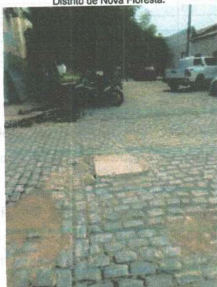
Figura 180: Estrutura do sistema coletor em logradouro do Distrito de Nova Floresta.
