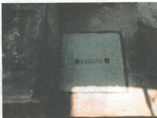
Figura 157: Caixa de passagem em passeio do Distrito de Mapuá.
