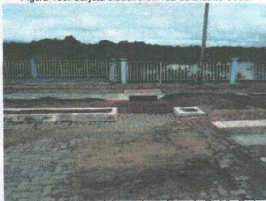
Figura 201: Boca-de-lobo em logradouro do Distrito Sede.
