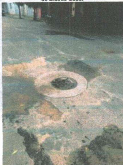
Figura 105: Poço de visita em rua do bairro Centro - Distrito Sede.
