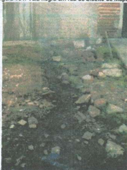
Figura 166: Vaia negra em rua do Distrito de Mapuá.
