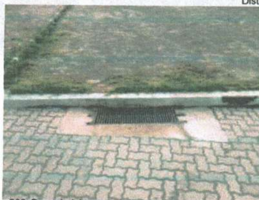
Figura 206: Boca-de-lobo com grelha em logradouro do Distrito Sede.
