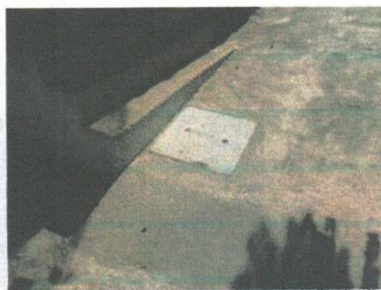
Figura 158: Caixa de passagem em passeio do Distrito de Mapuá.
