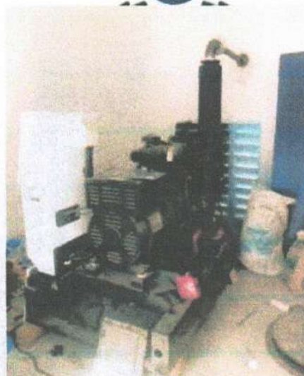
Figura 114: Gerador da EEE-1.
