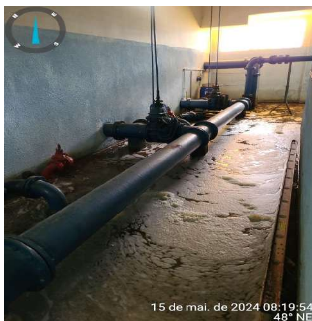
Foto 4 - ETA (sede) - área dos registros dos filtros com vazamento.
