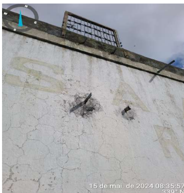
Foto 8 - RAP 1 e RAP 2 (sede) - ausência de escadas.
