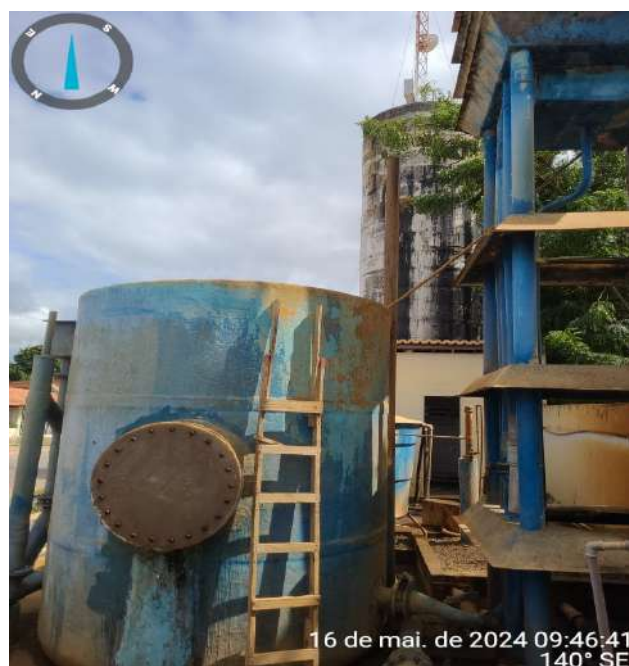
Foto 12 - ETA (Gadelha) - filtro e RAP com pinturas deterioradas.
