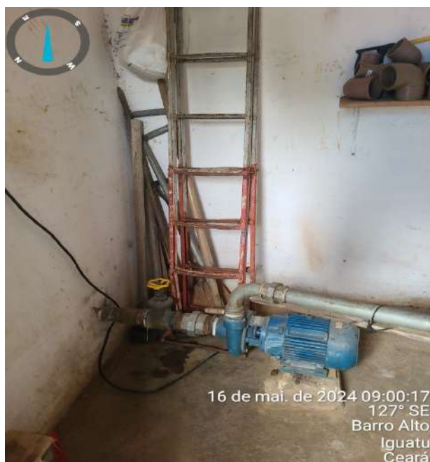
Foto 9 - ETA (Vila Barro Alto) - ausência de bomba reserva.
