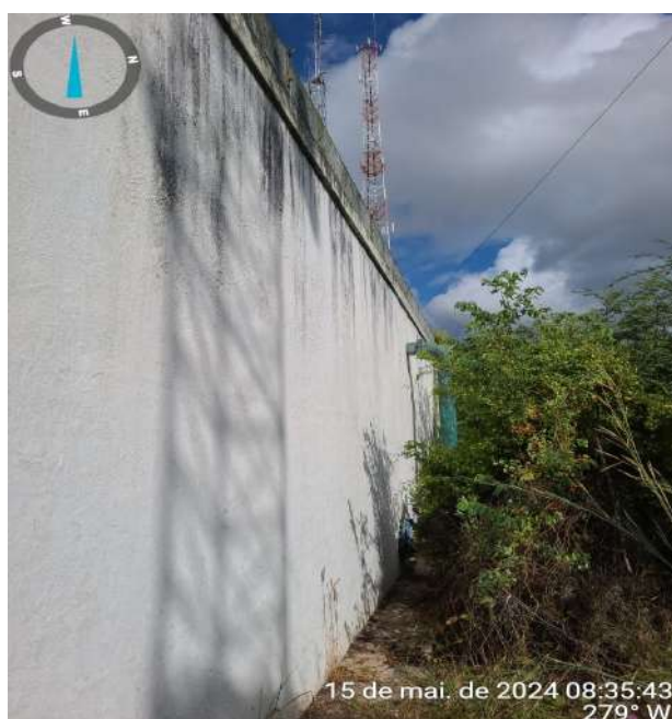
Foto 7 - RAP 1 e RAP 2 (sede) - excesso de vegetação no entorno.
