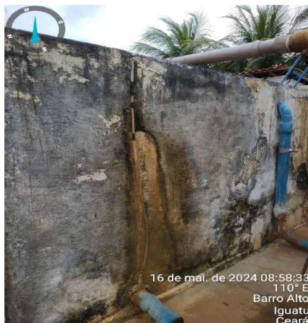
Foto 10 - ETA (Vila Barro Alto) - pintura do RAP deteriorada.
