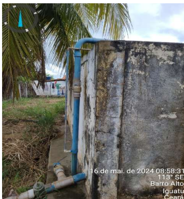
Foto 11 - ETA (Vila Barro Alto) - pintura do RAP deteriorada.
