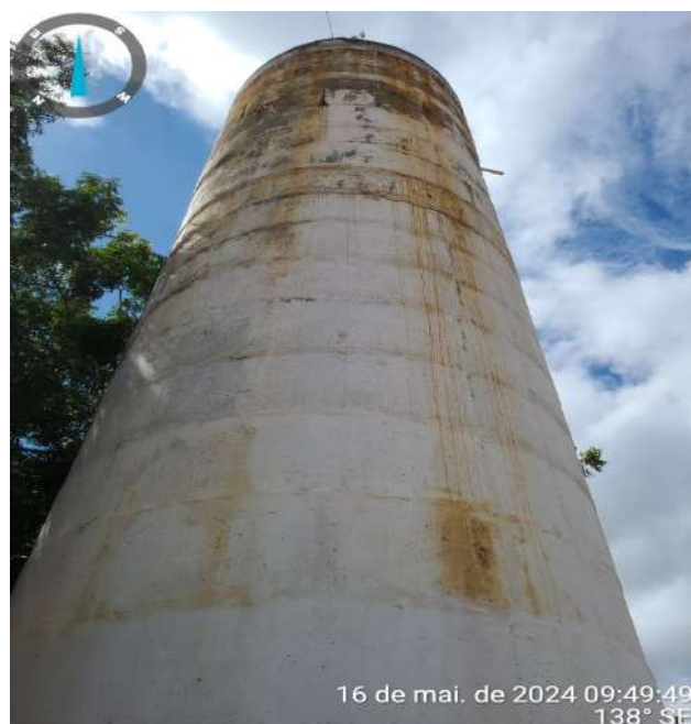
Foto 14 - ETA (Gadelha) - REL com pintura deteriorada.
