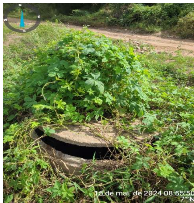
Foto 2 - Poço de captação (sede) - excesso de vegetação no entorno.
