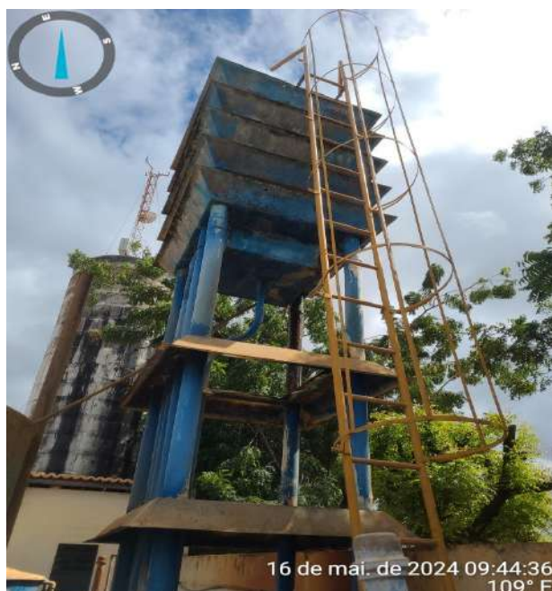
Foto 13 - ETA (Gadelha) - aerador oxidado e REL com pintura deteriorada.
