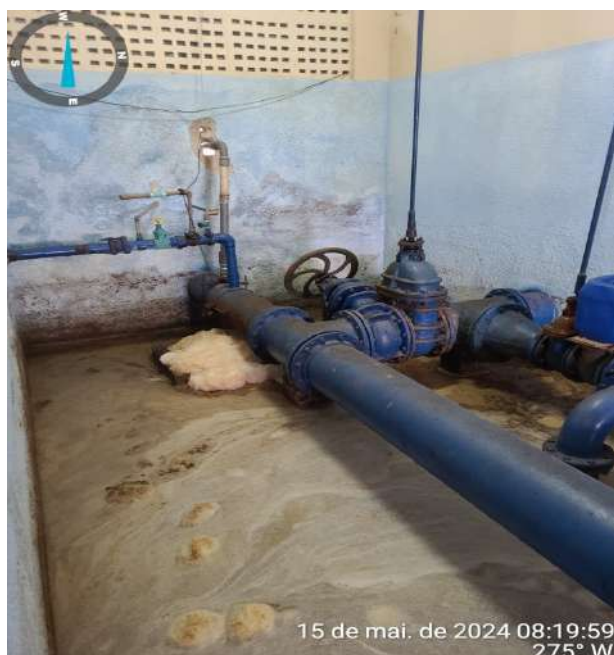
Foto 5 - ETA (sede) - área dos registros dos filtros com vazamento.
