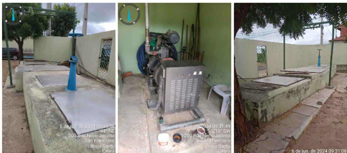
Figura 36. Estação Elevatória de Esgoto.
