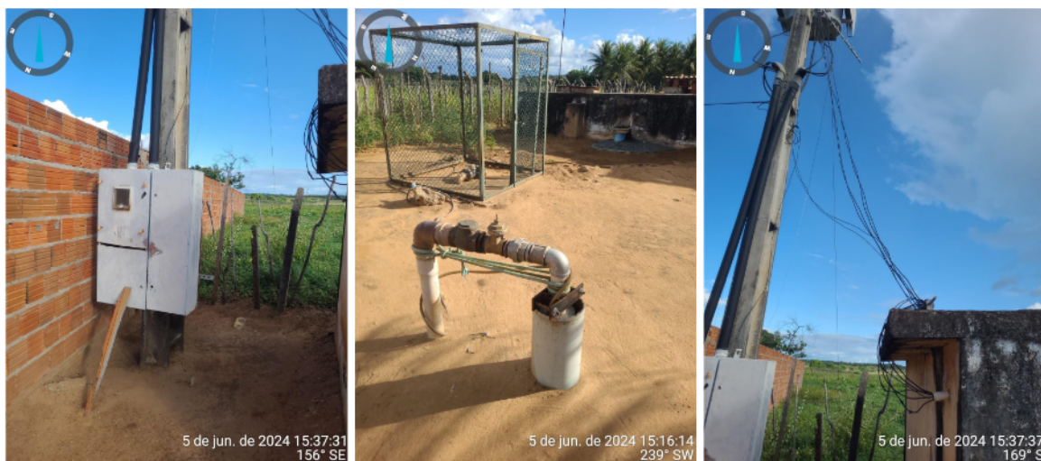
Figura 27. Poço Barreiro Preto.
