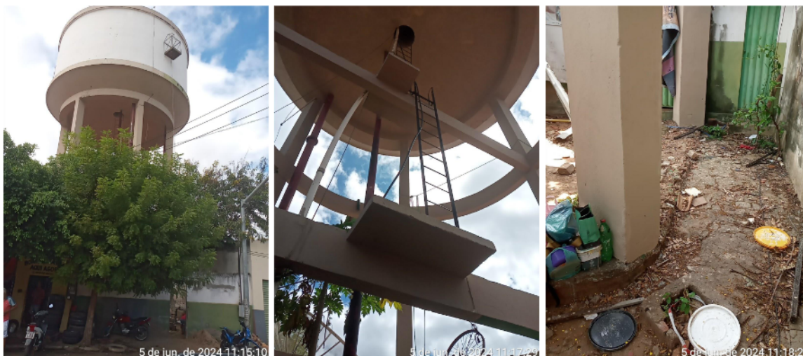
Figura 32. Reservatório Elevado - Caixa IMAP.
