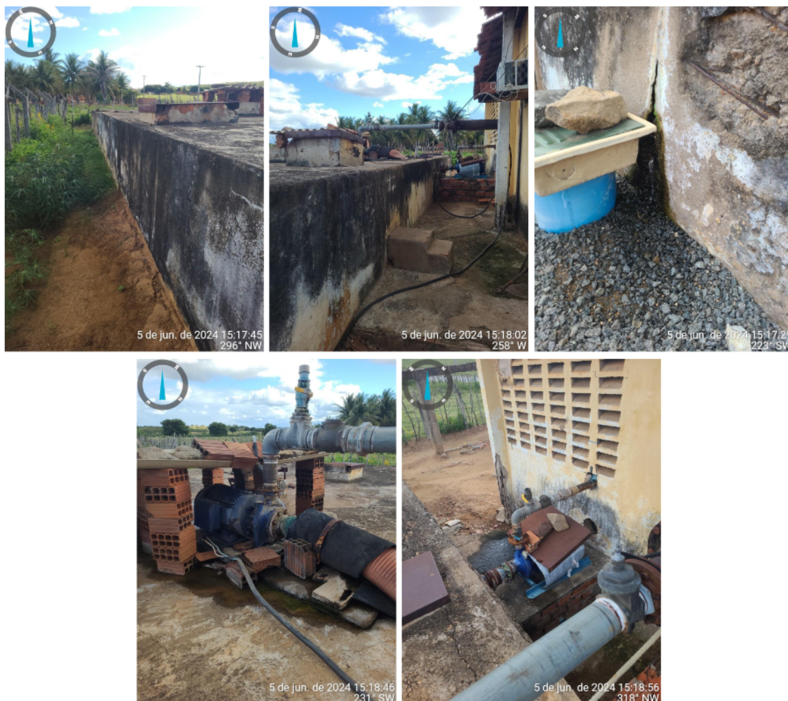
Figura 34. Reservatório Semienterrado - Barreiro Preto.
