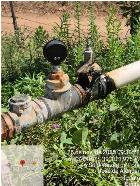
Foto 30 - Poço reserva com vazamento na tubulação.
