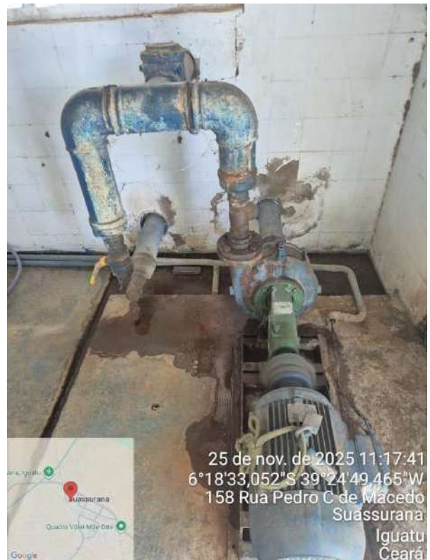
Foto 23 - Bomba com vazamento em tubulação oxidada e pintura desgastada.
