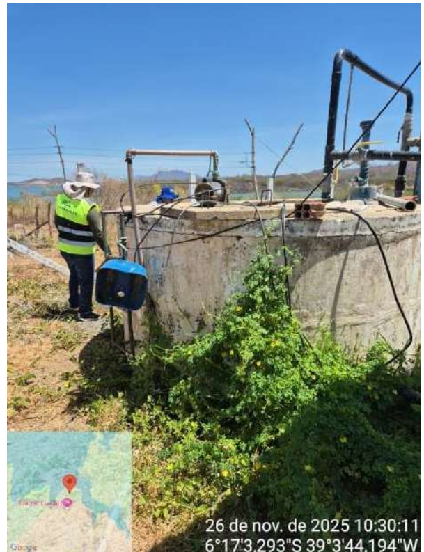
Foto 31 - Reservatório Apoiado de Catolé com vegetação crescida e pintura desgastada.
