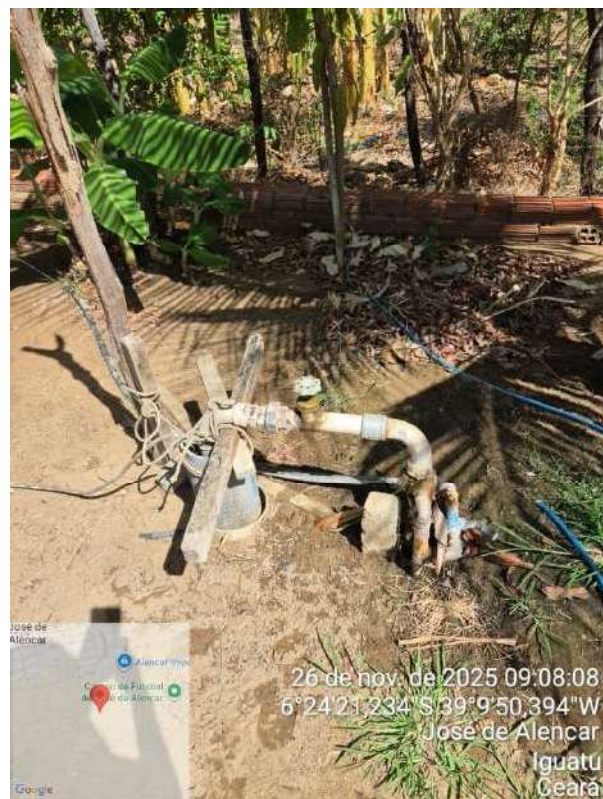
Foto 27 - Poço Rosária com vazamento na tubulação.
