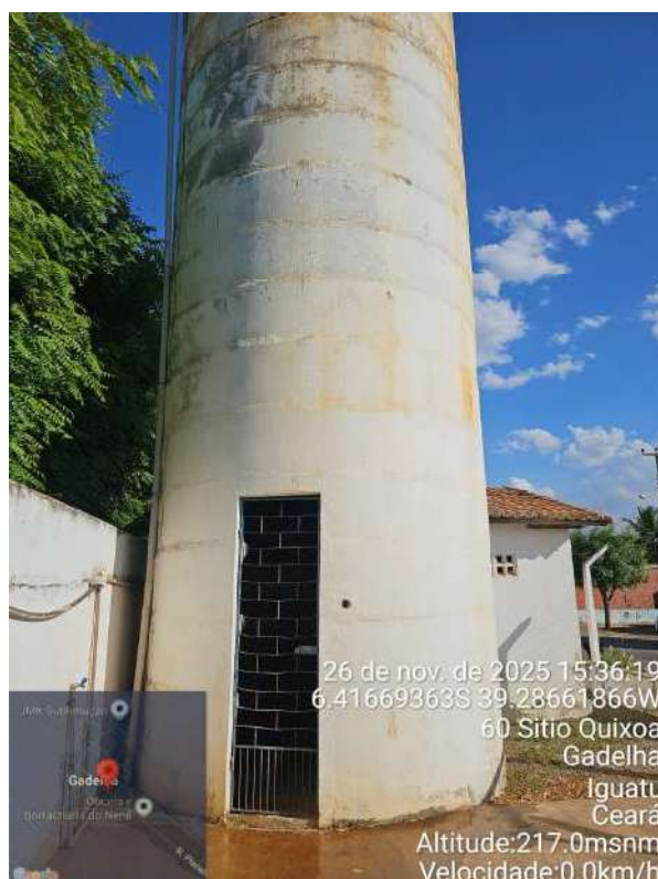
Foto 45 - Reservatório com pintura desgastada.
