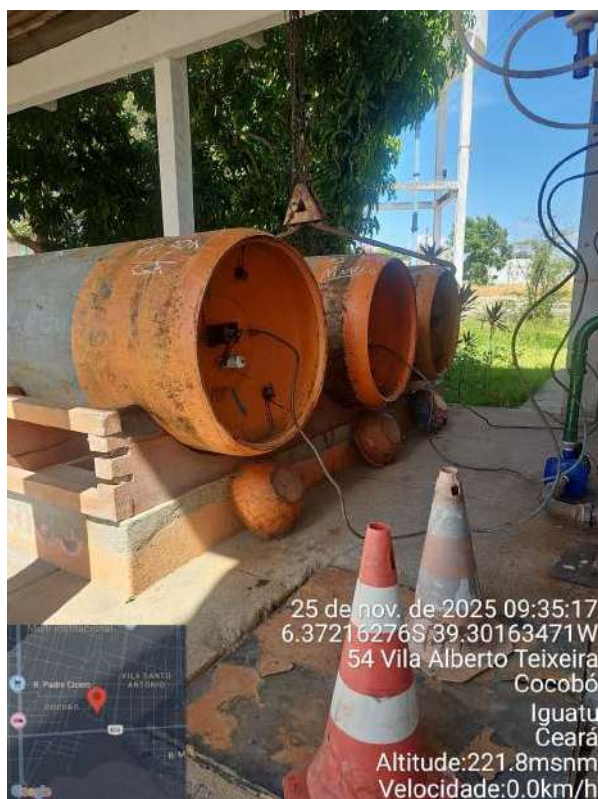
Foto 12 - Área do cloro com tampas corroídas, apresentando risco de acidentes.
