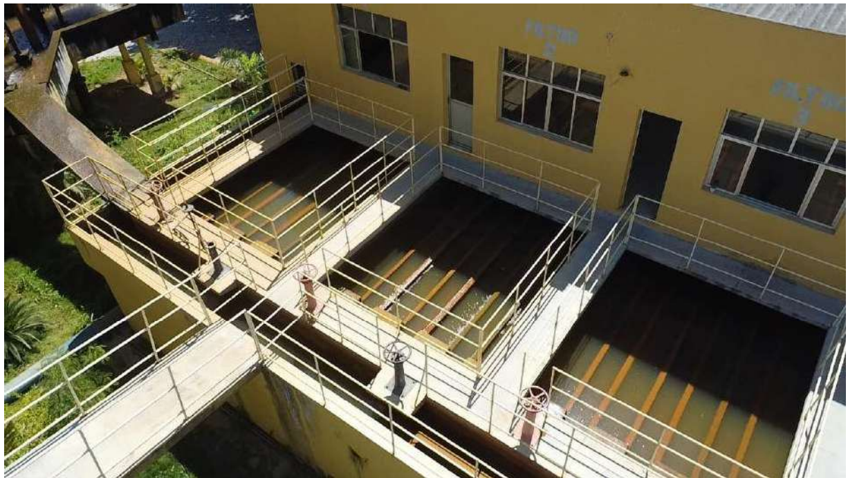
Foto 2 - Estrutura do aerador com armadura aparente, oxidada e desgastada, com passarela sem guarda-corpo.
