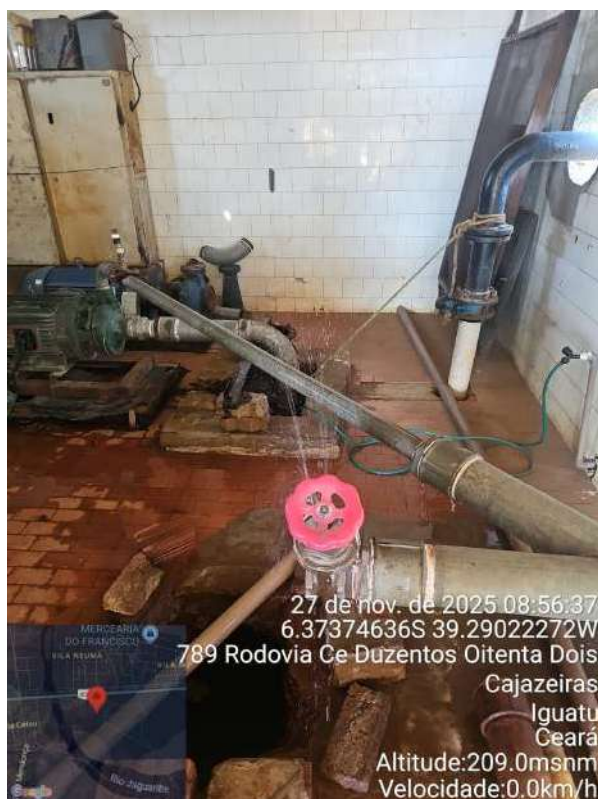
Foto 65 - Bombas e válvulas oxidadas e com vazamento extremo.
