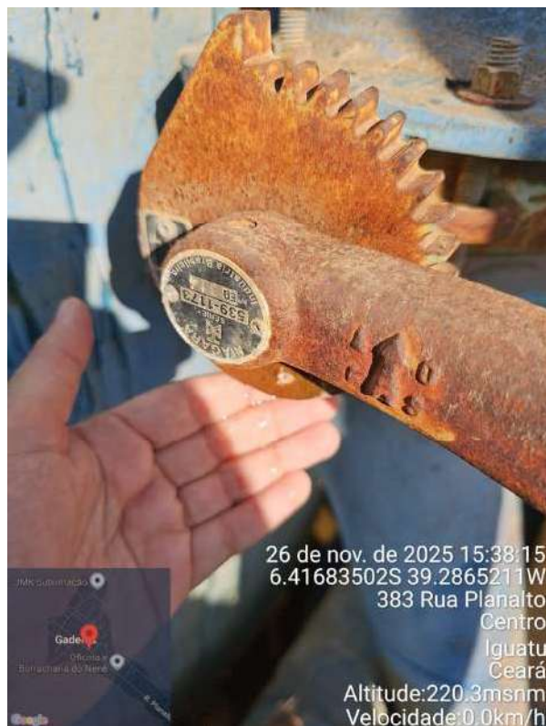
Foto 42 - Válvula oxidada e com vazamento.
