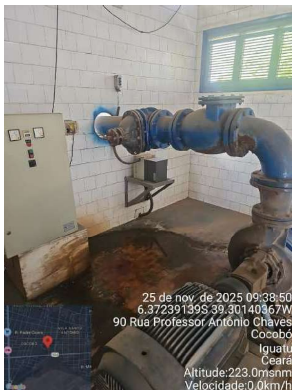
Foto 14 - EEAT-03 com tubulação oxidada e com vazamento.
