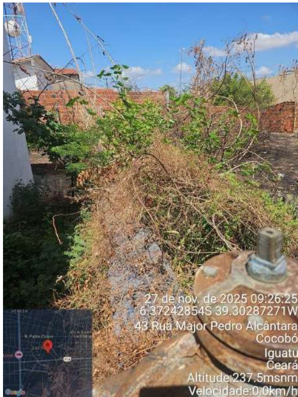
Foto 71 - Vegetação alta ao redor do reservatório e nas proximidades, com tubulações oxidadas.
