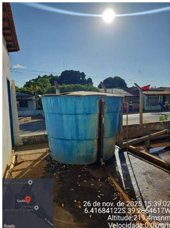
Foto 43 - Caixa com vazamento na tubulação.
