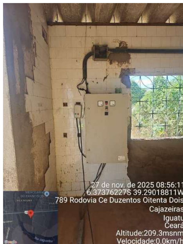
Foto 60 - Painéis com fiação solta e sem eletrodutos, paredes degradadas e com sujeira.
