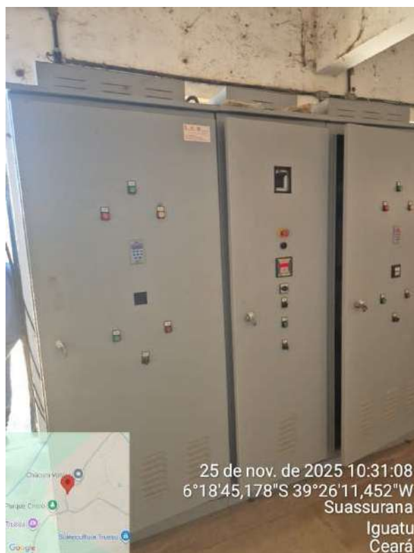
Foto 16 - Painel sem aviso de perigo de choque elétrico.
