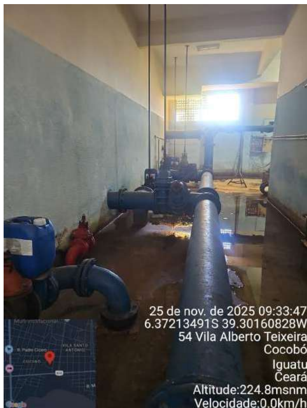
Foto 10 - Casa de bombas com vazamento.
