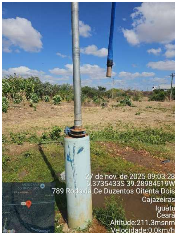
Foto 75 - Ponto de distribuição com vazamento na válvula e na mangueira.
