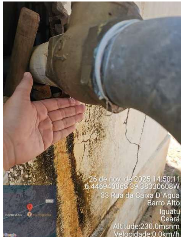
Foto 39 - Tubulações e filtros com vazamento.
