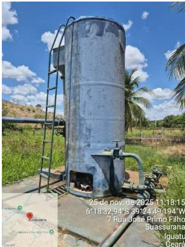
Foto 22 - Tanque sem guarda-corpo e com vazamento próximo da válvula.
