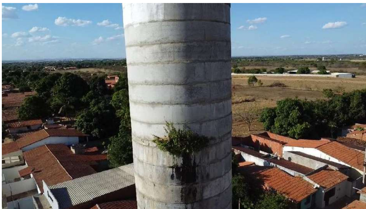
Foto 47 - Reservatório 2 com presença de vegetação nas paredes, pintura desgastada, sem tampa e com escada e guarda-corpo oxidados.
