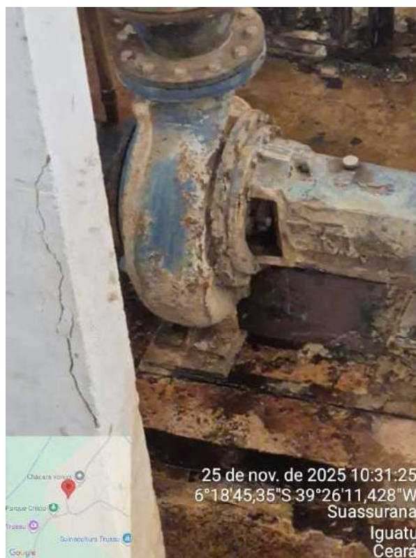
Foto 17 - Tubulações com oxidação e vazamento.
