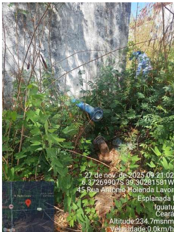
Foto 69 - Vegetação alta ao redor do reservatório e nas proximidades, sem proteção no fim da laje.
