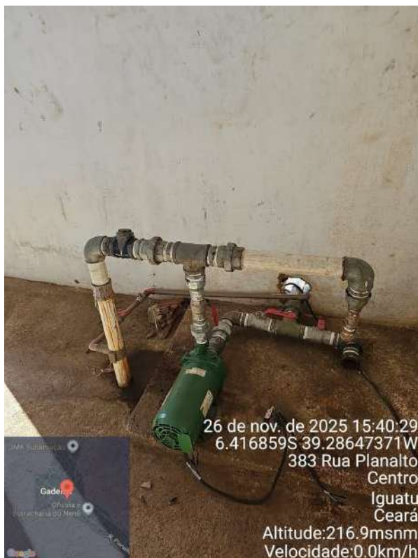
Foto 40 - Fiação da bomba sem eletrodutos.
