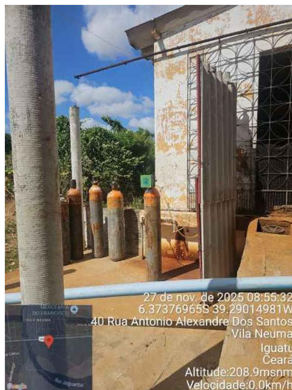
Foto 58 - Armazenamento inadequado de cilindros de gás, sem casa de proteção.
