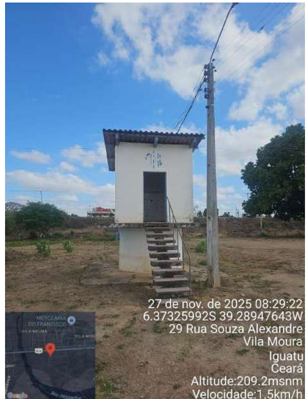
Foto 52 - EEAB sem lâmpada, sinalização e guarda-corpo.
