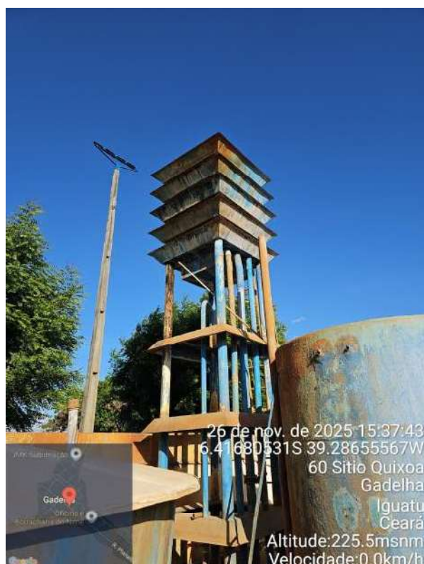
Foto 44 - Aerador oxidado e com pintura desgastada.
