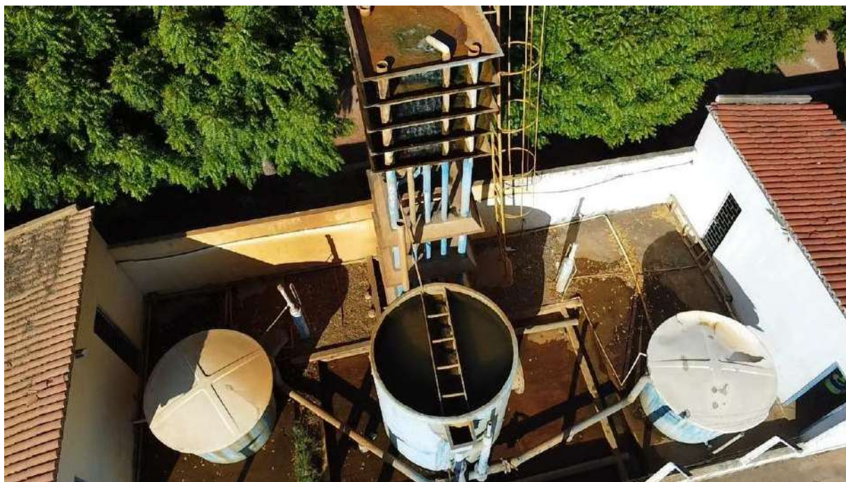
Foto 46 - Área da ETA com pontos de vazamento e equipamentos desgastados.
