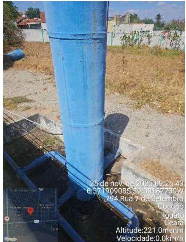
Foto 4 - Tubulação da segunda pré-cloração com vazamento.
