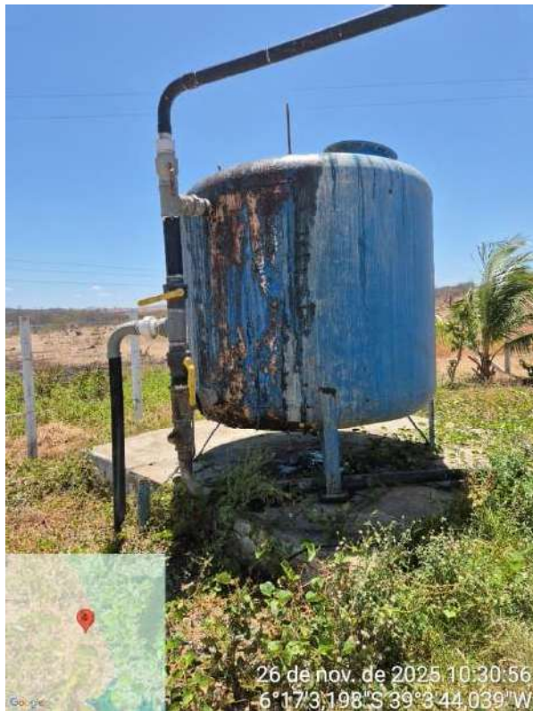
Foto 34 - Filtro com vazamentos no registro e oxidação severa.
