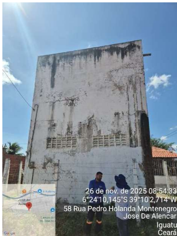
Foto 26 - Reservatório por compensação com paredes desgastadas.
