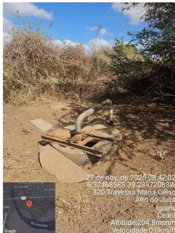
Foto 56 - Manilha 2 com vazamento em estado inicial e tampa quebrada.
