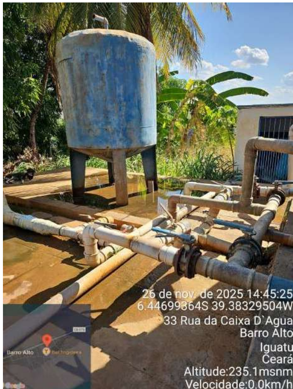
Foto 38 - Tubulações e filtros com vazamento.
