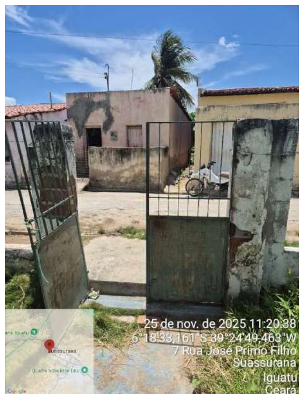
Foto 25 - Portão de acesso da ETA oxidado e com parede deteriorada.
