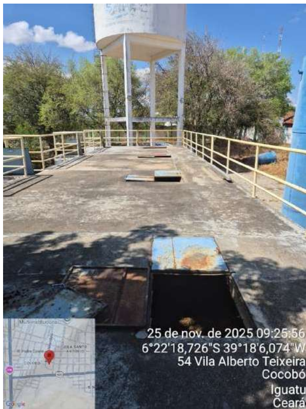
Foto 5 - Tampas dos filtros oxidadas, com risco de contaminação da água com ferro.
