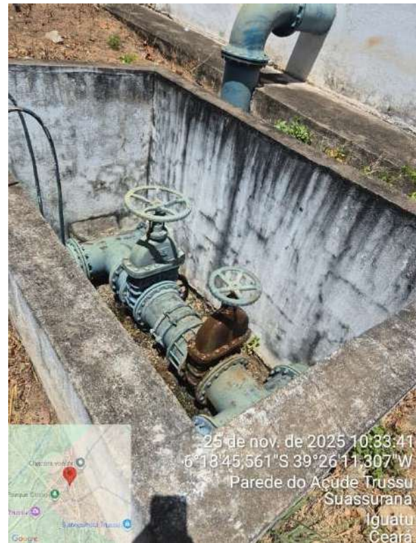
Foto 19 - Válvulas com vazamento e sem tampa de proteção.
