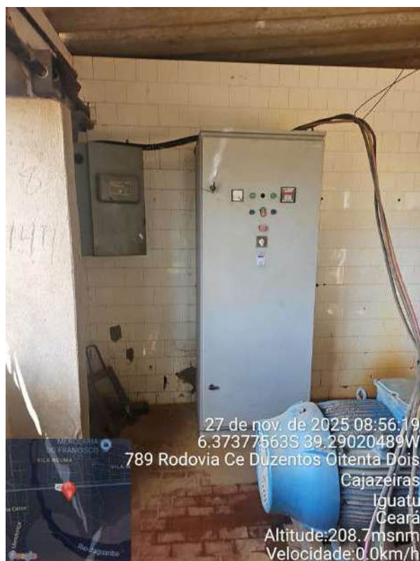
Foto 61 - Painéis com fiação solta e sem eletrodutos, paredes degradadas e com sujeira.
