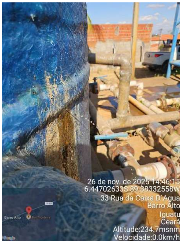
Foto 36 - Tubulações e filtros com vazamento.
