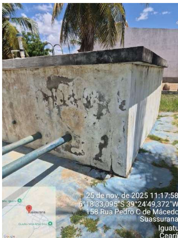
Foto 20 - Reservatório de água tratada com pintura desgastada, fissuras e vazamento.
