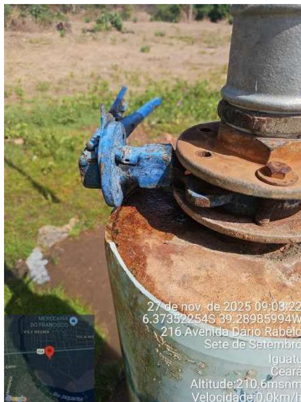
Foto 76 - Ponto de distribuição com vazamento na válvula e na mangueira.
