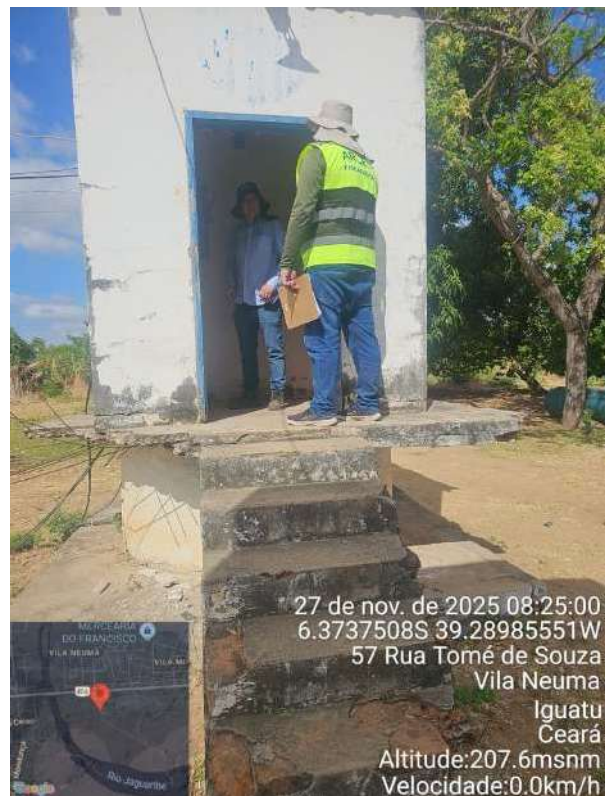
Foto 50 - Casa de controle com armadura exposta, pintura desgastada e riscos de queda.
