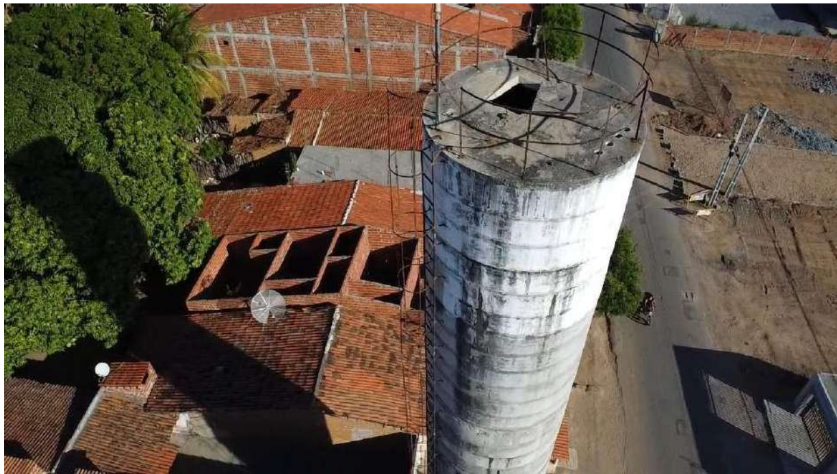
Foto 48 - Reservatório 2 com presença de vegetação nas paredes, pintura desgastada, sem tampa e com escada e guarda-corpo oxidados.
