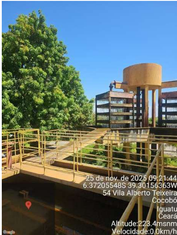
Foto 3 - Estrutura do aerador desgastada, com passarela sem guarda-corpo.
