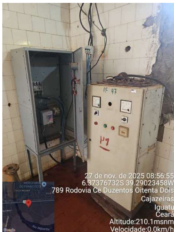
Foto 59 - Painéis com fiação solta e sem eletrodutos, paredes degradadas e com sujeira.
