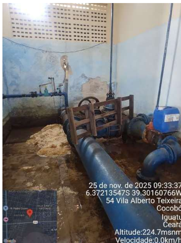
Foto 9 - Casa de bombas com válvulas enferrujadas, tubulações oxidadas e com vazamento de produto.
