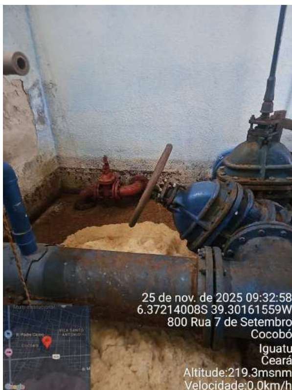
Foto 8 - Casa de bombas com válvulas enferrujadas, tubulações oxidadas e com vazamento de produto.
