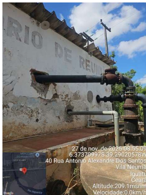
Foto 62 - Abertura inadequada para passagem de tubulação, que está oxidada.
