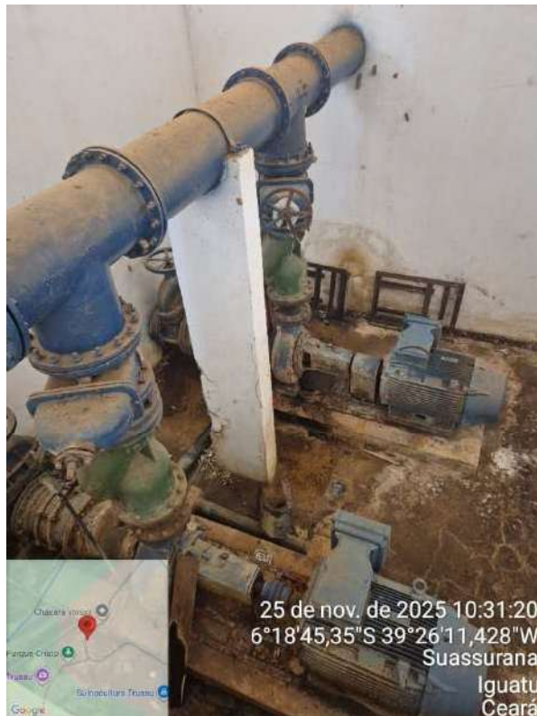
Foto 18 - Tubulações com oxidação e vazamento.
