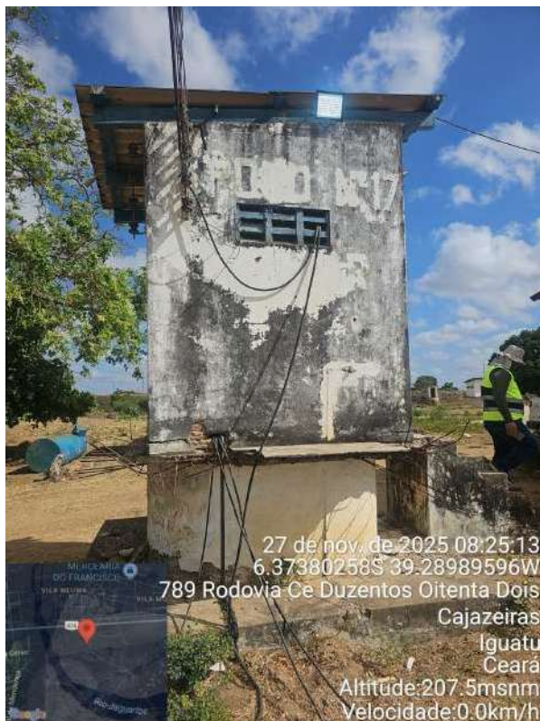
Foto 49 - Casa de controle com armadura exposta, pintura desgastada e riscos de queda.
