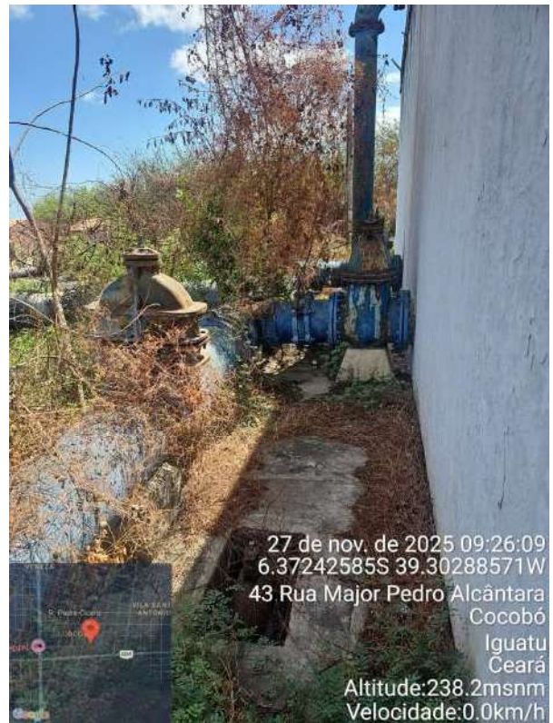
Foto 72 - Vegetação alta ao redor do reservatório e nas proximidades, com tubulações oxidadas.
