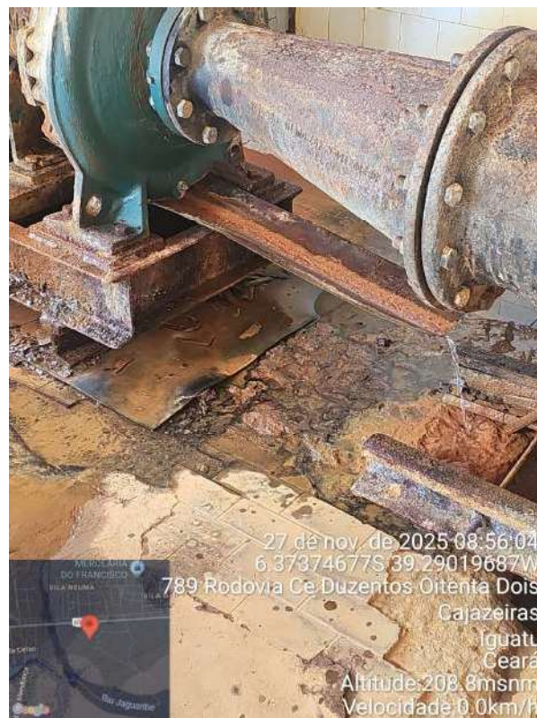
Foto 64 - Bombas e válvulas oxidadas e com vazamento extremo.
