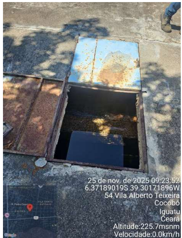
Foto 6 - Tampas dos filtros oxidadas, com risco de contaminação da água com ferro.
