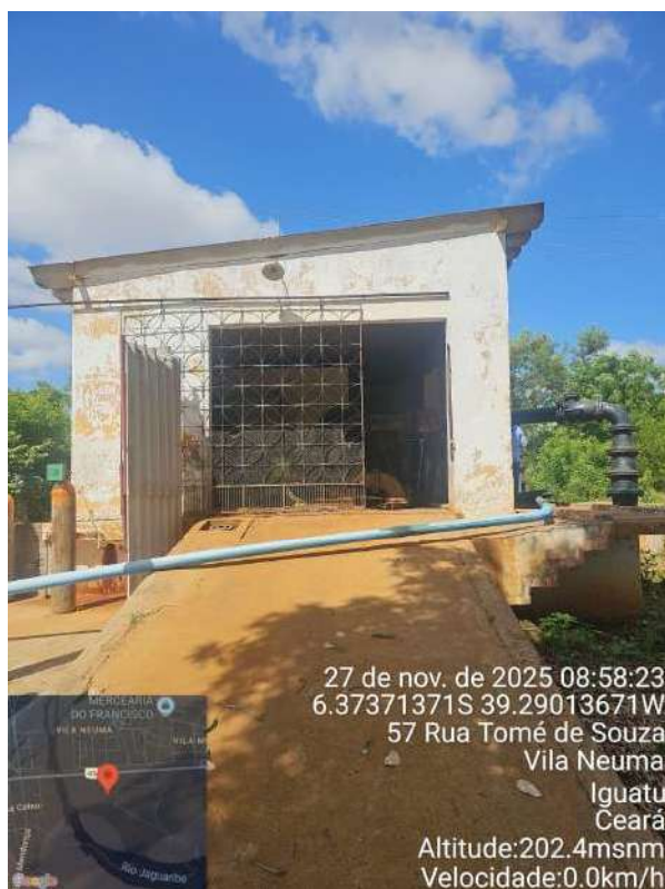
Foto 57 - Portão de acesso sem identificação.
