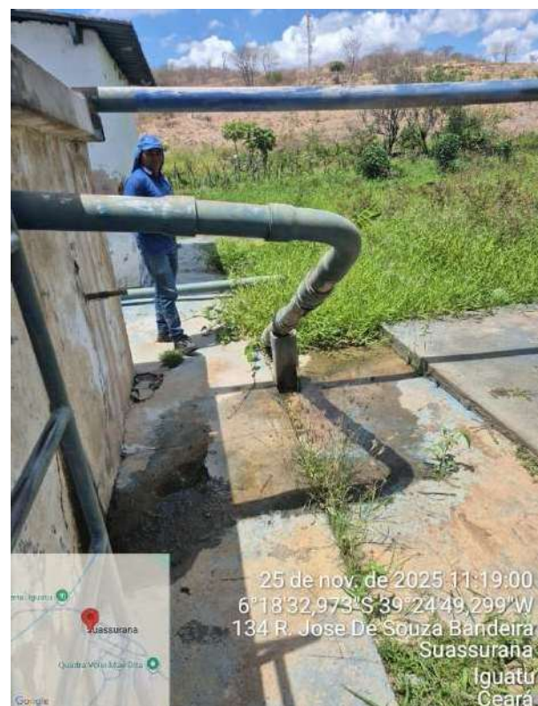
Foto 21 - Reservatório de água tratada com pintura desgastada, fissuras e vazamento.
