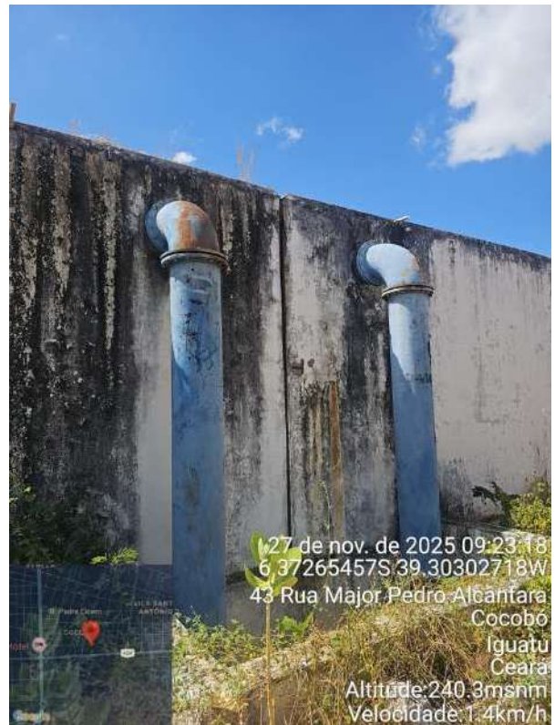
Foto 68 - Tubulação de entrada com pontos de oxidação, parede do reservatório desgastada e com armadura exposta.
