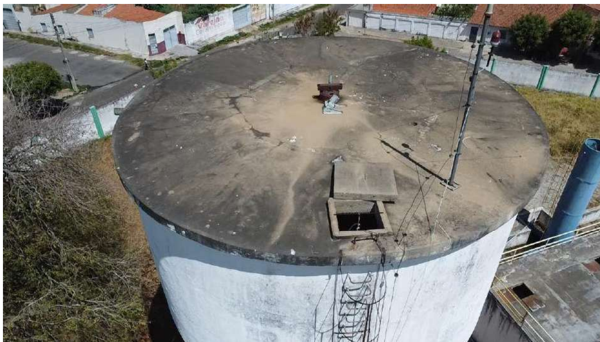
Foto 7 - Reservatório da ETA aberto, pintura desgastada, escada com oxidação.
