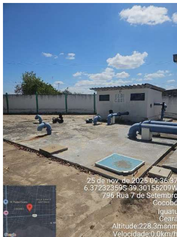
Foto 13 - Reservatório de reunião com peças de tubulações soltas e partes oxidadas.
