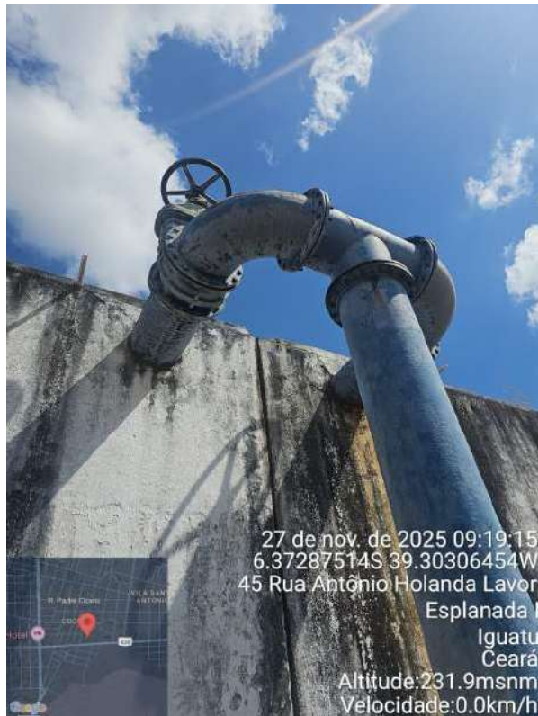
Foto 67 - Tubulação de entrada com pontos de oxidação, parede do reservatório desgastada e com armadura exposta.
