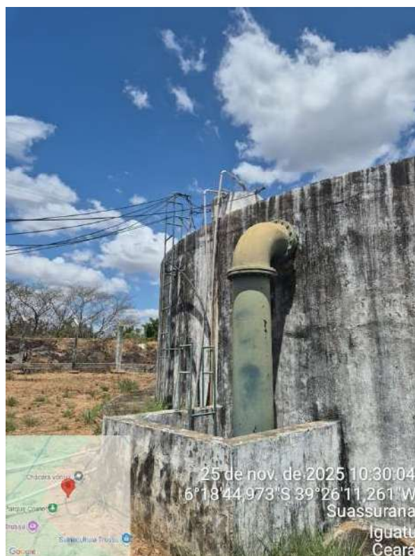
Foto 15 - Reservatório EEAB com pintura desgastada e escada sem guarda-corpo, com fiação presa na escada inadequadamente.
