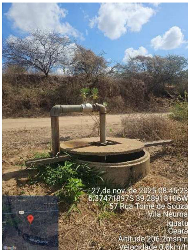
Foto 55 - Manilha 5 com vazamento.
