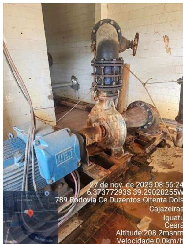
Foto 66 - Bombas e válvulas oxidadas e com vazamento extremo.
