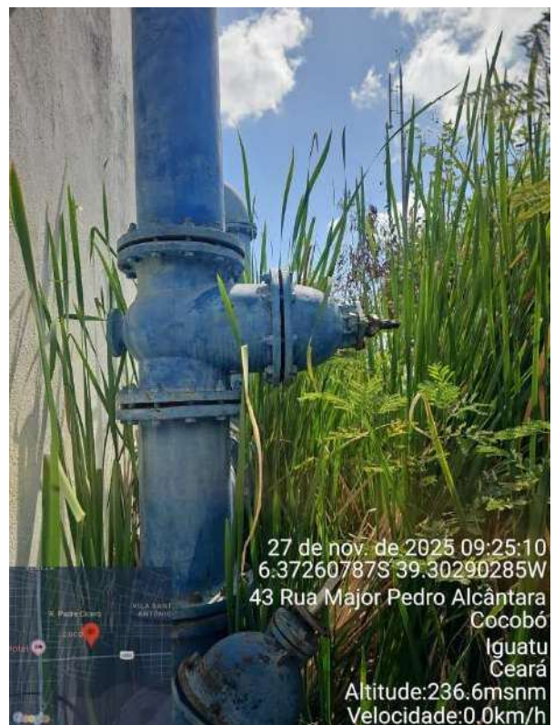
Foto 74 - Entrada de água com vazamento na válvula.
