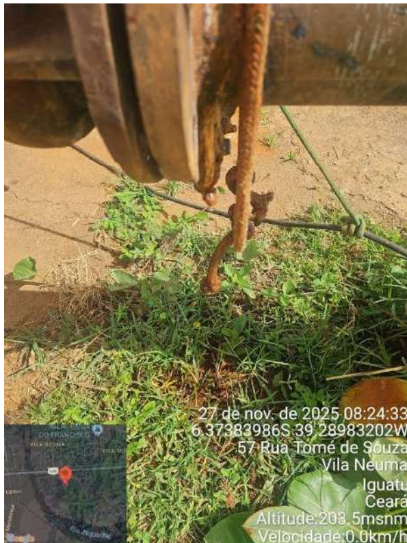
Foto 51 - PT-45 e 47 com vazamento.
