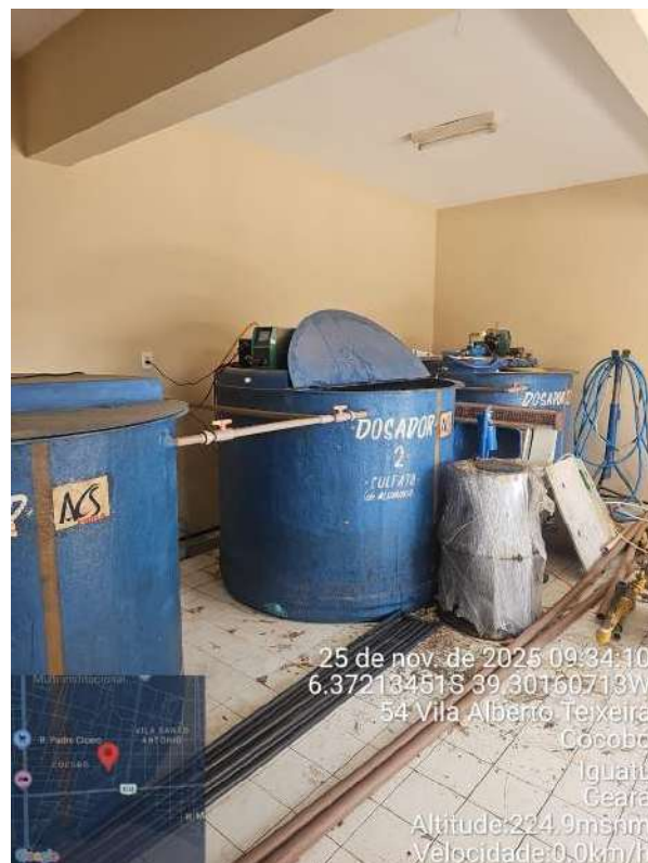
Foto 11 - Materiais de tubulação próximos aos dosadores, apresentando risco de acidentes.
