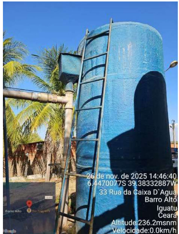
Foto 35 - Escada dos filtros inadequada, sem guarda-corpo.
