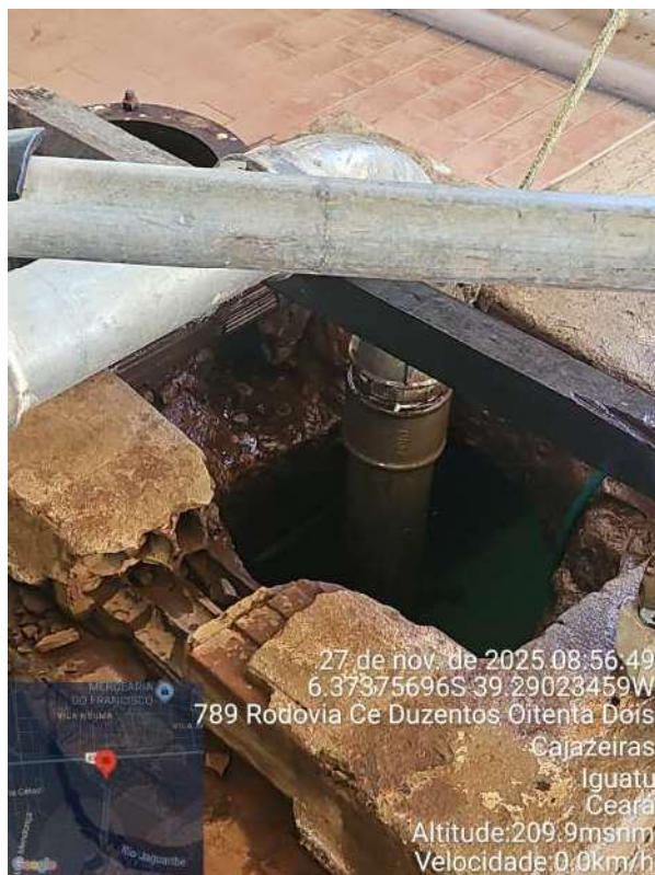
Foto 63 - Bombas e válvulas oxidadas e com vazamento extremo.
