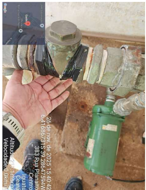
Foto 41 - Tubulação da bomba com vazamento.
