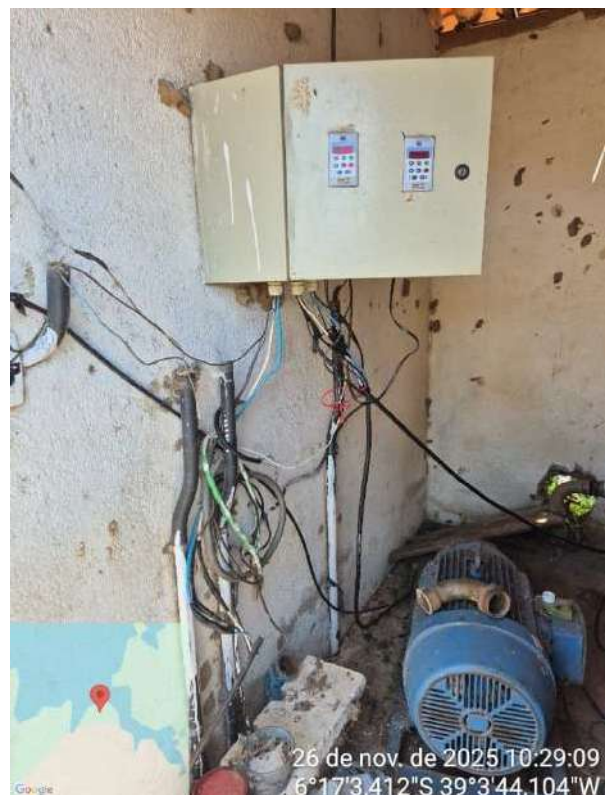
Foto 33 - Painel de controle com fiação exposta e sem adesivos de perigo, sala com sujidades.
