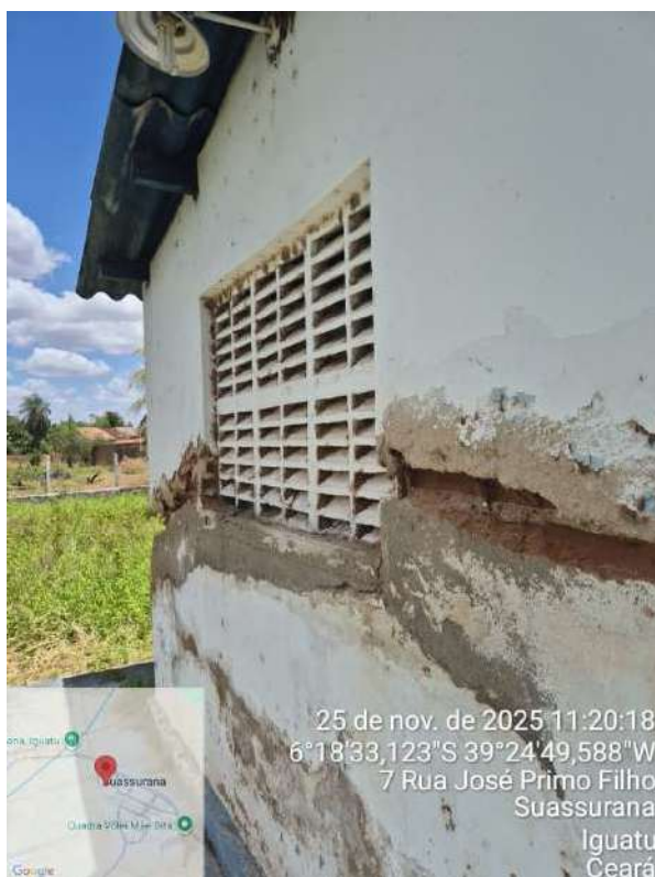
Foto 24 - Casa de bombas com parede deteriorada.
