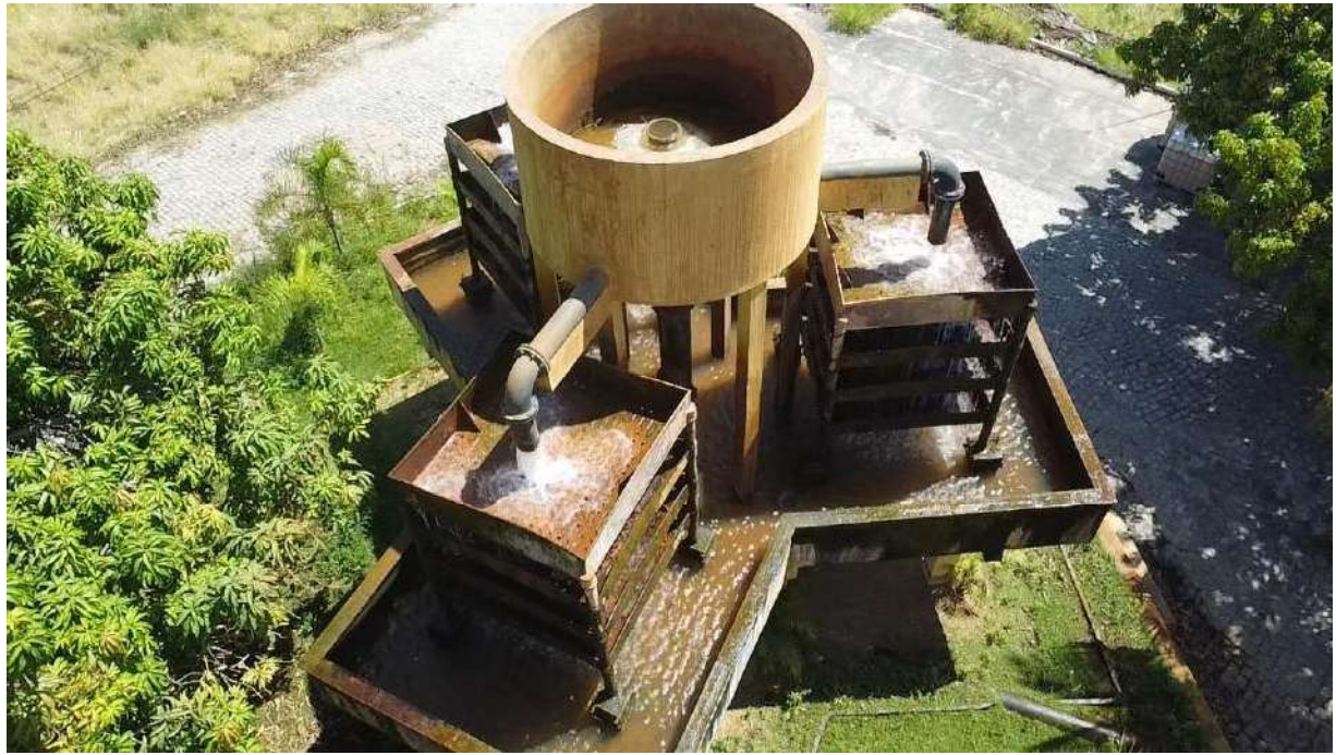
Foto 1 - Estrutura do aerador com armadura aparente, oxidada e desgastada.
