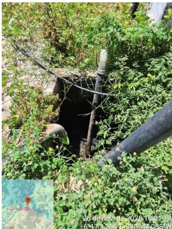
Foto 32 - Vegetação crescida e buracos no piso apresentando riscos de queda.
