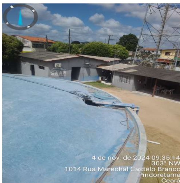
Foto 8 - Reservatório apoiado sem tampa e com instalações elétricas inadequadas.
