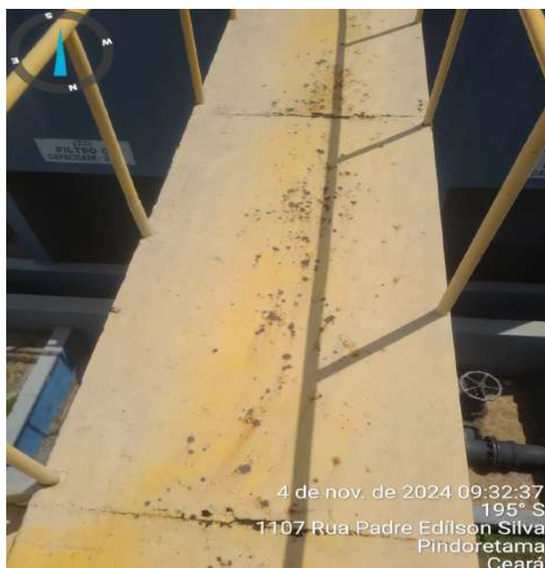
Foto 5 - Passarela em processo de corrosão.
