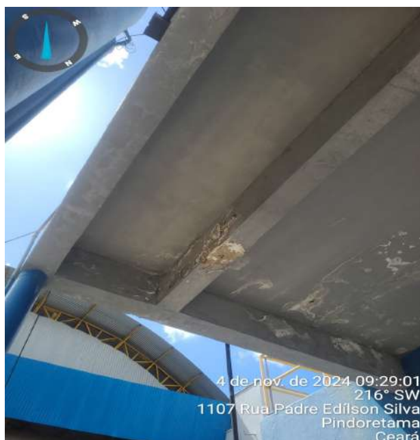
Foto 1 - Laje com estrutura em processo de deterioração.
