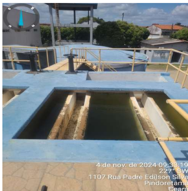
Foto 6 - Ausência de guarda-corpos na área superior dos filtros.
