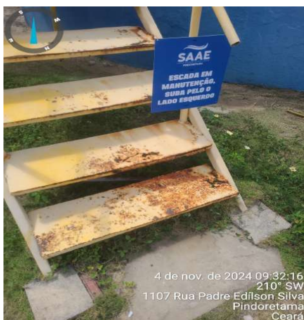
Foto 3 - Escada em processo de corrosão.
