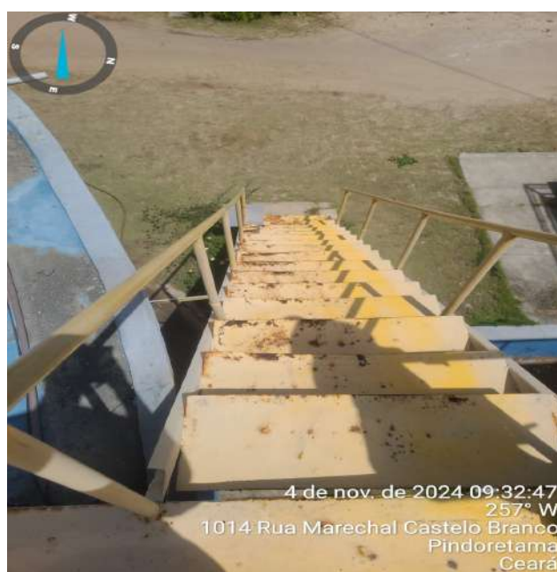
Foto 4 - Escada em processo de corrosão.
