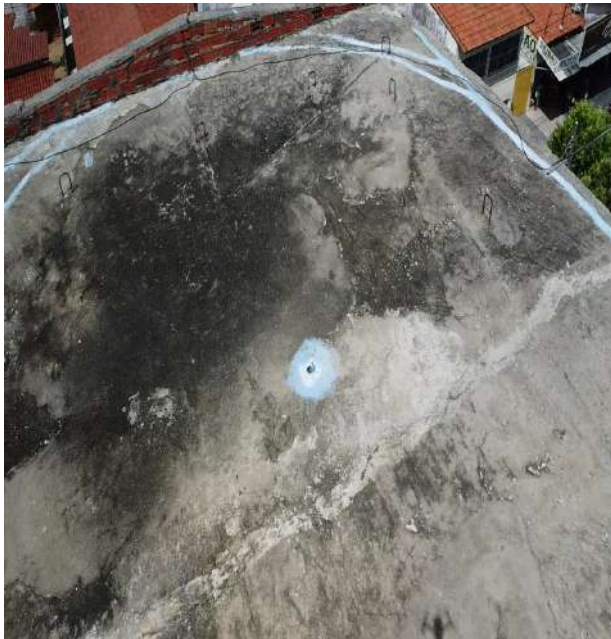
Foto 9 - Reservatório elevado com tubulação de respiro inadequada.
