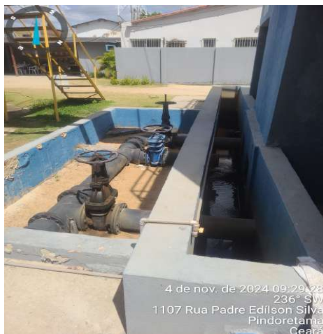
Foto 2 - Válvulas dos filtros com vazamentos.
