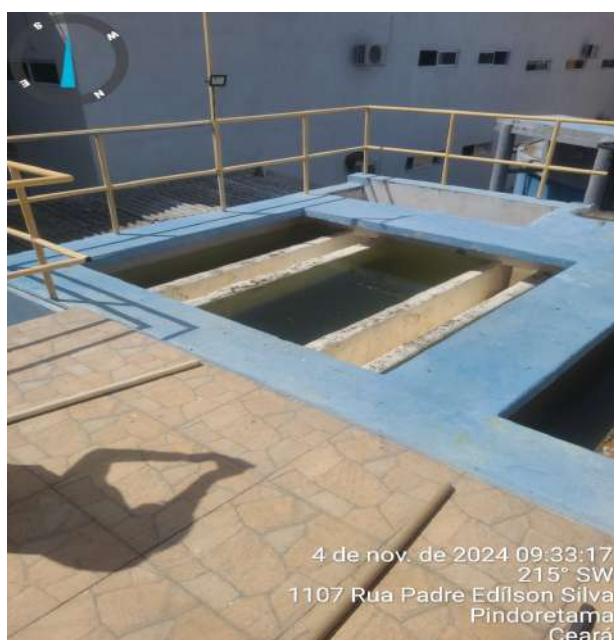
Foto 7 - Ausência de guarda-corpos na área superior dos filtros.
