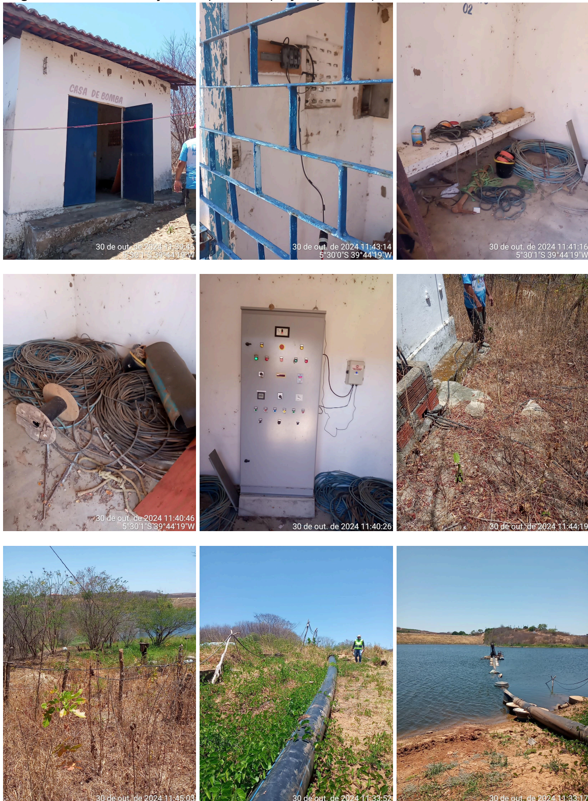
Figura 6. Manancial Açude Trapiá II e Captação (flutuante).
