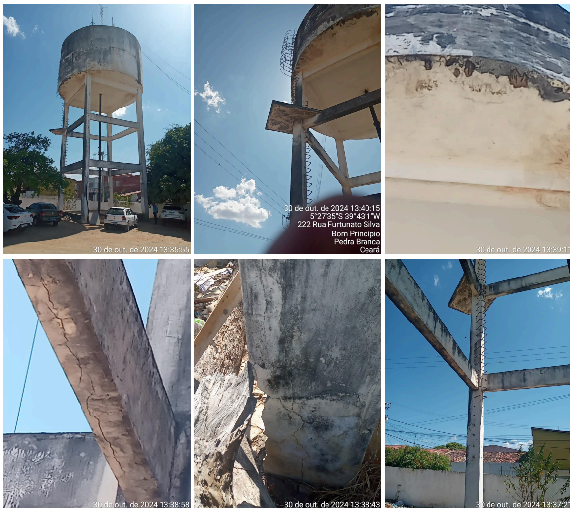
Figura 13. Reservatório Elevado - Centro / Hospital.
