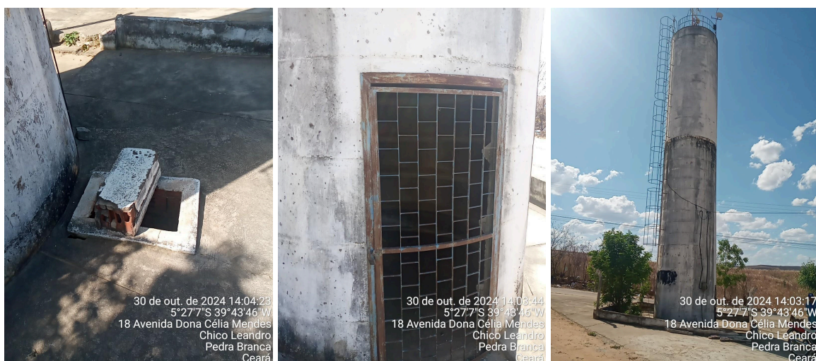
Figura 14. Reservatório Elevado - Residencial Chico Leandro.
