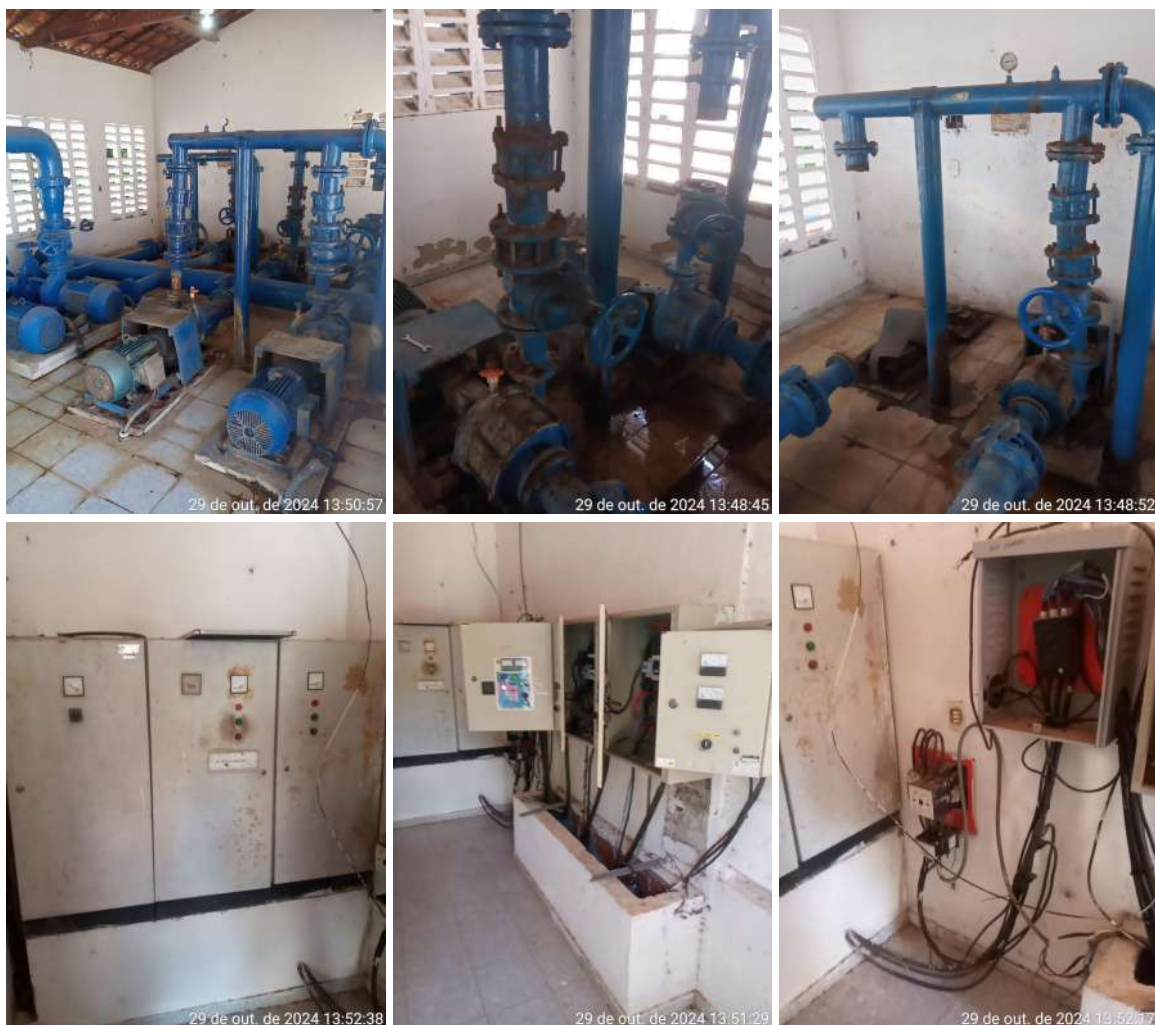
Figura 15. Casa de Bombas.
