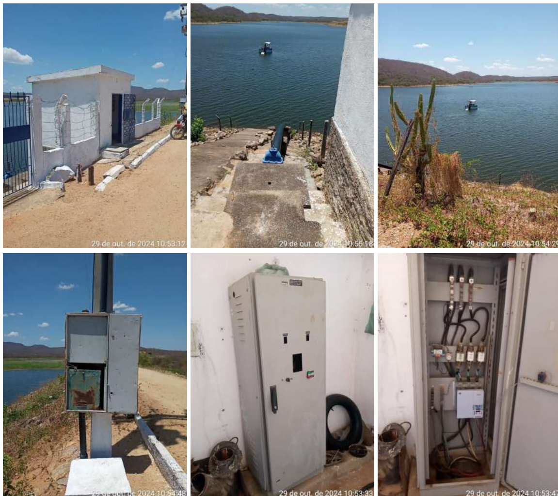
Figura 7. Imagens da estação de captação do Açude Farias de Souza.
