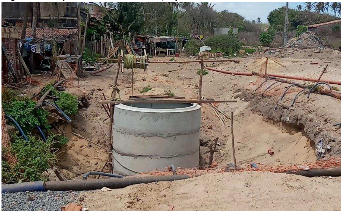
Figura 36. Estação Elevatória EEE-5 da Ampliação do SES da Sede de Camocim.
