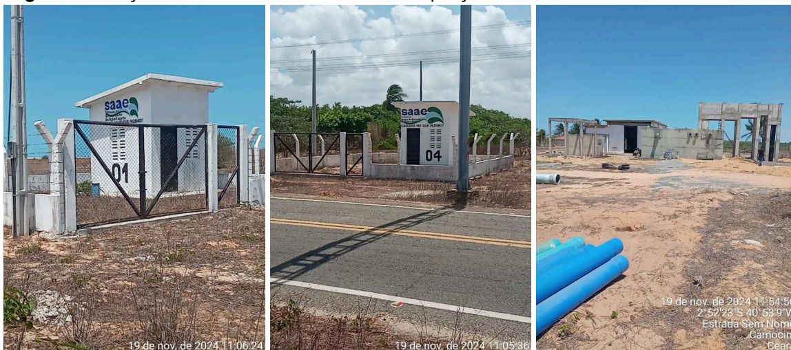
Figura 35. Poços Subterrâneos e ETA nova da Ampliação do SAA da Sede de Camocim.
