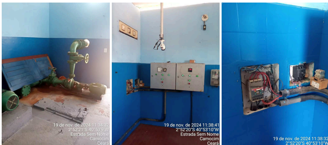
Figura 10. Casa de Bombas.
