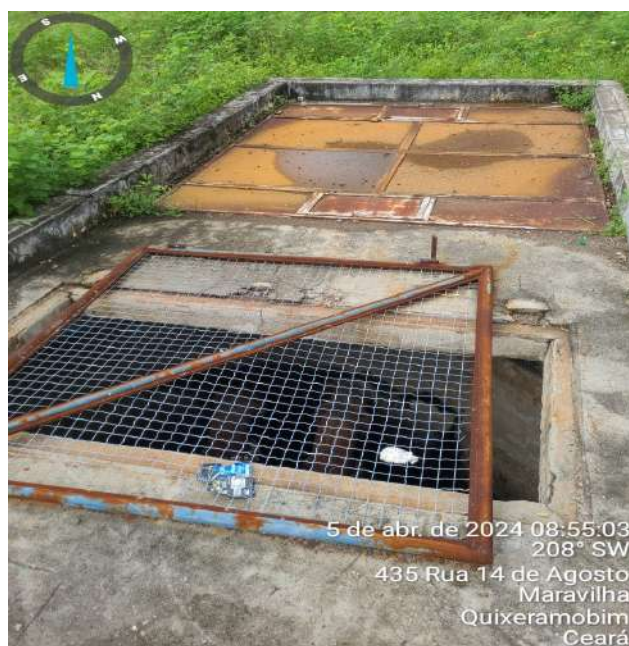
Foto 2 - EEE: poço com ausência de tampas.
