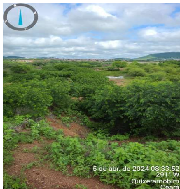
Foto 11 - ETE: vegetação no interior das lagoas de maturação e nos taludes.
