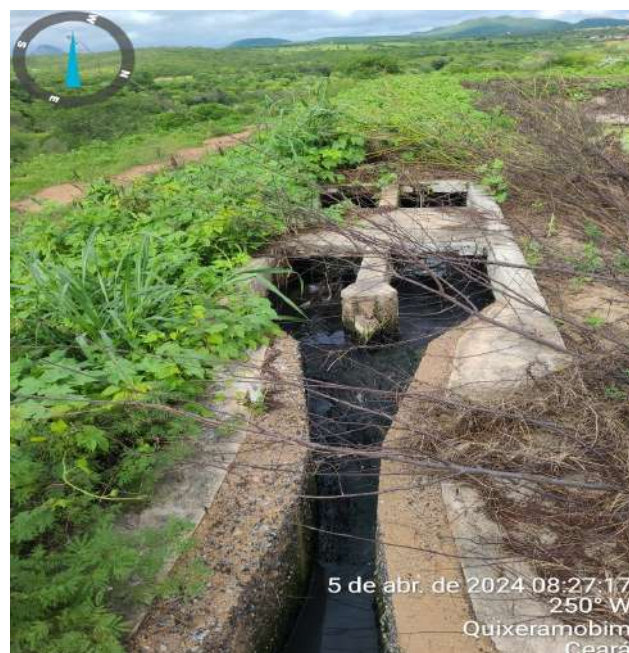
Foto 6 - ETE: caixa de areia sem manutenção.
