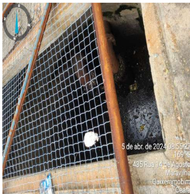
Foto 4 - EEE: ausência de gradeamento.
