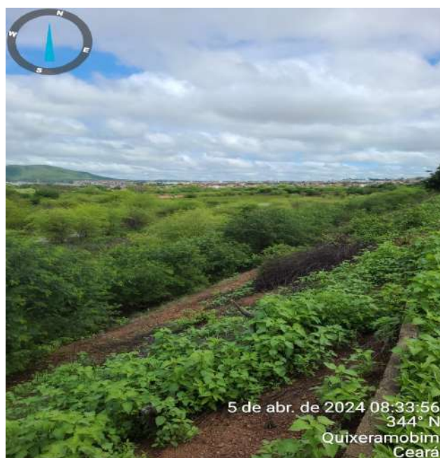
Foto 10 - ETE: vegetação no interior da lagoa facultativa e nos taludes.
