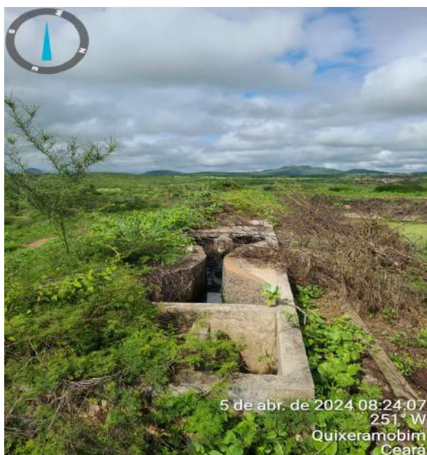
Foto 5 - ETE: caixa de areia sem manutenção.
