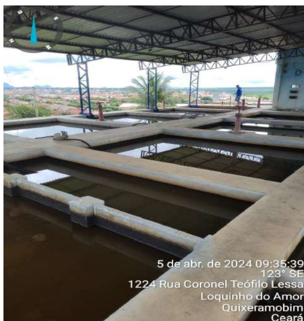
Foto 1 - ETE: ausência de guarda-corpo.
