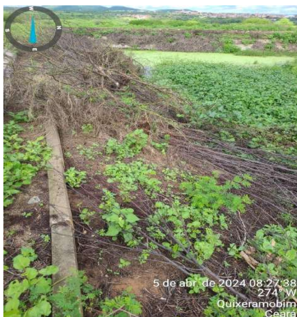
Foto 9 - ETE: vegetação no interior da lagoa facultativa e nos taludes.
