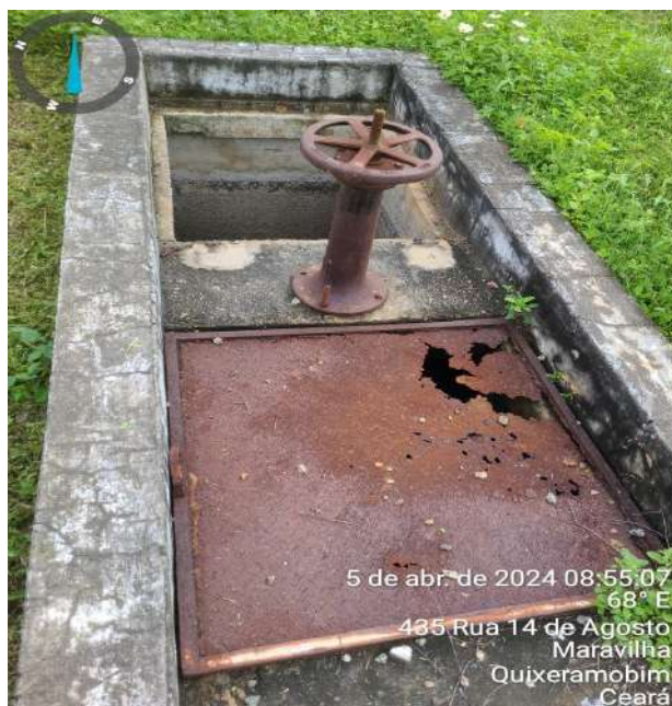
Foto 3 - EEE: poço com ausência de tampas e tampa oxidada.
