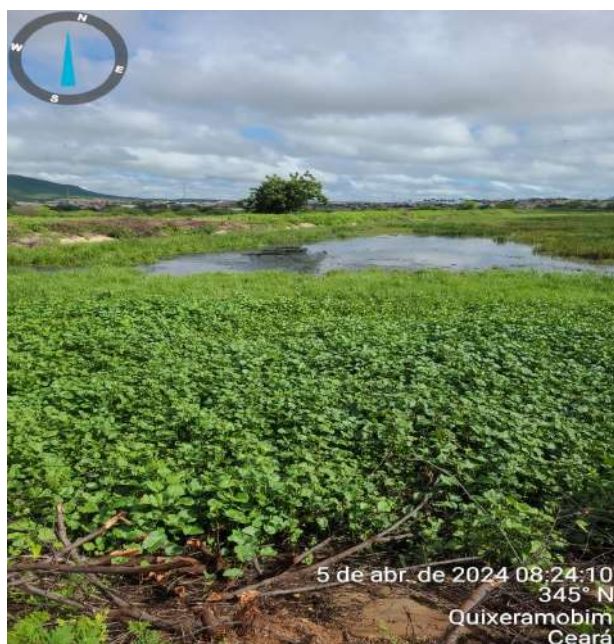
Foto 7 - ETE: vegetação no interior da lagoa facultativa e nos taludes.
