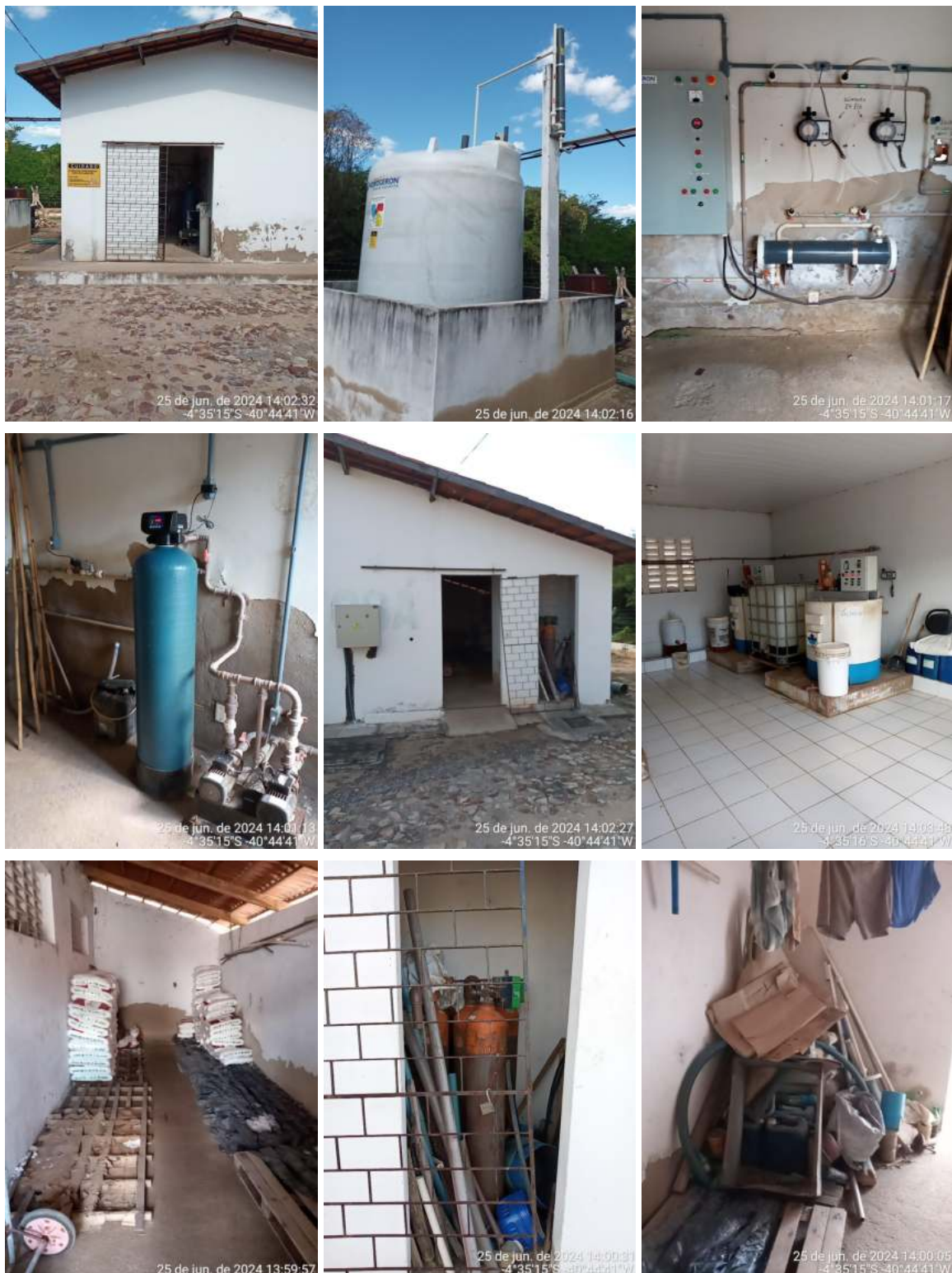
Figura 13. Casa de Química / Cloração / Almoxarifado
