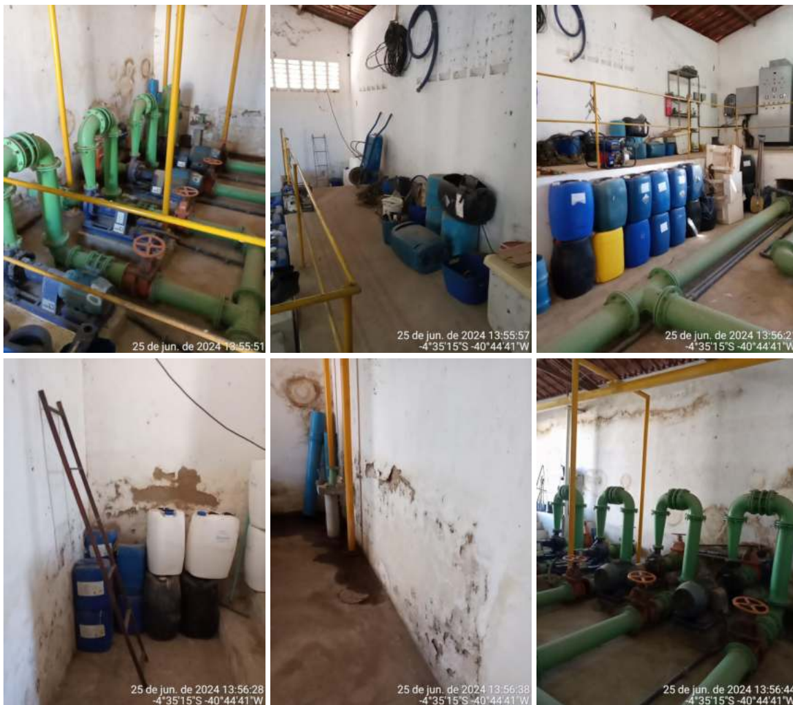
Figura 12. Casa de Bombas.
