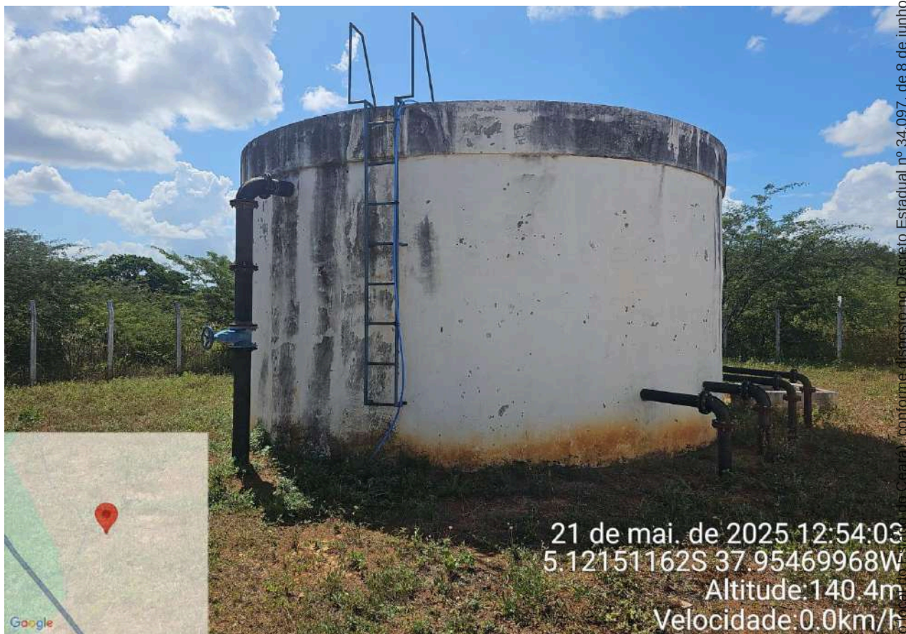
Foto 44 - Cercado do Meio: reservatório com pintura desgastada.
