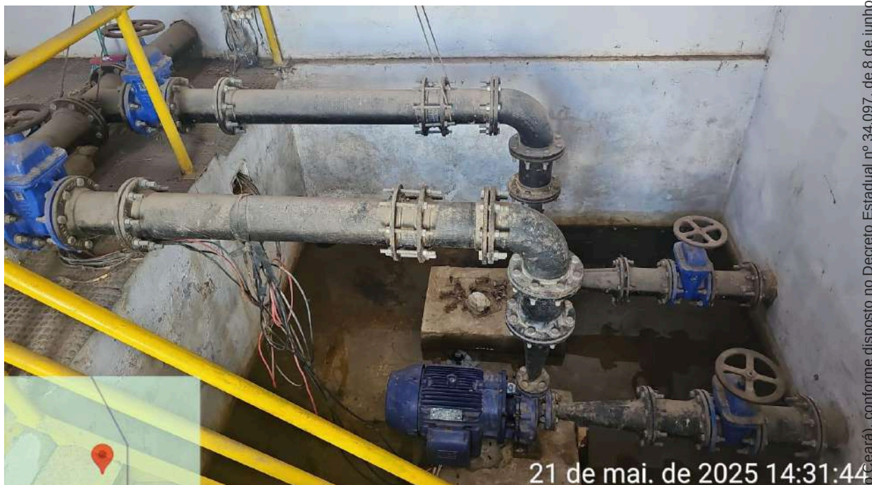
Foto 42 - EAEB Bonsucesso: tubulação com sujeira, acúmulo de água nas bombas, fiação exposta.
