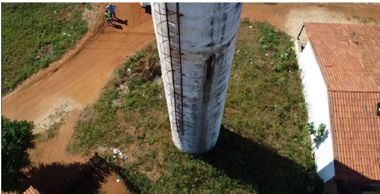
Foto 64 - Reservatório Carnaúbas: escada e guarda-corpo oxidados, pintura desgastada.
