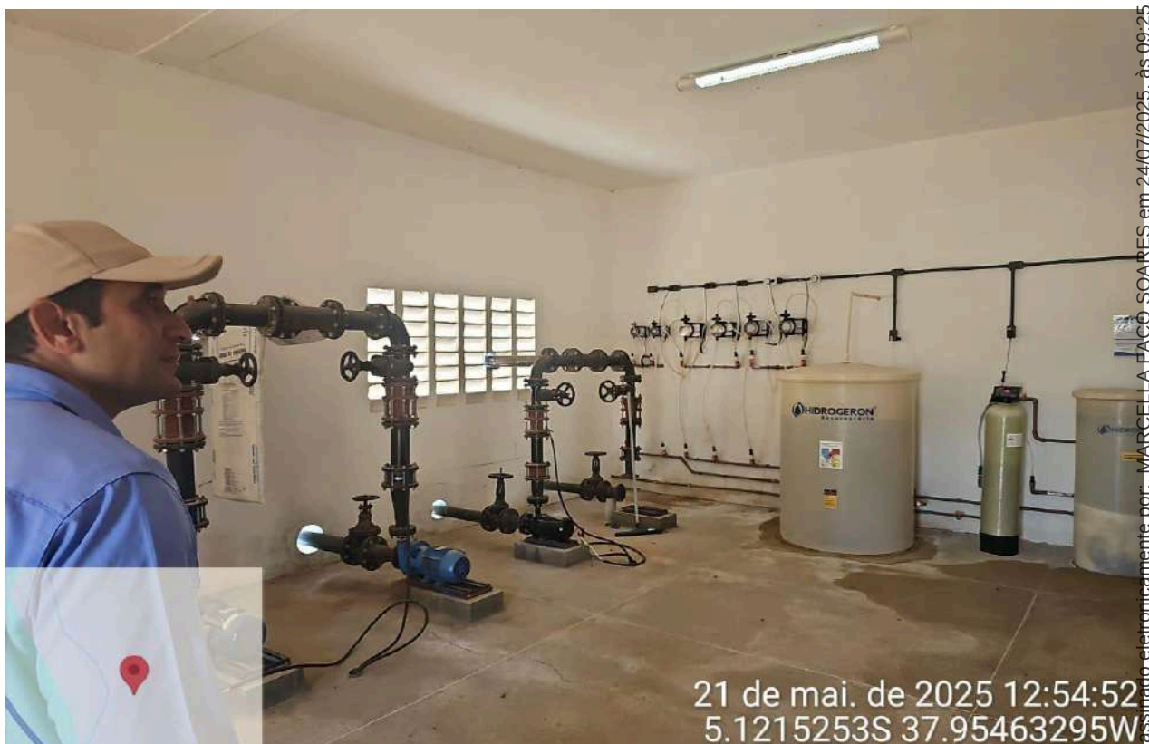
Foto 45 - Cercado do Meio: fiação sem eletrodutos, manchas no piso indicando vazamentos.
