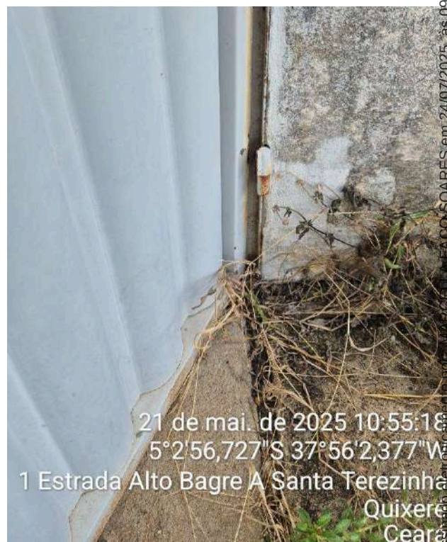
Foto 49 - Recalque Santa Terezinha: porta com dobradiça quebrada e oxidada.
