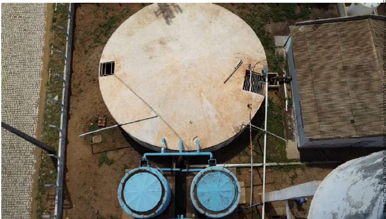
Foto 30 - ETA Lagoinha: reservatório sem tampas.
