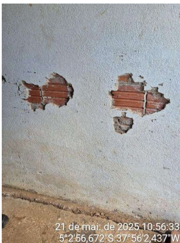
Foto 52 - Recalque Santa Terezinha: parede com tijolo exposto e rachaduras.
