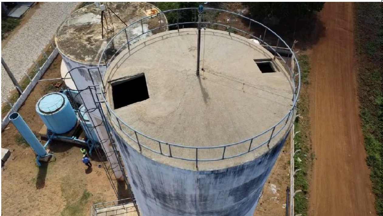
Foto 29 - ETA Lagoinha: reservatório sem tampas.
