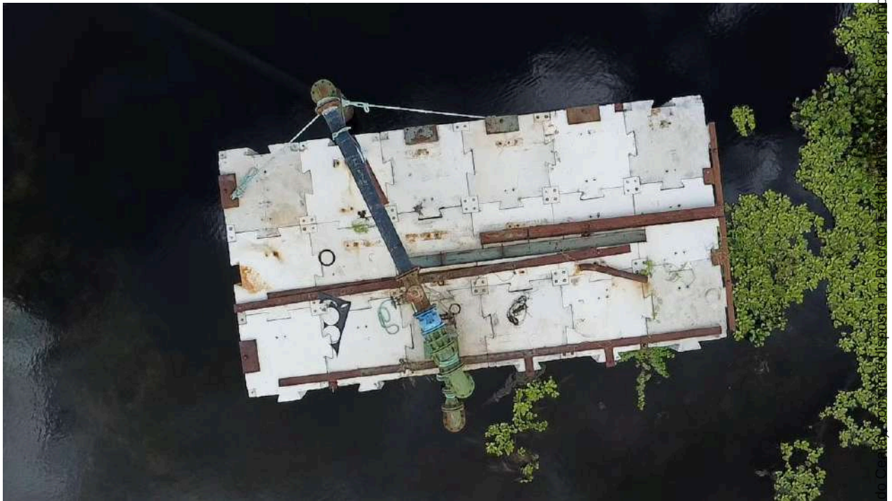
Foto 27 - Captação Quixeré: estrutura e tubulação oxidada.
