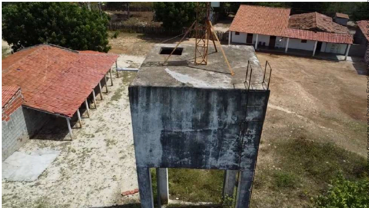
Foto 69 - Reservatório de Vertente: reservatório sem tampa, pintura desgastada, escada oxidada e sem guarda-corpo.
