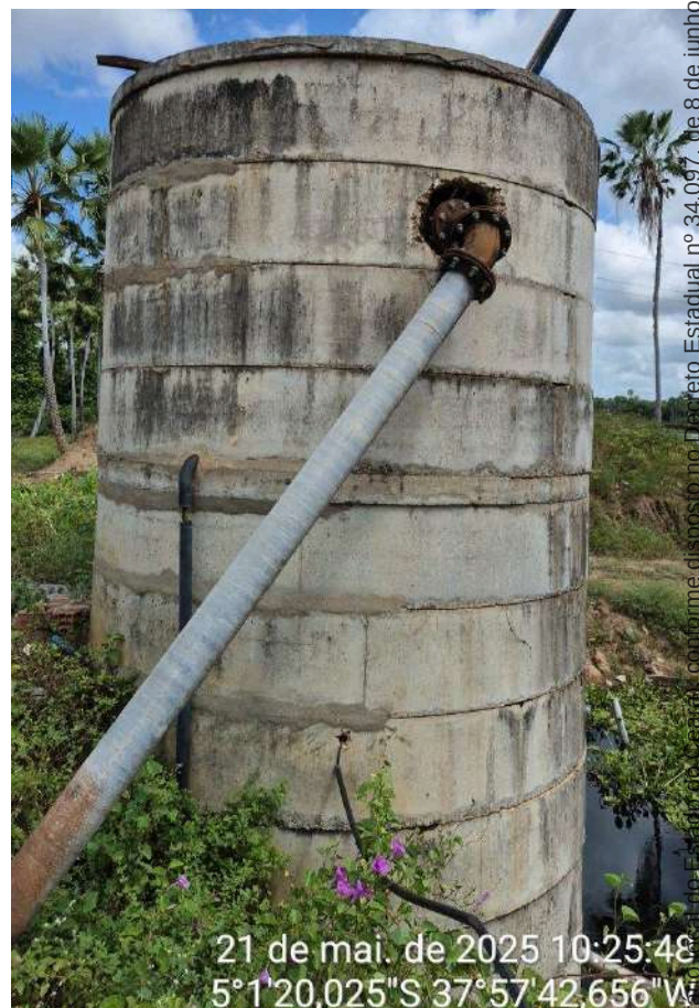
Foto 24 - Captação Água Fria: tubulação oxidada.
