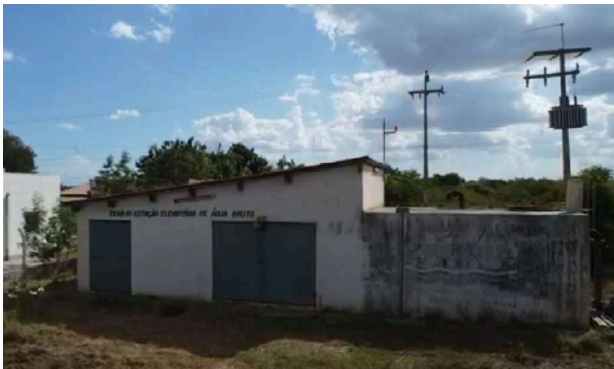
Foto 5 - Estação Elevatória de Água Bruta.
