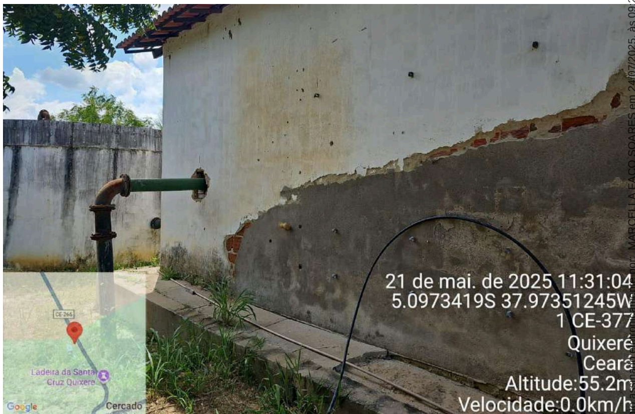
Foto 85 - Reservatório Santa Cruz: parede inadequada.
