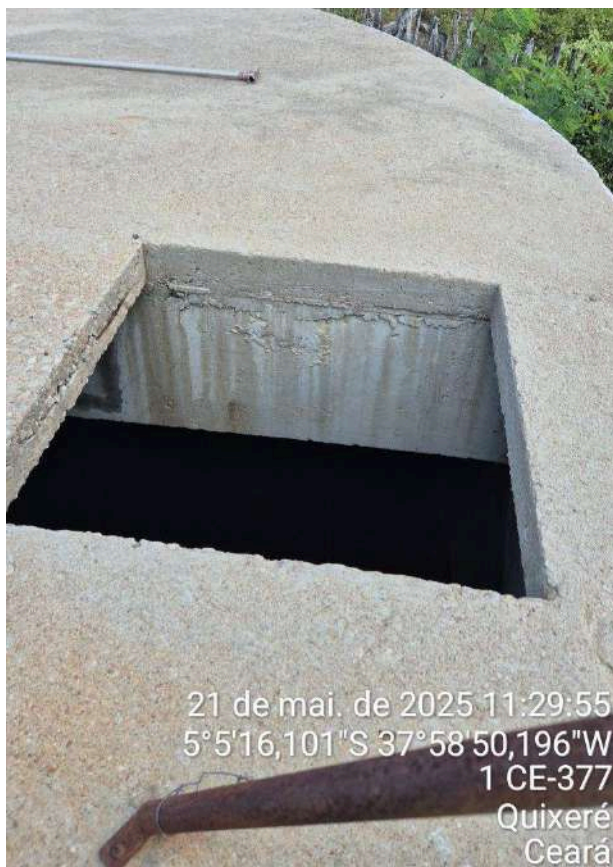
Foto 79 - Reservatório Santa Cruz: reservatório sem tampa.
