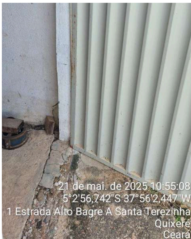
Foto 48 - Recalque Santa Terezinha: piso com rachaduras.
