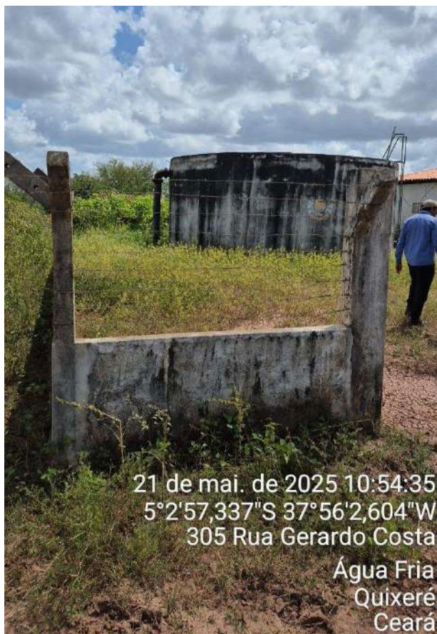
Foto 46 - Recalque Santa Terezinha: reservatório com pintura desgastada.
