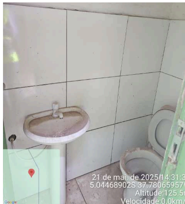
Foto 37 - EAEB Bonsucesso: banheiro com sujeira.
