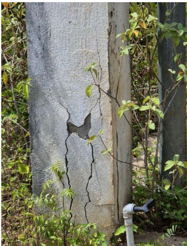
Foto 67 - Reservatório de Vertente: armadura exposta, rachaduras na estrutura.
