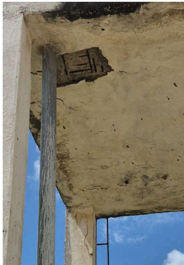
Foto 66 - Reservatório de Vertente: armadura exposta, rachaduras na estrutura.
