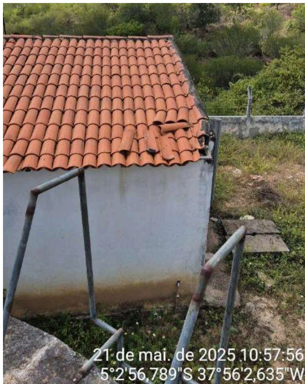
Foto 58 - Recalque Santa Terezinha: telhado com telhas soltas.
