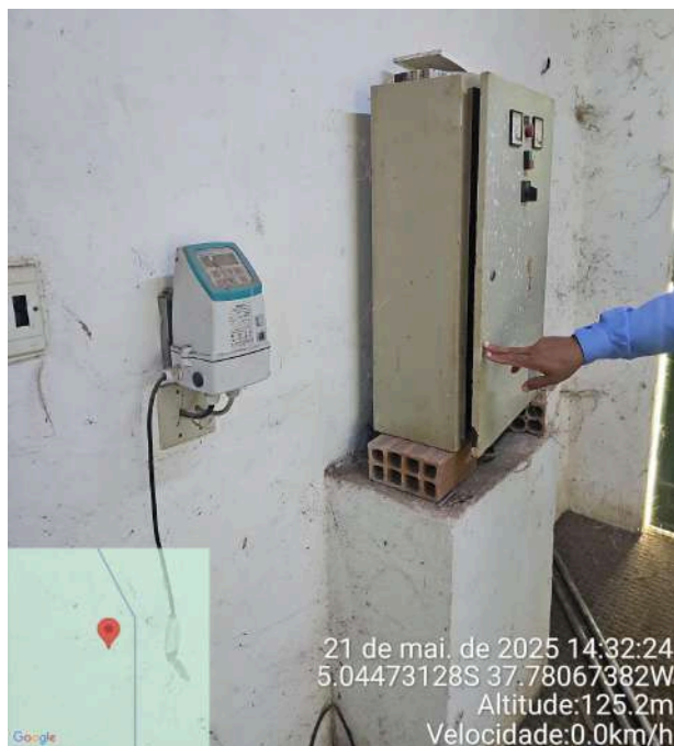
Foto 36 - EAEB Bonsucesso: quadro de controle e macromedidor sem funcionar.
