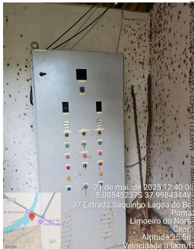
Foto 26 - Captação Quixeré: parede com sujeira.
