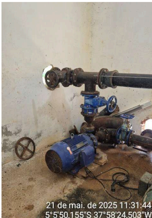
Foto 83 - Reservatório Santa Cruz: fiação da bomba sem eletrodutos.
