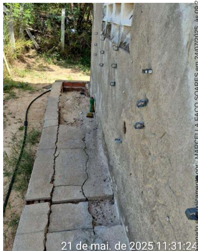
Foto 82 - Reservatório Santa Cruz: piso quebrado.
