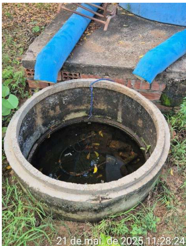
Foto 77 - Reservatório Santa Cruz: acúmulo de água e de material inadequado.
