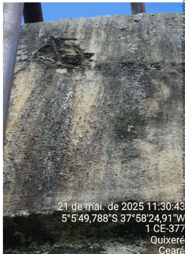
Foto 80 - Reservatório Santa Cruz: reservatório com armadura exposta.
