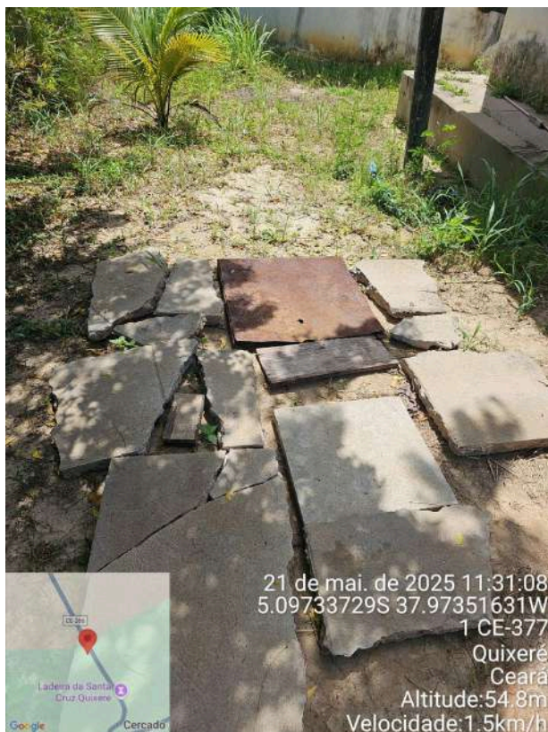
Foto 75 - Reservatório Santa Cruz: piso com material inadequado, risco de queda.
