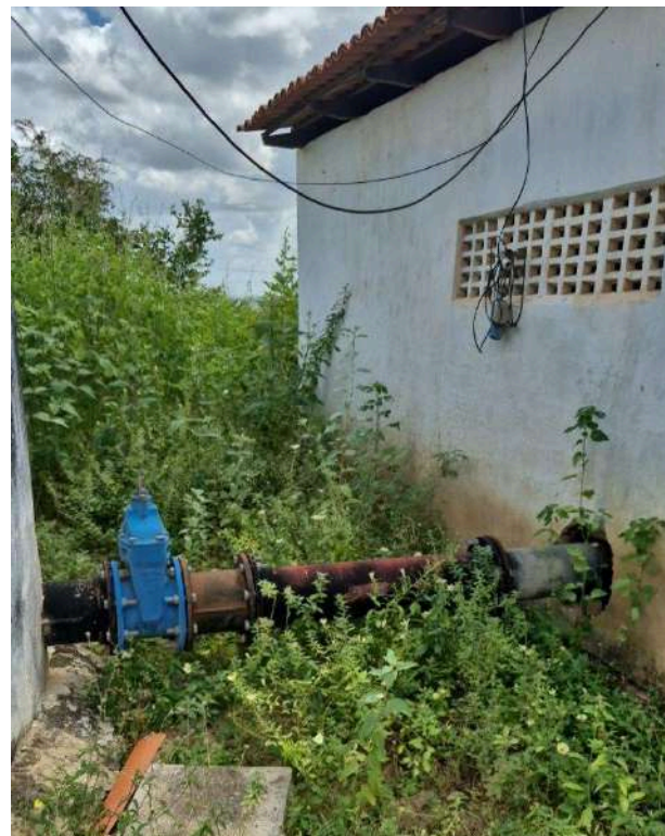
Foto 59 - Recalque Santa Terezinha: fiação solta, vegetação elevada e tubulação oxidada.
