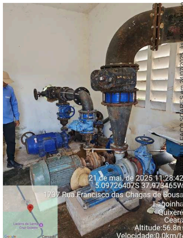
Foto 74 - Reservatório Santa Cruz: vazamento na bomba, tubulação oxidada.
