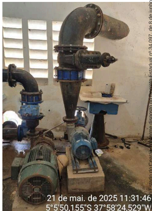
Foto 84 - Reservatório Santa Cruz: acúmulo de material em local inadequado.
