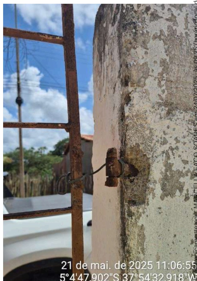
Foto 35 - ETA Lagoinha: portão oxidado e paredes desgastadas.
