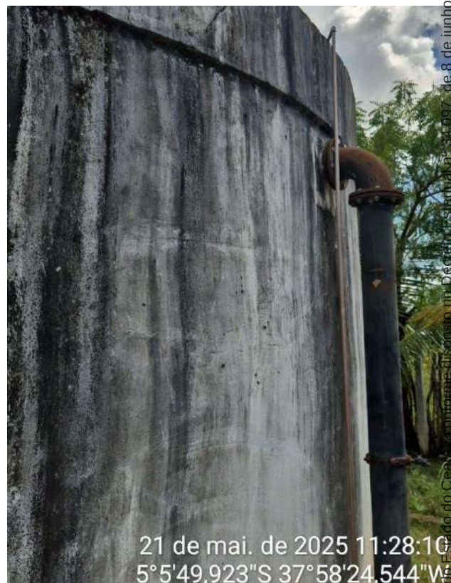
Foto 76 - Reservatório Santa Cruz: tubulação oxidada e pintura desgastada.
