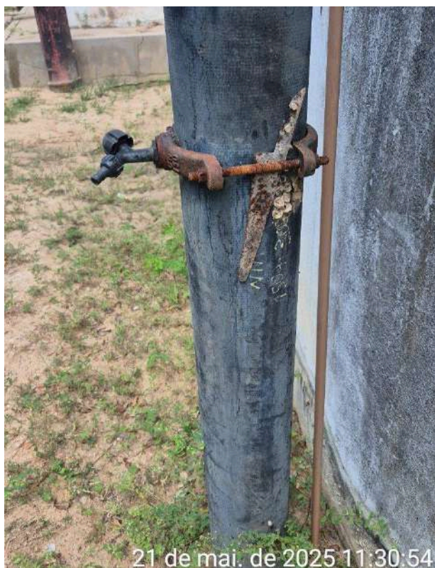
Foto 81 - Reservatório Santa Cruz: material perigoso e oxidado em local inadequado.
