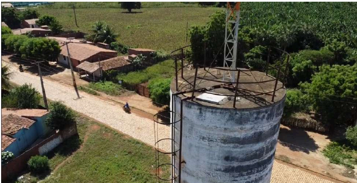
Foto 63 - Reservatório Carnaúbas: escada e guarda-corpo oxidados, pintura desgastada.
