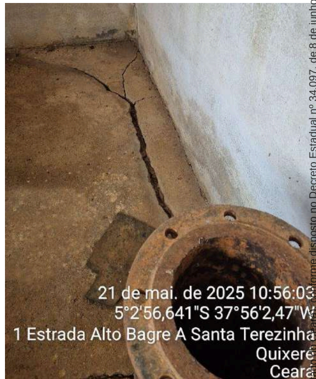
Foto 55 - Recalque Santa Terezinha: piso com rachaduras.
