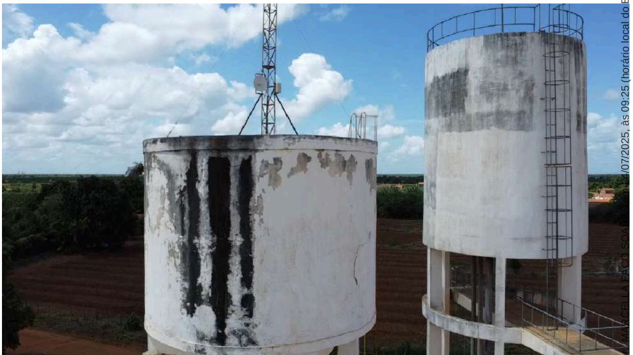
Foto 28 - ETA Lagoinha: pintura dos reservatórios desgastada.
