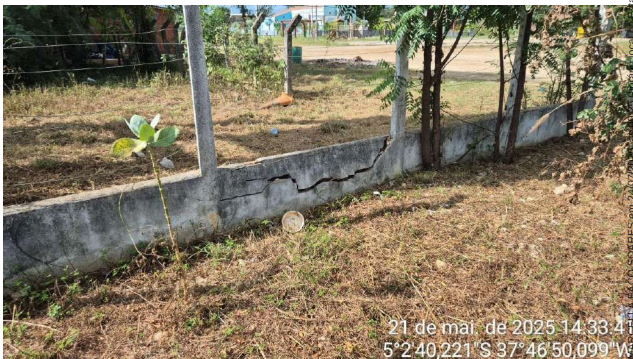
Foto 41 - EAEB Bonsucesso: cercamento quebrado.
