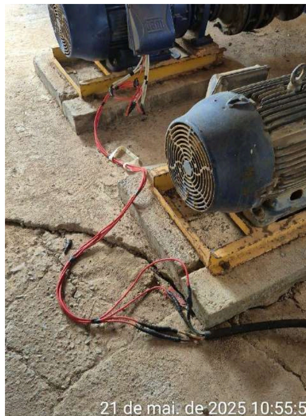
Foto 51 - Recalque Santa Terezinha: fiação da bomba sem eletrodutos.
