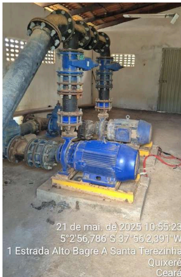
Foto 10 - Recalque Santa Terezinha.
