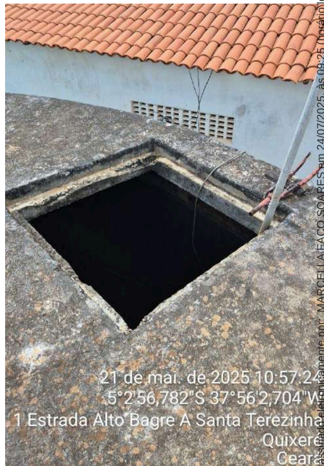
Foto 57 - Recalque Santa Terezinha: reservatório sem tampas.
