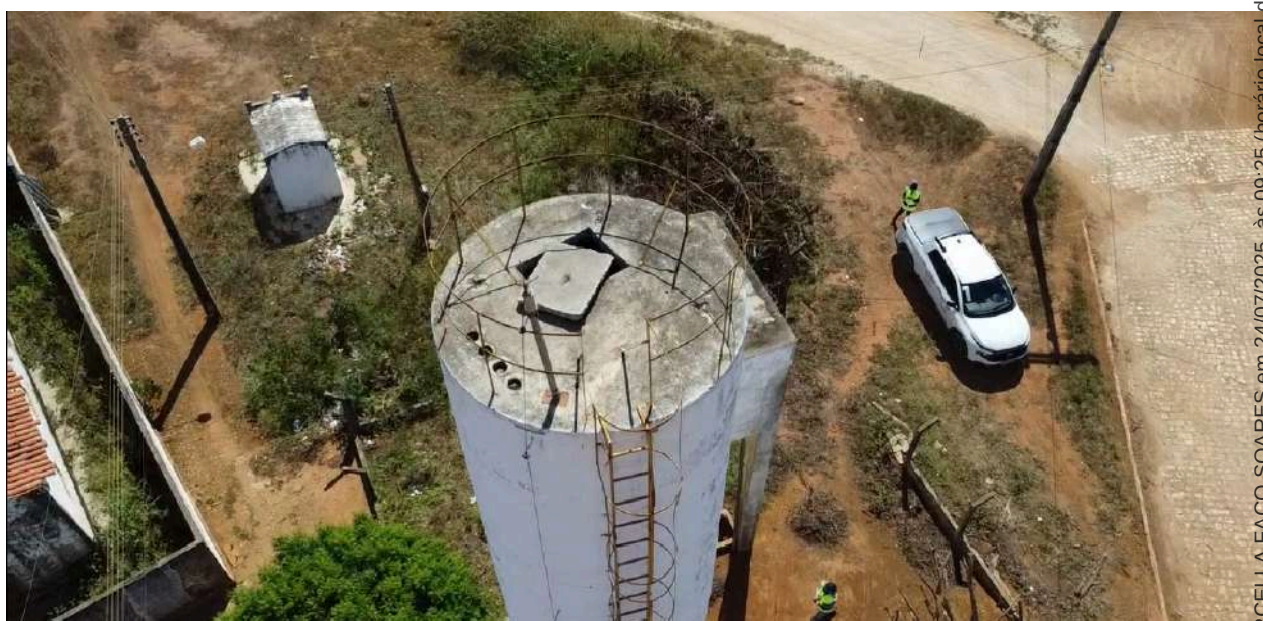
Foto 70 - Reservatório Macacos: tampa deslocada, guarda-corpo e escada oxidados.
