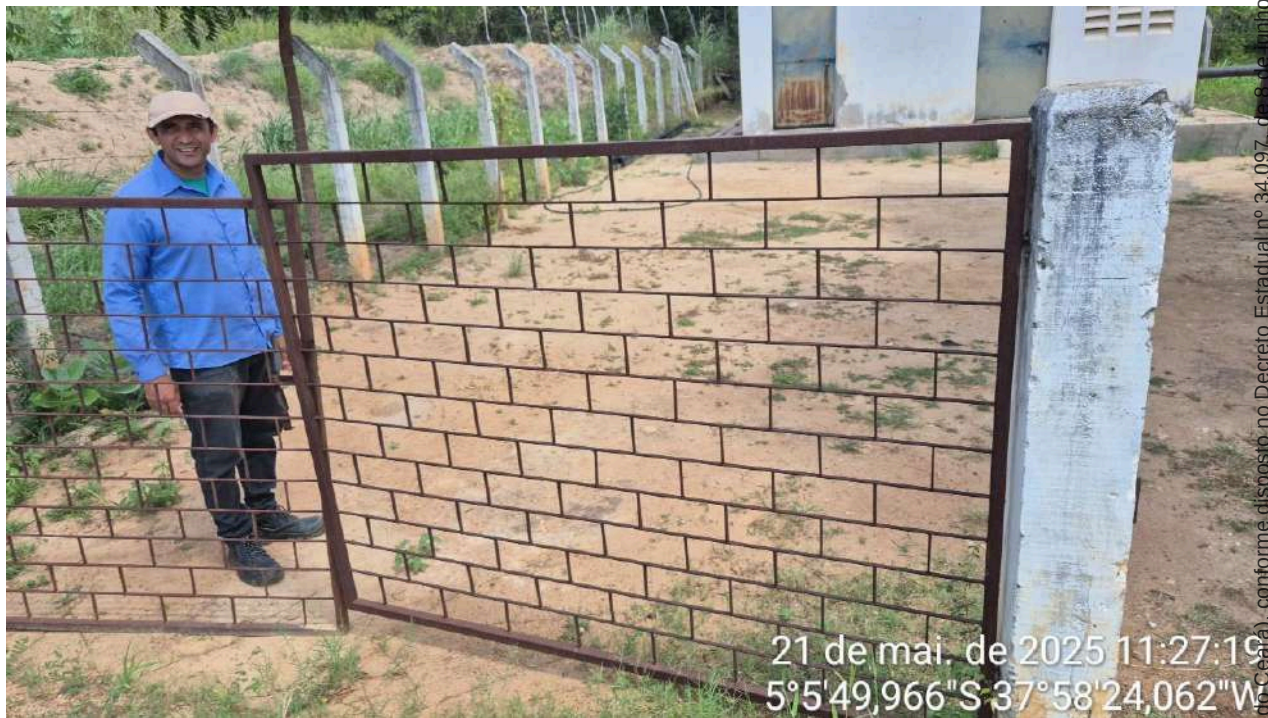
Foto 86 - Reservatório Santa Cruz: portão de acesso oxidado.
