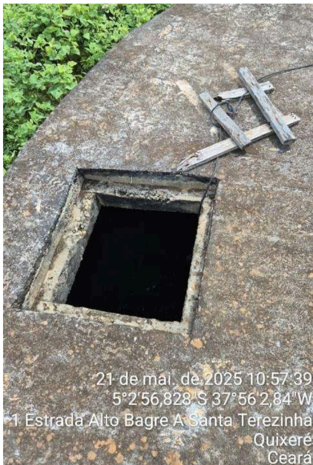
Foto 56 - Recalque Santa Terezinha: reservatório sem tampas.
