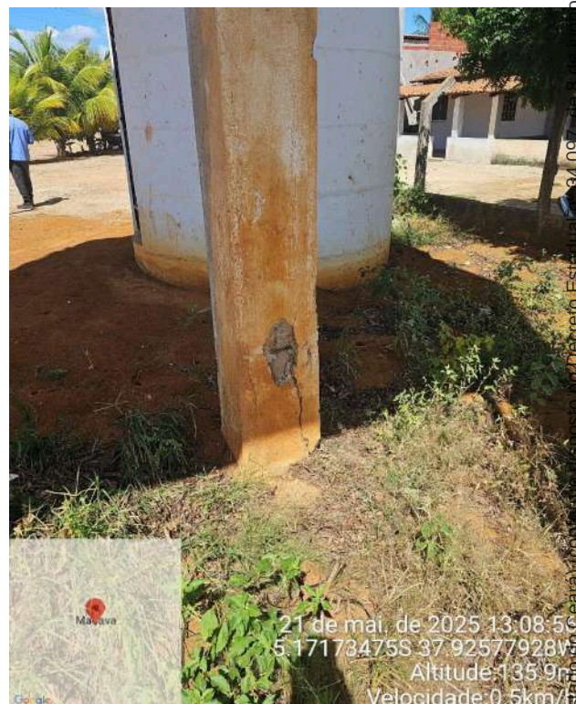
Foto 72 - Reservatório Macacos: armadura exposta e rachaduras no pilar.
