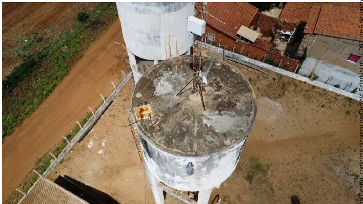
Foto 31 - ETA Lagoinha: reservatório com tampa oxidada e estrutura desgastada.
