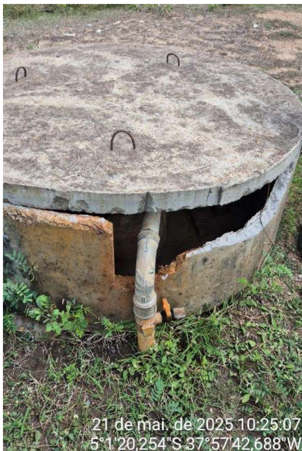
Foto 23 - Captação Água Fria: estrutura quebrada.
