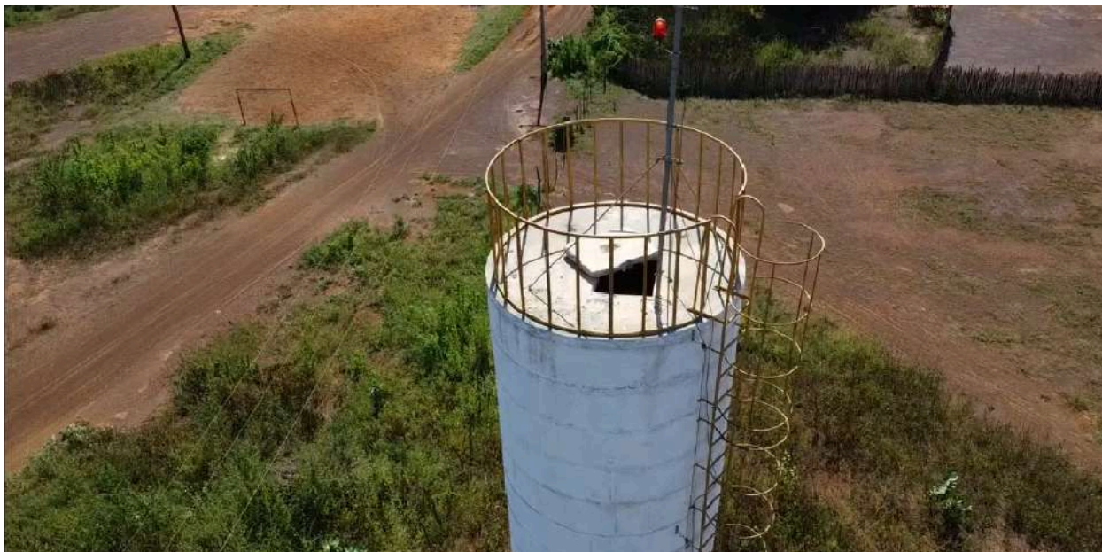
Foto 61 - Reservatório Carnaúbas: tampa deslocada.
