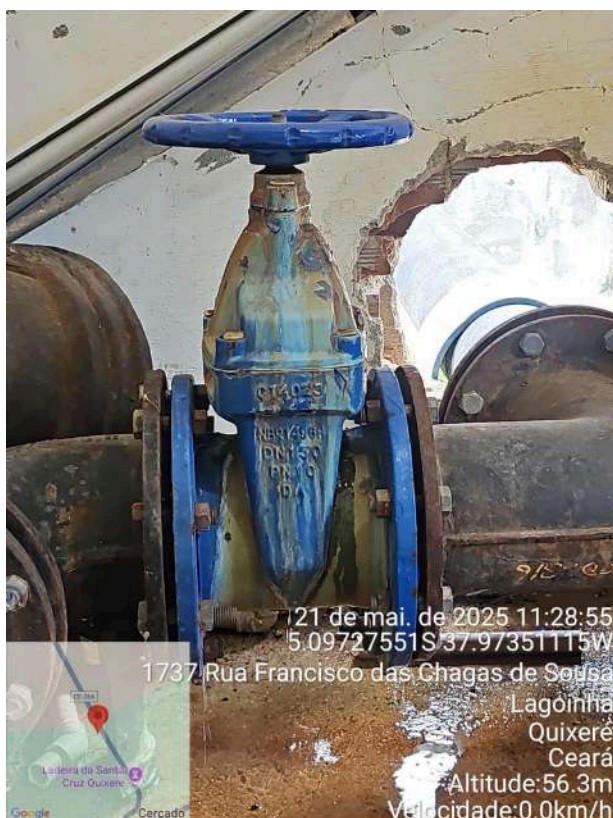
Foto 73 - Reservatório Santa Cruz: vazamento no registro parede com abertura inadequada.
