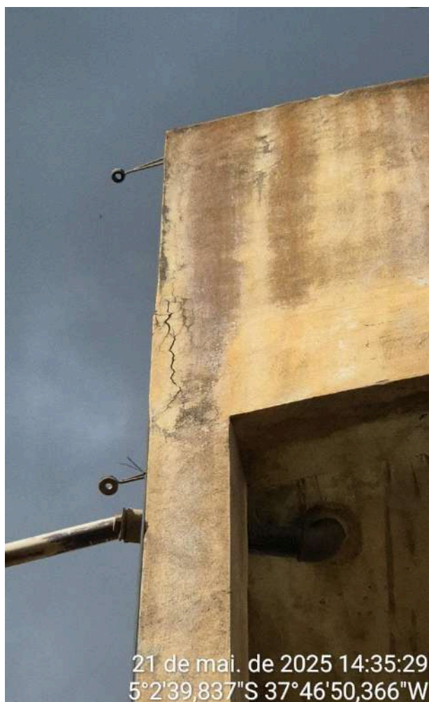
Foto 38 - EAEB Bonsucesso: pintura desgastada.
