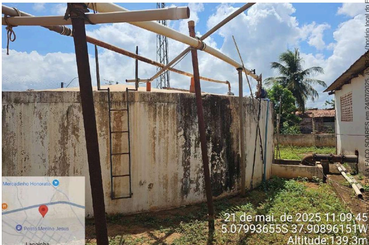
Foto 32 - ETA Lagoinha: pintura dos reservatórios desgastada.
