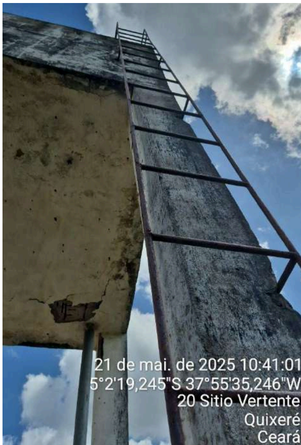
Foto 65 - Reservatório de Vertente: escada sem guarda-corpo, armadura exposta.
