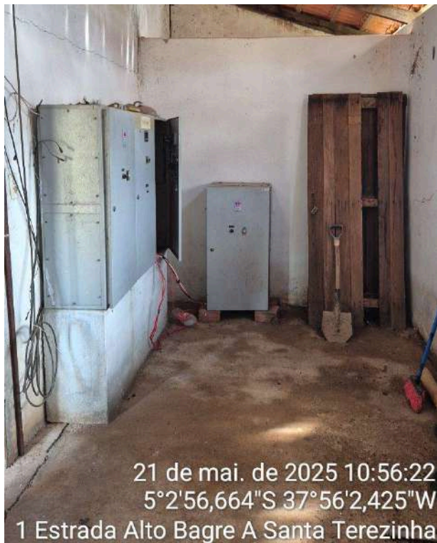
Foto 54 - Recalque Santa Terezinha: fiação saindo do painel inadequadamente, painel sem suporte.
