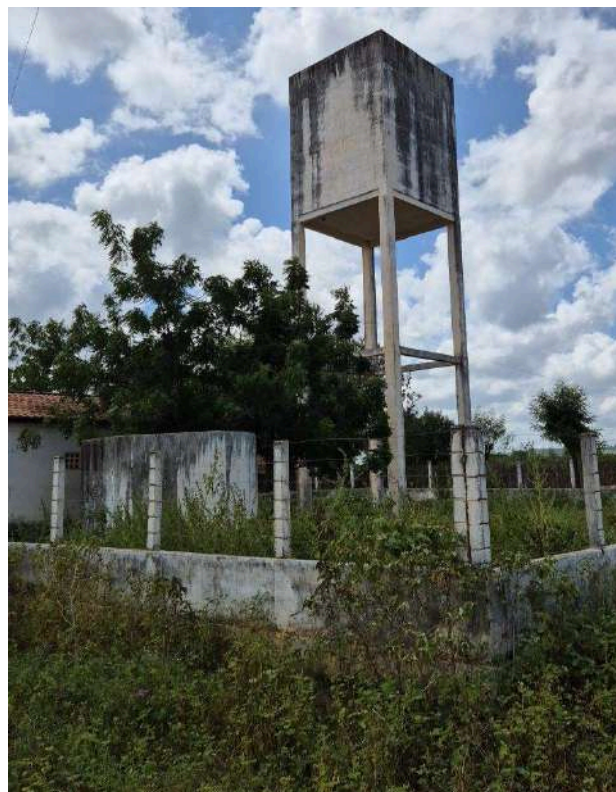
Foto 68 - Reservatório de Vertente: vegetação alta, pintura desgastada.
