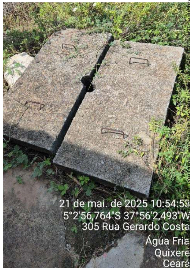
Foto 47 - Recalque Santa Terezinha: tampa deslocada, com vegetação ao redor.
