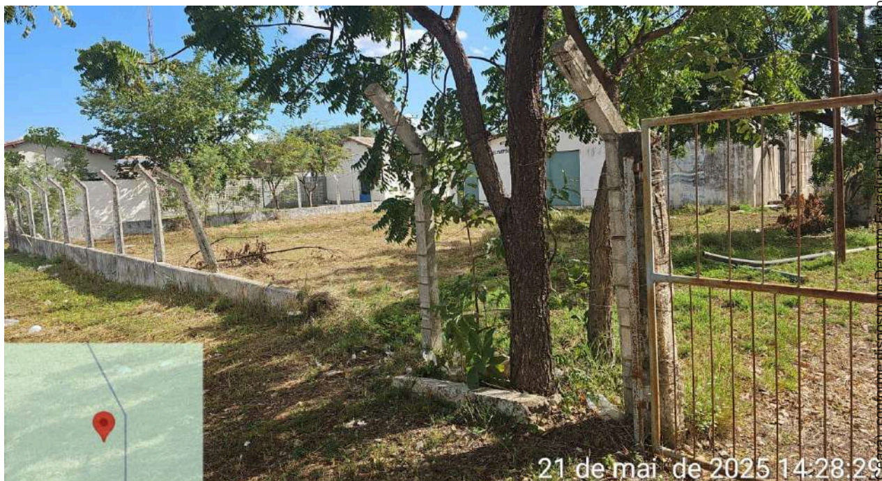
Foto 40 - EAEB Bonsucesso: área sem fechamento e sem sinalização
