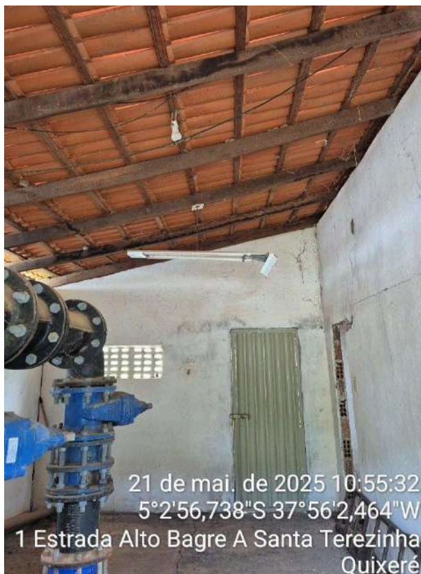
Foto 50 - Recalque Santa Terezinha: lâmpada descolada do teto e presa pela fiação.
