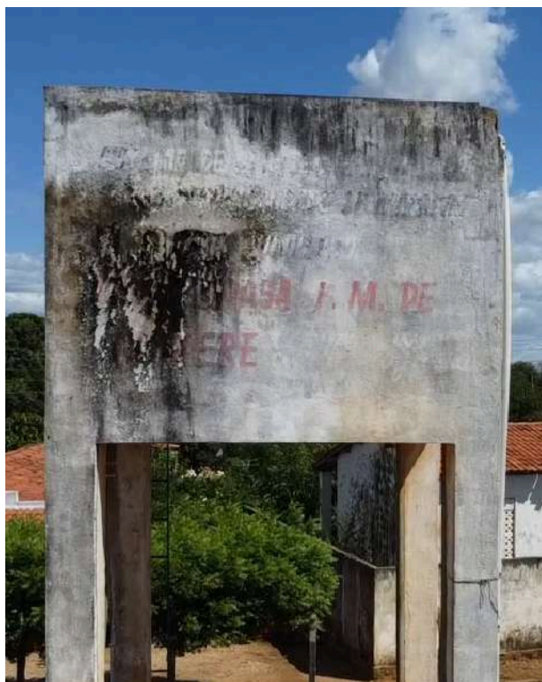
Foto 71 - Reservatório Macacos: pintura e identificação desgastada.
