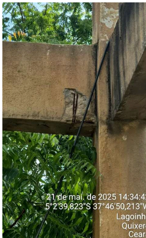
Foto 39 - EAEB Bonsucesso: armadura exposta.
