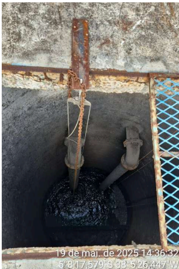
Foto 121 - Haste de sustentação oxidada.
