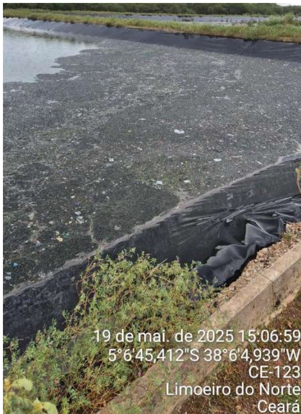
Foto 105 - Acúmulo de sujidades.
