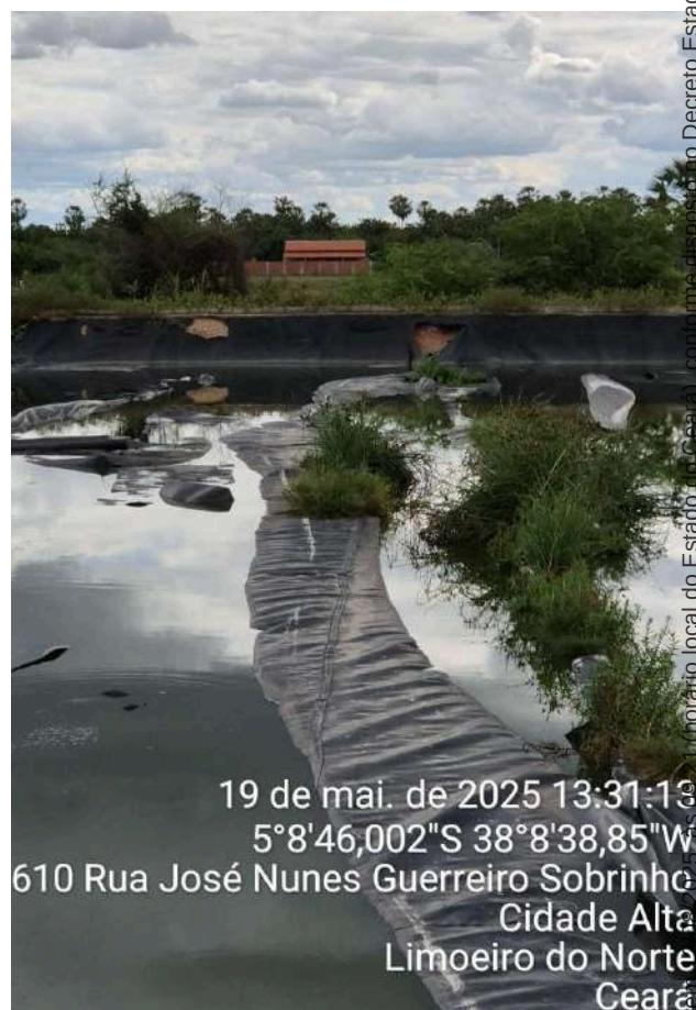
Foto 110 - Manta colocada de forma inadequada.
