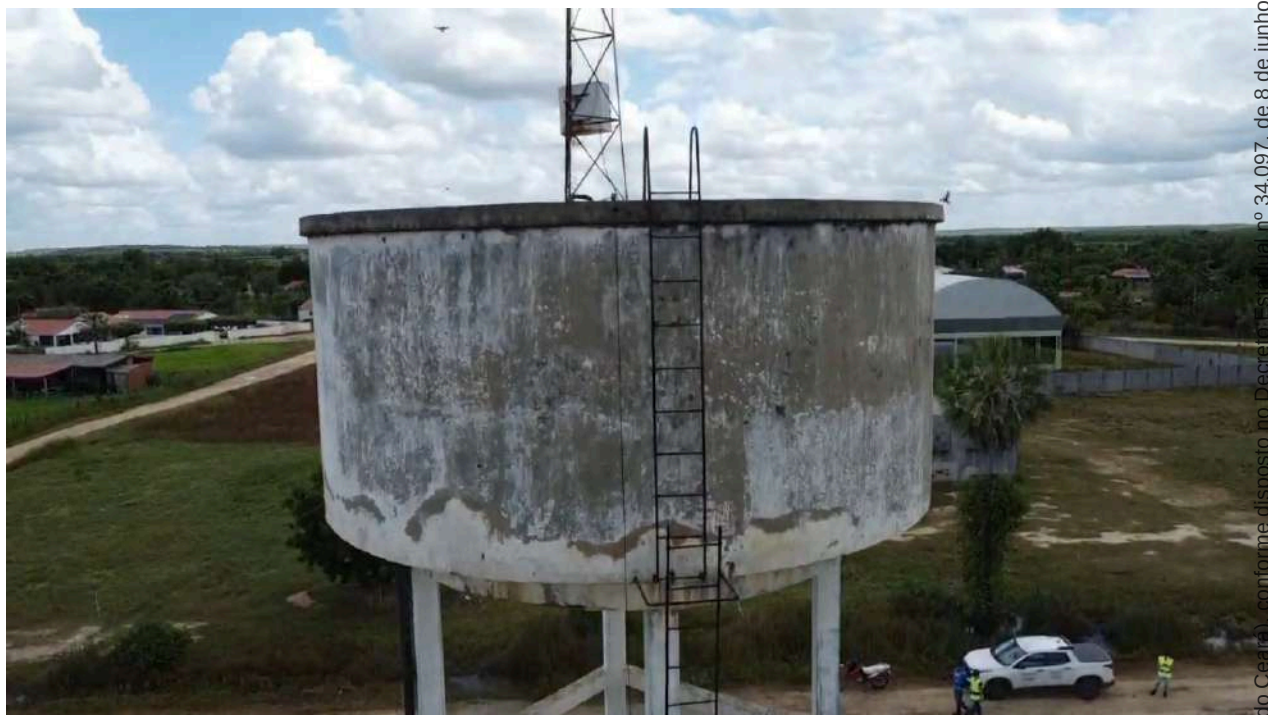
Foto 68 - Escada oxidada e inadequada, sem guarda-corpo.
