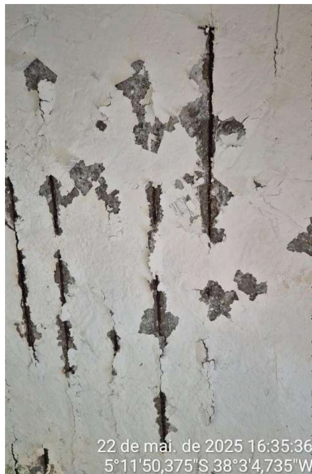
Foto 63 - Teto das casas de bomba com armadura expostas e pintura desgastada.
