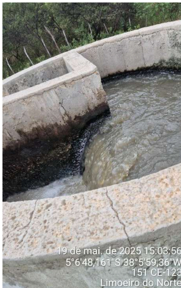
Foto 27 - Entrada efluente ETE.
