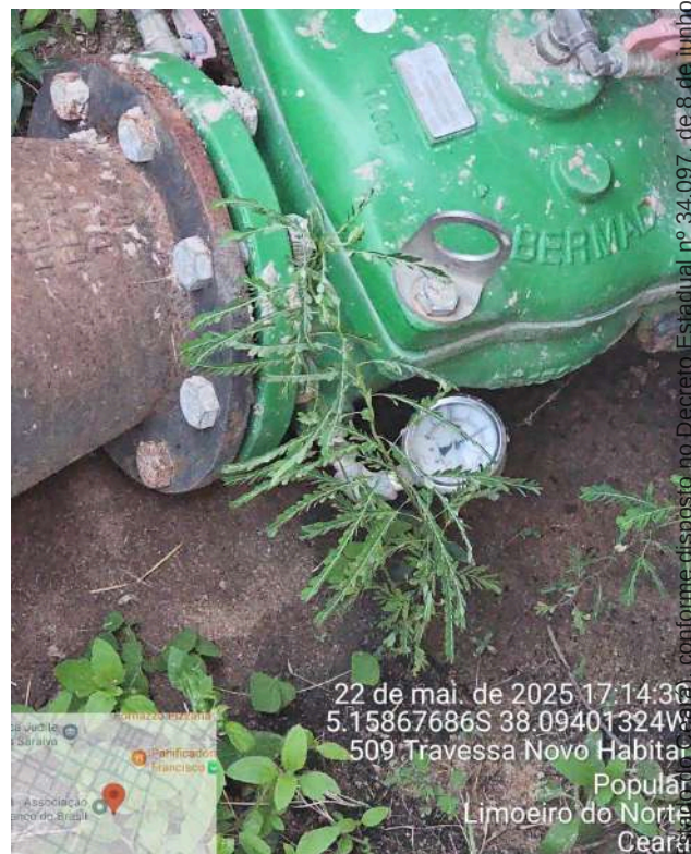
Foto 79 - ACÚMULO DE VEGETAÇÃO NA TUBULAÇÃO.
