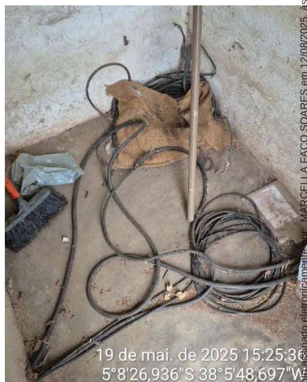
Foto 138 - Fiação exposta sem eletrodutos.
