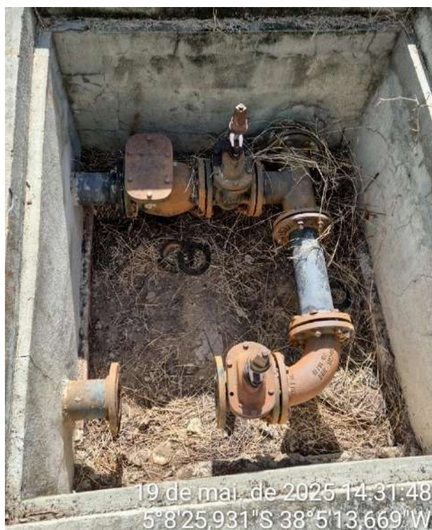
Foto 117 - Tubulação sem bomba e oxidada.
