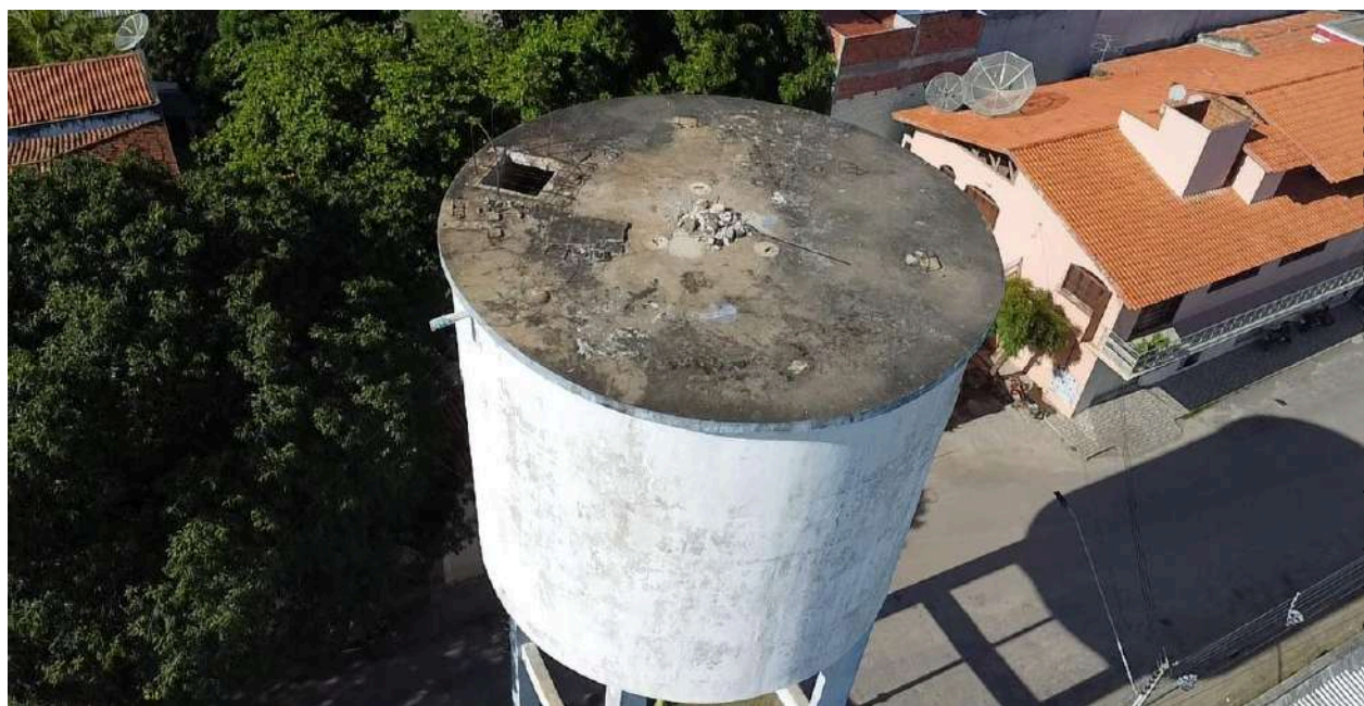
Foto 82 - Pintura desgastada e reservatório sem tampa.
