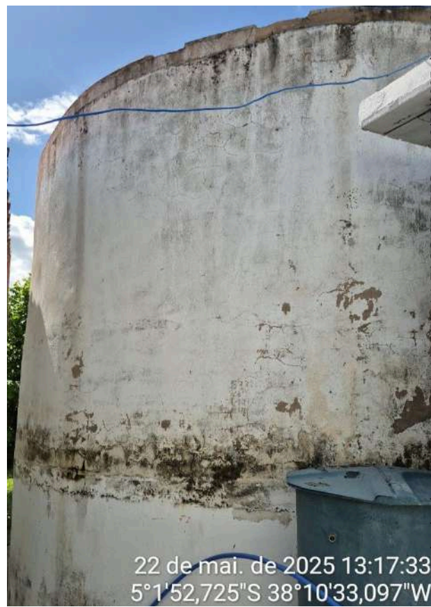
Foto 55 - Pintura do reservatório desgastada.
