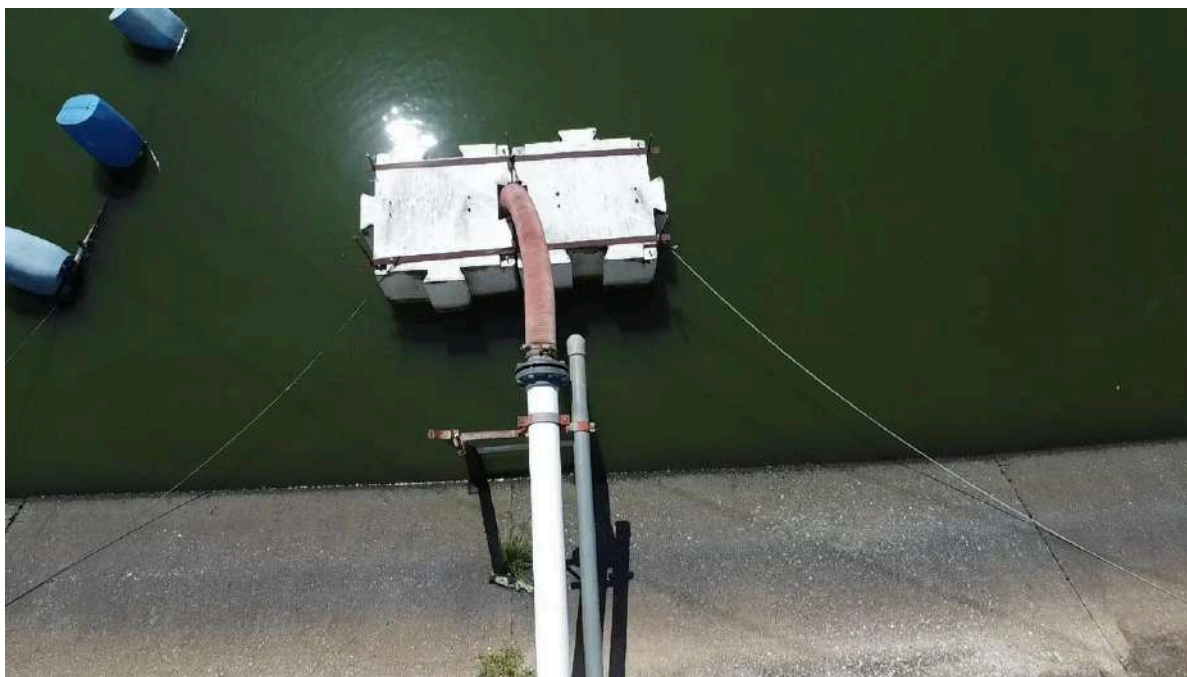
Foto 1 - Captação superficial no Rio Jaguaribe - ETA Manoel Conrado.
