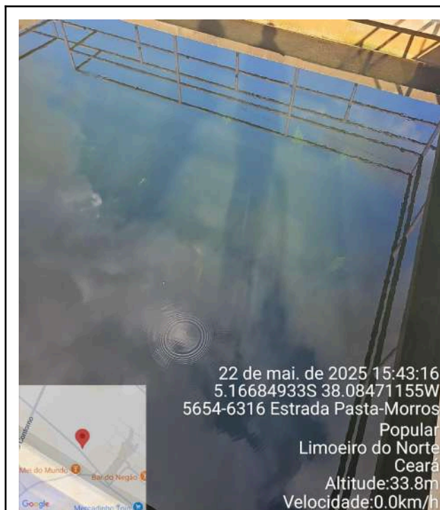
Foto 45 - Placa do decantador caída.
