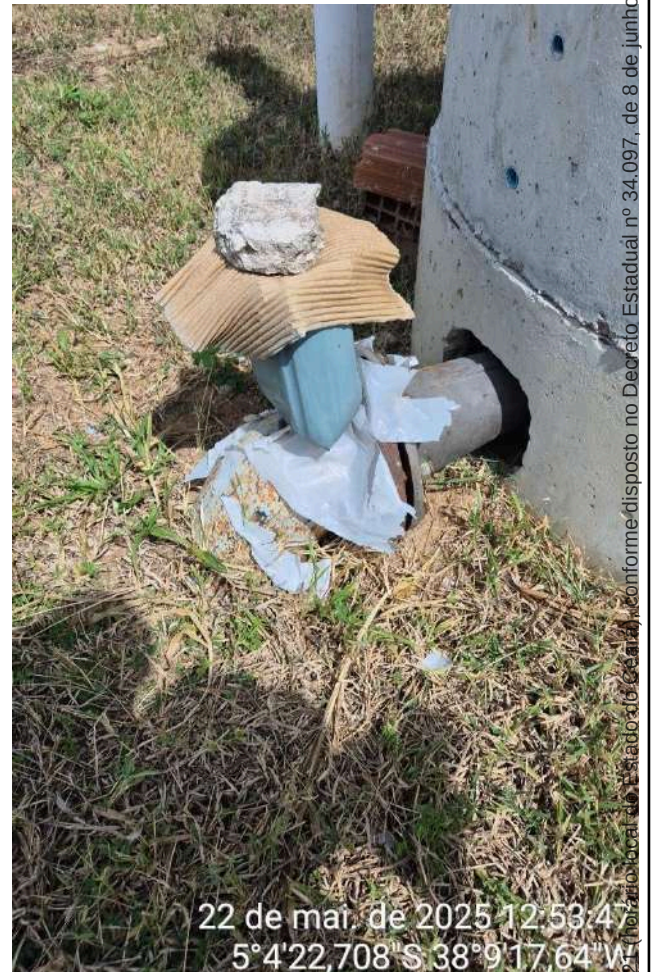
Foto 104 - Vedação com material inapropriado.
