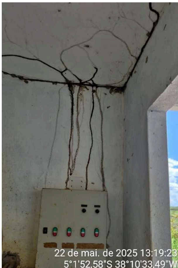
Foto 56 - Parede e teto com cupim.
