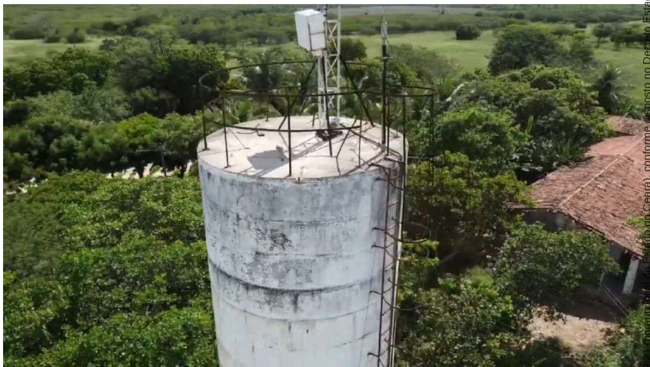
Foto 99 - Pintura desgastada e escada oxidada.
