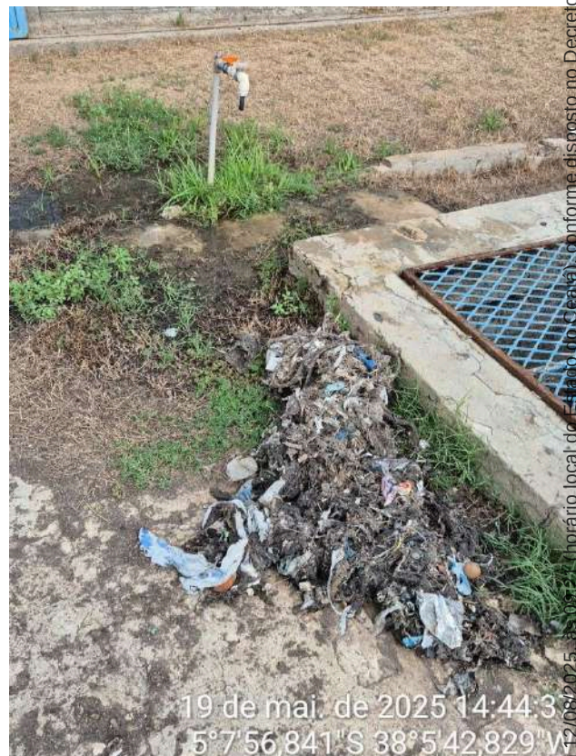
Foto 126 - Acúmulo de sujeira.
