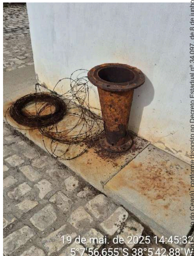
Foto 128 - Material oxidado em local inadequado.
