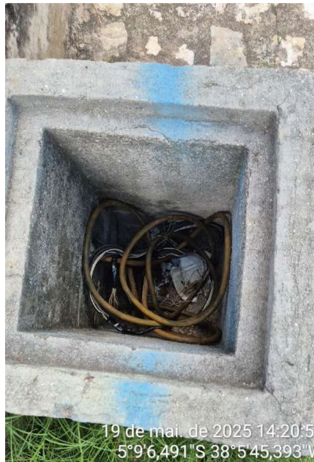
Foto 132 - Material em local inadequado.
