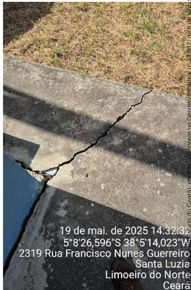
Foto 116 - Rachaduras no piso.
