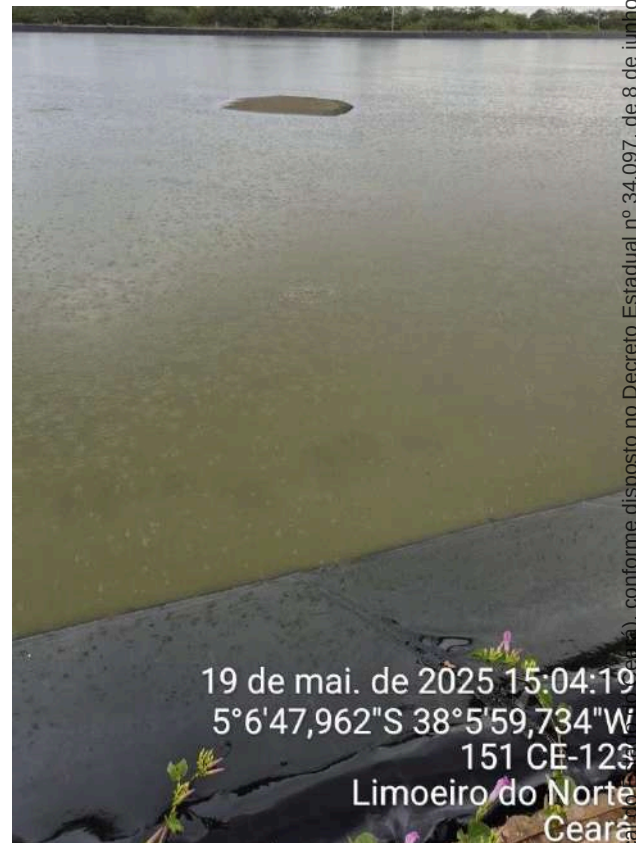
Foto 106 - Rasgo na manta em diversos pontos.
