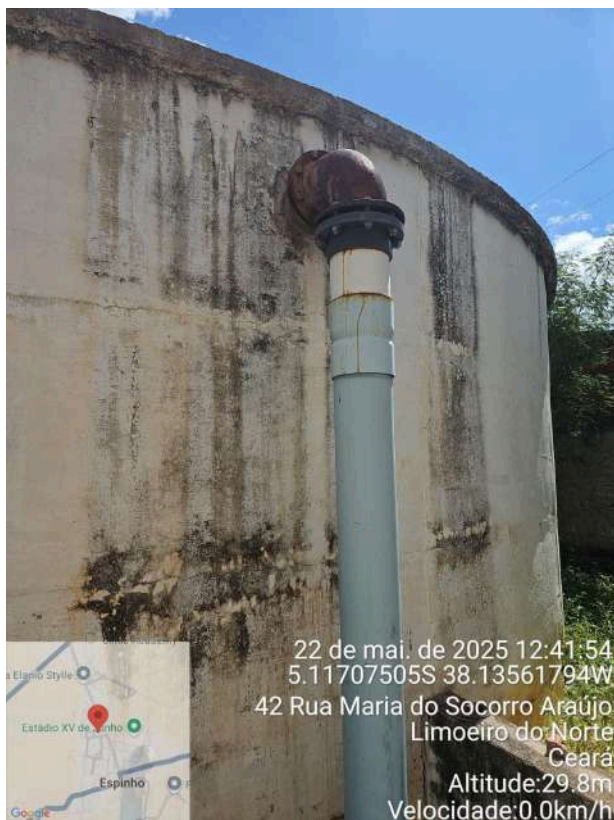
Foto 95 - Tubulação oxidada e parede do reservatório desgastada.
