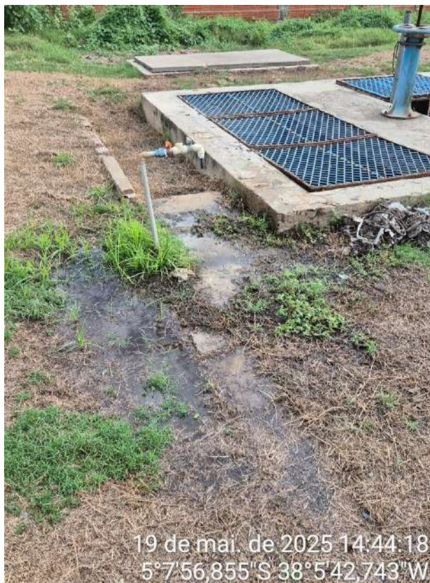
Foto 125 - Acúmulo de água da chuva.
