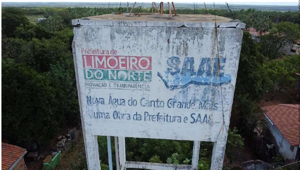
Foto 88 - Pintura desgastada e partes do reservatório quebradas.
