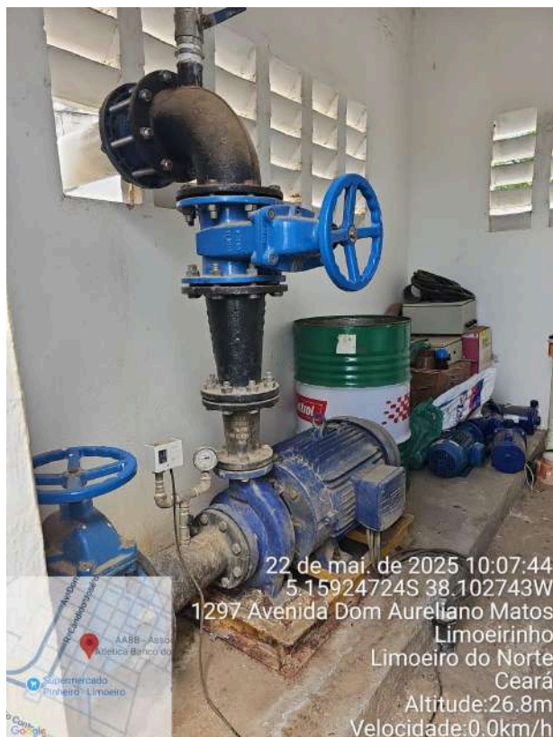
Foto 80 - Tubulação e bomba com sujeira.
