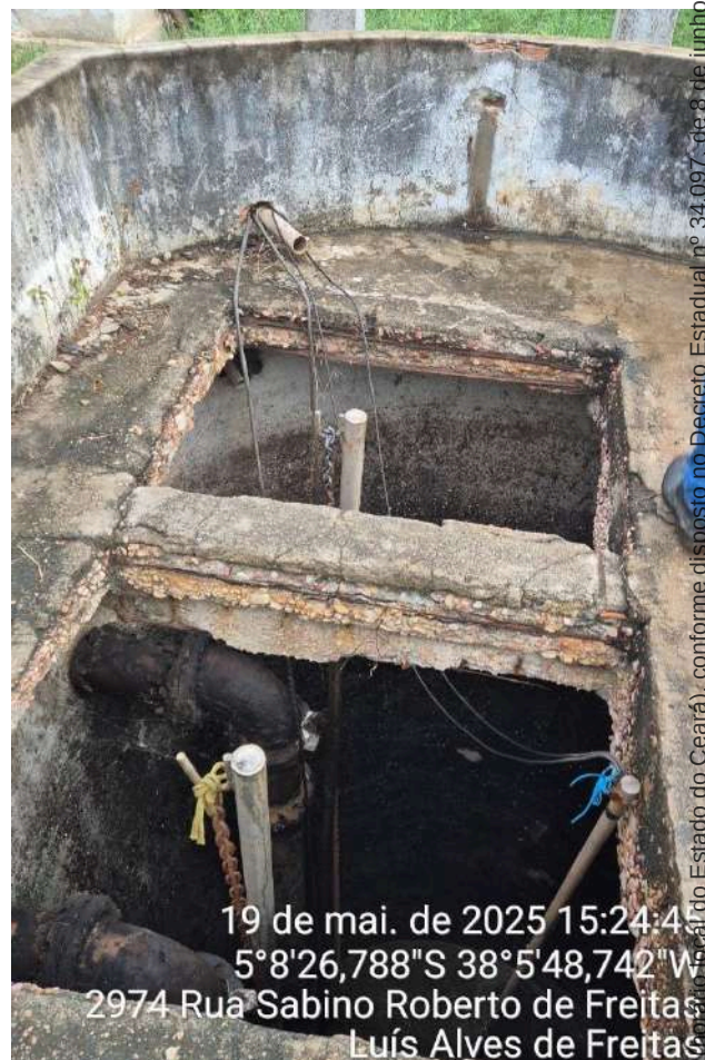
Foto 136 - Estrutura oxidada e com rachaduras.
