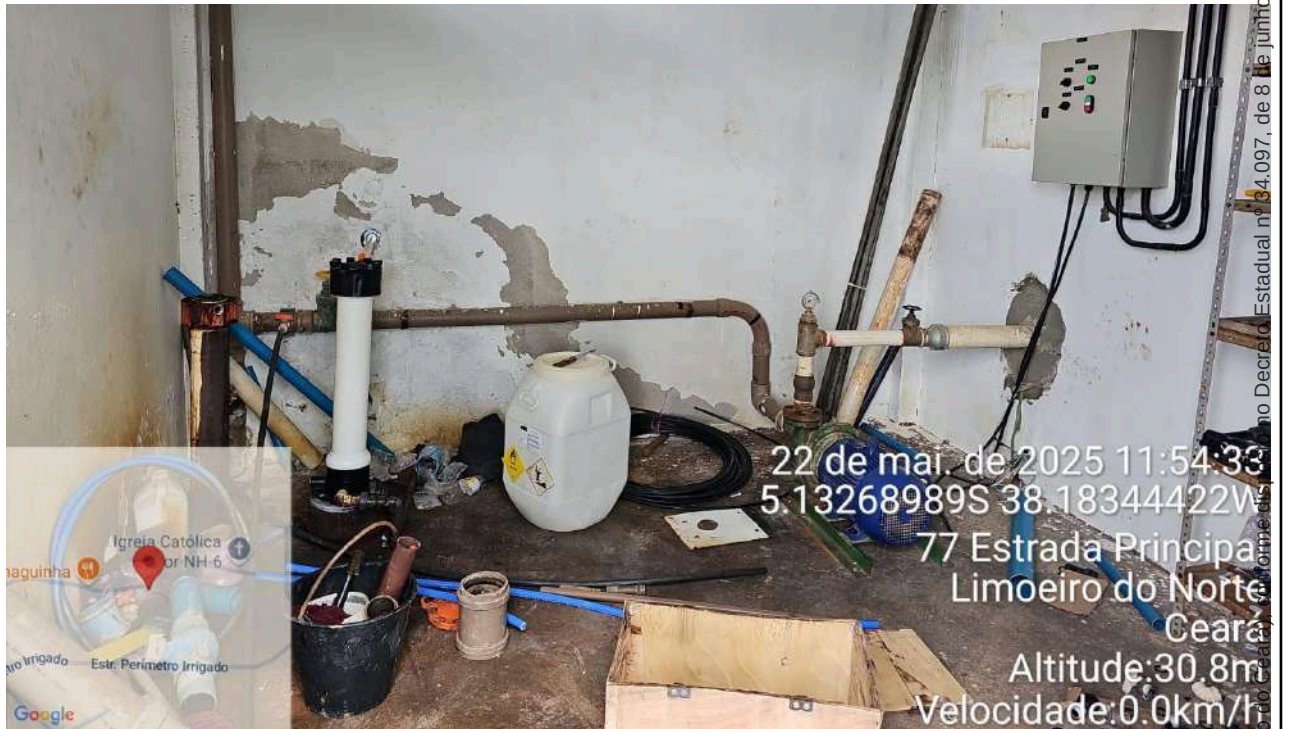
Foto 75 - Parede desgastada, acúmulo de material inadequado.
