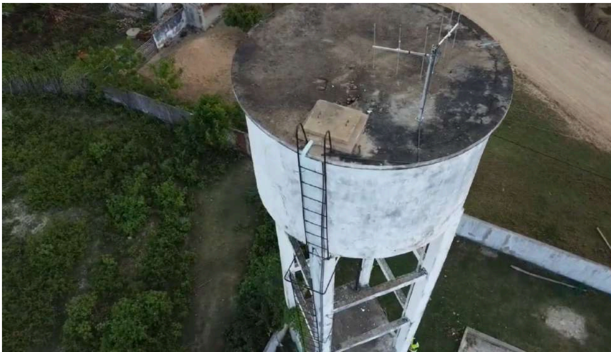
Foto 73 - Pintura desgastada, escada sem guarda-corpo.
