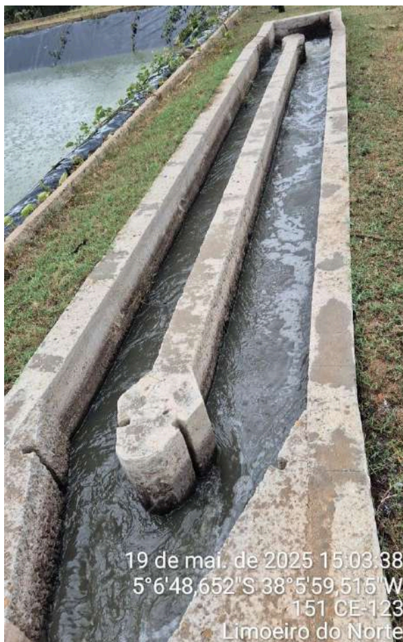
Foto 26 - Entrada efluente ETE.
