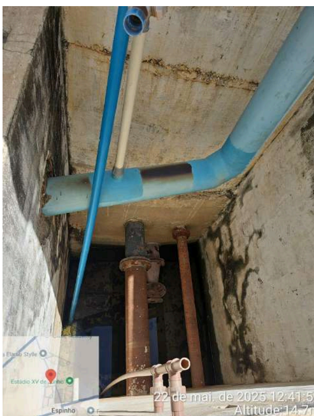
Foto 98 - Presença de lodo e acúmulo de água.
