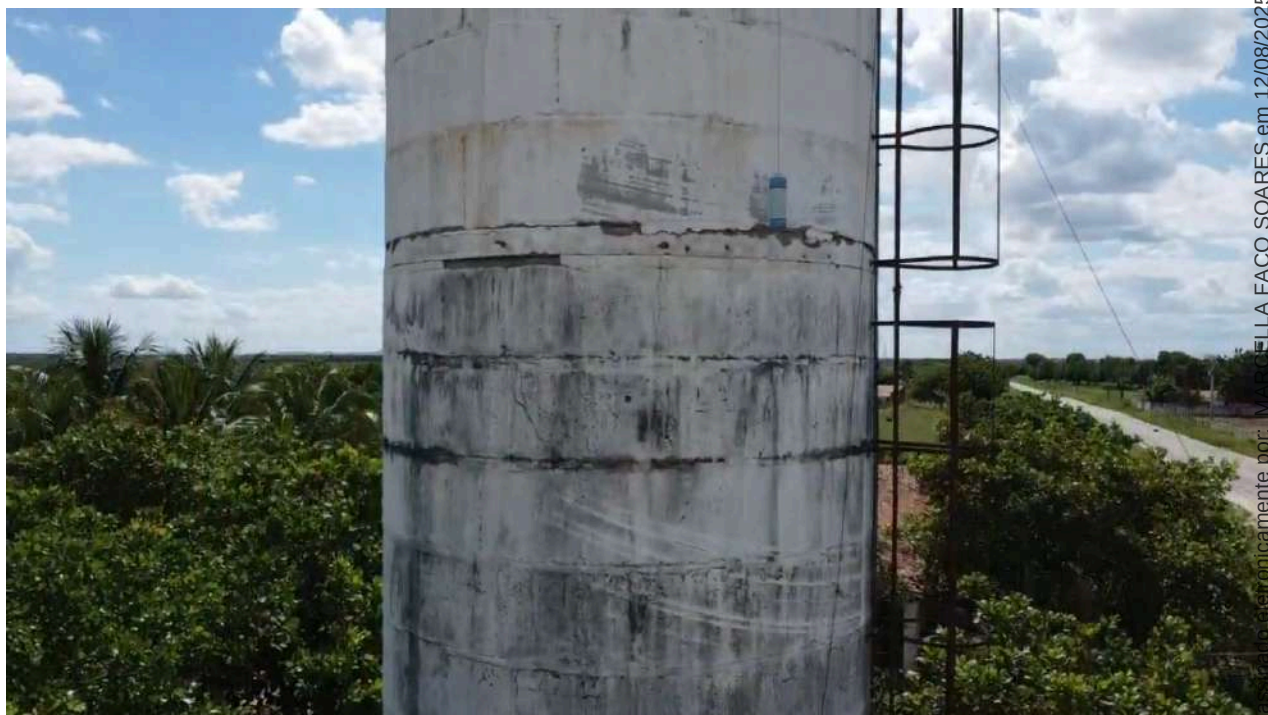
Foto 100 - Rachaduras no reservatório.
