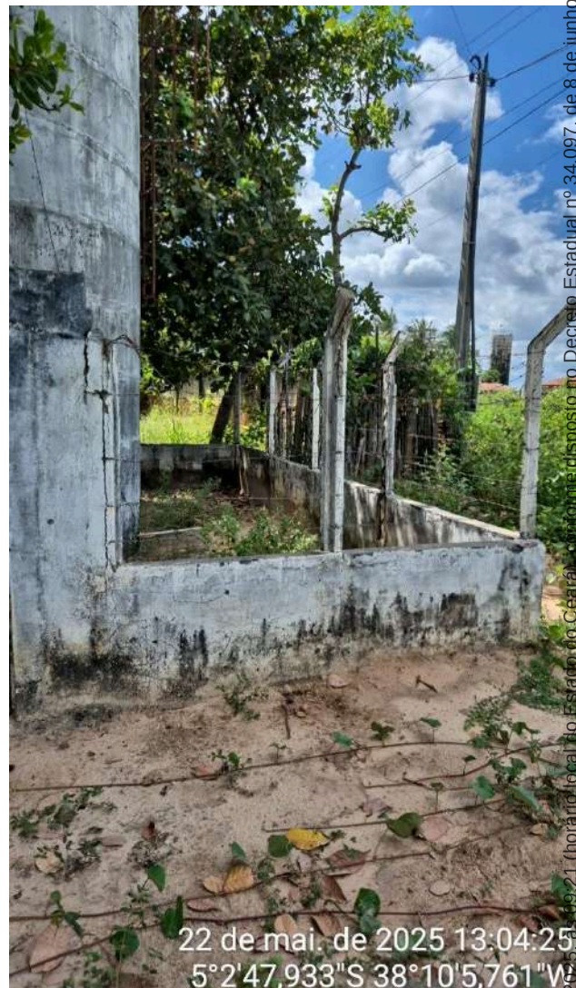
Foto 102 - Estrutura com armadura exposta.
