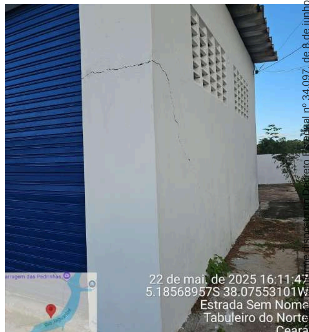
Foto 38 - Pareda com rachaduras.
