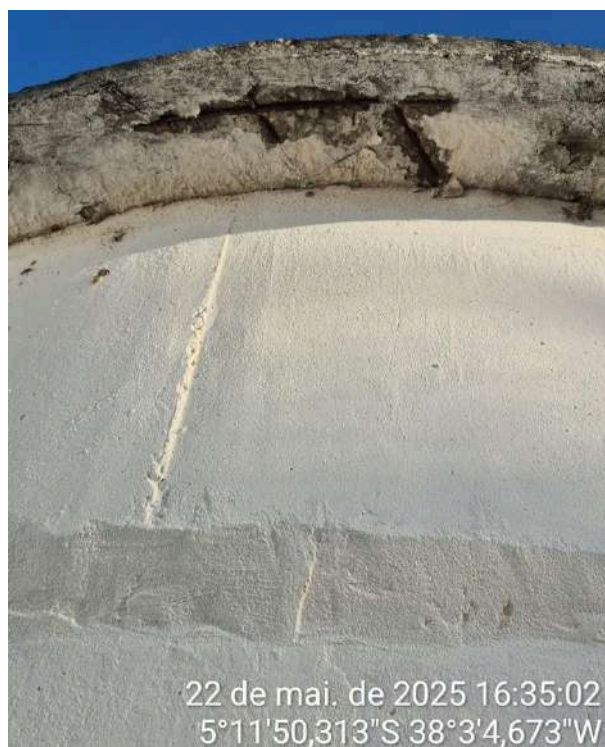
Foto 64 - Teto das casas de bomba com armadura expostas e pintura desgastada.
