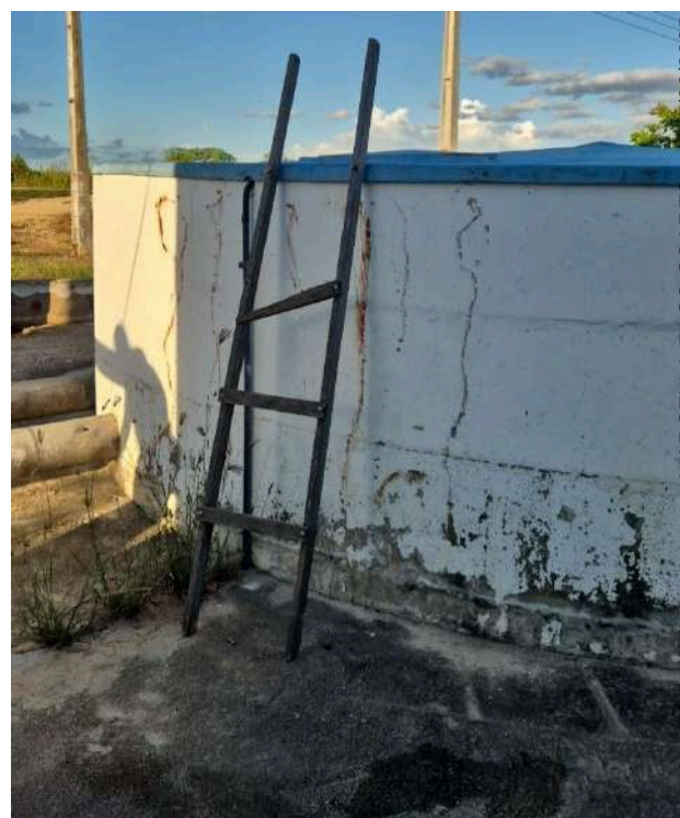
Foto 65 - Escada inadequada sem apoio.
