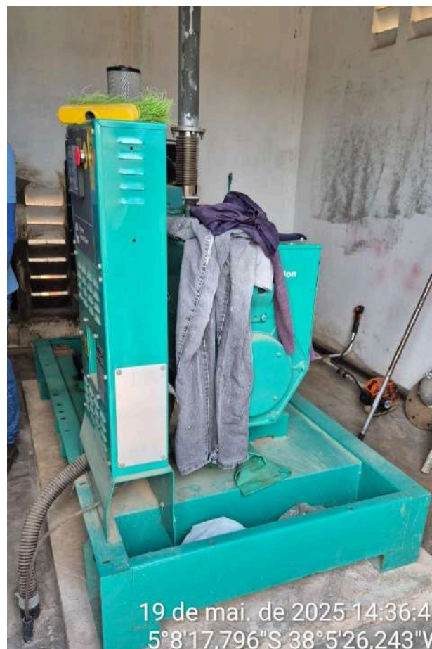
Foto 122 - Material em local inadequado.
