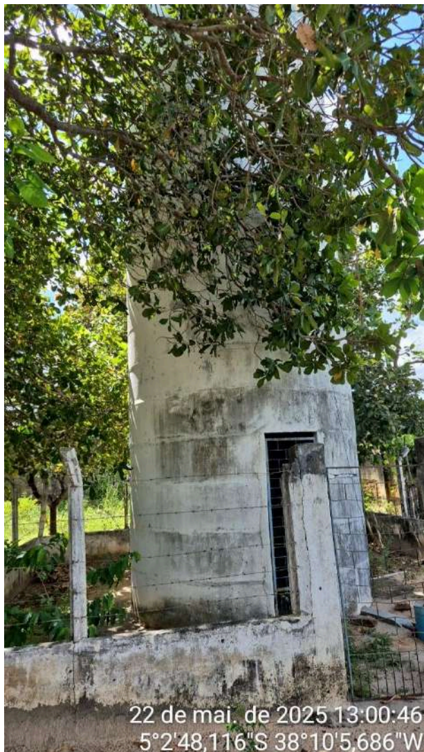
Foto 101 - Estrutura com armadura exposta.
