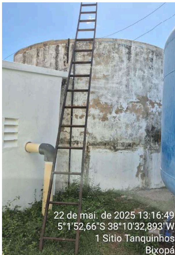
Foto 52 - Escada inadequada para reservatório.
