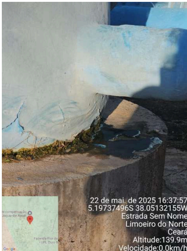
Foto 60 - Vazamento na fibra do filtro.
