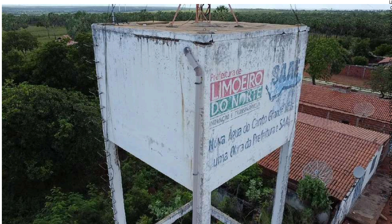
Foto 89 - Escada sem guarda-corpo e armadura exposta.
