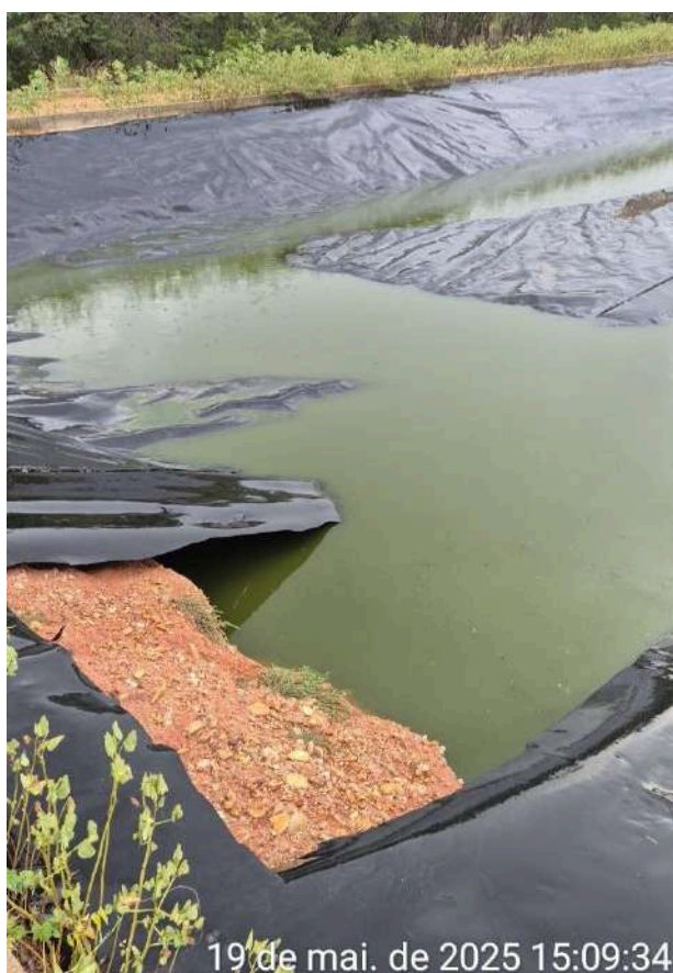
Foto 107 - Rasgo na manta em diversos pontos.
