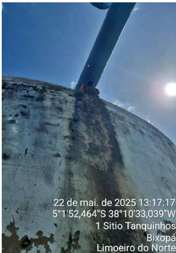
Foto 54 - Pintura do reservatório desgastada.
