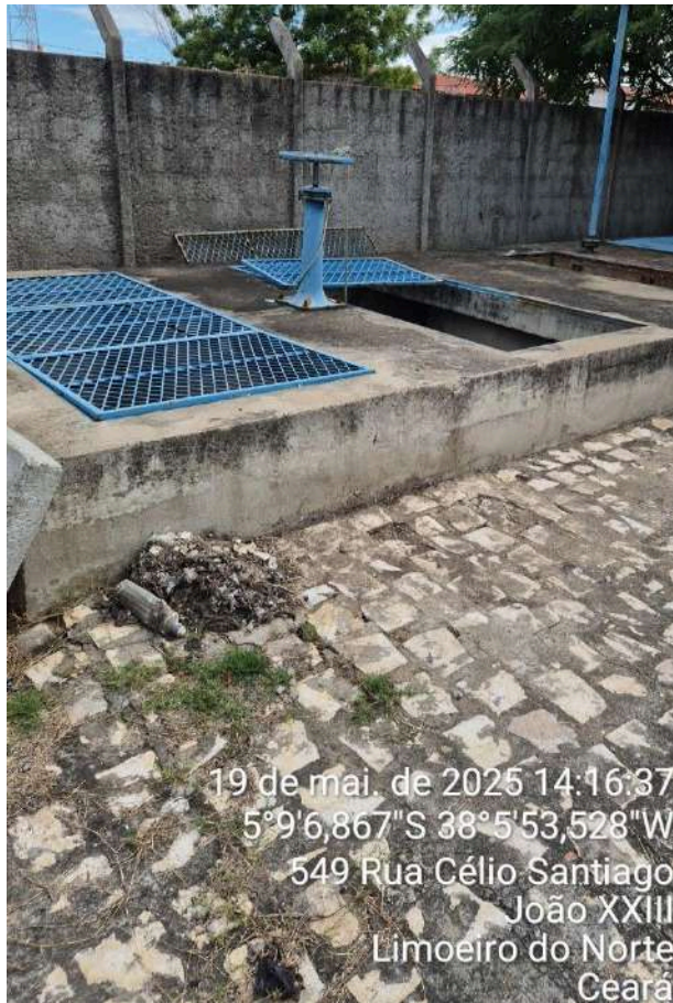
Foto 113 - Acúmulo de sujeira.
