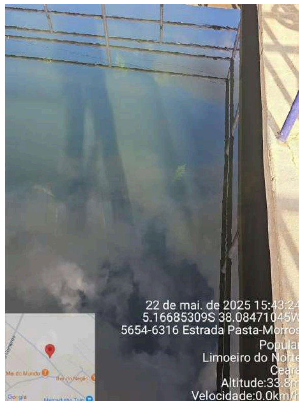
Foto 11 - Decantador - ETA Bom Fim.
