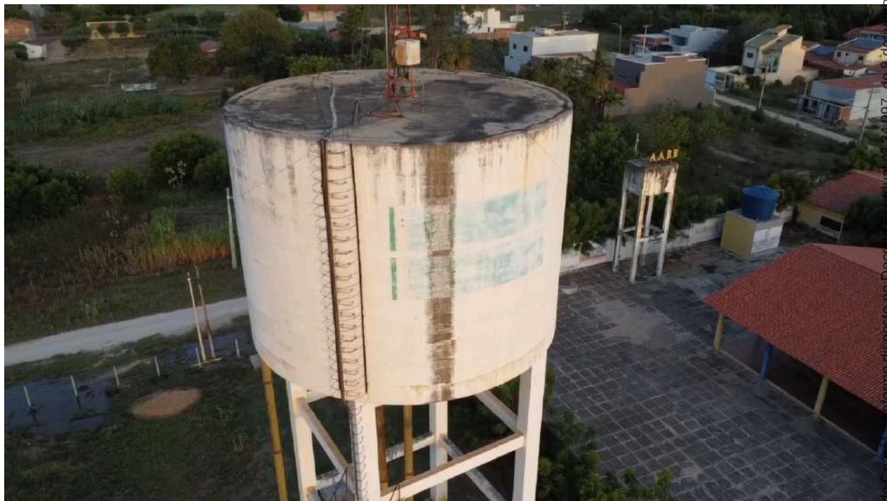
Foto 76 - Pintura desgastada e escada oxidada.
