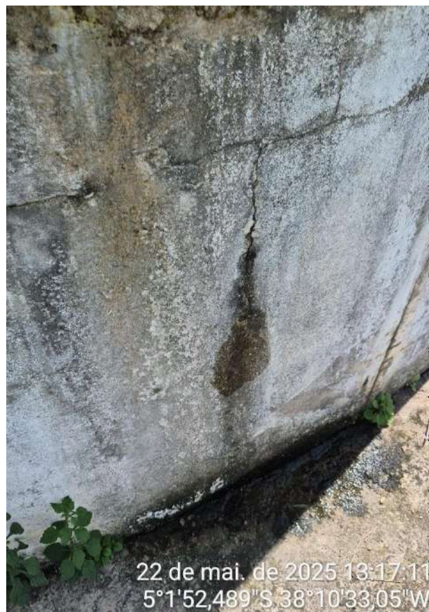
Foto 53 - Vazamento externo no reservatório.
