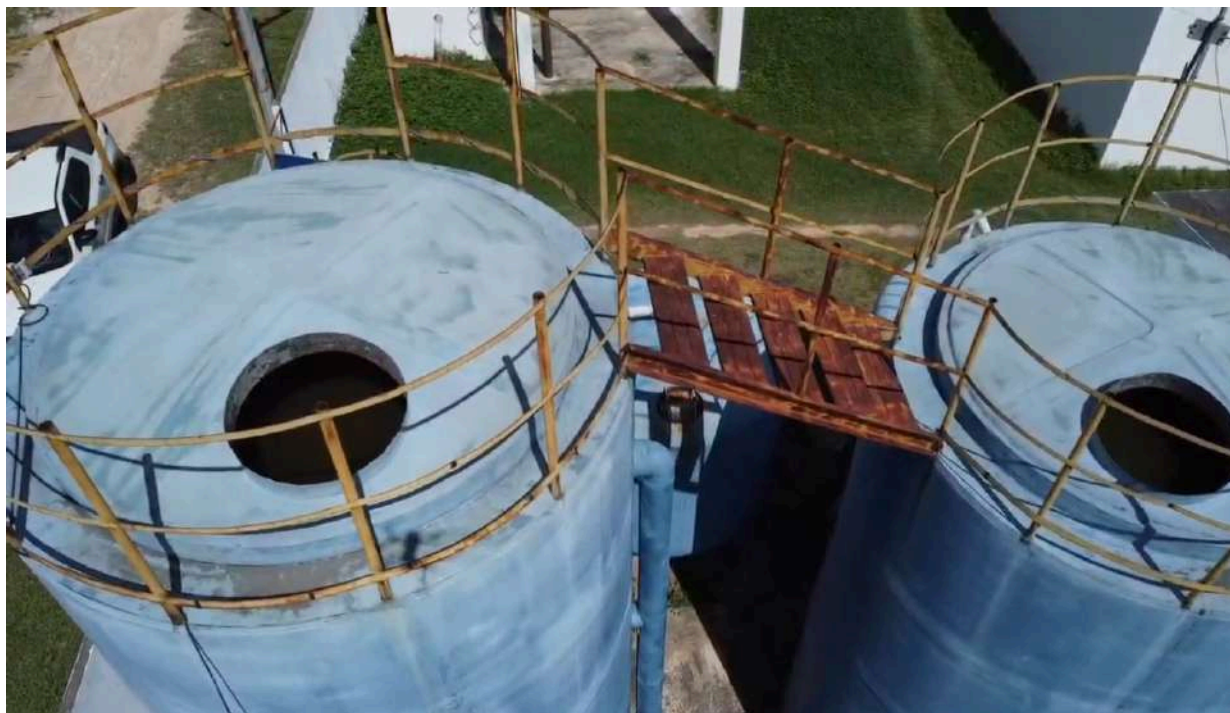
Foto 49 - Escada e guarda-corpo oxidadas.
