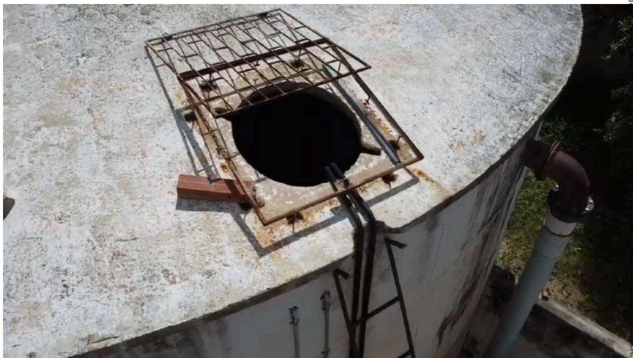
Foto 94 - Escada oxidada e inadequada.
