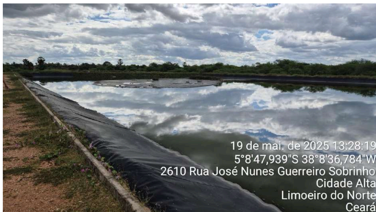
Foto 25 - Lagoa de Maturação - ETE Cidade Alta.
