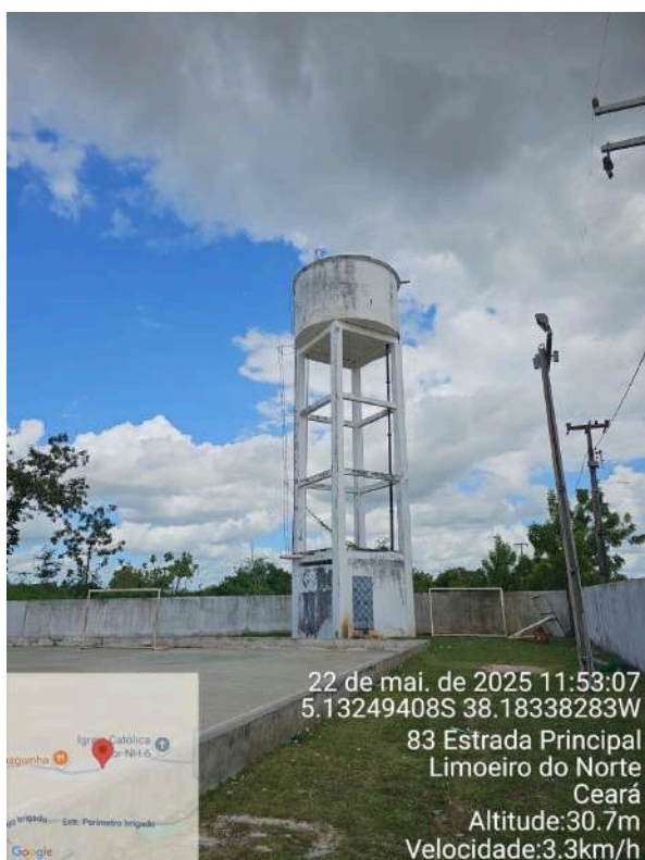
Foto 15 - Sistema Alternativo Poço Profundo - NH6.
