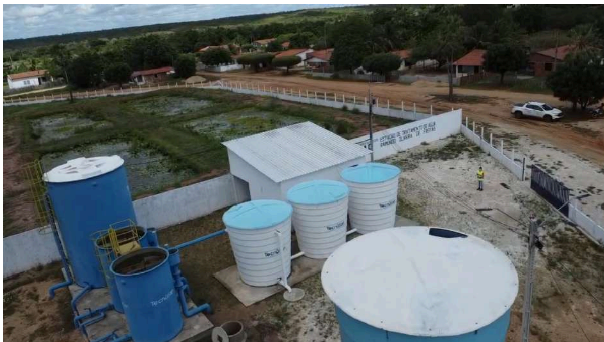
Foto 7 - Filtros - ETA Setores.
