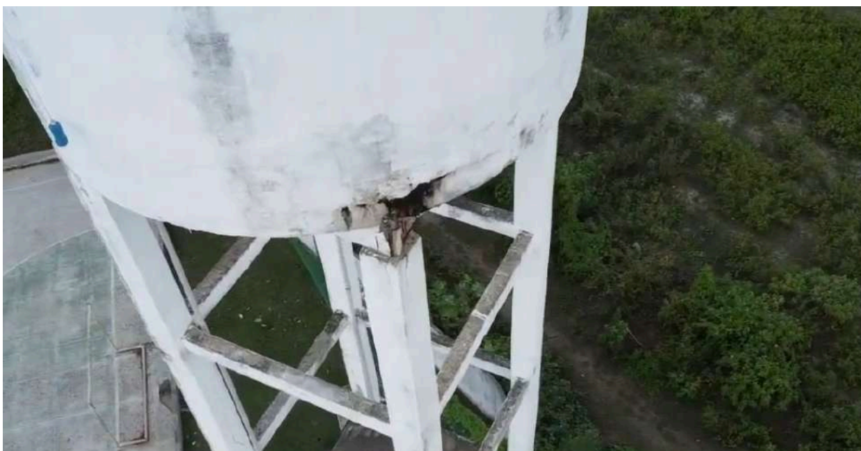
Foto 74 - Armadura exposta na base do reservatório.
