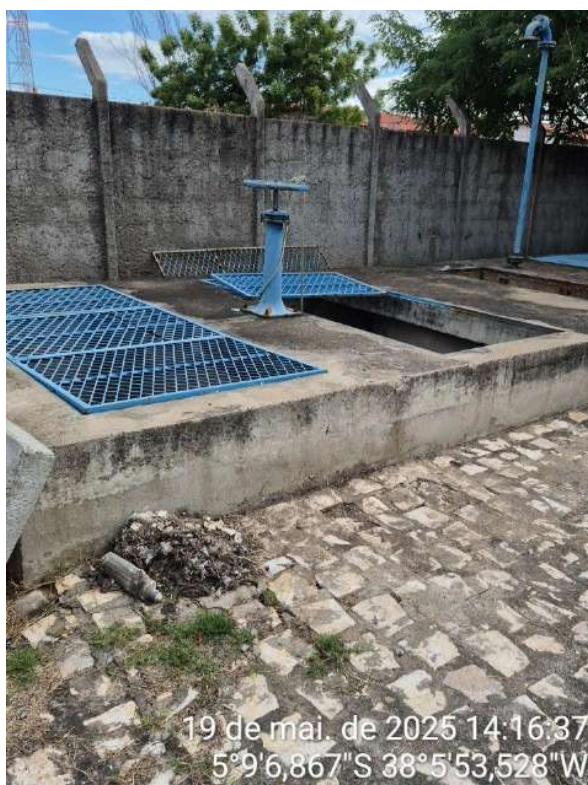
Foto 28 - Estação Elevatória de Esgoto (EEE).
