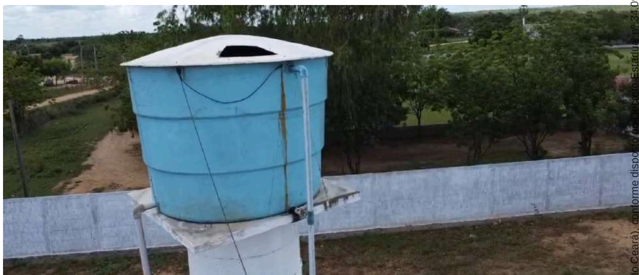
Foto 66 - Reservatório aberto, sem tampa.
