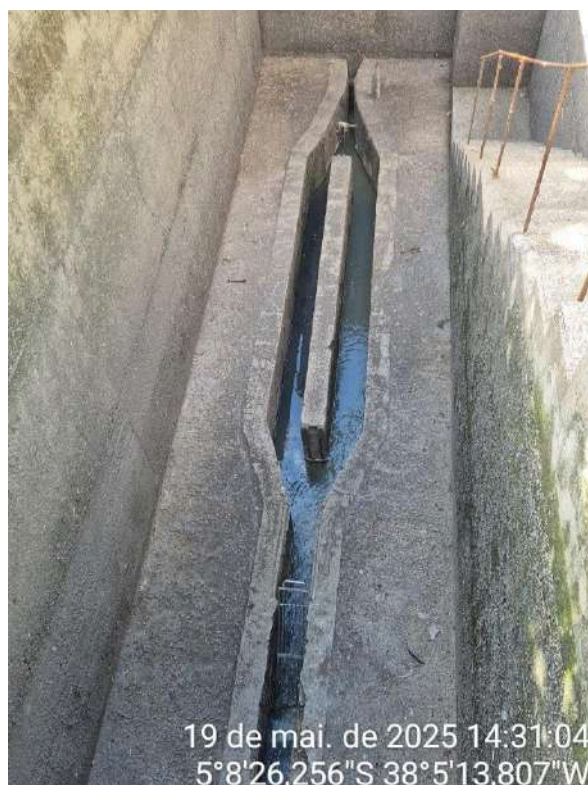
Foto 29 - Entrada da EEE.
