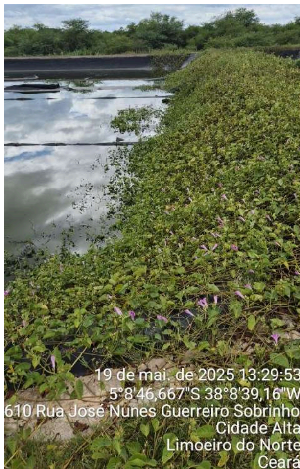
Foto 112 - Acúmulo de vegetação alta.
