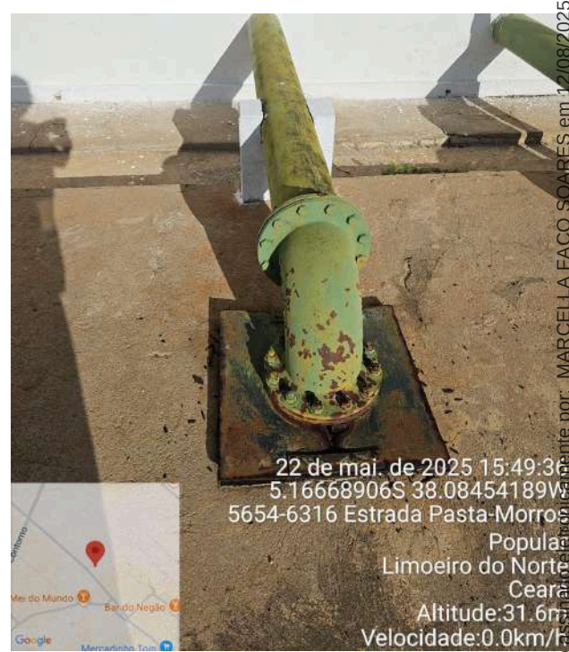
Foto 48 - Tampas oxidadas e degradadas.
