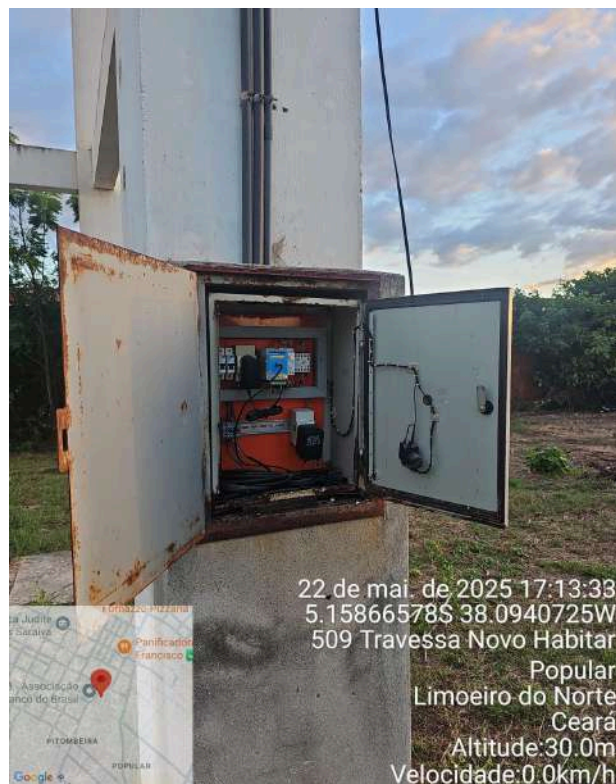
Foto 78 - PAINEL DE CONTROLE OXIDADO.
