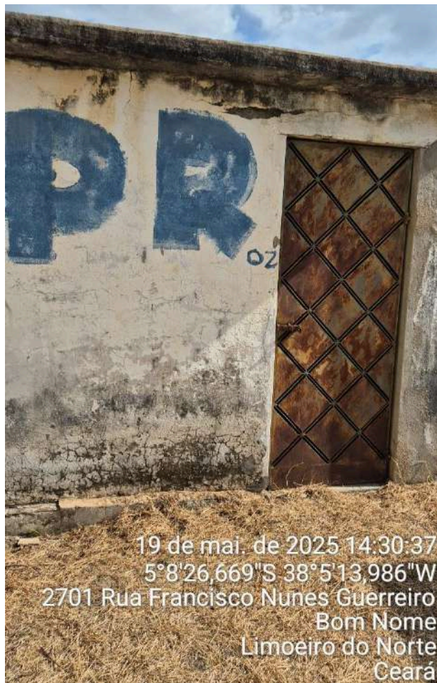
Foto 115 - Porta oxidada e parede desgastada.
