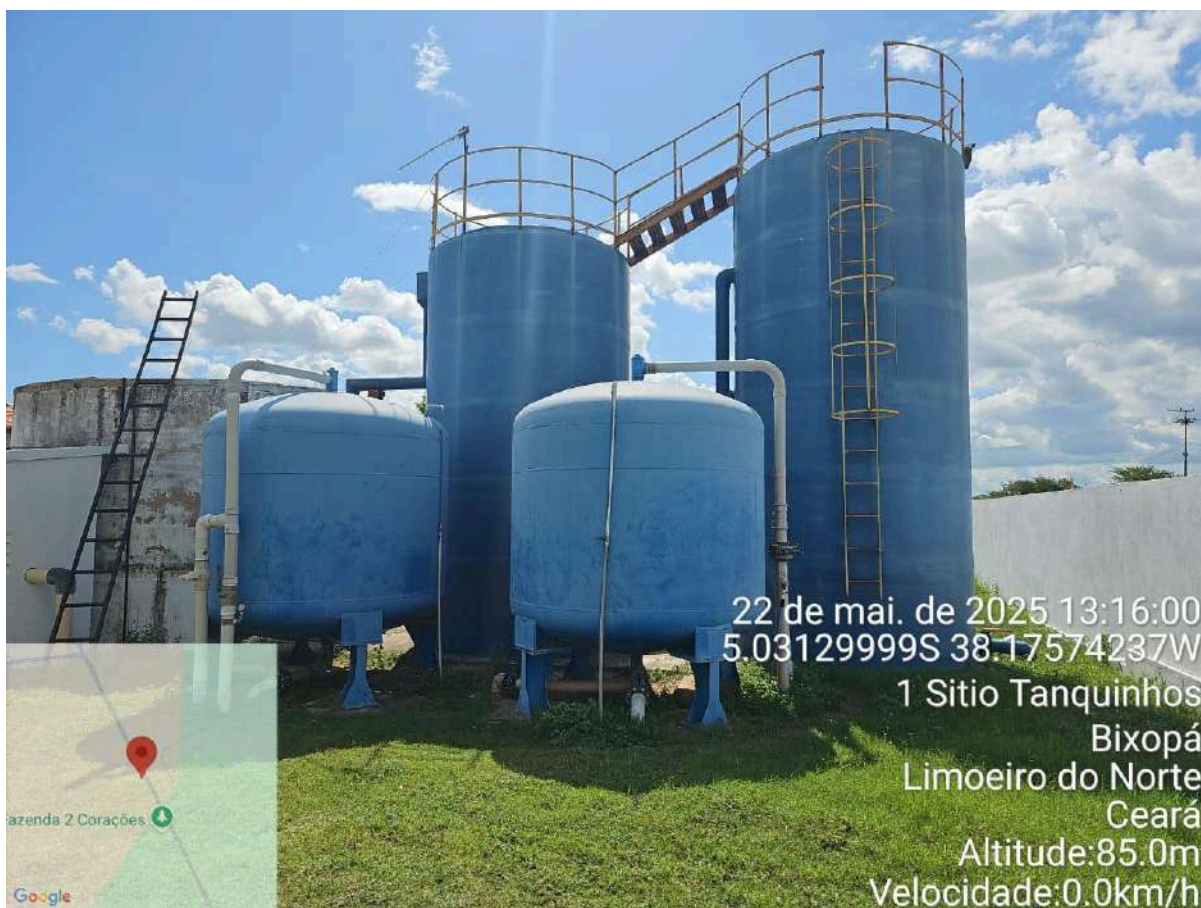
Foto 2 - Filtros - ETA Manoel Conrado.
