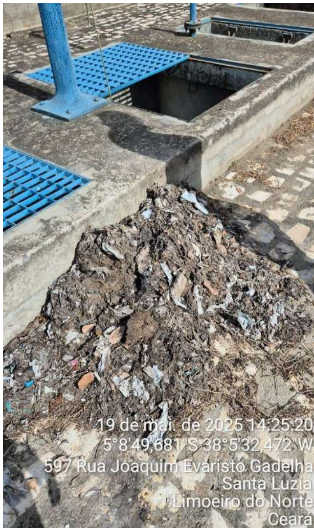
Foto 119 - Acúmulo de sujeira.
