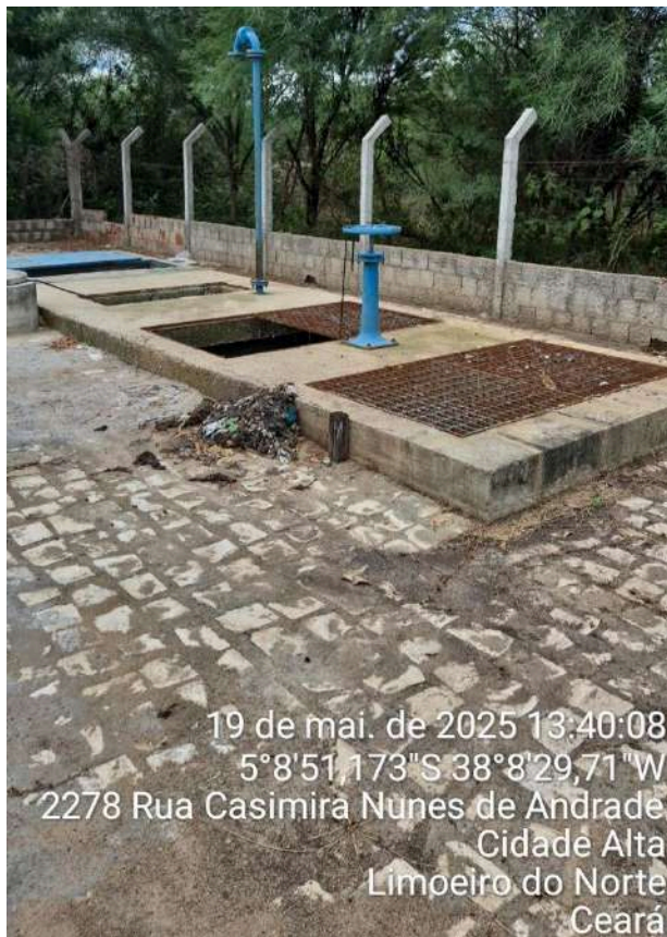
Foto 129 - Acúmulo de sujeira.
