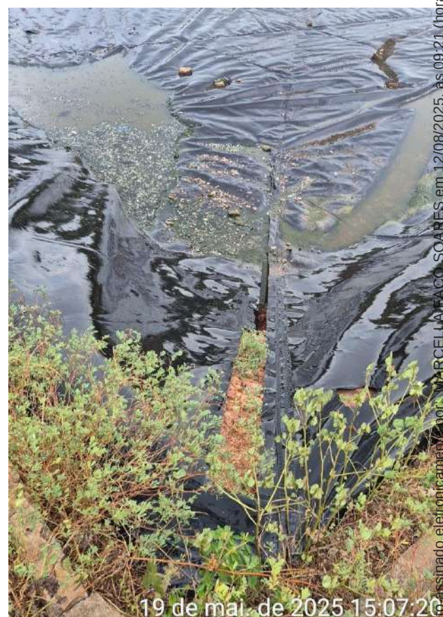
Foto 108 - Rasgo na manta em diversos pontos.
