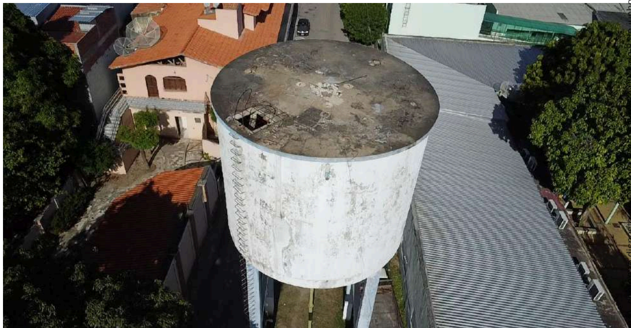
Foto 83 - Escada oxidada e inadequada, sem guarda-corpo.
