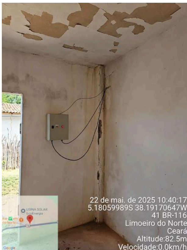
Foto 91 - Armadura exposta e teto desgastado.
