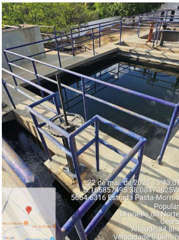
Foto 10 - Filtros descendentes - ETA Bom Fim.
