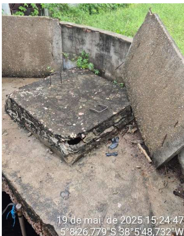
Foto 137 - Estrutura oxidada e com rachaduras.
