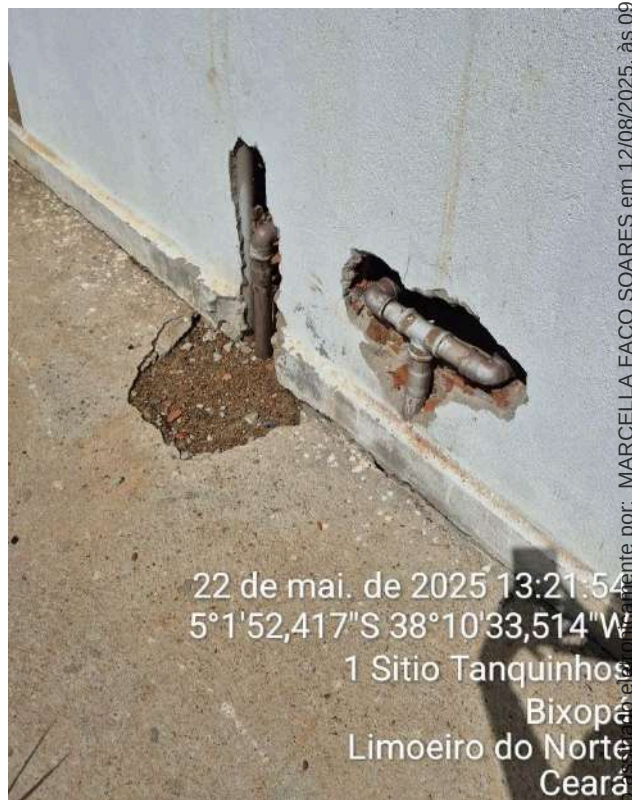
Foto 59 - Parede quebrada com tubulação exposta.
