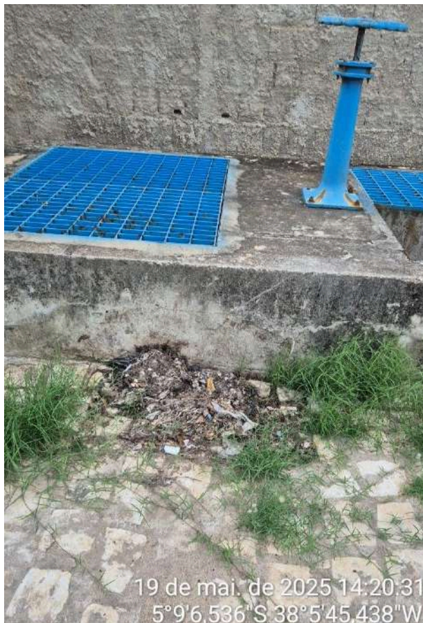
Foto 131 - Acúmulo de sujeira.
