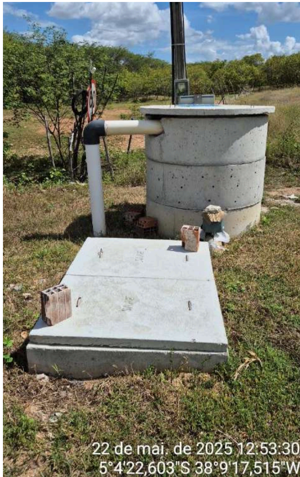
Foto 103 - Vedação com material inapropriado.
