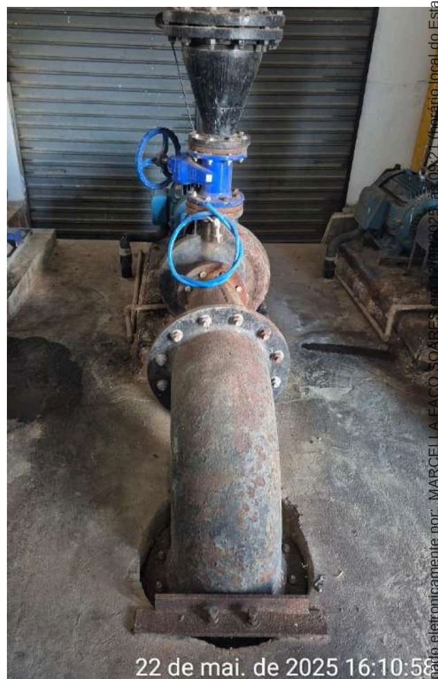
Foto 40 - Tubulações das bombas oxidadas e com vazamento.
