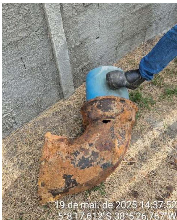
Foto 123 - Material em local inadequado.
