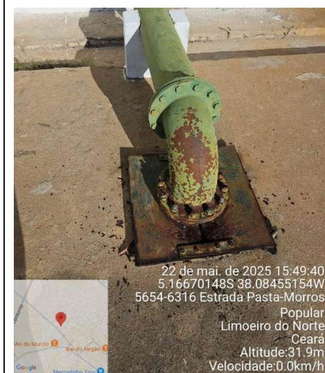
Foto 47 - Tampas oxidadas e degradadas.
