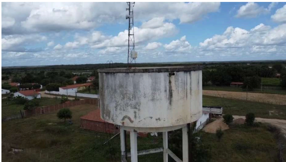
Foto 14 - Sistema Alternativo Poço Profundo - NH3.
