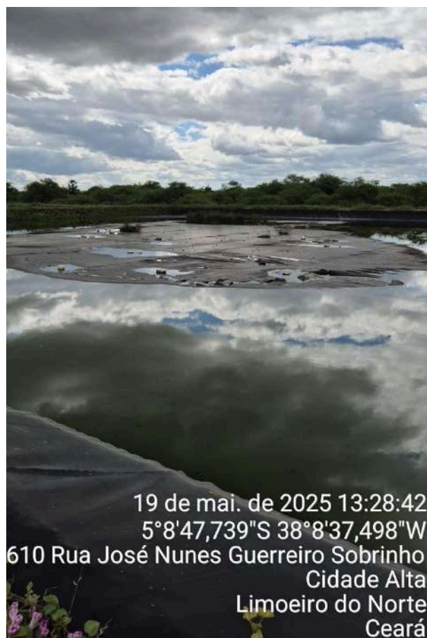
Foto 109 - Manta colocada de forma inadequada.
