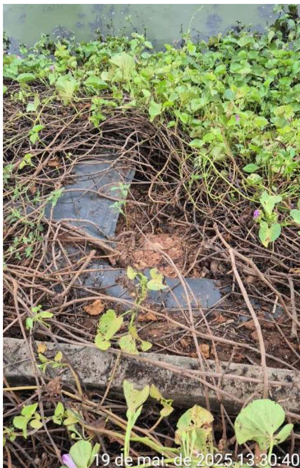
Foto 111 - Rasgo na manta em diversos pontos.
