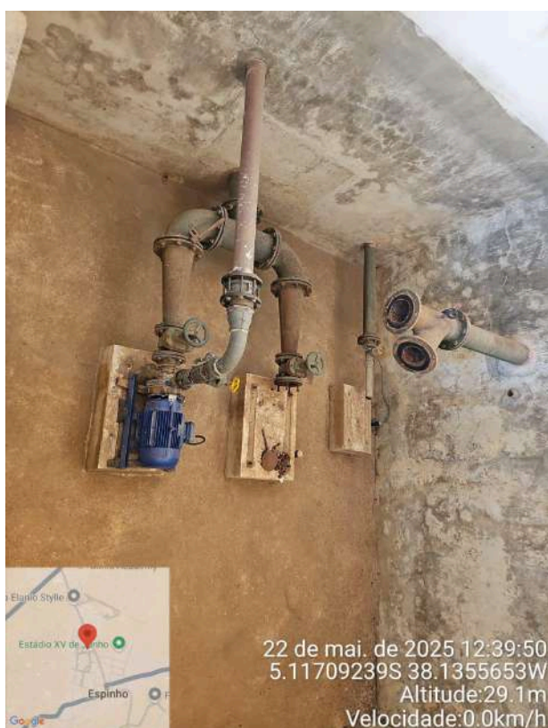
Foto 97 - Tubulação sem conexão.
