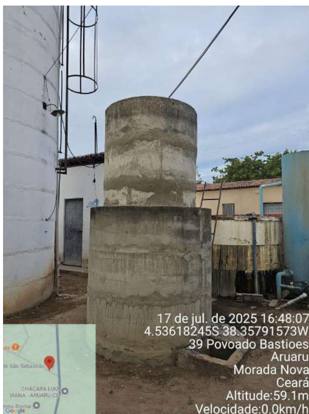
Foto 128 - Filtro sem pintura.
