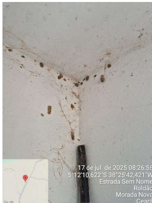
Foto 180 - Casa de bichos nas paredes da casa de comando.
