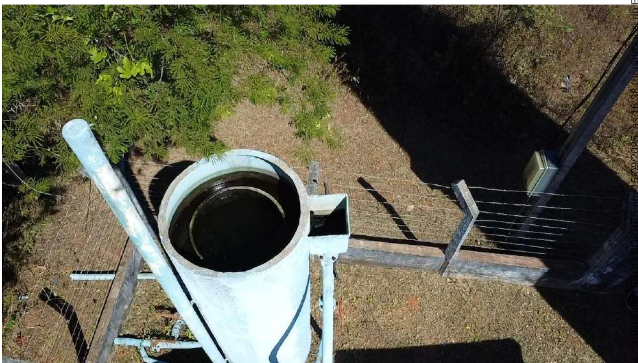
Foto 185 - Pintura desgastada do filtro.
