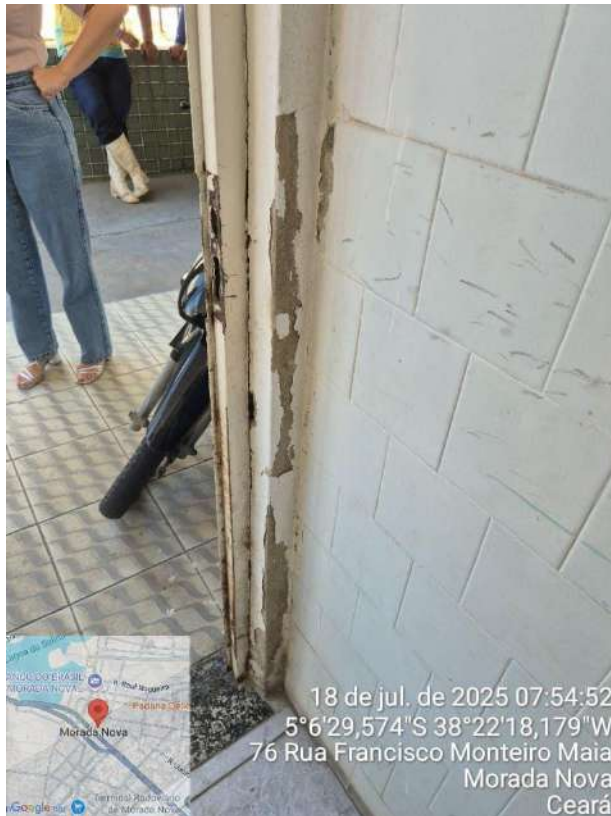
Foto 81 - Banheiro Feminino: parede desgastada.
