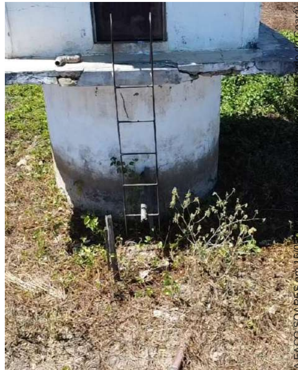
Foto 104 - Captação Pedras: escada sem fixação base degradada com armadura exposta.
