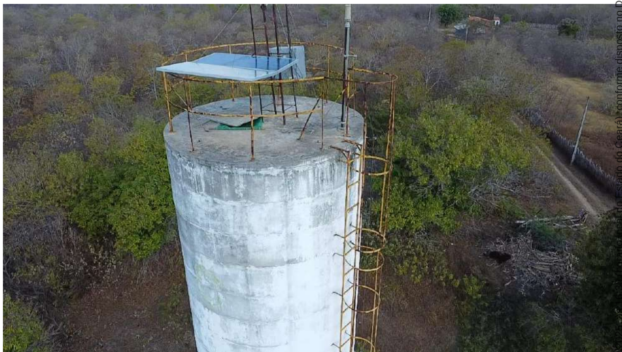
Foto 194 - REL com tampa deslocada e escada e guarda corpo oxidados.
