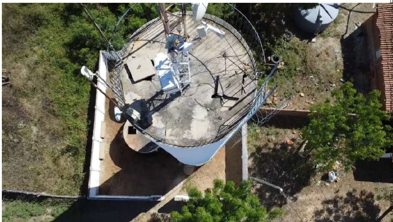
Foto 241 - REL com tampa deslocada.
