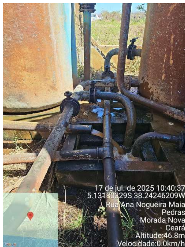
Foto 113 - ETA Pedras: tubulação com desgaste elevado devido ao aerador.
