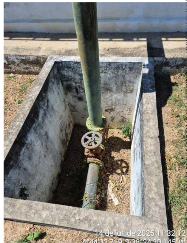
Foto 86 - Captação Lajedo: tubulação e válvulas oxidadas.
