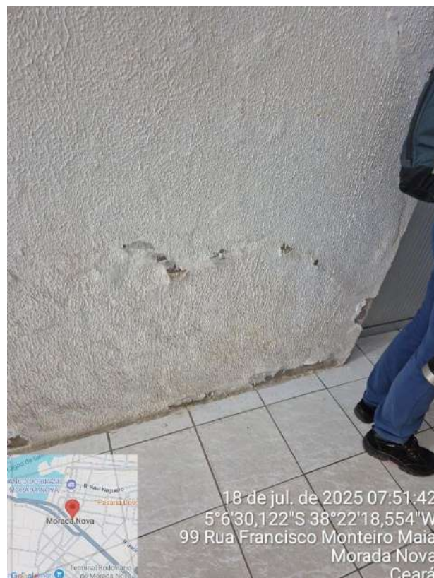
Foto 58 - Corredores: paredes deterioradas.
