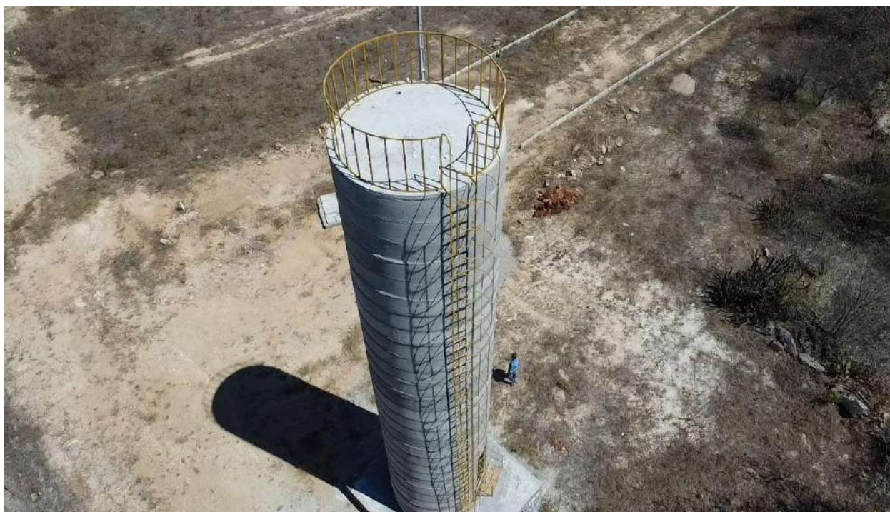
Foto 246 - REL sem pintura.
