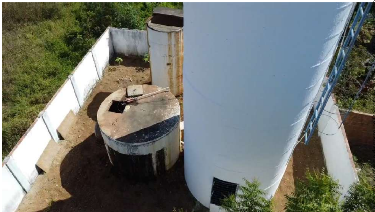
Foto 240 - RAP sem tampa e com indicativo de vazamento externo, filtro com manchas.
