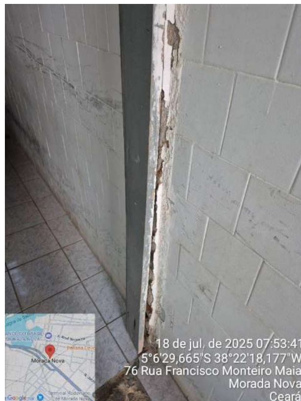
Foto 74 - Banheiro Masculino: armação da porta desgastada.
