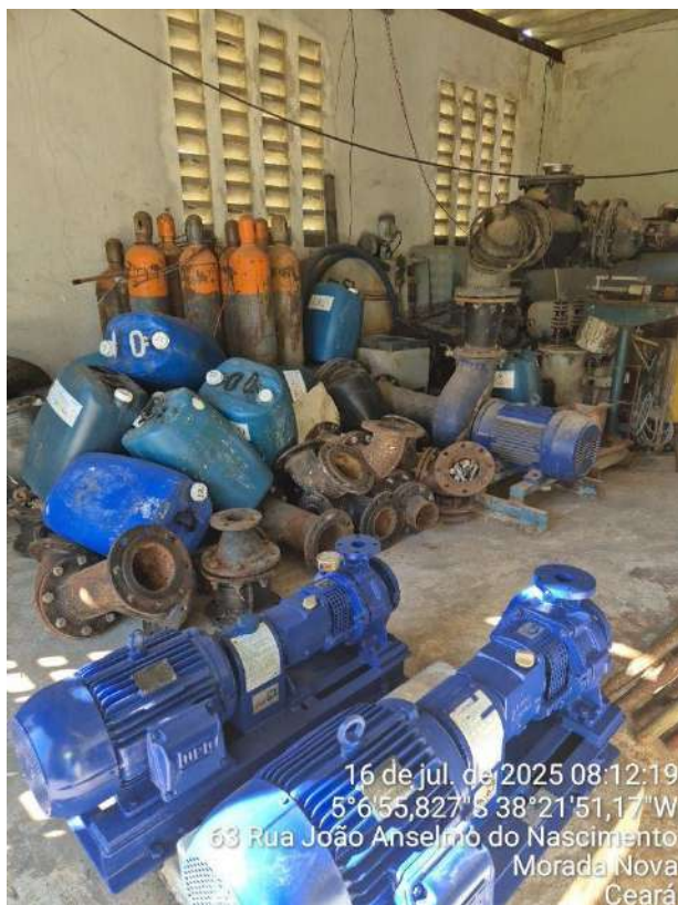
Foto 138 - EE-01: Utilizada como depósito, desativada.
