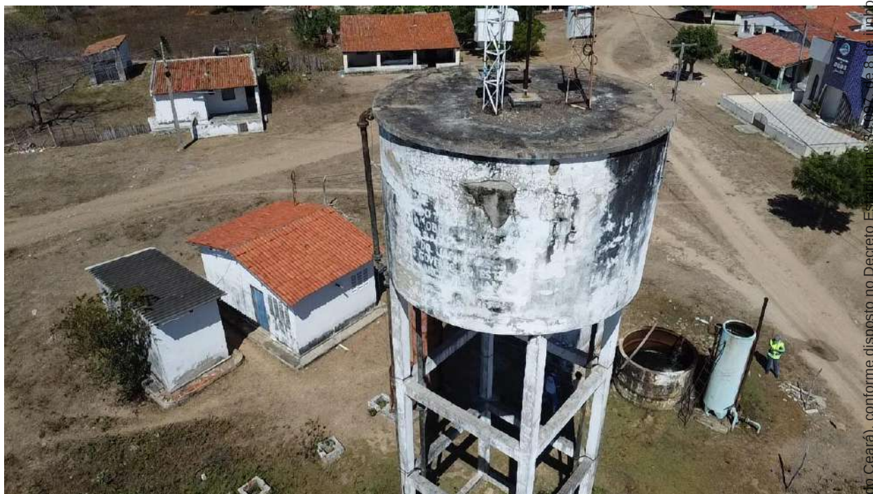
Foto 228 - REL com pintura desgastada, tubulação oxidada.
