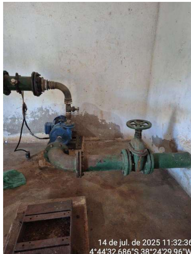
Foto 88 - Captação Lajedo: tubulação da bomba oxidada e fios sem eletrodutos.
