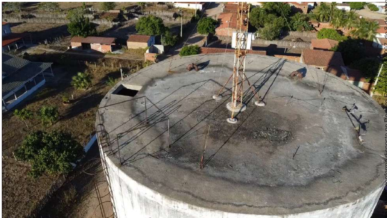
Foto 242 - REL sem tampa, tubulação oxidada.
