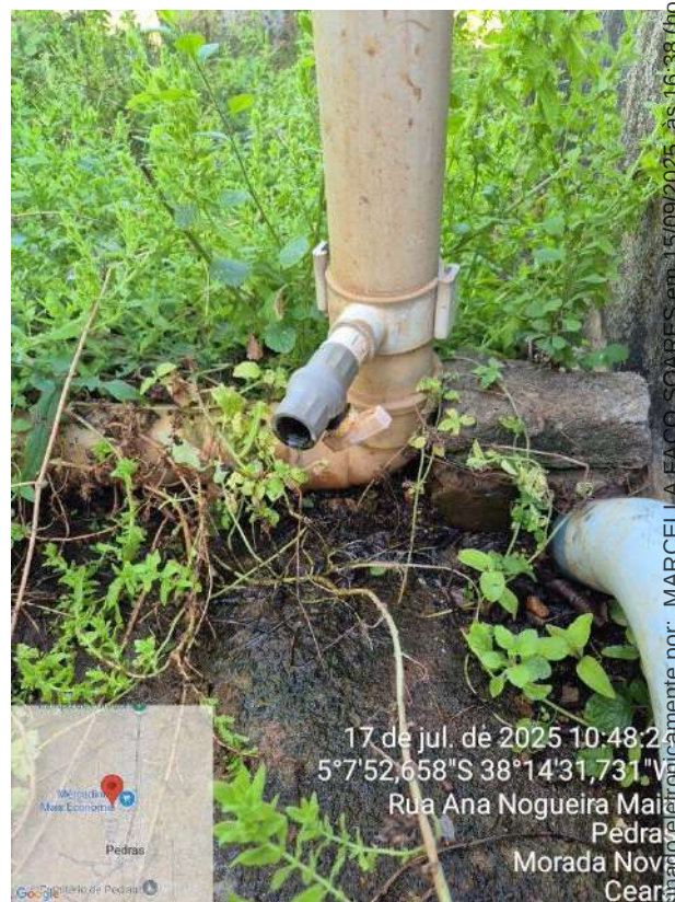
Foto 111 - ETA Pedras: vazamento na tubulação do cloro da caixa.
