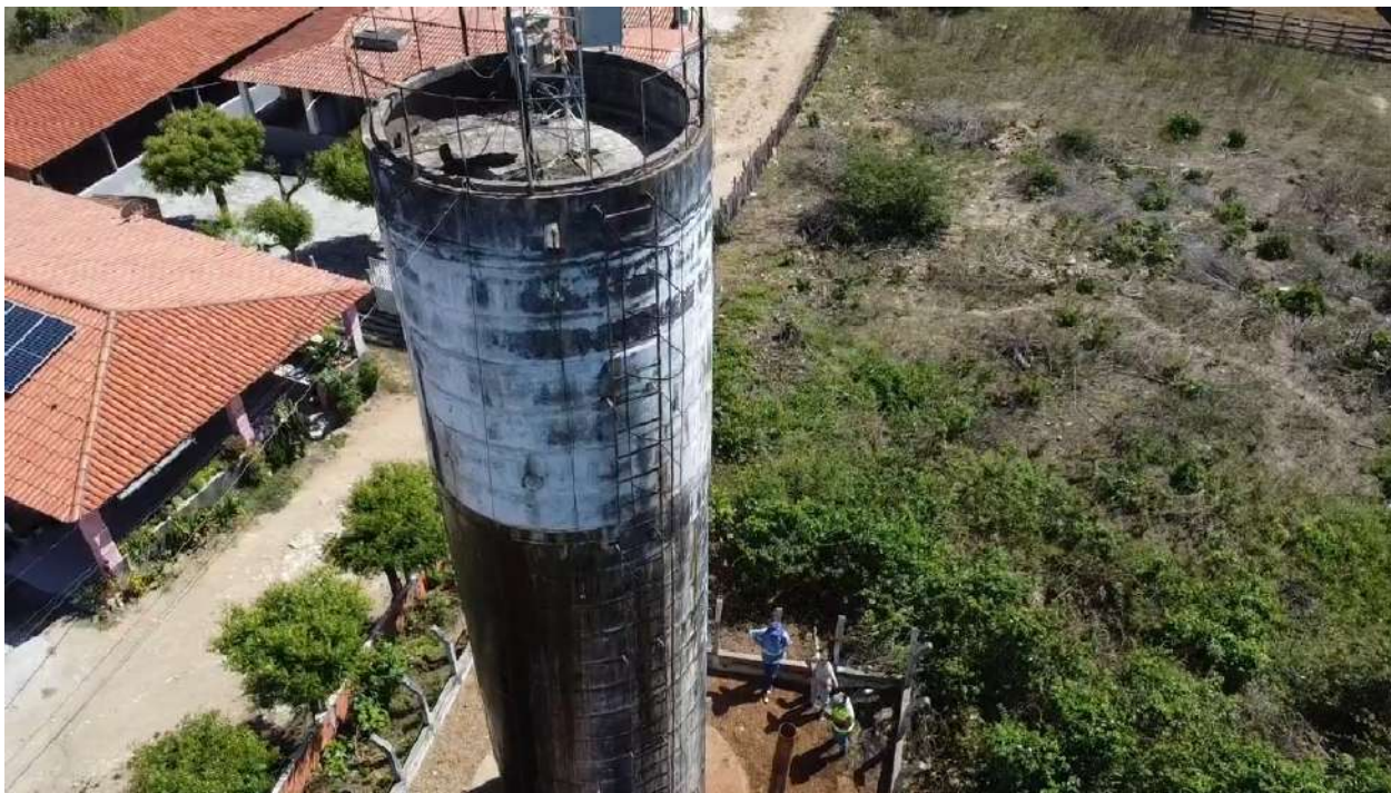
Foto 171 - Escada oxidada e presença de lodo na parte externa.
