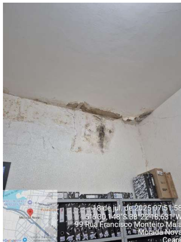
Foto 60 - Corredores: teto e parede com infiltração.
