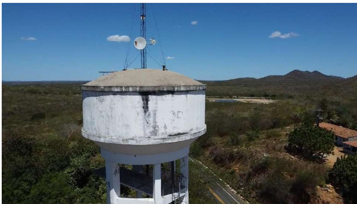
Foto 102 - Reservatório Lagoa Funda: pintura desgastada.
