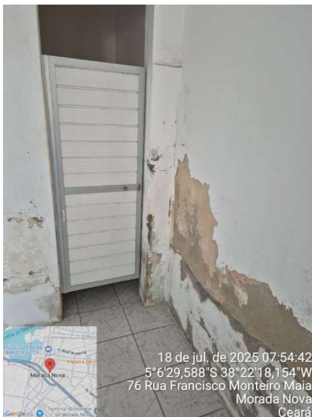
Foto 79 - Banheiro Feminino: parede desgastada.
