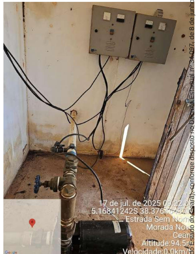
Foto 187 - Fiação sem eletrodutos inadequada.
