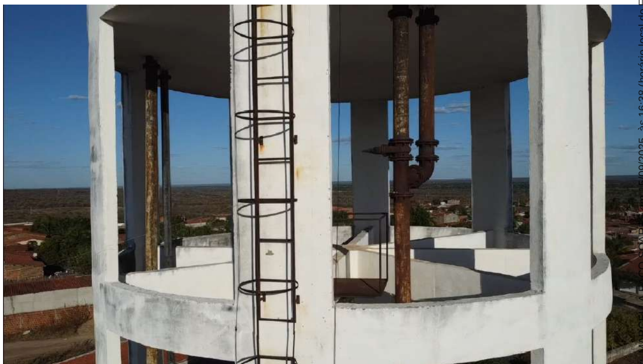
Foto 243 - Tubulação e escada oxidadas.
