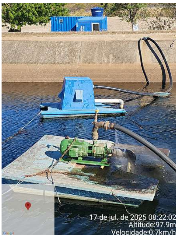
Foto 21 - Captação Lagoa dos Bois (com vazamento na tubulação).
