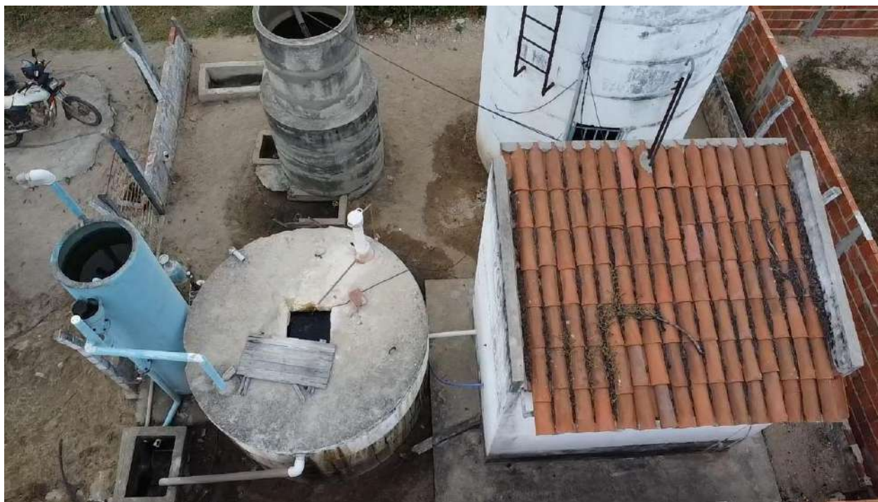
Foto 123 - RAP sem tampa.
