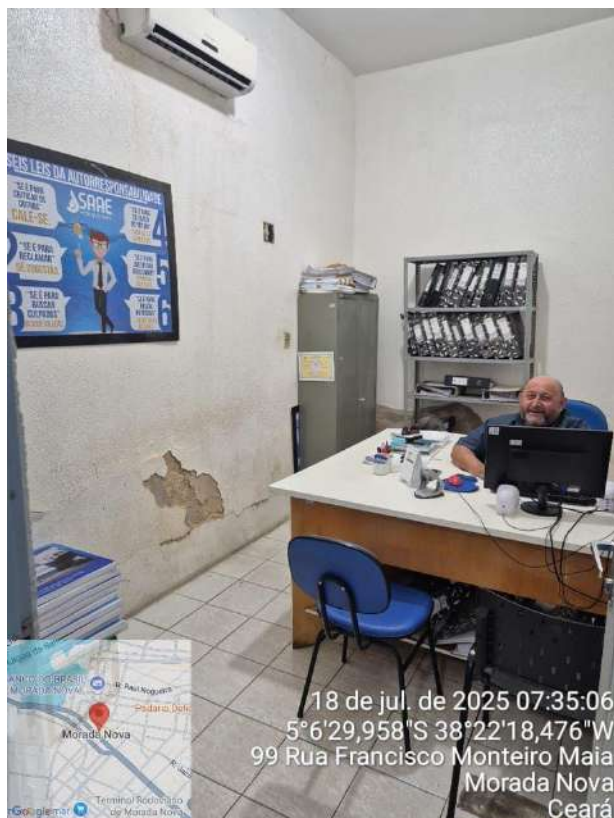
Foto 49 - Diretoria Administrativa: parede descascando.
