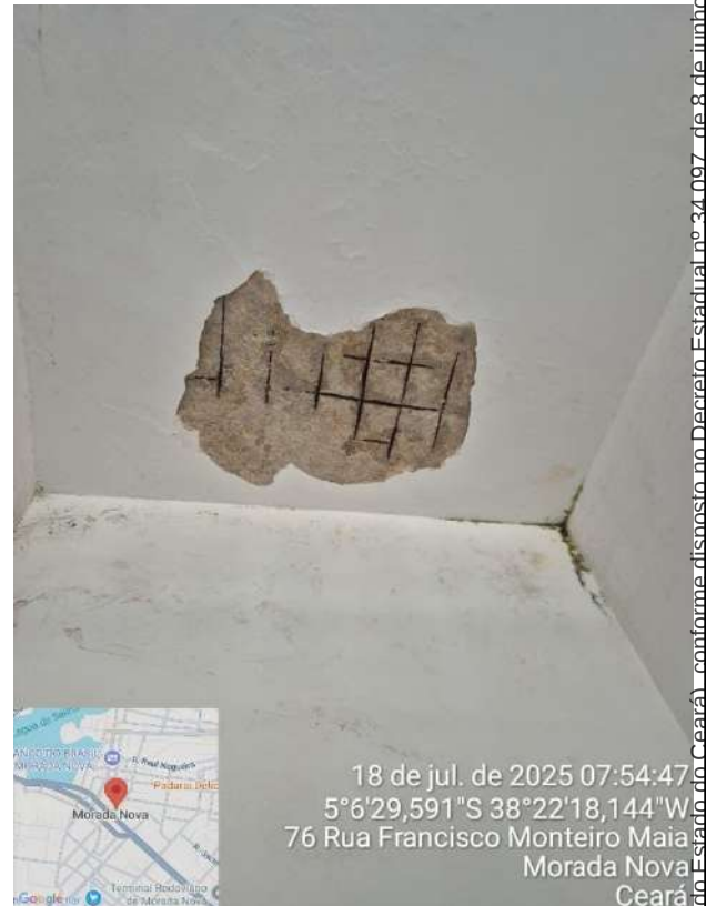
Foto 82 - Banheiro Feminino: teto com armadura exposta.
