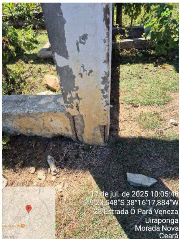
Foto 232 - REL com armadura exposta.
