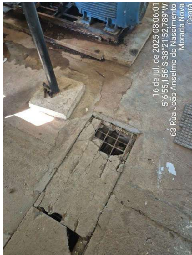
Foto 143 - EE-03: piso quebrado.
