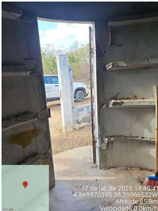
Foto 195 - Rachaduras na parte interna do REL.
