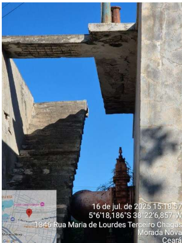
Foto 158 - Armadura exposta, tubulação oxidada.
