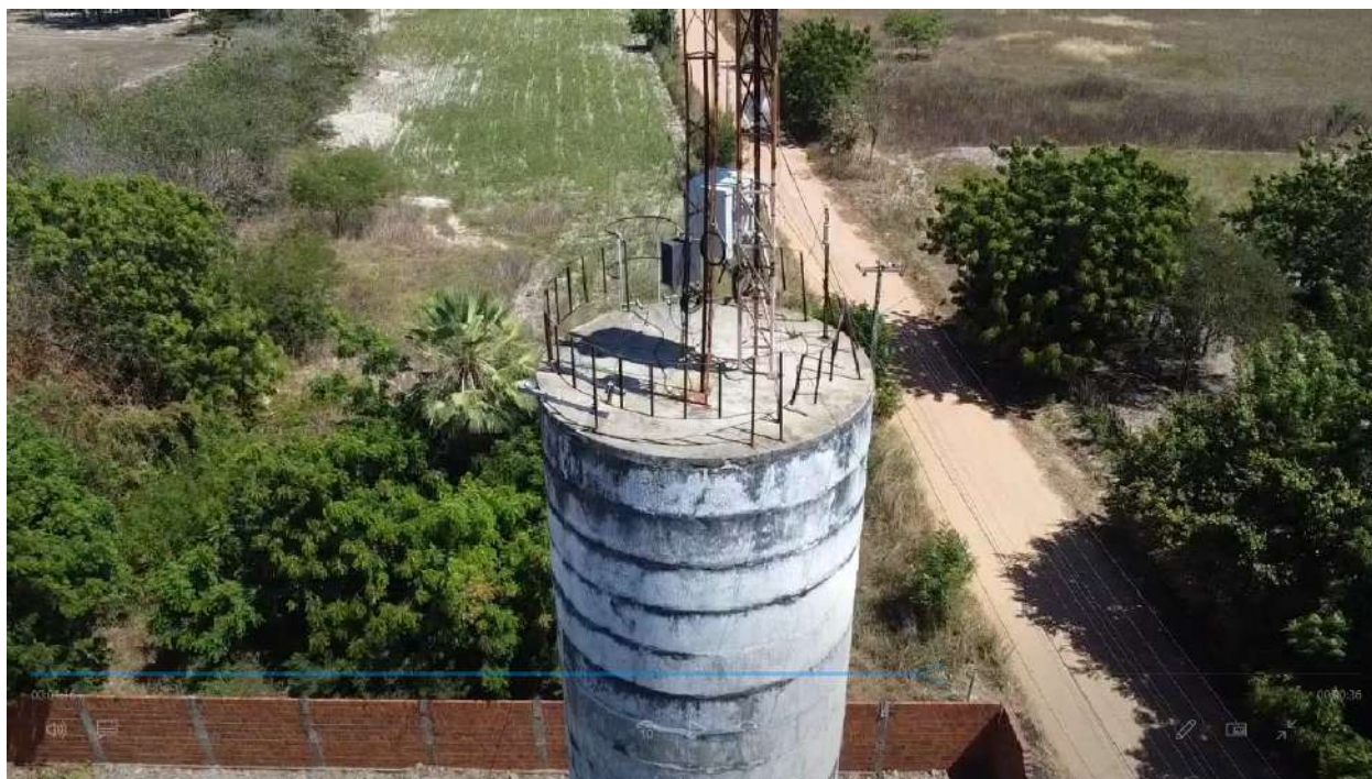
Foto 101 - Batentes: REL com pintura desgastada, guarda corpo oxidado quebrado.
