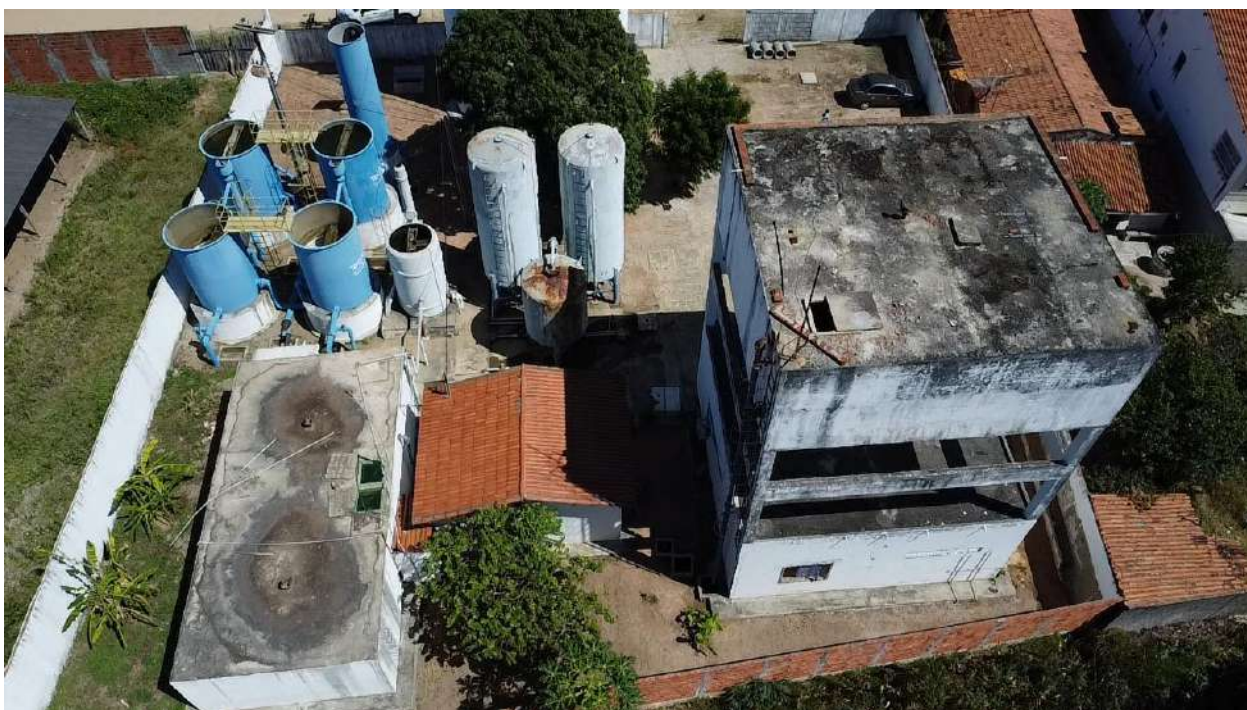
Foto 96 - ETA Aruaru: Reservatórios com tampas abertas, filtro oxidado, escada oxidada.
