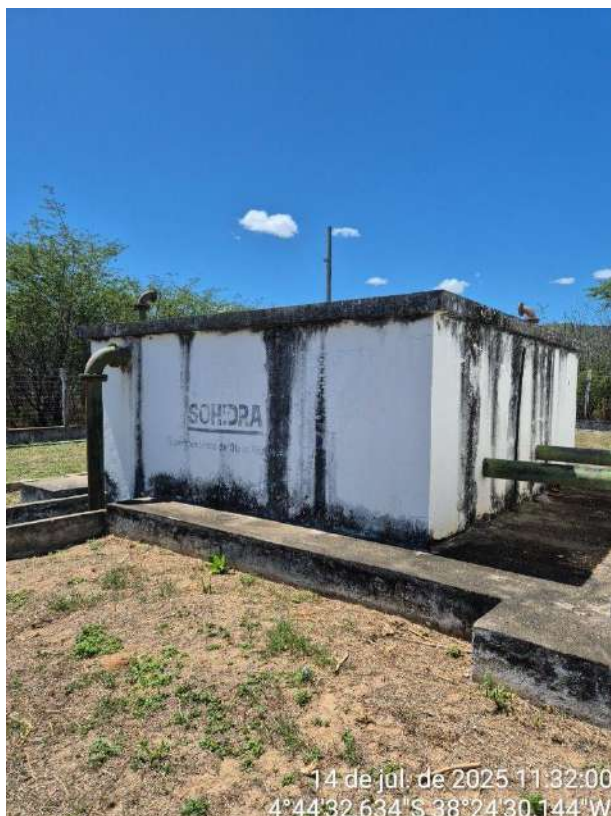
Foto 85 - Captação Lajedo: Reservatório com pintura desgastada.
