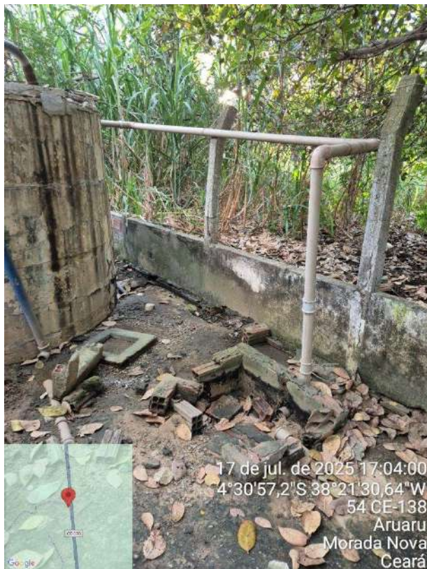
Foto 212 - Caixa da descarga quebrada.
