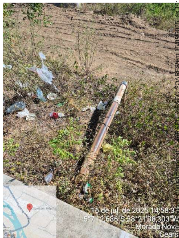
Foto 204 - Tubulação oxidada, com lixo ao redor.
