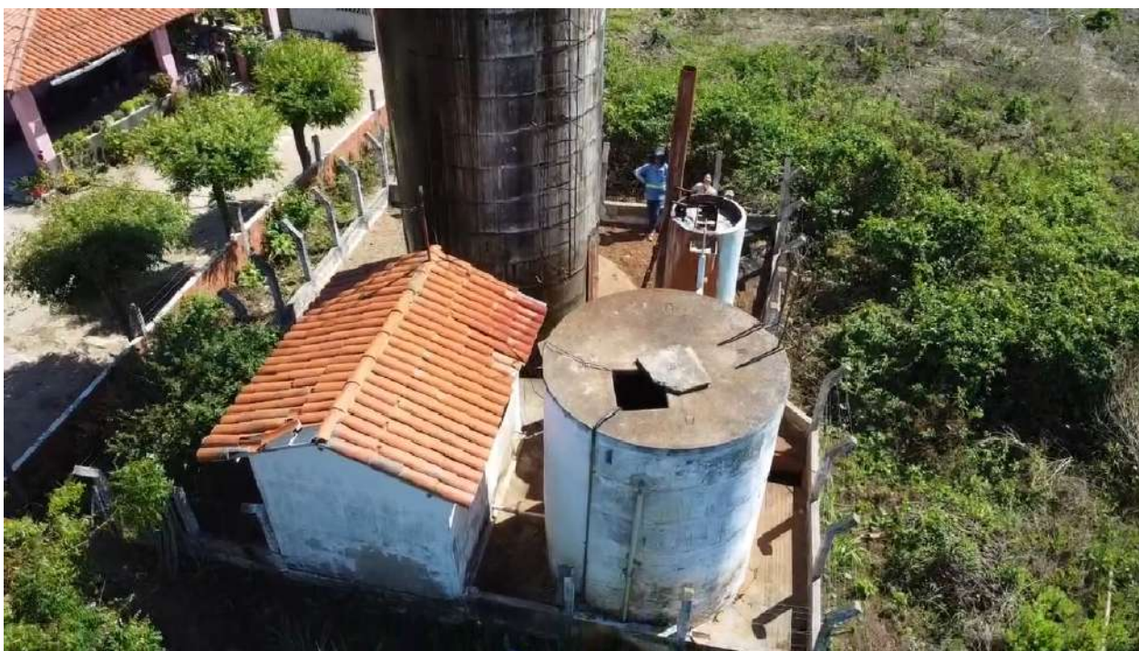
Foto 172 - RAP com tampa deslocada, filtro oxidado.
