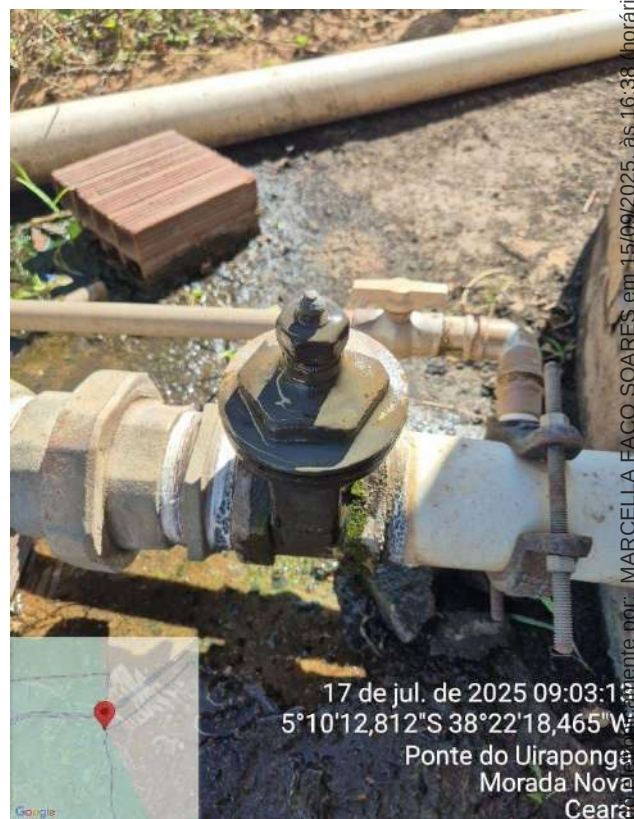
Foto 135 - Vazamento na válvula.
