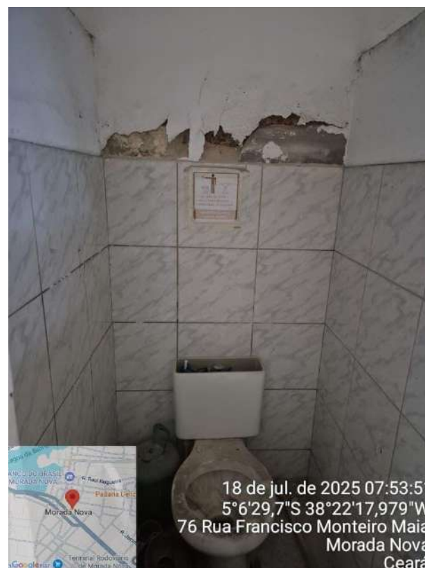
Foto 72 - Banheiro Masculino: parede desgastada, vaso com muita sujeira.
