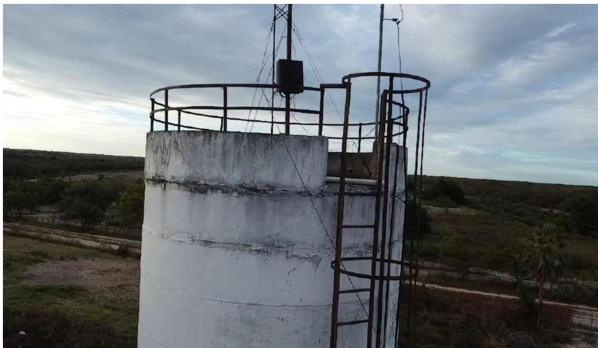
Foto 121 - Escada oxidada, pintura do REL desgastada.
