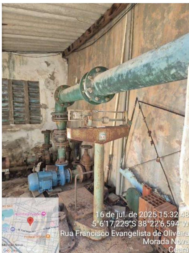
Foto 160 - Estruturas quebradas e oxidadas.
