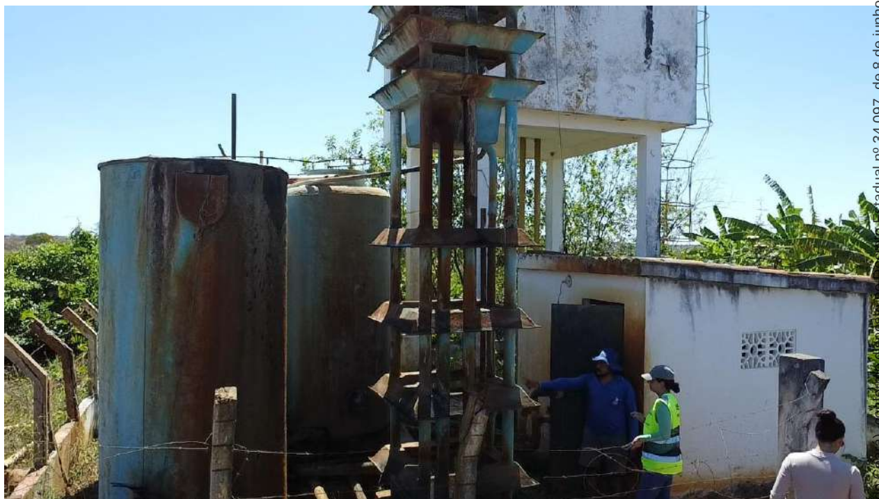
Foto 112 - ETA Pedras: aerador e filtros com estrutura extremamente oxidada.
