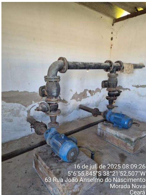
Foto 140 - EE-02: sem luz, parede desgastada e tubulação oxidada.
