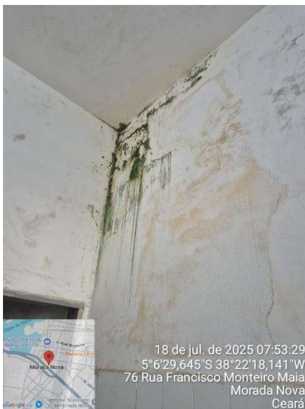
Foto 75 - Banheiro Masculino: presença de lodo e infiltração nas paredes e teto.
