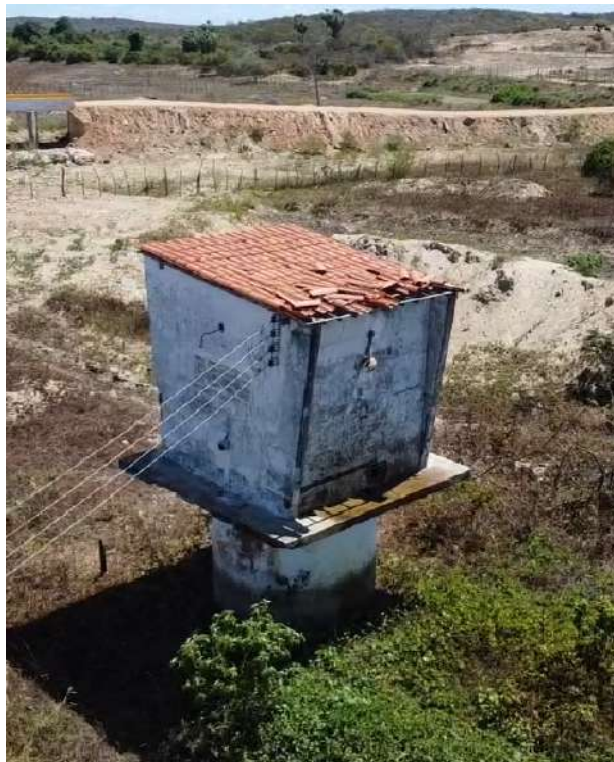
Foto 103 - Captação Pedras: sala de comando com telhas soltas.
