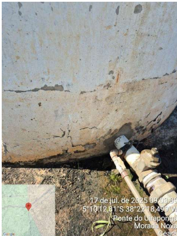
Foto 136 - Rachadura no reservatório.
