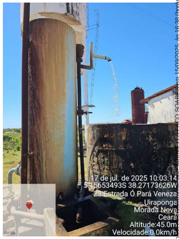
Foto 233 - Filtro e RAP desgastados, com oxidação no filtro e lodo no RAP.
