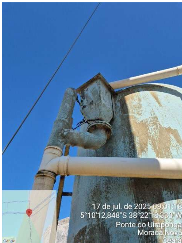
Foto 132 - Pintura do filtro desgastada.
