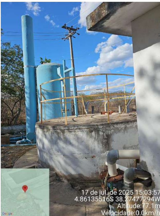
Foto 197 - Tubulação oxidada, RAP desgastado.
