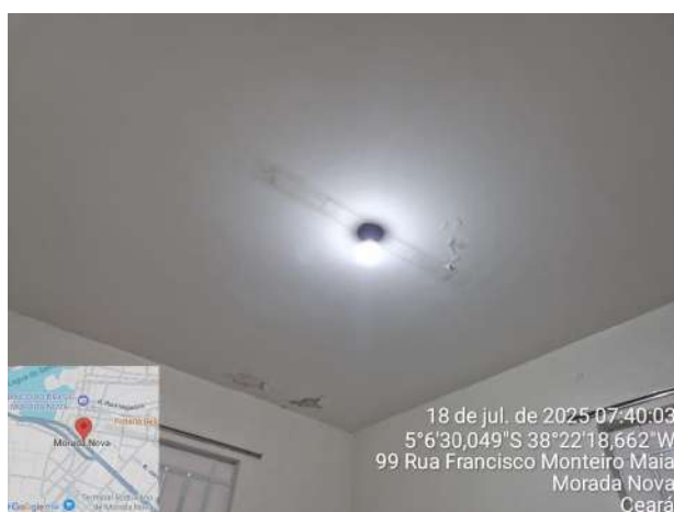
Foto 51 - Setor Financeiro: tinta do teto descascando.
