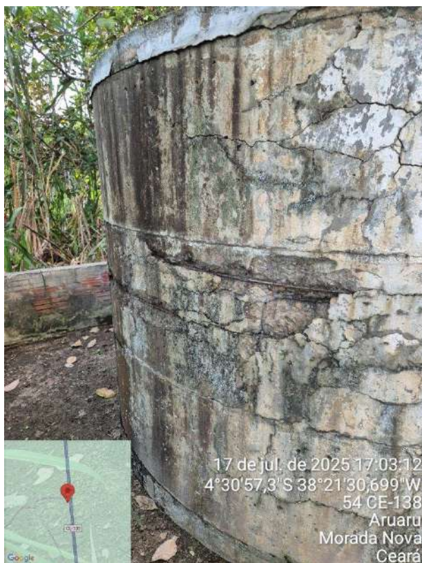
Foto 210 - RAP com armadura exposta.
