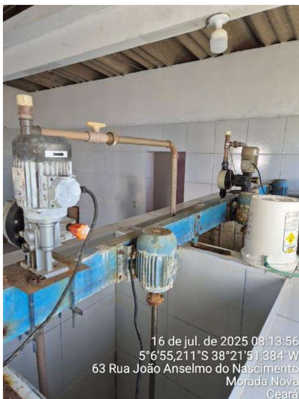
Foto 148 - Estrutura da bomba oxidada.
