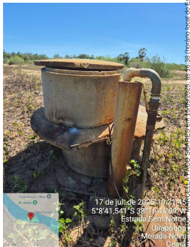
Foto 224 - Base quebrada, proteção desgastada.
