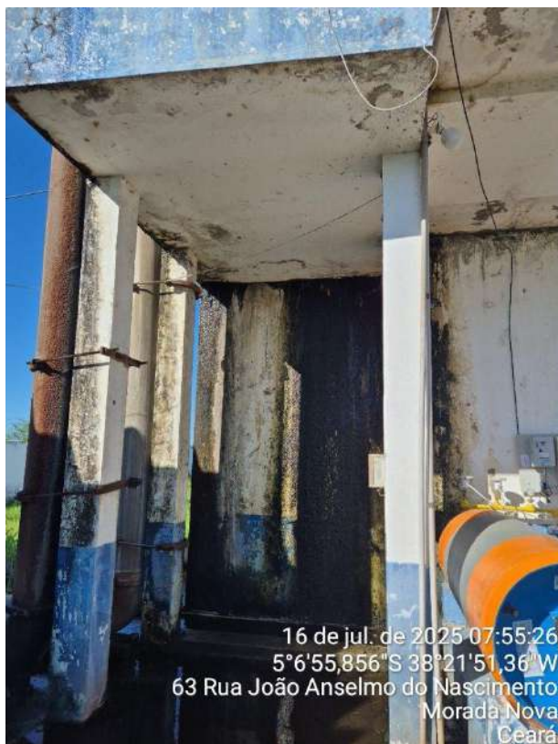
Foto 144 - Vazamento na entrada da ETA.
