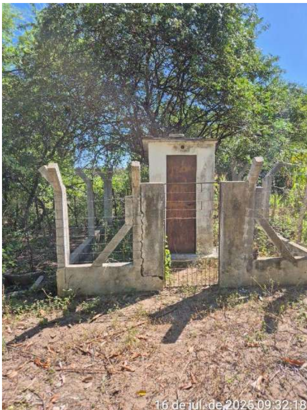
Foto 238 - Portão quebrado, muro com rachaduras e porta oxidada.
