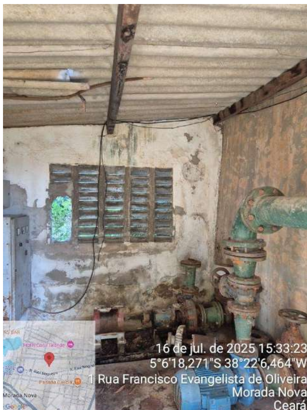
Foto 162 - Estruturas quebradas e oxidadas.
