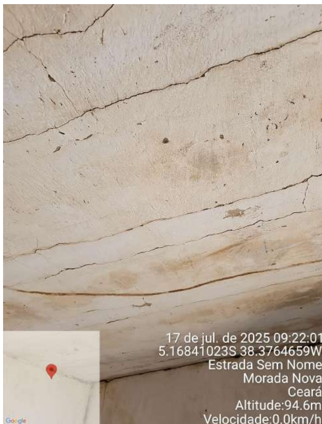
Foto 190 - Rachaduras e vazamentos no RAP.
