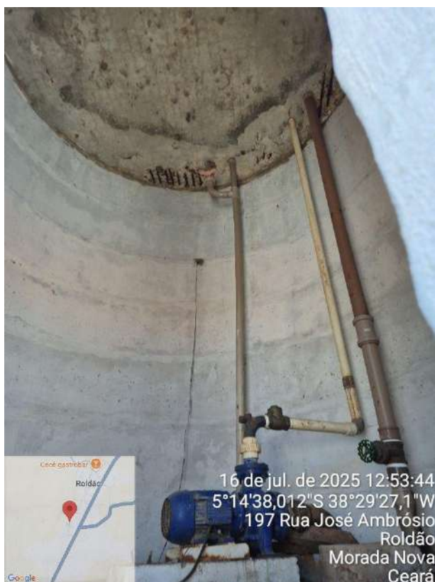
Foto 221 - Base da bomba e conexões oxidadas.
