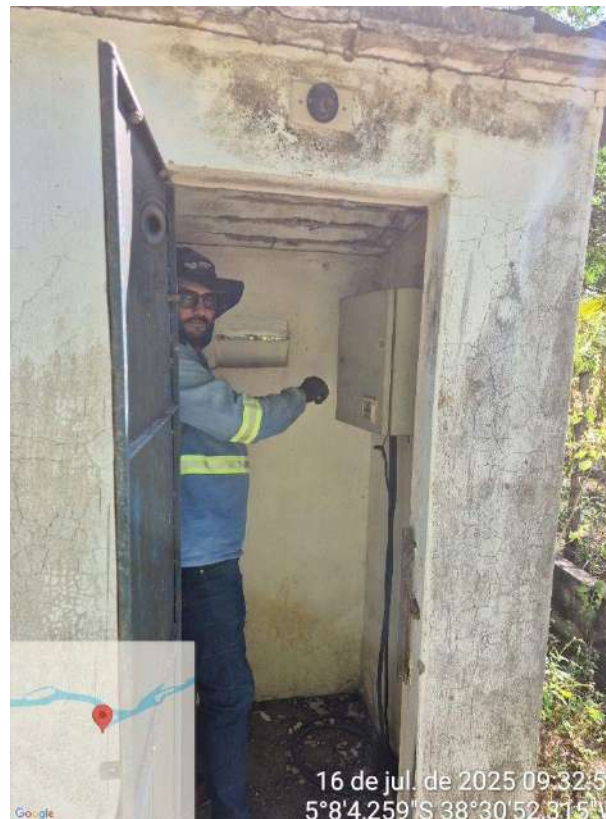
Foto 239 - Armadura exposta e pintura desgastada.
