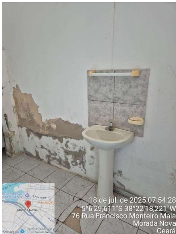
Foto 77 - Banheiro Feminino: parede desgastada, piso quebrado com risco de acidentes.
