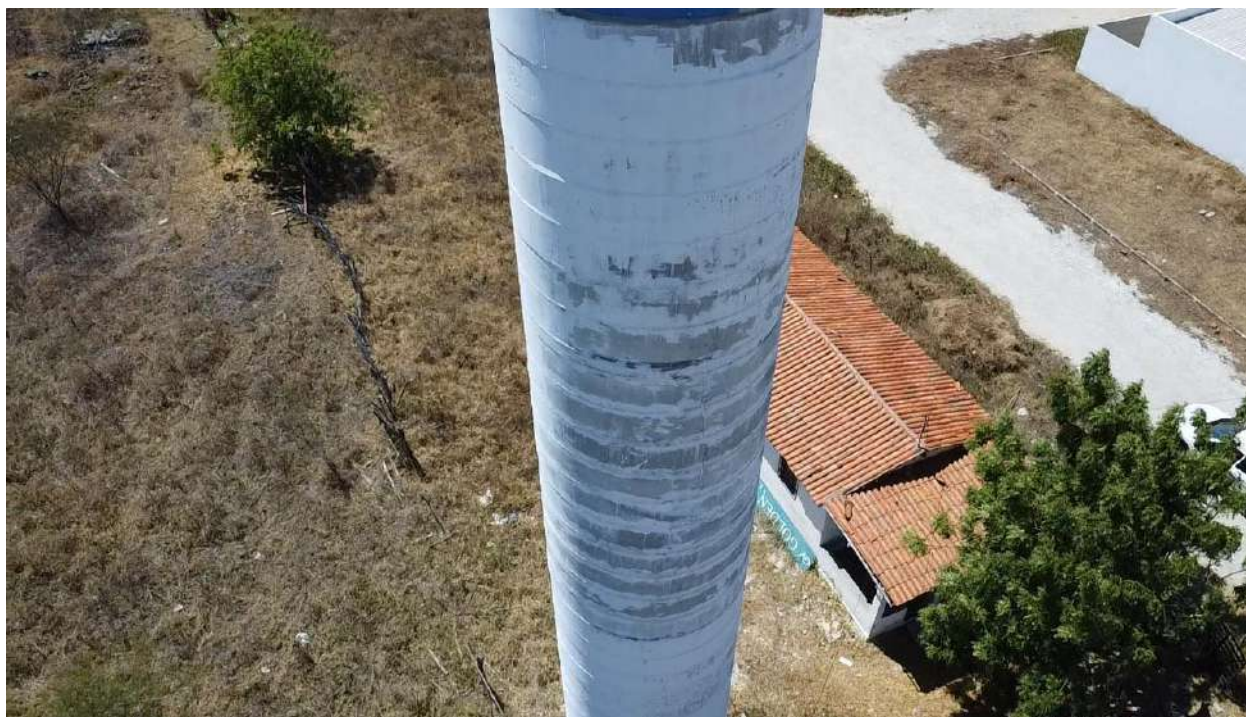
Foto 247 - REL com pintura desgastada.
