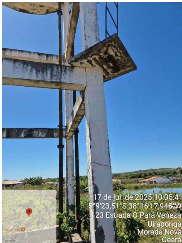
Foto 230 - REL com armadura exposta.
