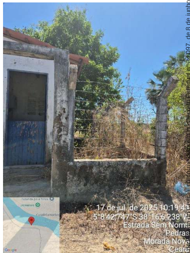
Foto 226 - Muro de proteção com pintura desgastada.
