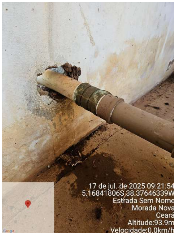
Foto 186 - Vazamento na tubulação.
