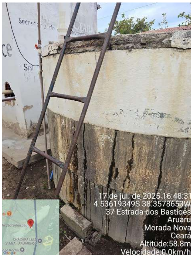
Foto 126 - Escada inadequada, RAP com vazamento e estrutura quebrada.
