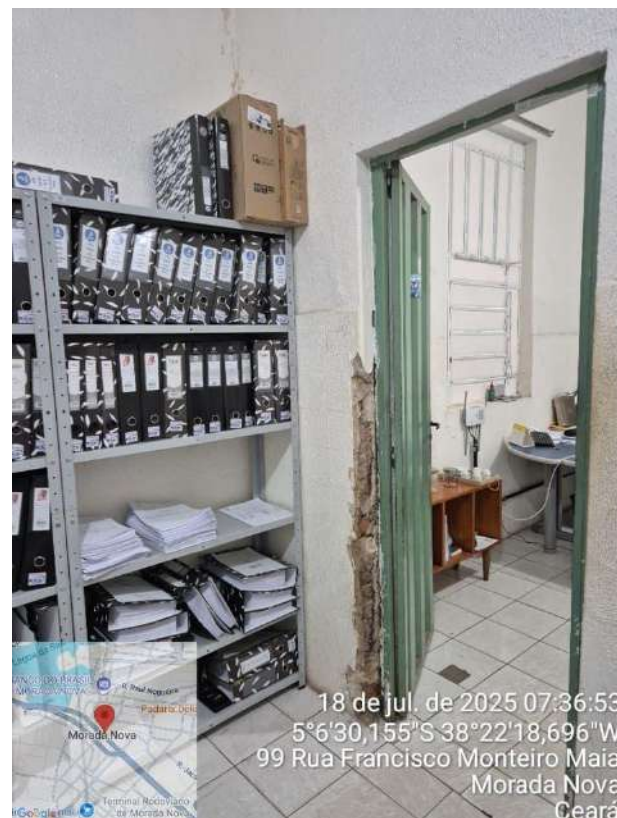
Foto 50 - Setor Financeiro: estrutura da porta com parede deteriorada.
