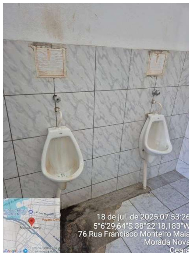
Foto 76 - Banheiro Masculino: piso inadequado, com risco de acidentes.
