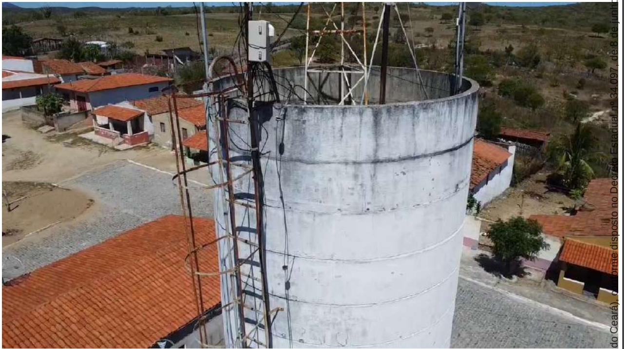
Foto 173 - Escada oxidada, fiação emaranhada na escada.
