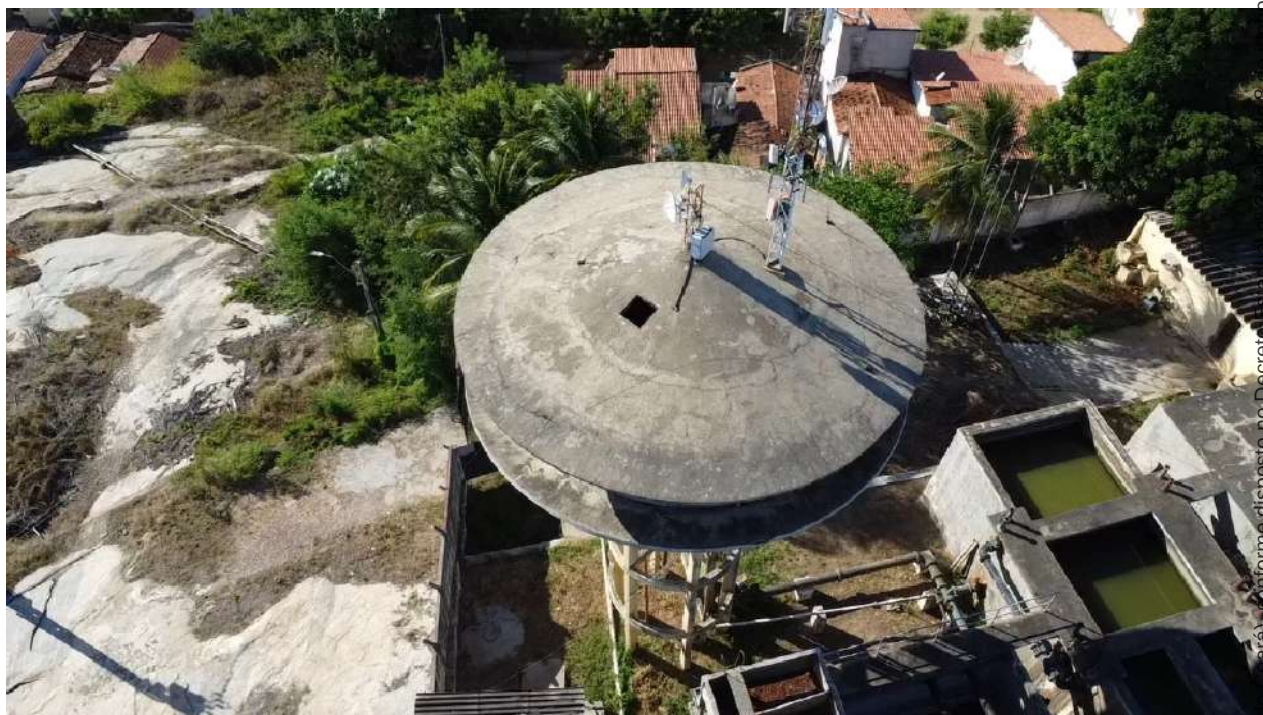
Foto 152 - Reservatório sem tampa.
