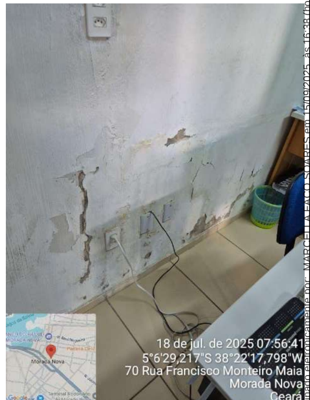
Foto 84 - Sala de arquivos: parede com infiltração.
