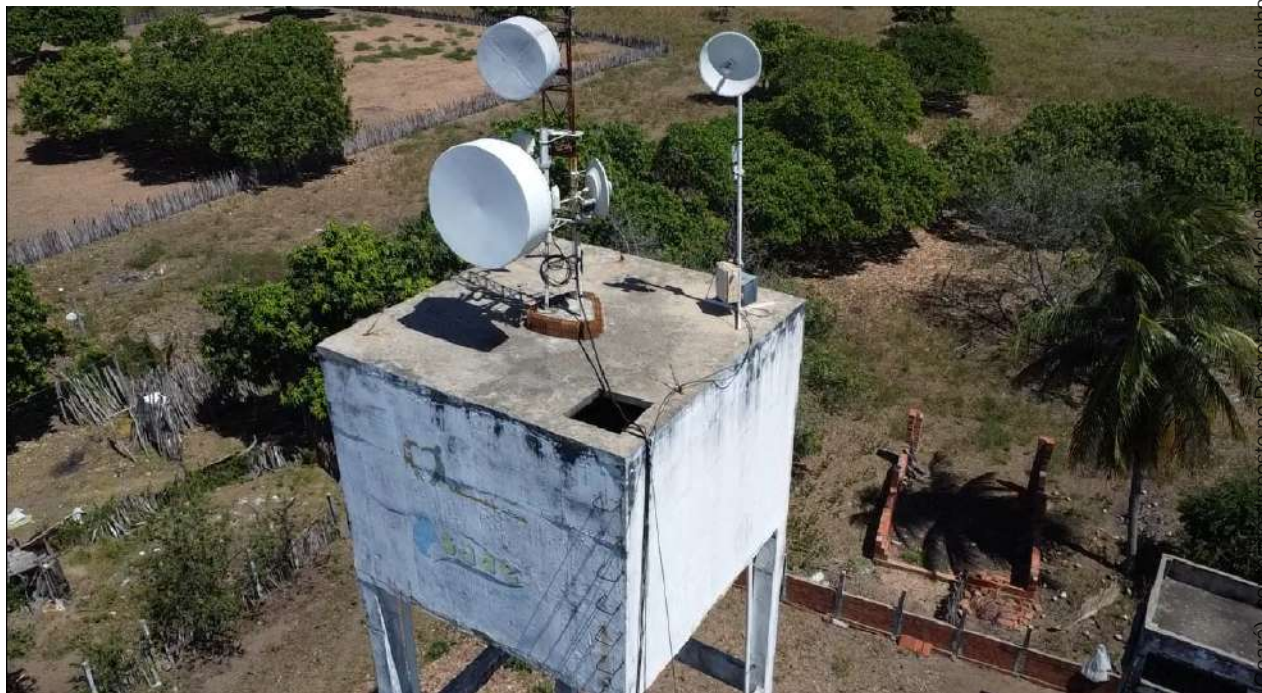
Foto 177 - Reservatório sem tampa, escada sem guarda corpo e oxidada.
