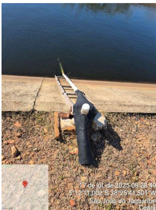
Foto 181 - Peças de suporte da escada oxidada.
