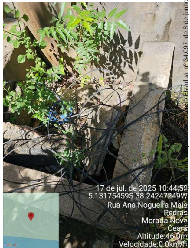
Foto 116 - ETA Pedras: fios descartados inadequadamente.
