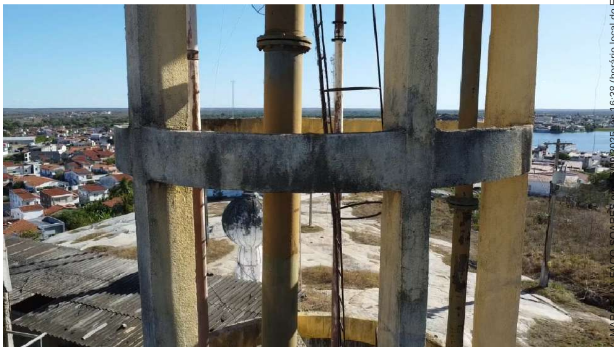
Foto 153 - Escada e tubulações oxidadas, pintura desgastada.
