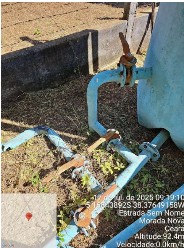
Foto 188 - Válvulas do filtro oxidadas.
