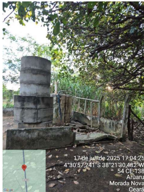
Foto 213 - Sem muro de proteção.
