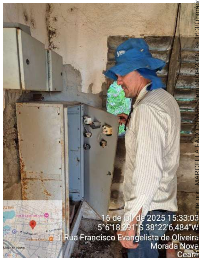
Foto 161 - Estruturas quebradas e oxidadas.
