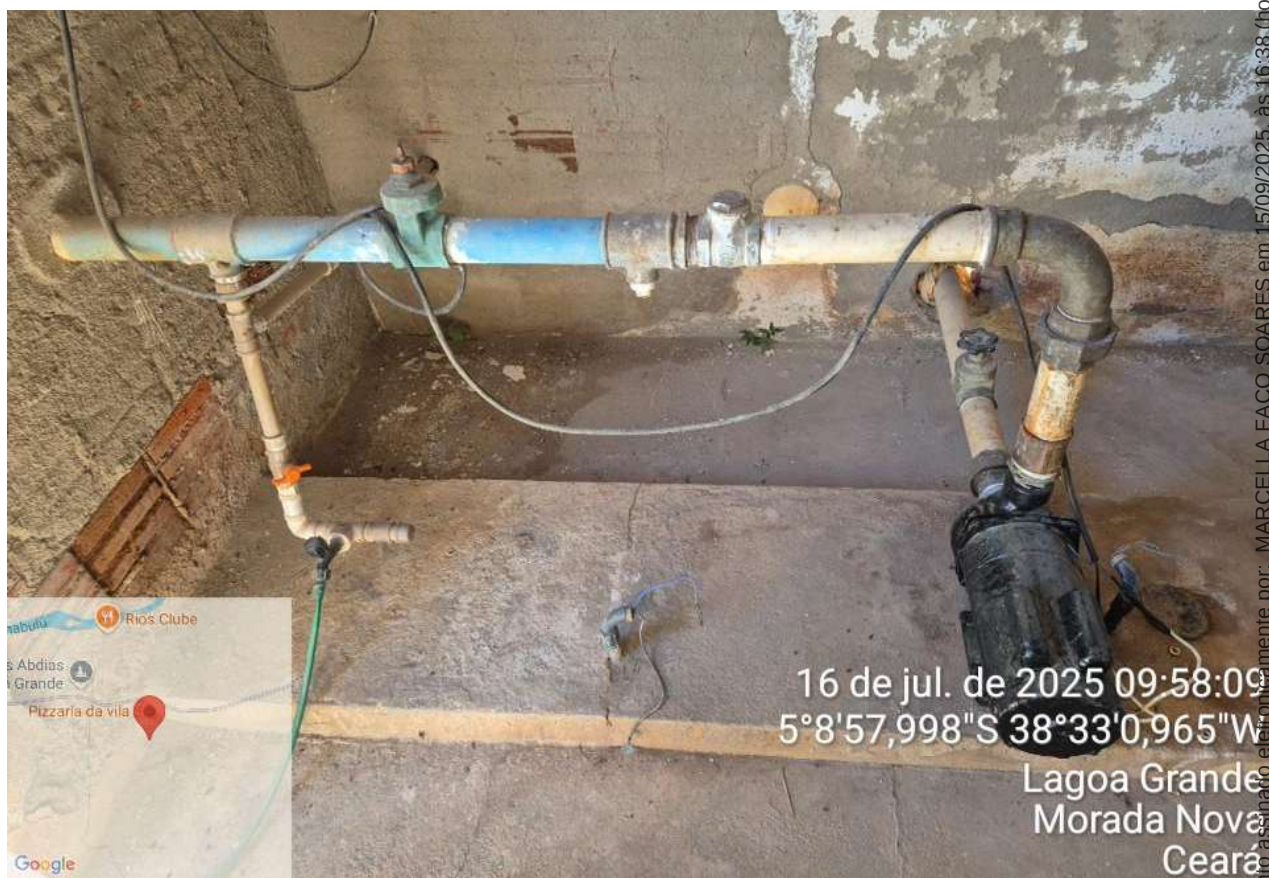
Foto 168 - Parede sem acabamento, tubulação antiga com parte oxidada.
