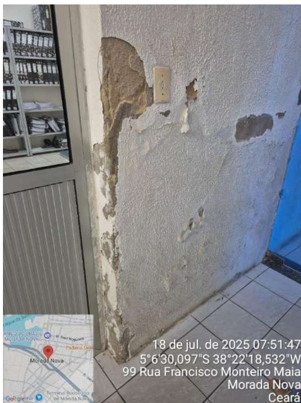
Foto 59 - Corredores: paredes deterioradas.
