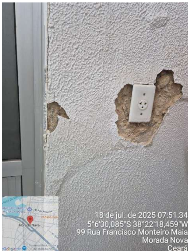
Foto 57 - Corredores: paredes deterioradas.
