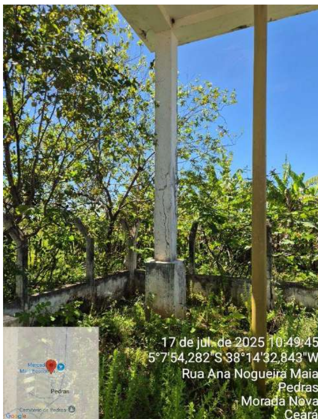
Foto 110 - ETA Pedras: rachaduras e armadura exposta na base da caixa.
