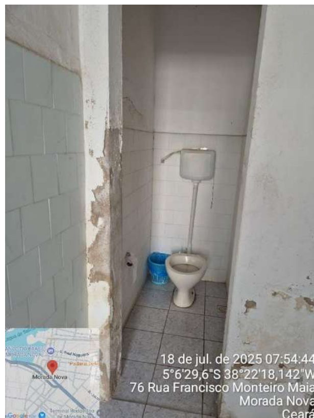
Foto 80 - Banheiro Feminino: parede desgastada.
