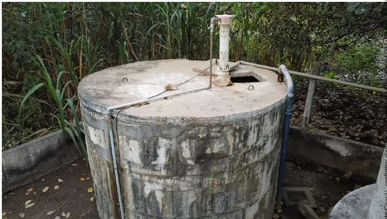
Foto 209 - RAP sem tampa, com rachaduras e pintura desgastada.
