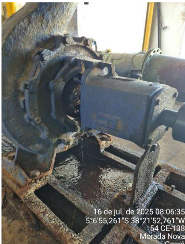
Foto 141 - EE-03: vazamento na bomba, estrutura oxidada.
