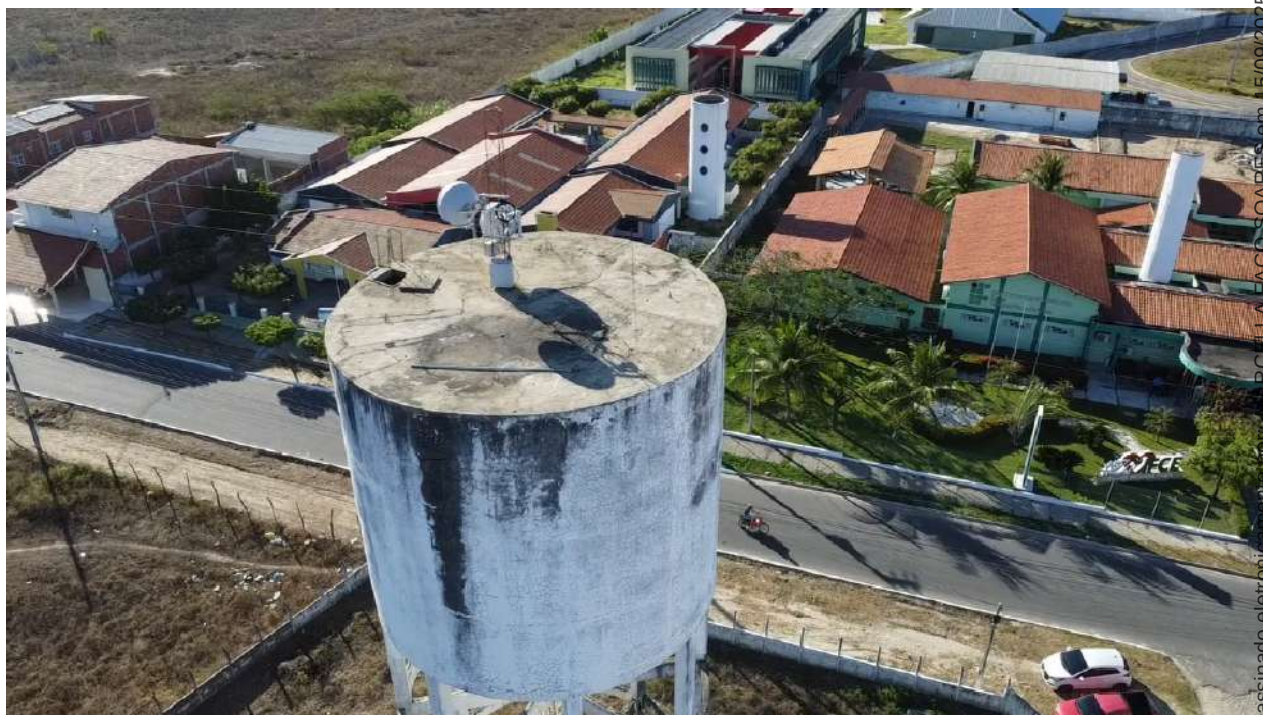
Foto 200 - REL 2: sem tampa, com pintura desgastada.
