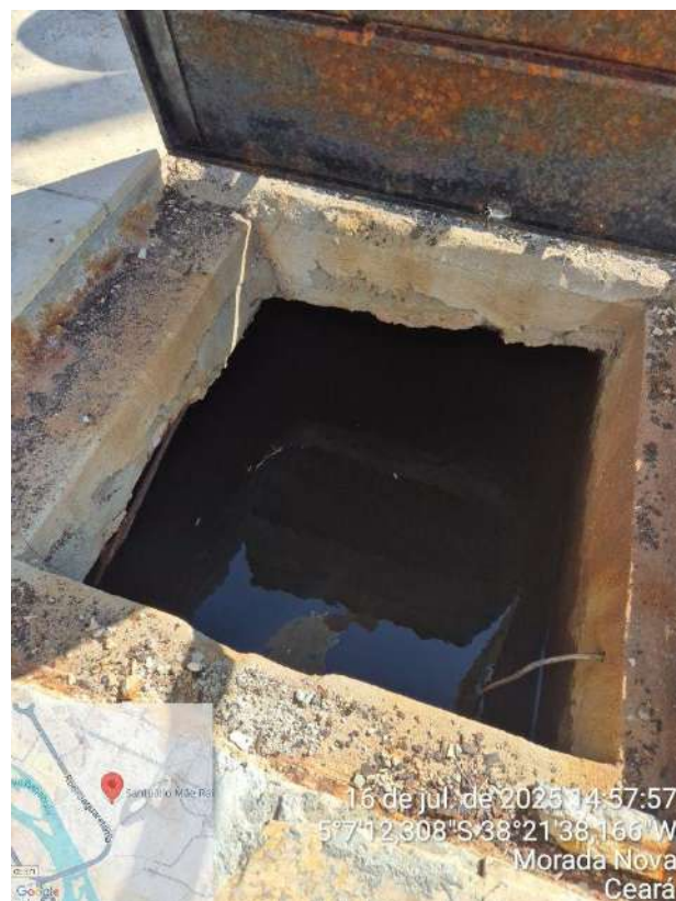
Foto 203 - Tampa oxidada, risco de contaminação.
