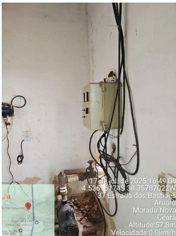
Foto 124 - Fiação sem eletrodutos, com tijolo quebrado no piso.
