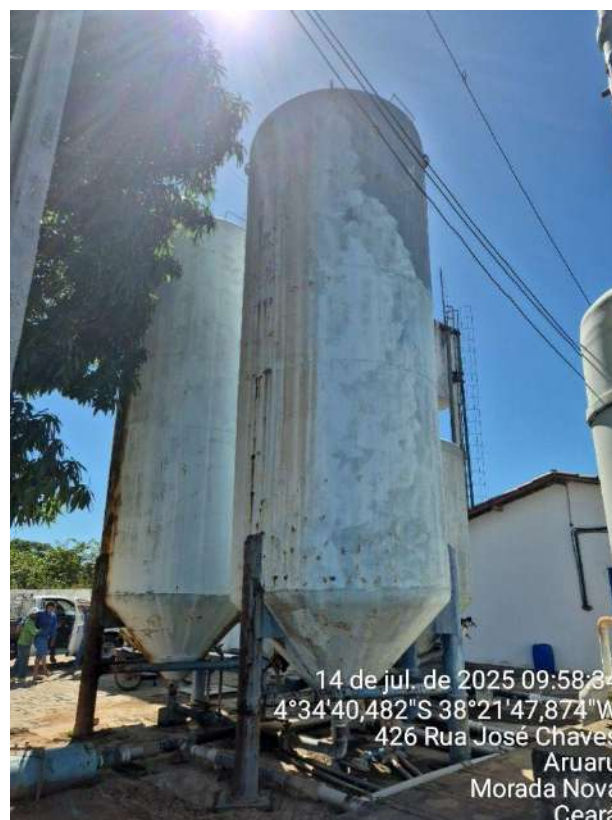
Foto 94 - ETA Aruaru: estrutura de suporte do filtro oxidada.
