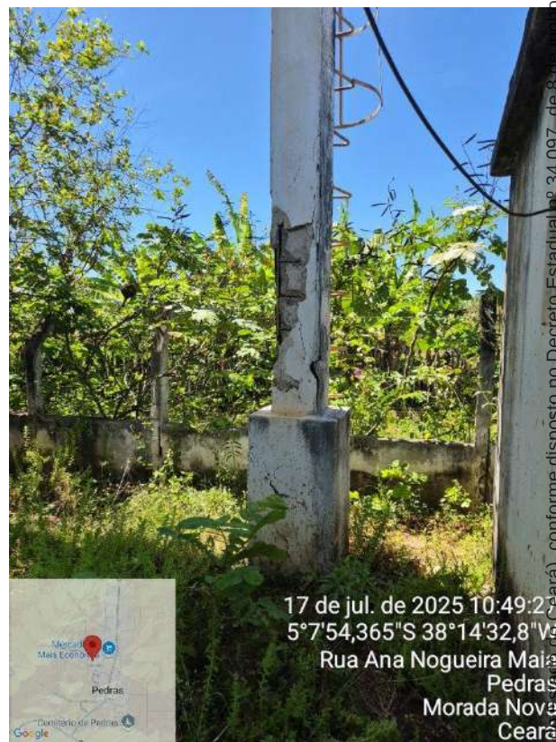
Foto 109 - ETA Pedras: rachaduras e armadura exposta na base da caixa.
