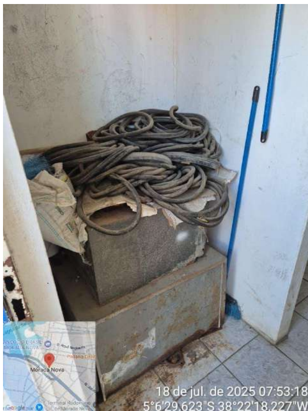
Foto 69 - Banheiro Masculino: acúmulo de material inadequado.
