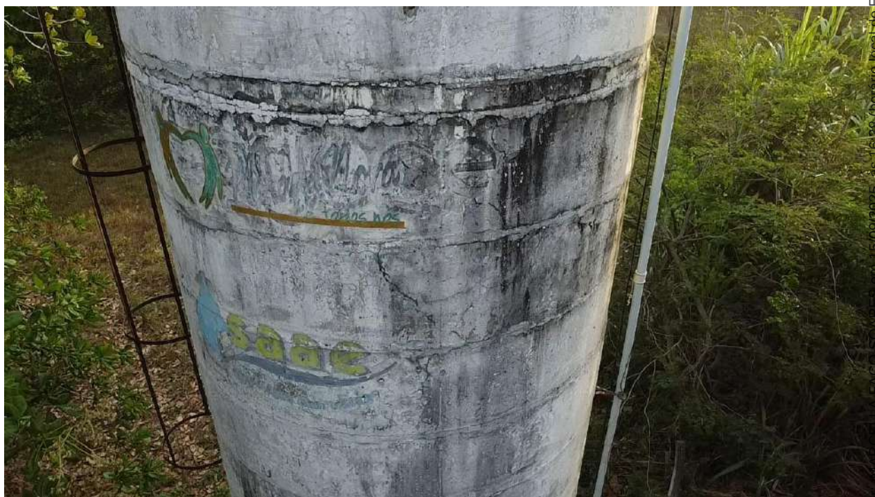
Foto 208 - REL com rachaduras e pintura desgastada.
