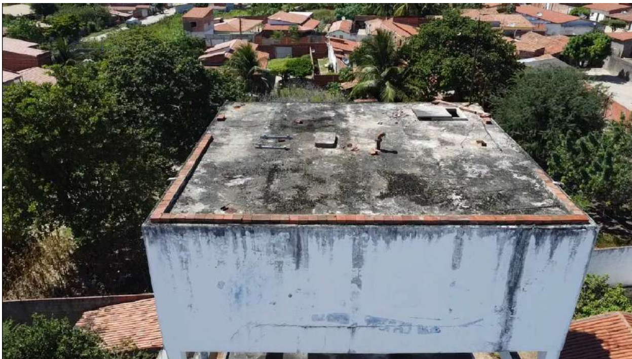
Foto 95 - ETA Aruaru: reservatório sem guarda corpo, com pintura desgastada, tubulação oxidada, tampa aberta.
