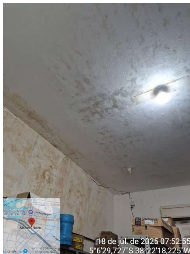
Foto 64 - Almoxarifado: mofo e infiltração nas paredes, tinta descascando.
