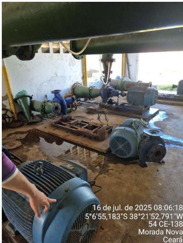
Foto 142 - EE-03: bomba desativada.
