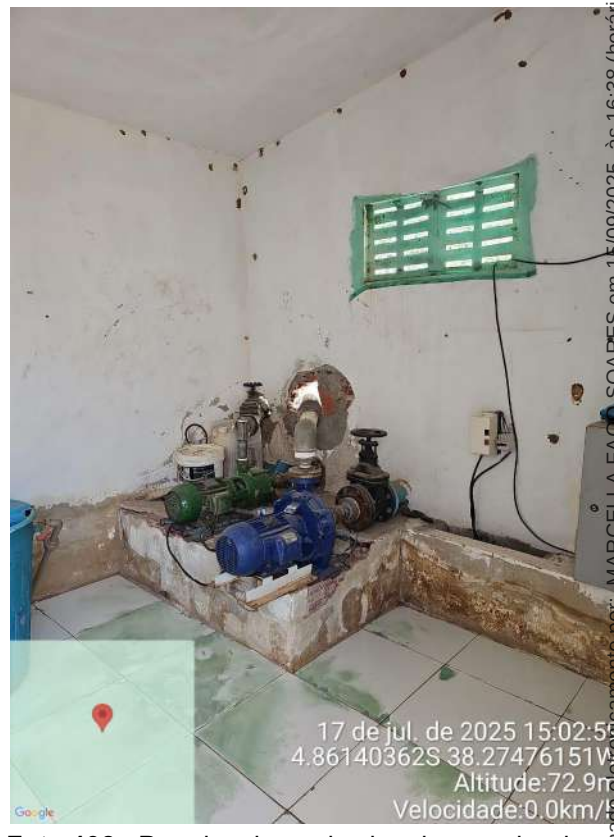
Foto 198 - Parede e base das bombas quebradas.
