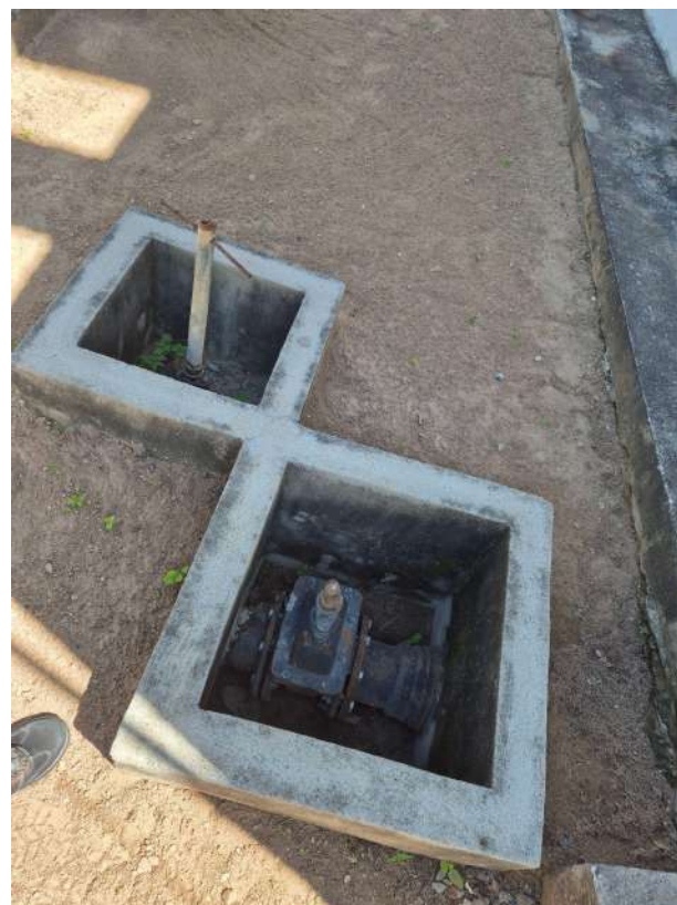
Foto 92 - ETA Aruaru: tubulação oxidada.
