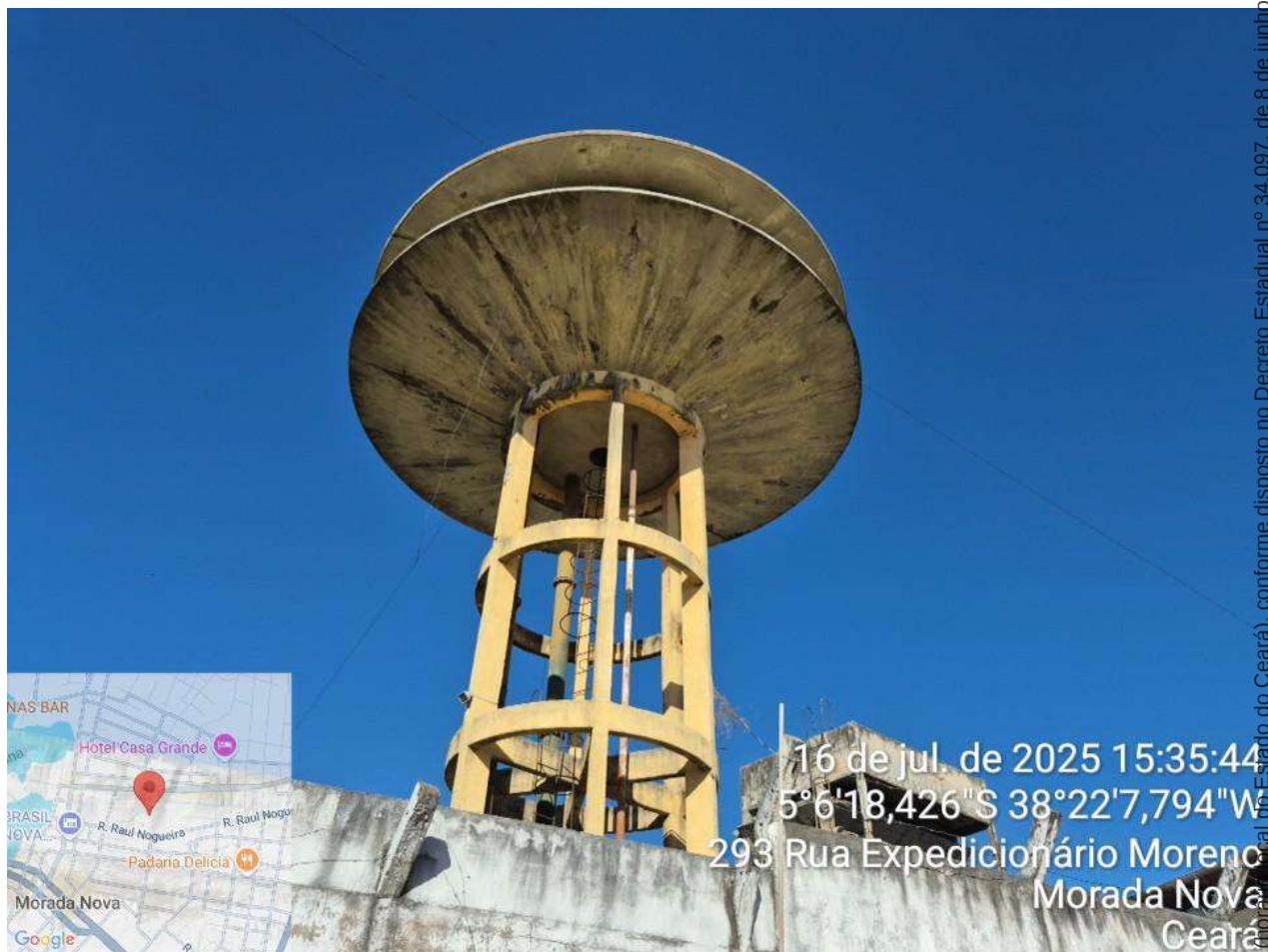
Foto 154 - Escada e tubulações oxidadas, pintura desgastada.
