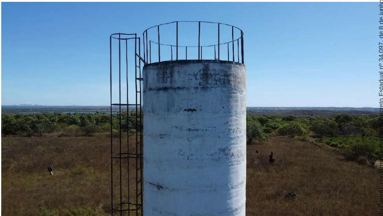
Foto 184 - Pintura desgastada, escada oxidada do REL.
