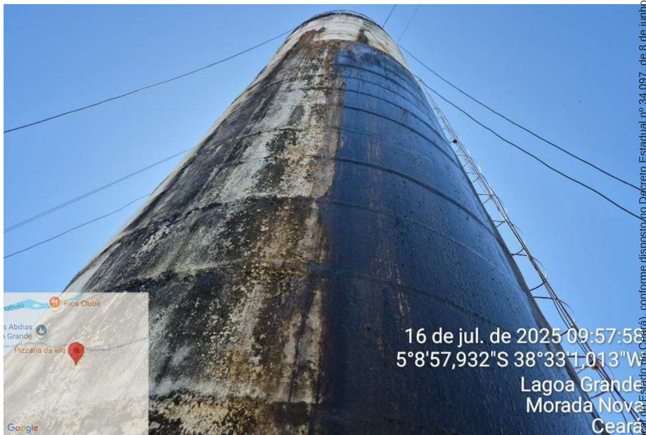
Foto 167 - Vazamento no reservatório.
