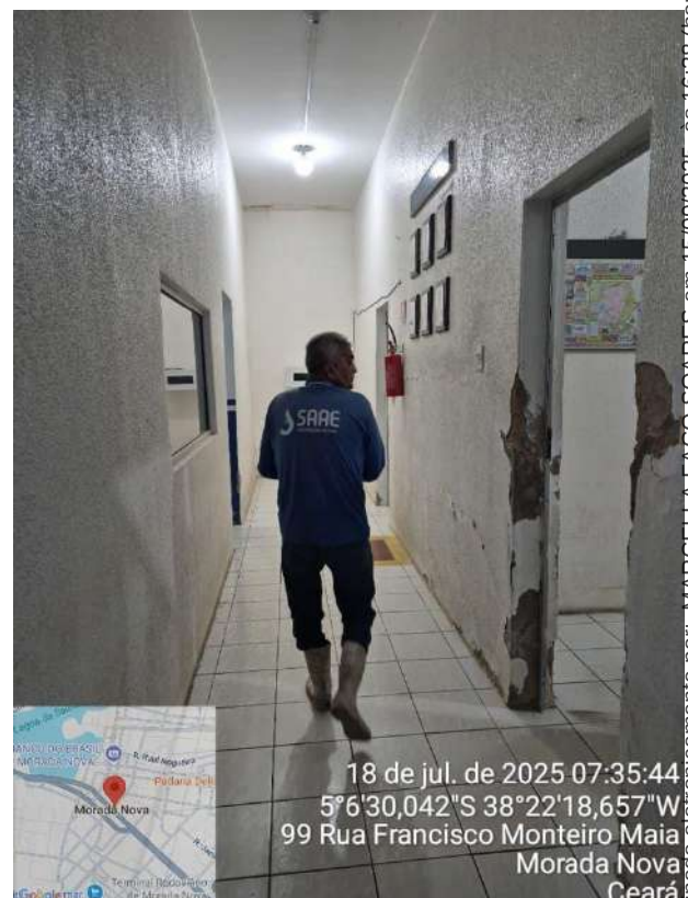
Foto 56 - Corredores: paredes deterioradas.
