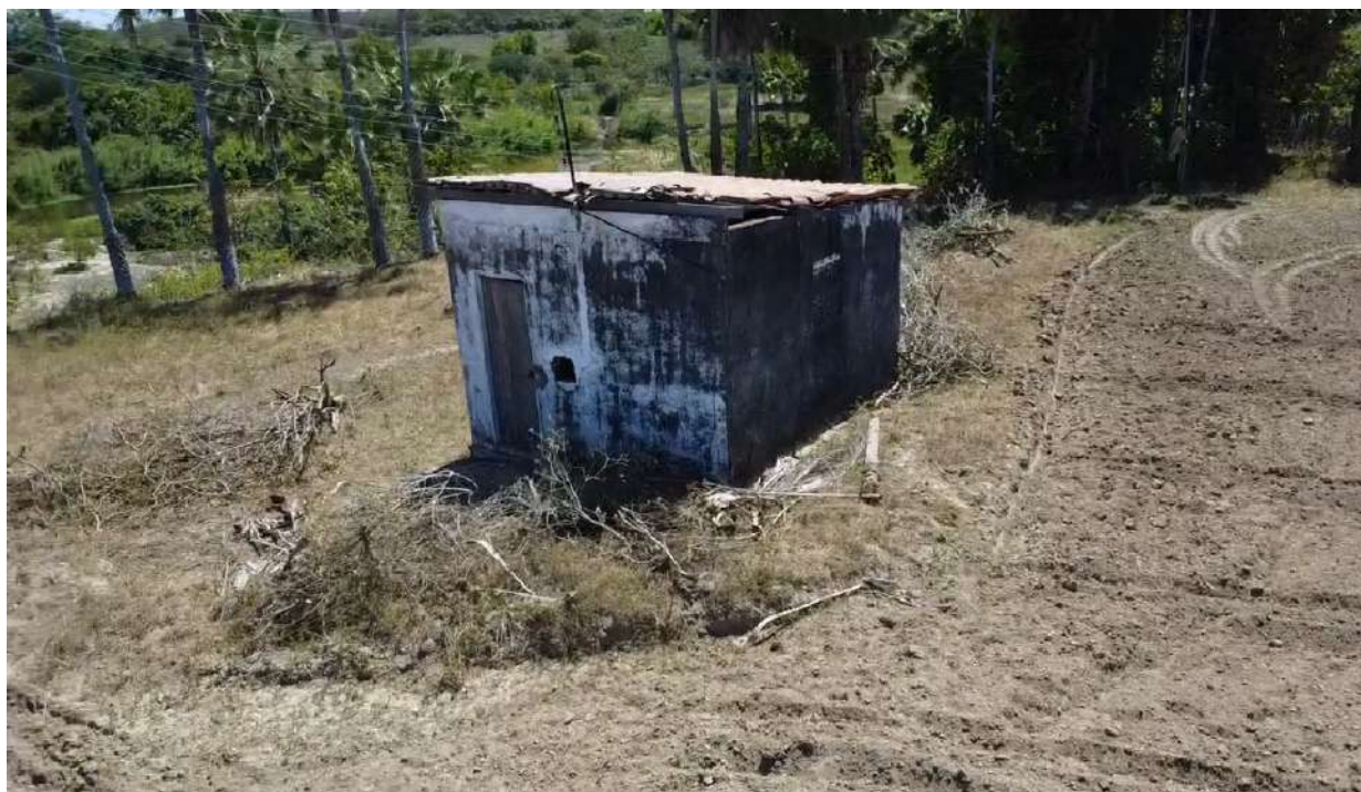
Foto 176 - Pintura desgastada, telhado quebrado.
