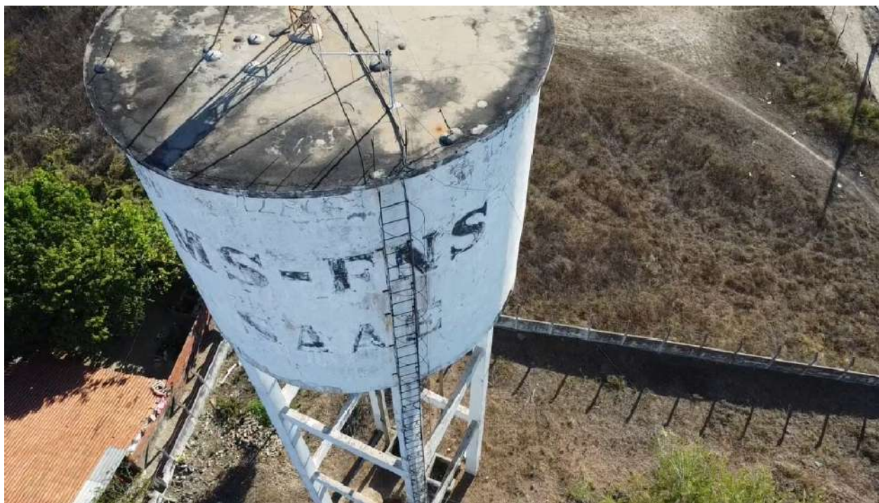
Foto 201 - REL 2: escada oxidada.
