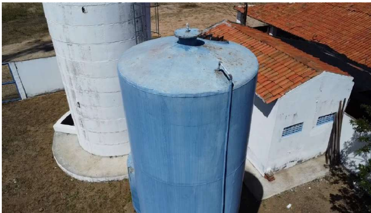
Foto 218 - Tampa do filtro oxidada.
