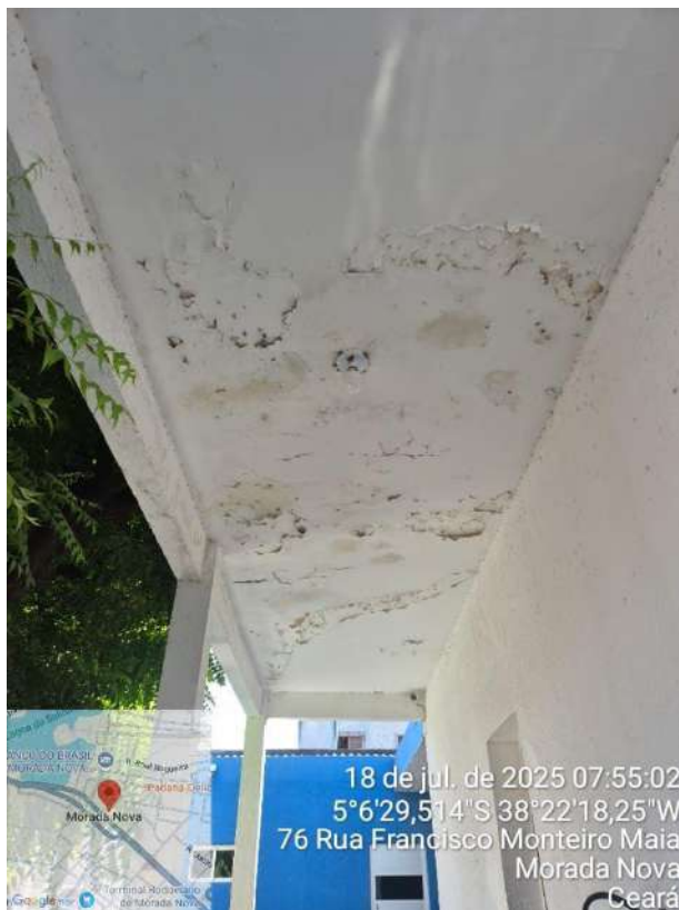
Foto 83 - Corredor externo: teto com pintura descascando e com infiltração.
