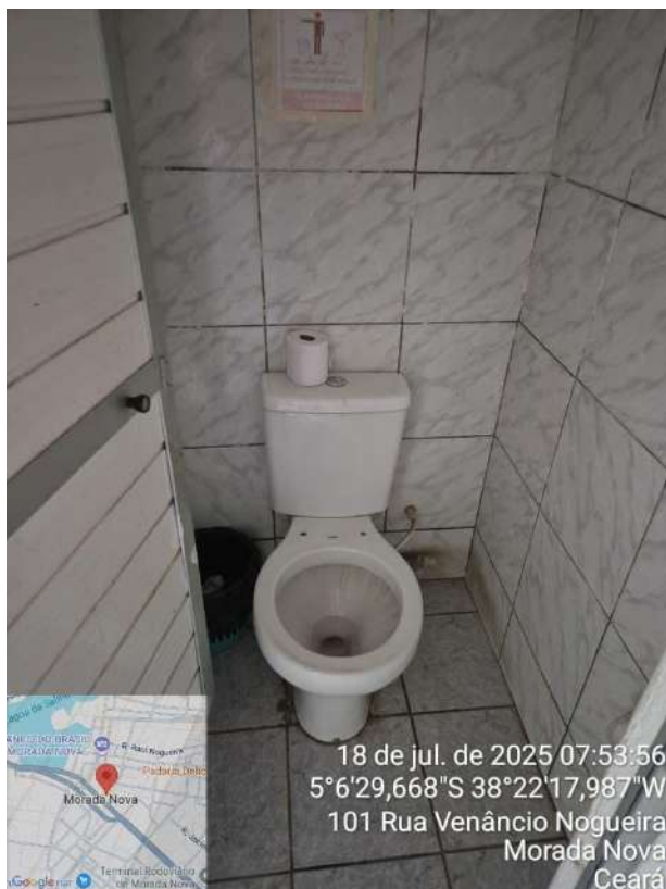
Foto 73 - Banheiro Masculino: apenas um boxe adequado.
