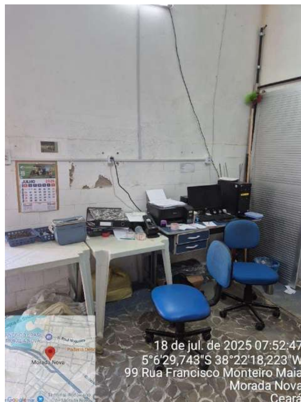
Foto 68 - Almojarifado: parede descascando, mesa de escritório inadequada.
