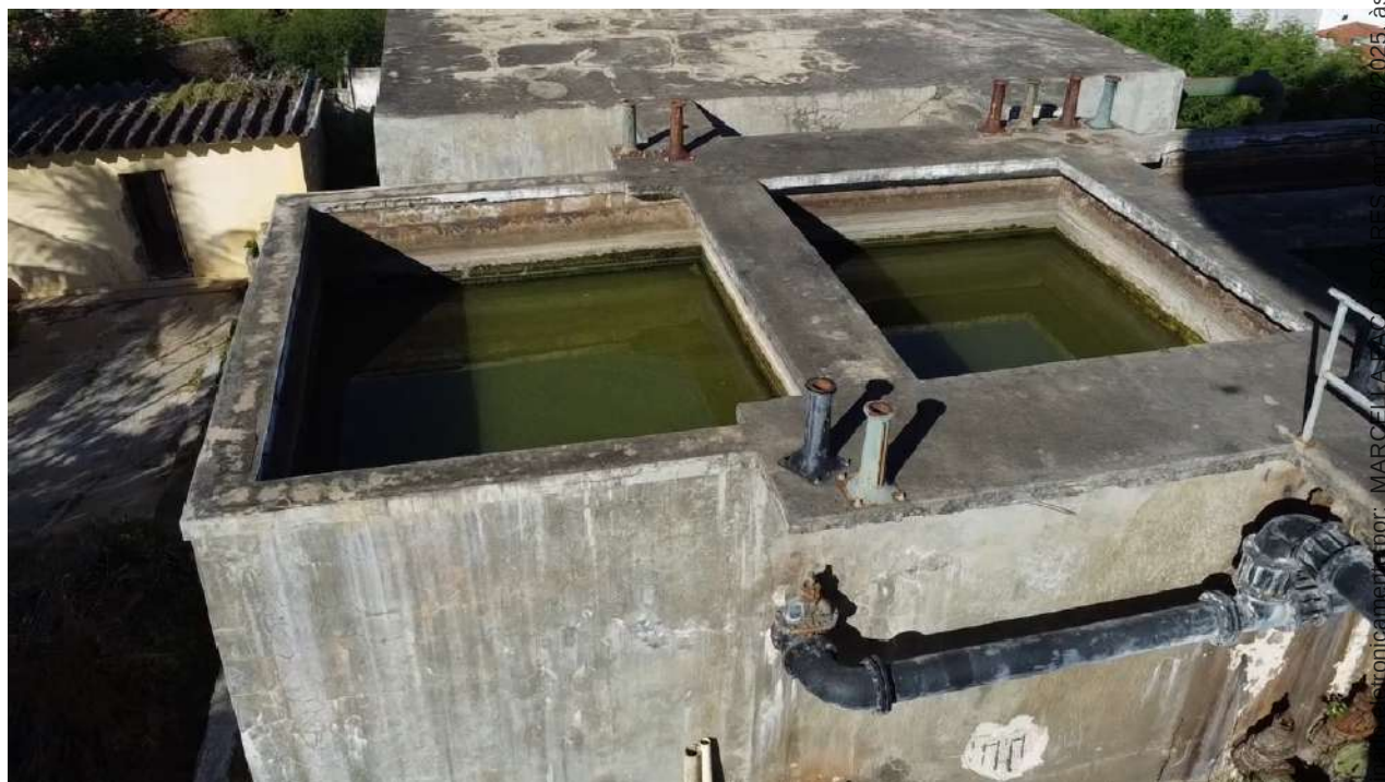
Foto 155 - Tubulações oxidadas, armadura exposta.
