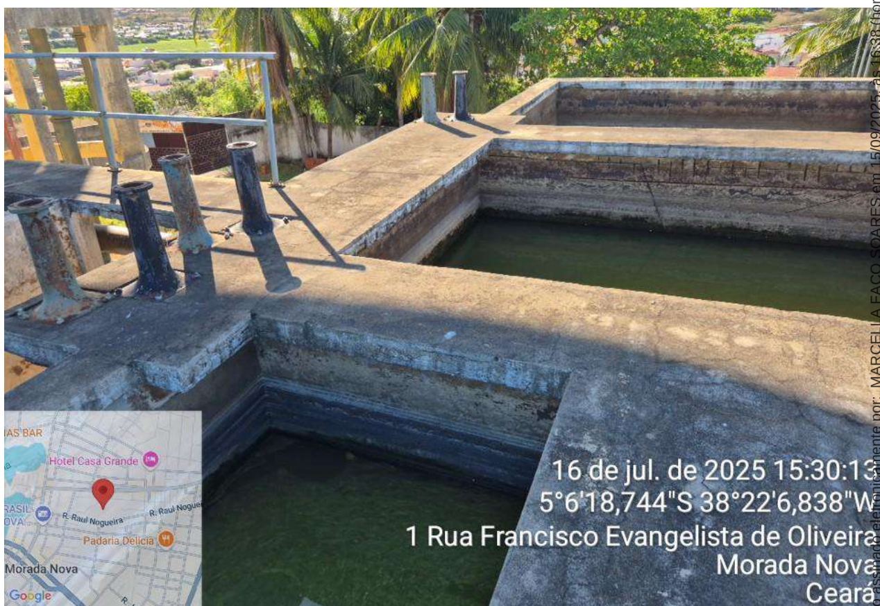
Foto 157 - Armadura exposta, tubulação oxidada.
