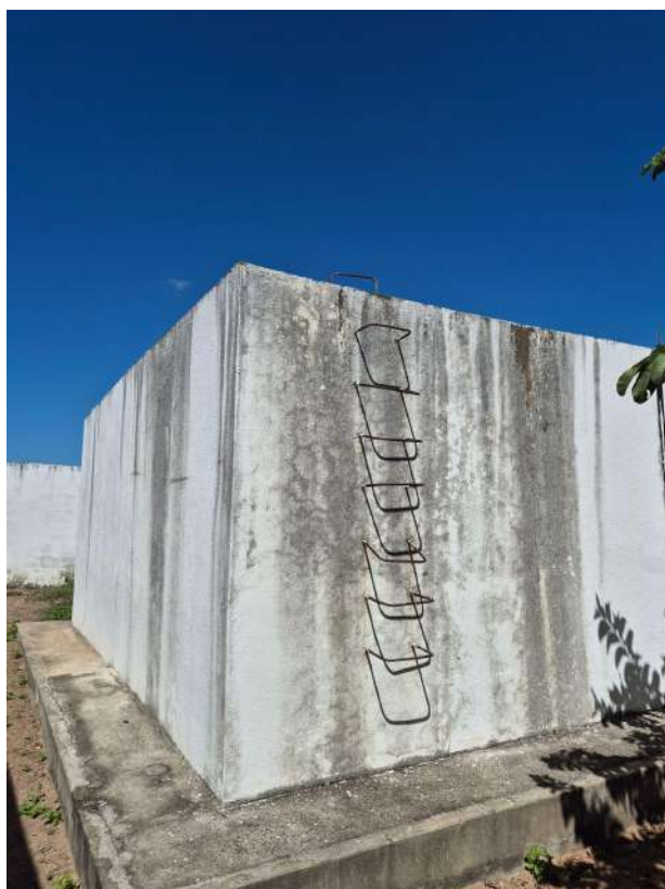
Foto 89 - ETA Aruaru: escada do reservatório oxidada e soltando e com formato inadequado.
