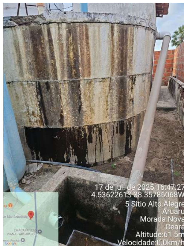
Foto 125 - RAP com vazamento e estrutura quebrada.
