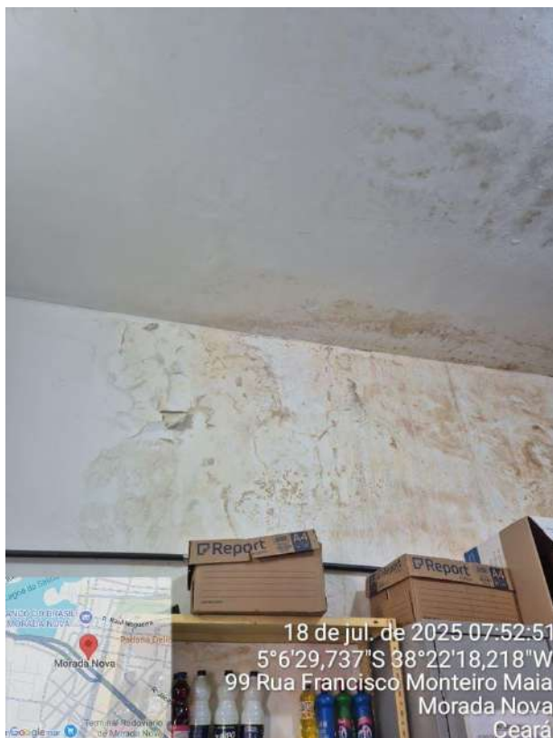
Foto 65 - Almojarifado: mofo e infiltração nas paredes, tinta descascando.
