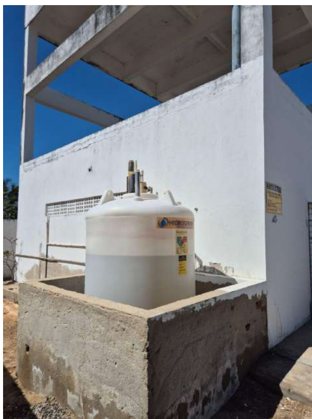
Foto 93 - ETA Aruaru: falta de pintura na contenção do produto.
