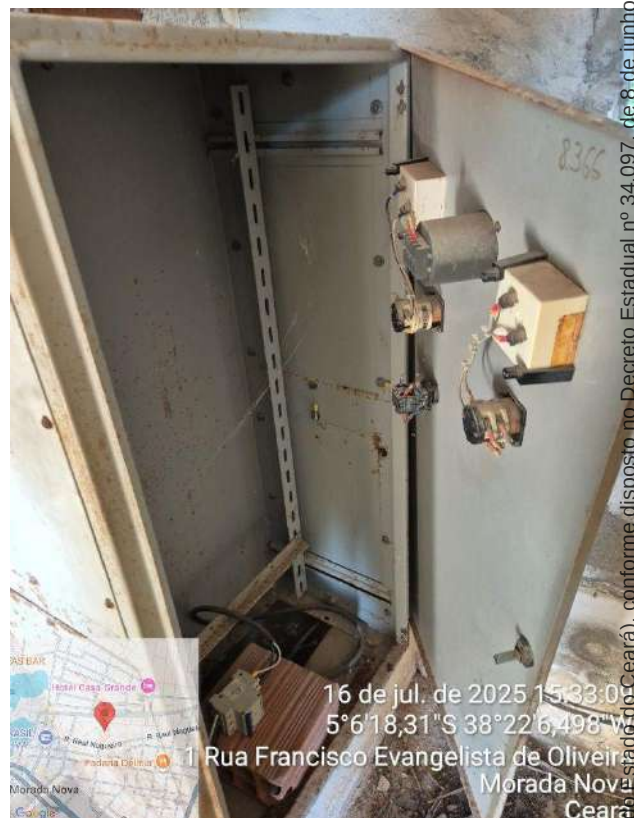
Foto 163 - Estruturas quebradas e oxidadas.
