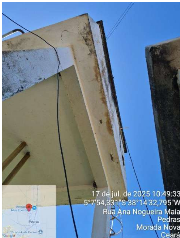
Foto 108 - ETA Pedras: reservatório com infiltração aparente.
