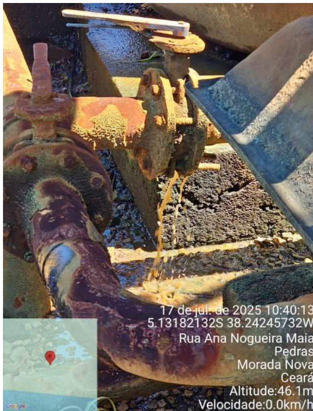
Foto 115 - ETA Pedras: vazamento na tubulação dos filtros.
