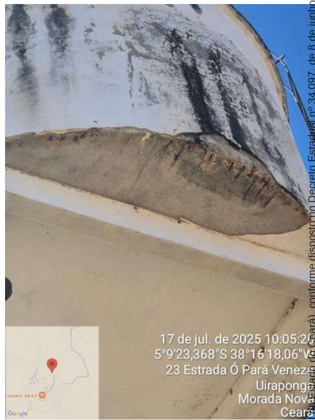
Foto 231 - REL com armadura exposta.
