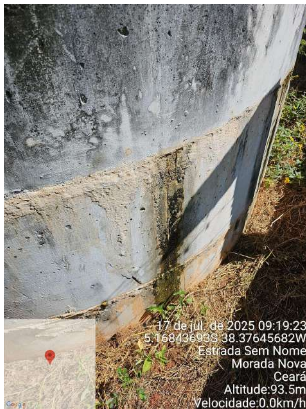
Foto 192 - Rachaduras e vazamentos no RAP.
