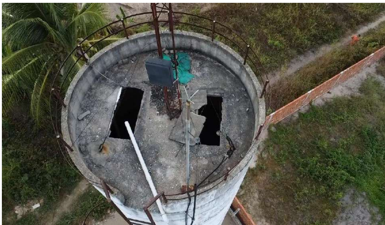
Foto 122 - Sem tampa, quebrada, com acúmulo de ferrugem na parte superior com risco de contaminação.
