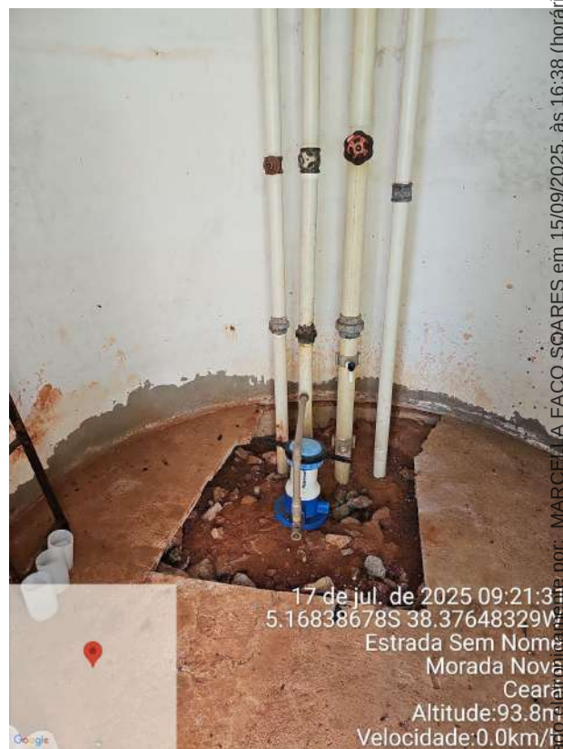
Foto 193 - Rachaduras e vazamentos no RAP.
