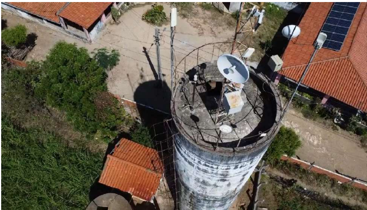
Foto 170 - Reservatório com tampa aberta e pintura desgastada.
