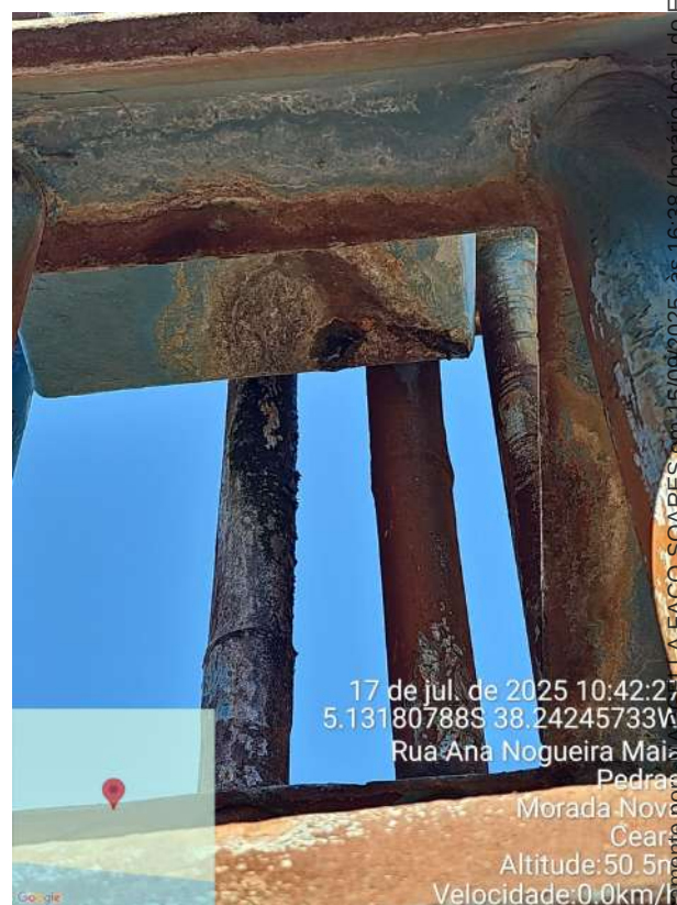
Foto 114 - ETA Pedras: vazamento no aerador.
