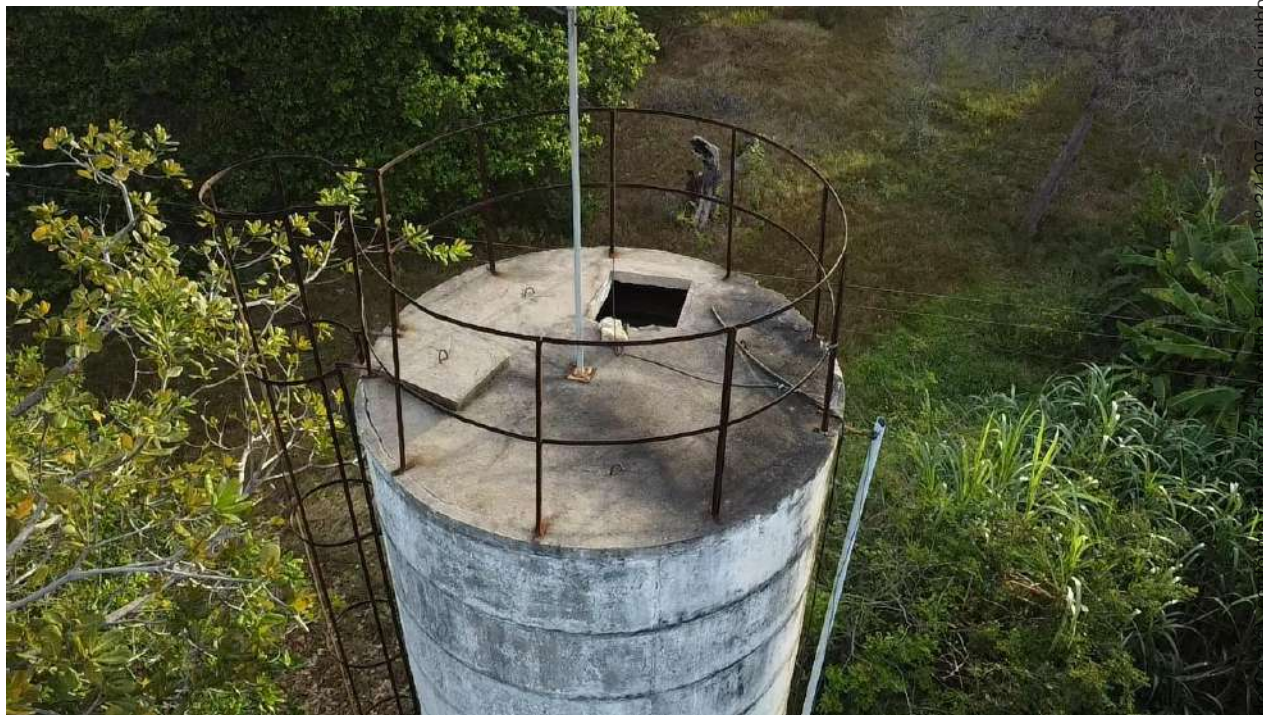
Foto 207 - REL sem tampa, escada e guarda corpo oxidados.
