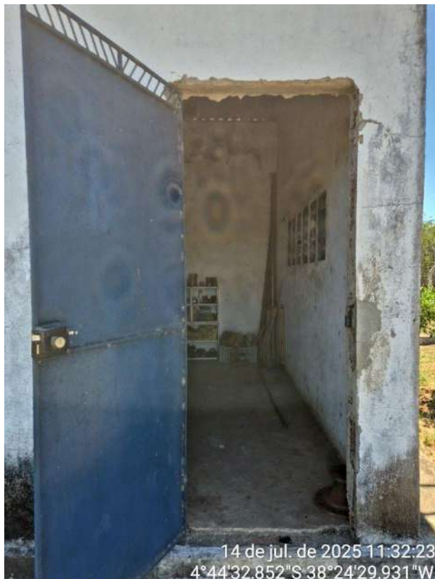
Foto 87 - Captação Lajedo: parede e pintura desgastadas.
