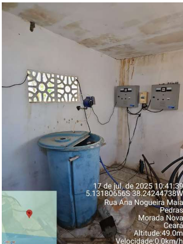
Foto 119 - ETA Pedras: sala do clorador com paredes e piso manchados.
