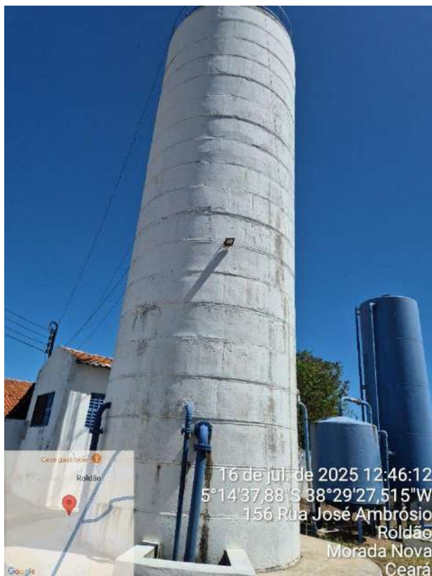
Foto 219 - Vazamento na tubulação.
