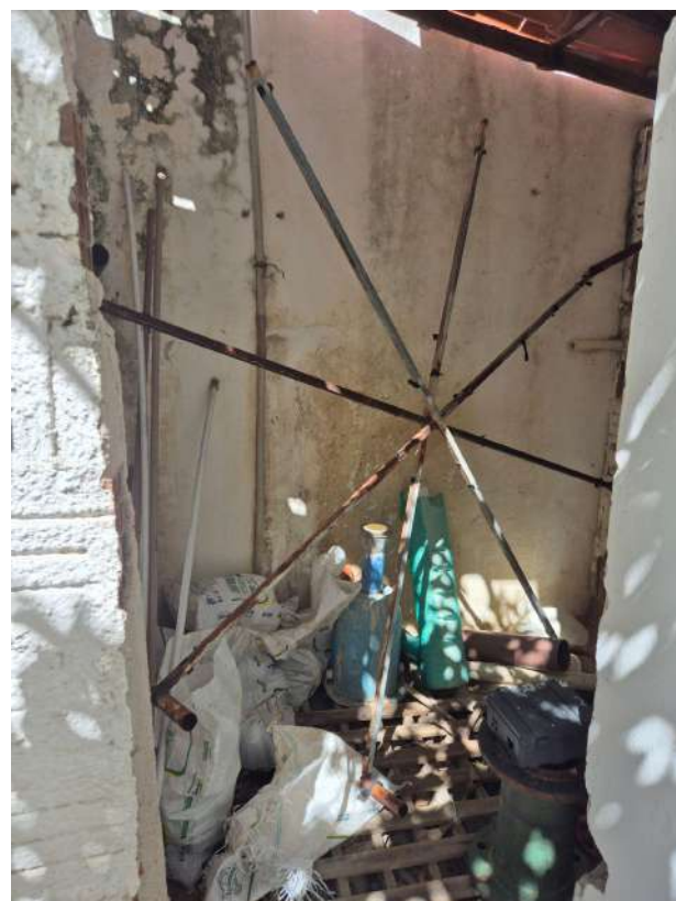
Foto 90 - ETA Aruaru: acúmulo de material de forma inadequada.
