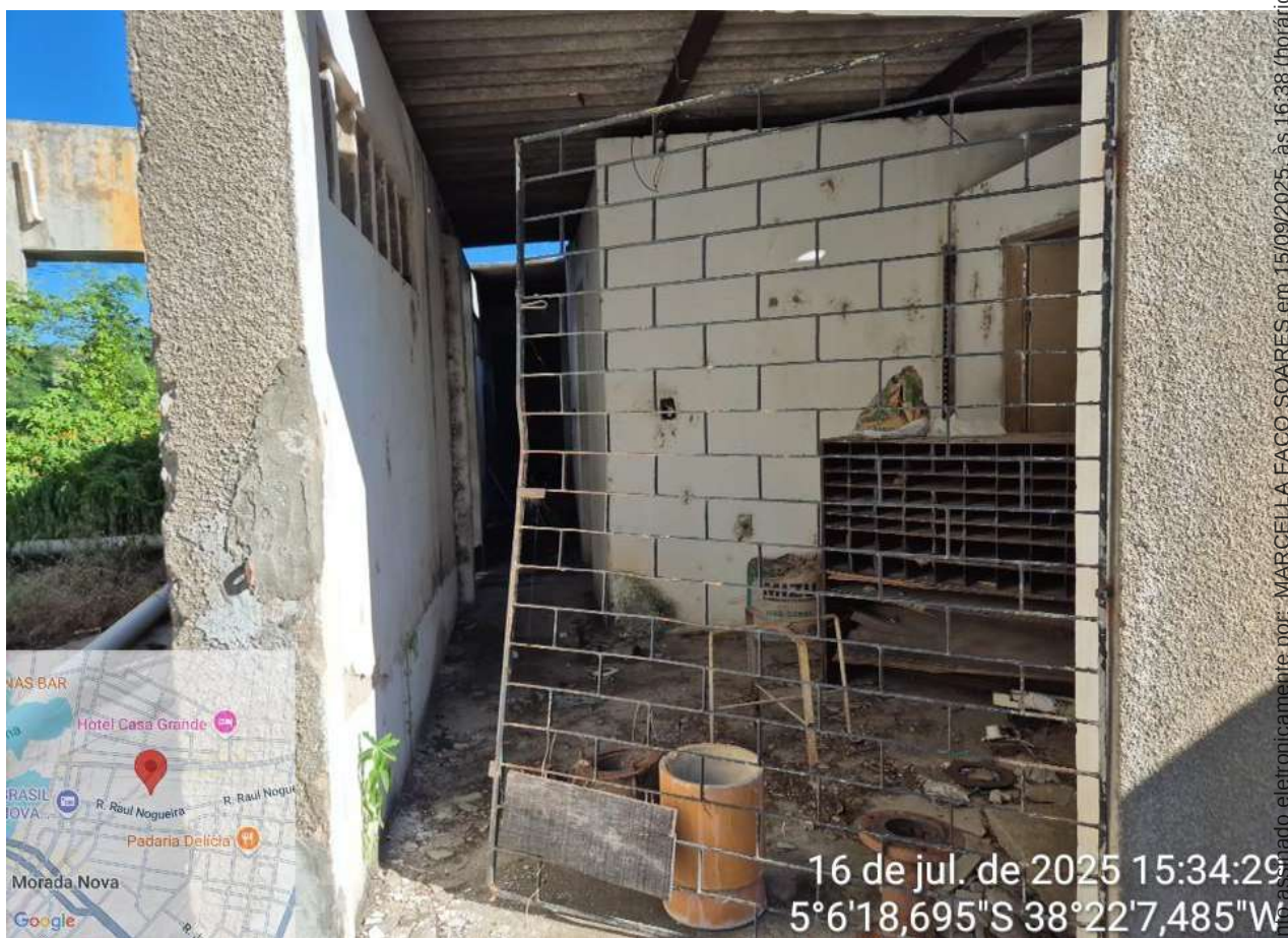
Foto 164 - Estruturas quebradas e oxidadas.
