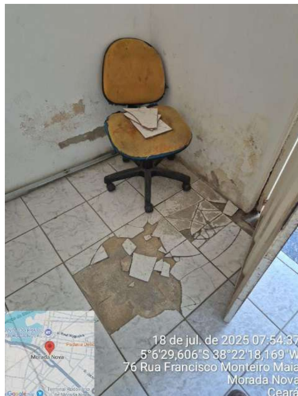
Foto 78 - Banheiro Feminino: parede desgastada, piso quebrado com risco de acidentes.
