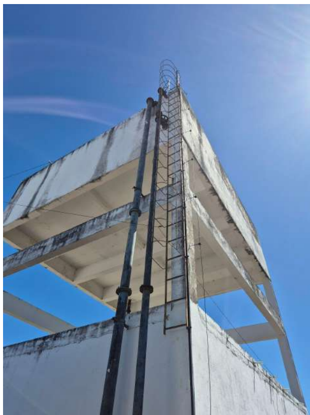
Foto 91 - ETA Aruaru: pintura do reservatório desgastada e escada oxidada.
