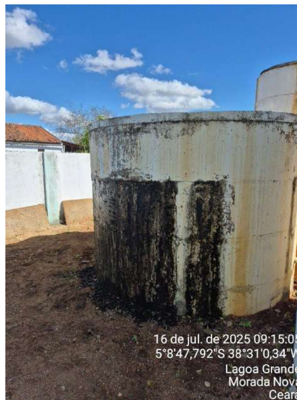
Foto 216 - RAP com vazamento aparente.
