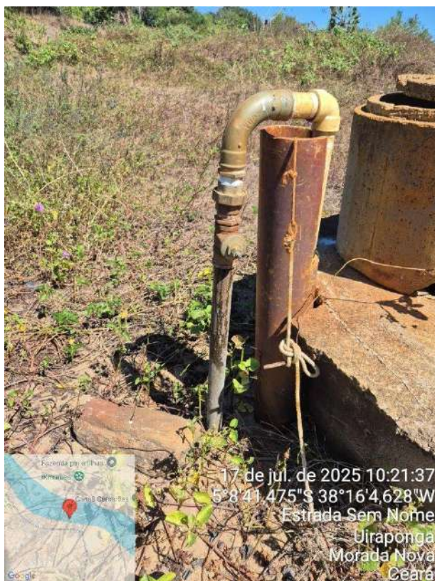
Foto 223 - Tubulação oxidada, vazamento na válvula.
