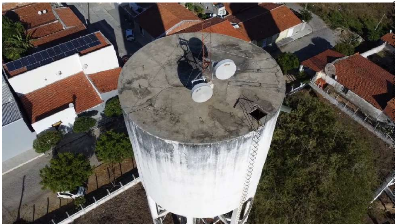
Foto 199 - REL 1: pintura desgastada, sem tampa, sem guarda corpo, escada oxidada.
