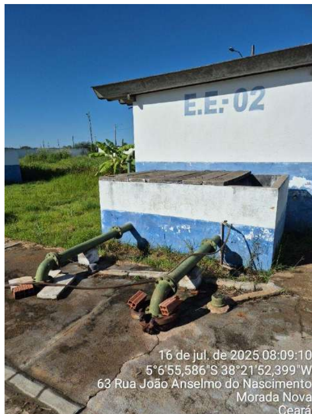
Foto 139 - EE-02: tijolos e placas de concreto em local irregular, base da tubulação oxidada e quebrada.
