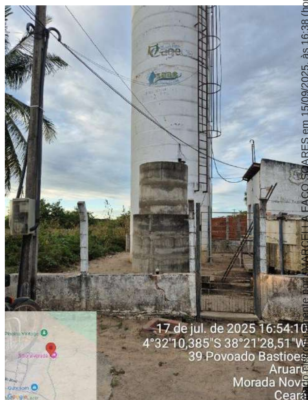
Foto 129 - ETA sem proteção (murada caída).
