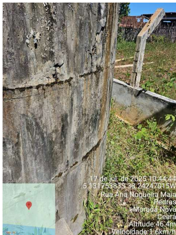
Foto 117 - ETA Pedras: reservatório com armadura exposta.
