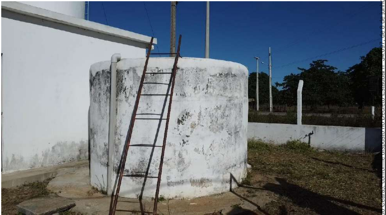
Foto 183 - RAP com pintura desgastada e sem escada adequada.
