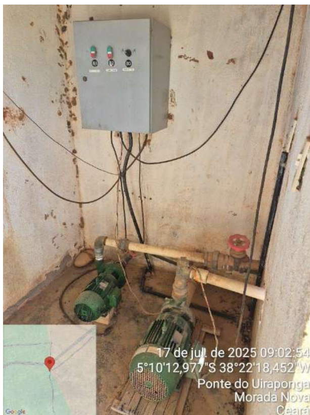
Foto 134 - Fiação sem eletrodutos.
