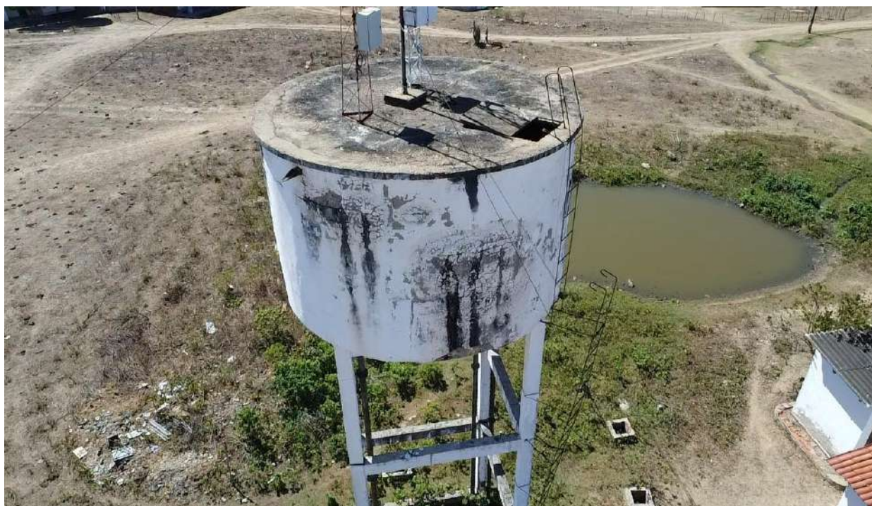
Foto 227 - REL com pintura desgastada, escada oxidada e sem guarda corpo, sem tampa.
