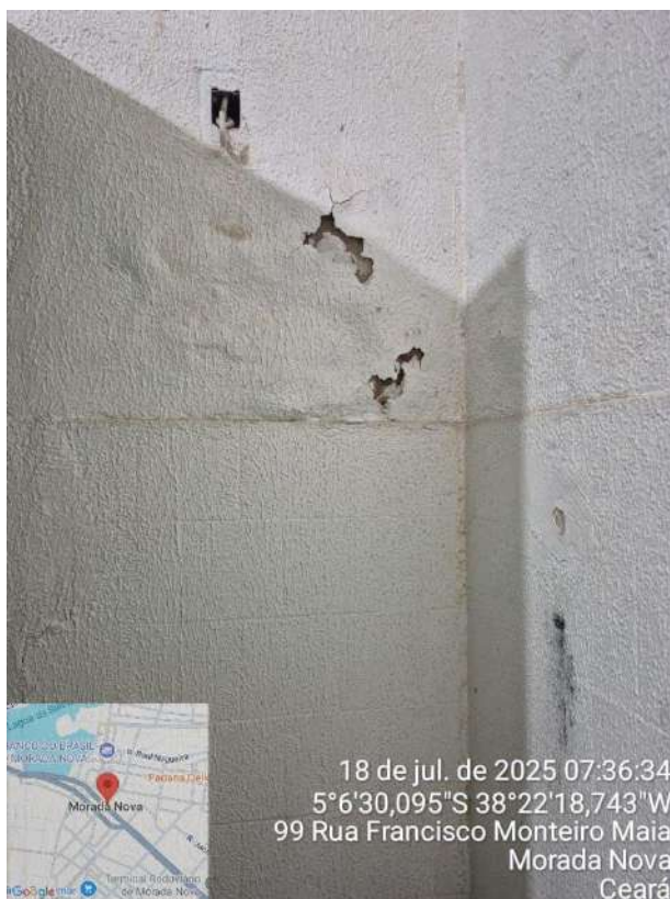
Foto 55 - Corredores: parede descascada.
