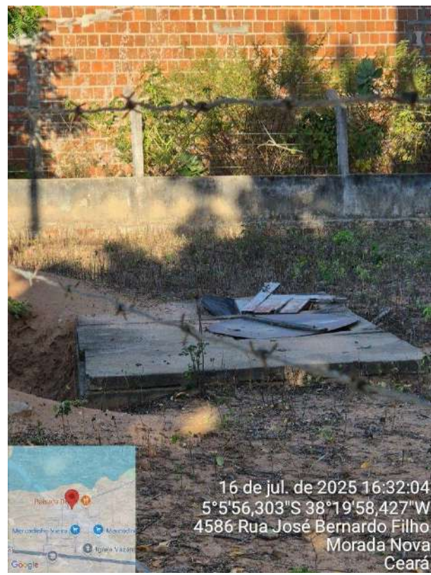
Foto 245 - Tampa sem fechamento adequado.
