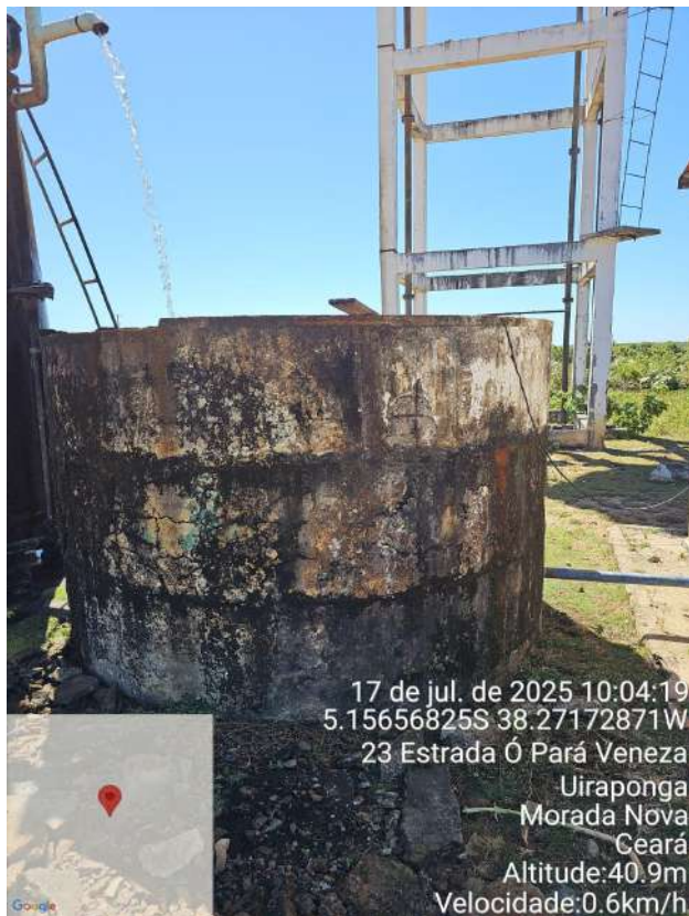
Foto 234 - RAP com armadura exposta.
