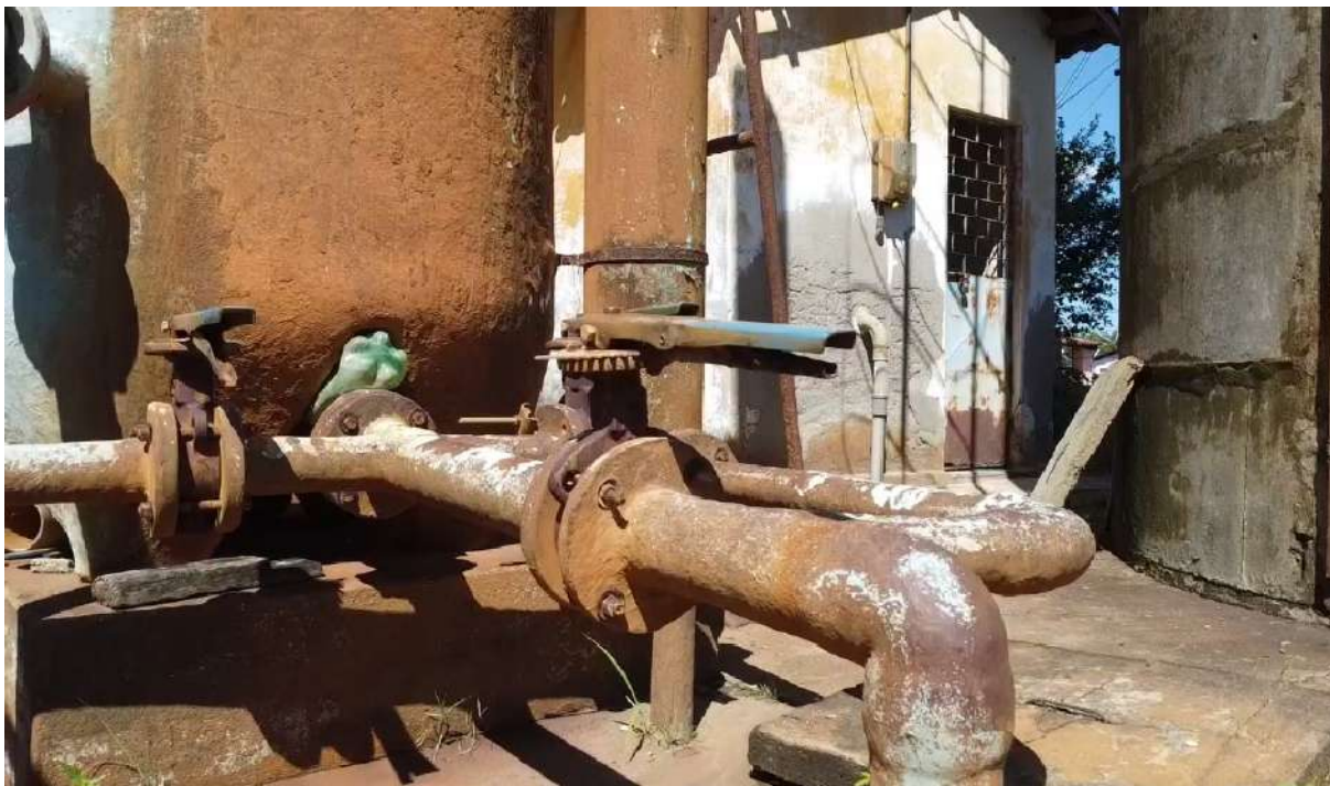
Foto 169 - Filtro e tubulações oxidadas.
