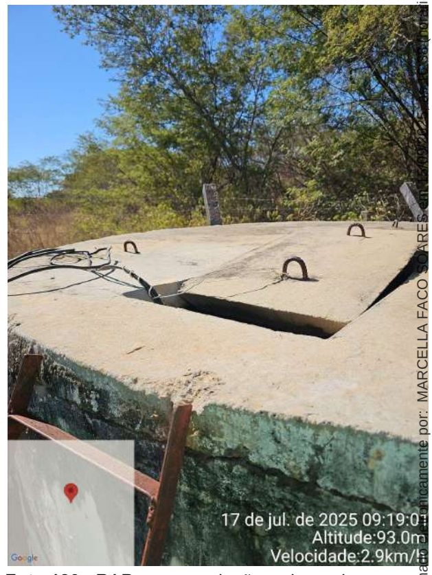
Foto 189 - RAP sem vedação adequada e com estrutura danificada.
