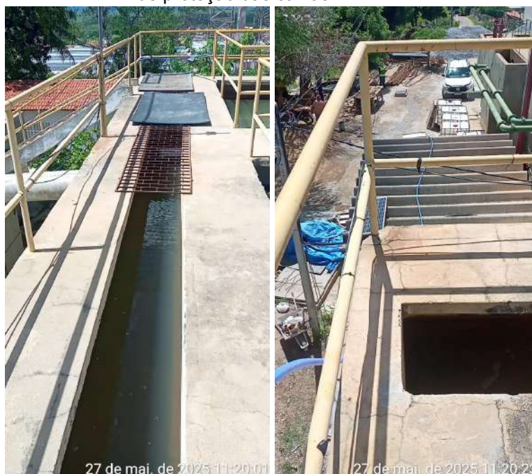
Figura 18 - Oportunidade de Melhorias - ETA (Sede): grelhas de proteção das calhas.
