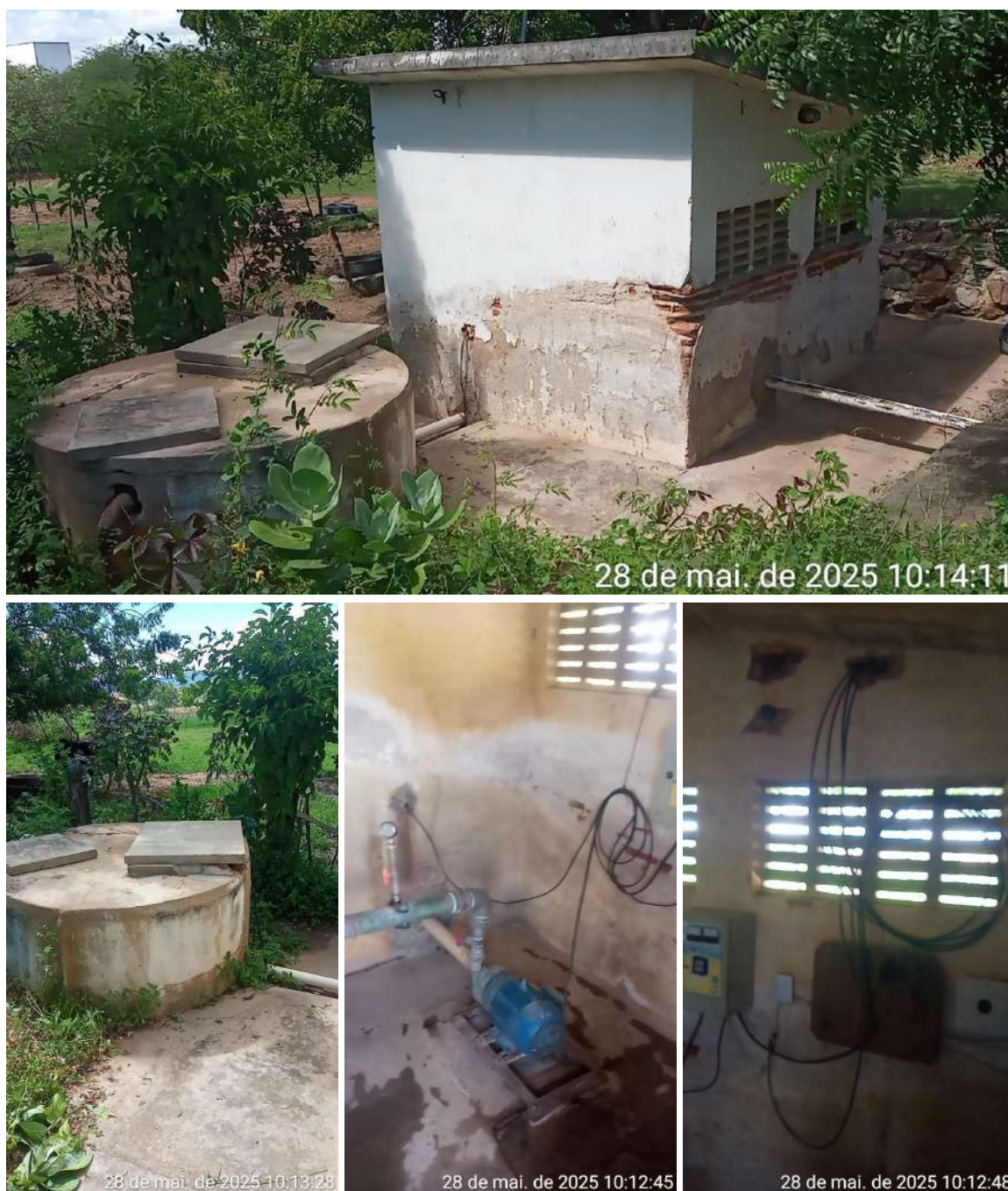
Figura 29 - Oportunidade de Melhorias - Reservatório Apoiado Booster Placa Verde: será desativado, sem identificação e isolamento, infraestrutura deteriorada.
