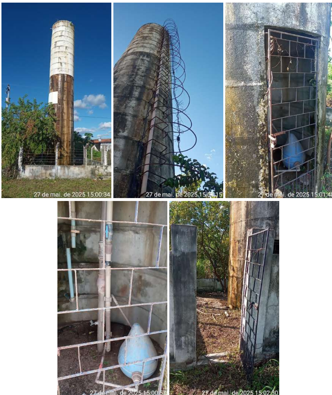
Figura 32 - Oportunidade de Melhorias - Reservatório Sítio Taboca: pintura desgastada, com vazamento, sem identificação.
