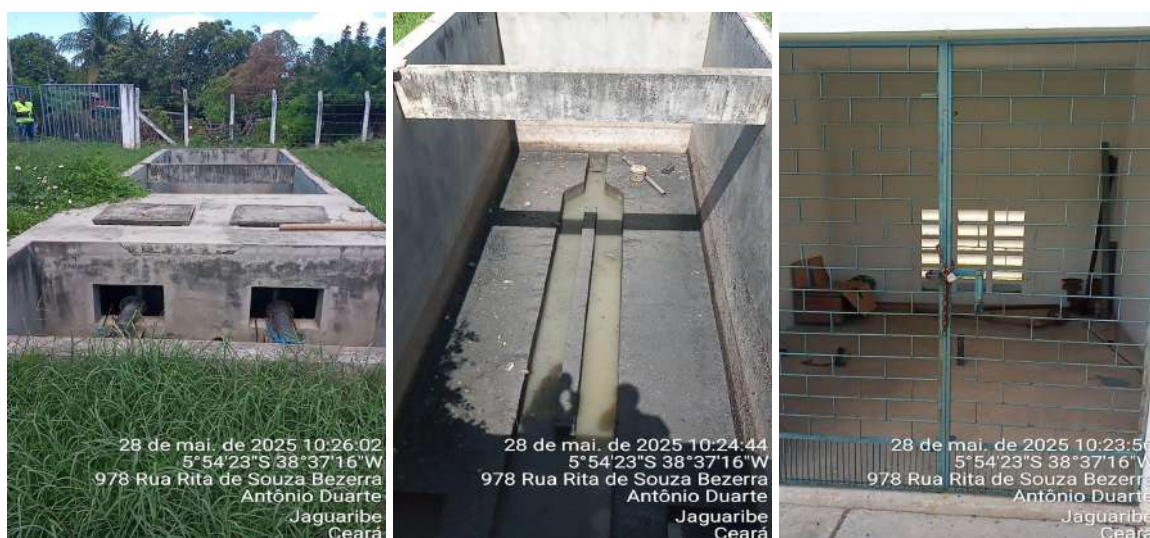
Figura 39 - Oportunidades de Melhoria - EEE-05: escada inadequada, sem proteção, fosso com sinais de inundação, vegetação crescida, sem gerador.
