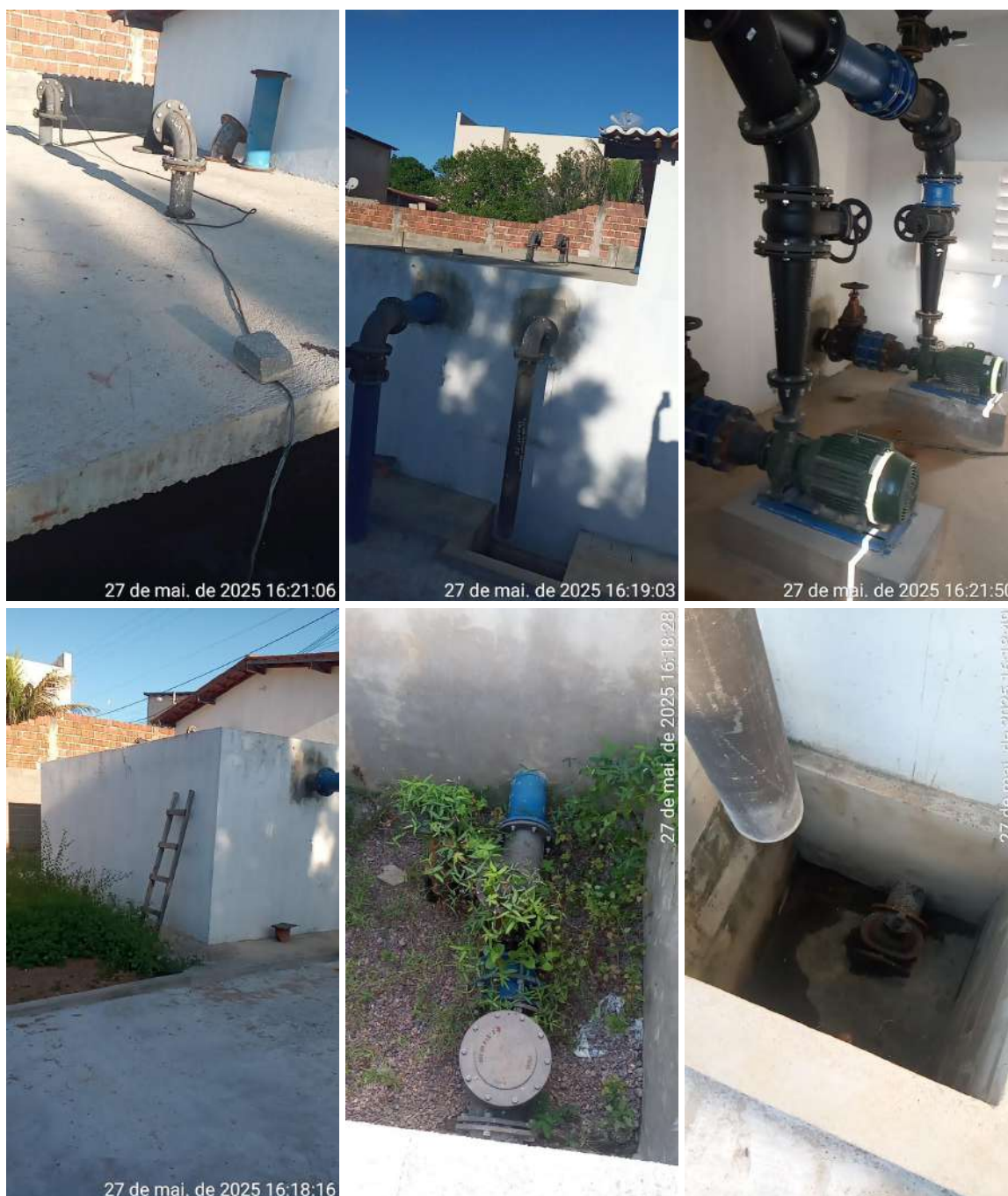
Figura 30 - Oportunidade de Melhorias - Reservatório Apoiado Booster COHAB: sem identificação, sem escada adequada, fiação exposta, abertura de inspeção sem tampa.
