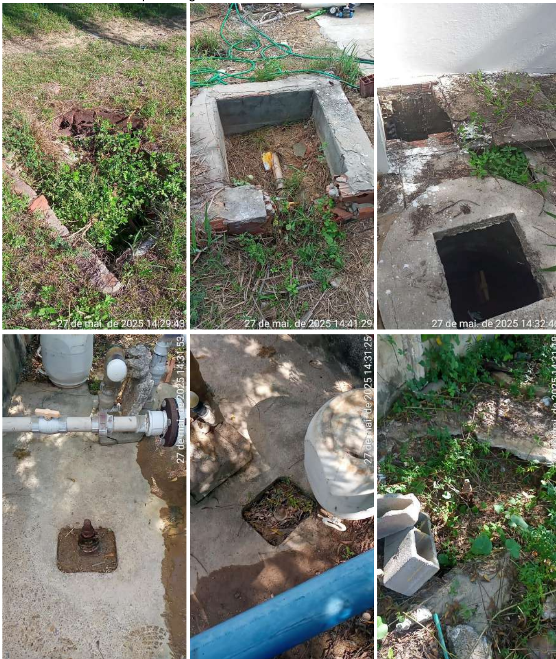
Figura 21 - Oportunidade de Melhorias - ETA (Feiticeiro): caixas de inspeção danificadas, sem tampas e registros sem caixa.
