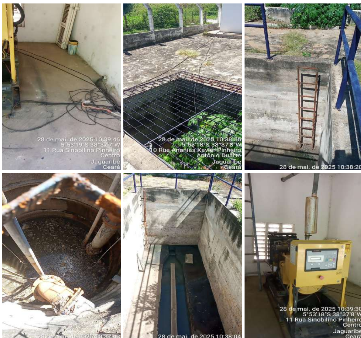
Figura 38 - Oportunidades de Melhoria - EEE-04: escada inadequada, sem proteção, fosso com sinais de inundação, vegetação crescida, fiação inadequada.
