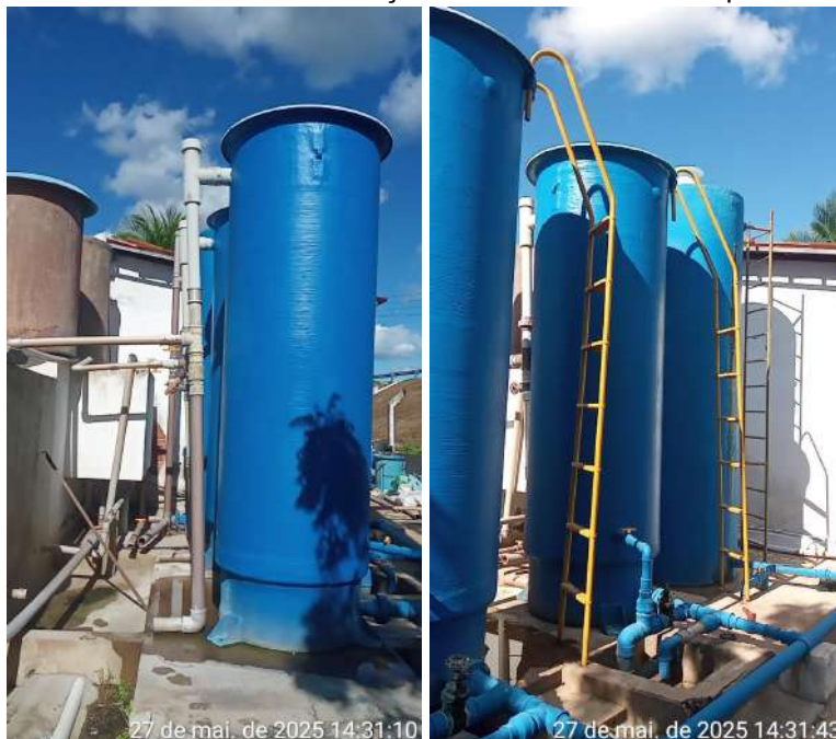
Figura 22 - Oportunidade de Melhorias - ETA (Sede): Filtros sem identificação e com escadas inadequadas.
