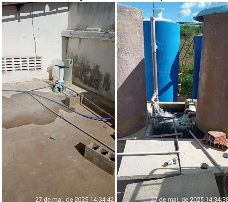
Figura 25 - Oportunidade de Melhorias - ETA (Sede): instalações hidráulicas inadequadas.
