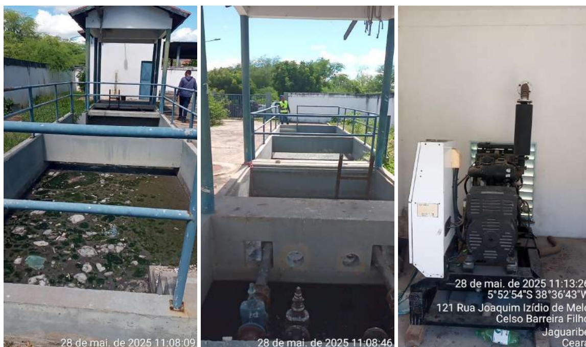
Figura 35 - Oportunidades de Melhoria - EEE-01: escada sem corrimão, fosso inundado e com sobrenadantes, grupo gerador inoperante.
