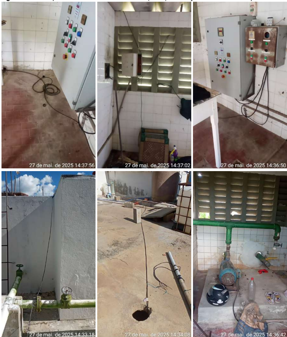
Figura 24 - Oportunidade de Melhorias - ETA (Sede): instalações elétricas inadequadas.
