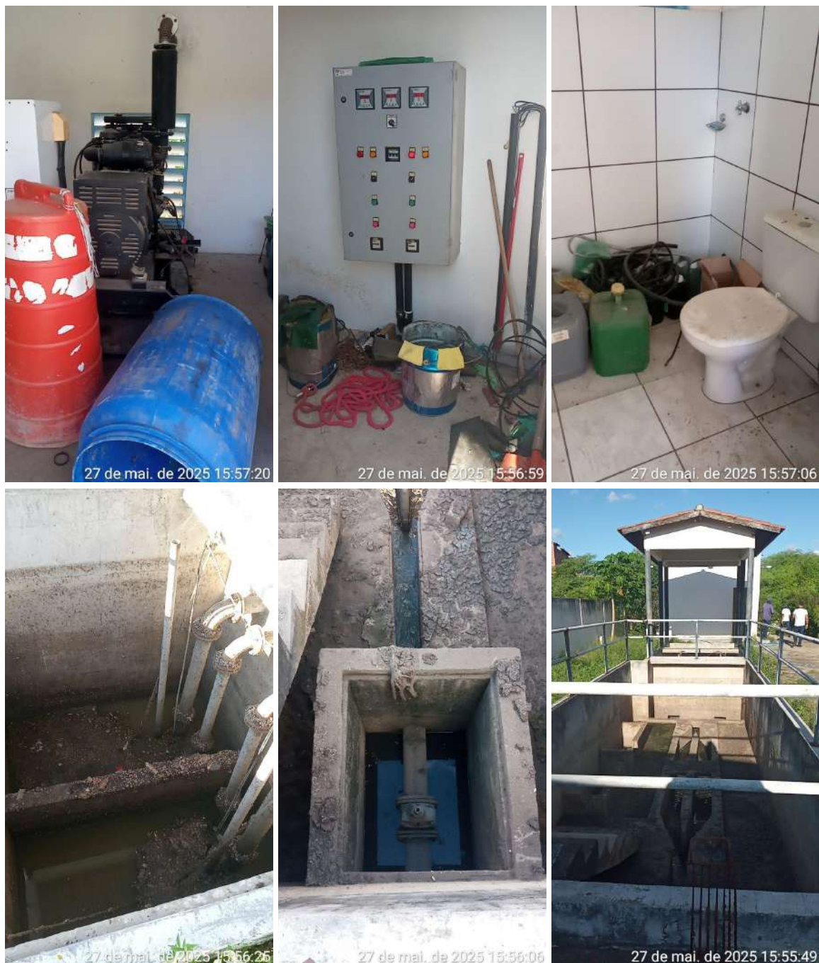
Figura 40 - Oportunidades de Melhoria - EEE-06: escada inadequada, fosso com sinais de inundação, gerador parado, material em local inadequado.
