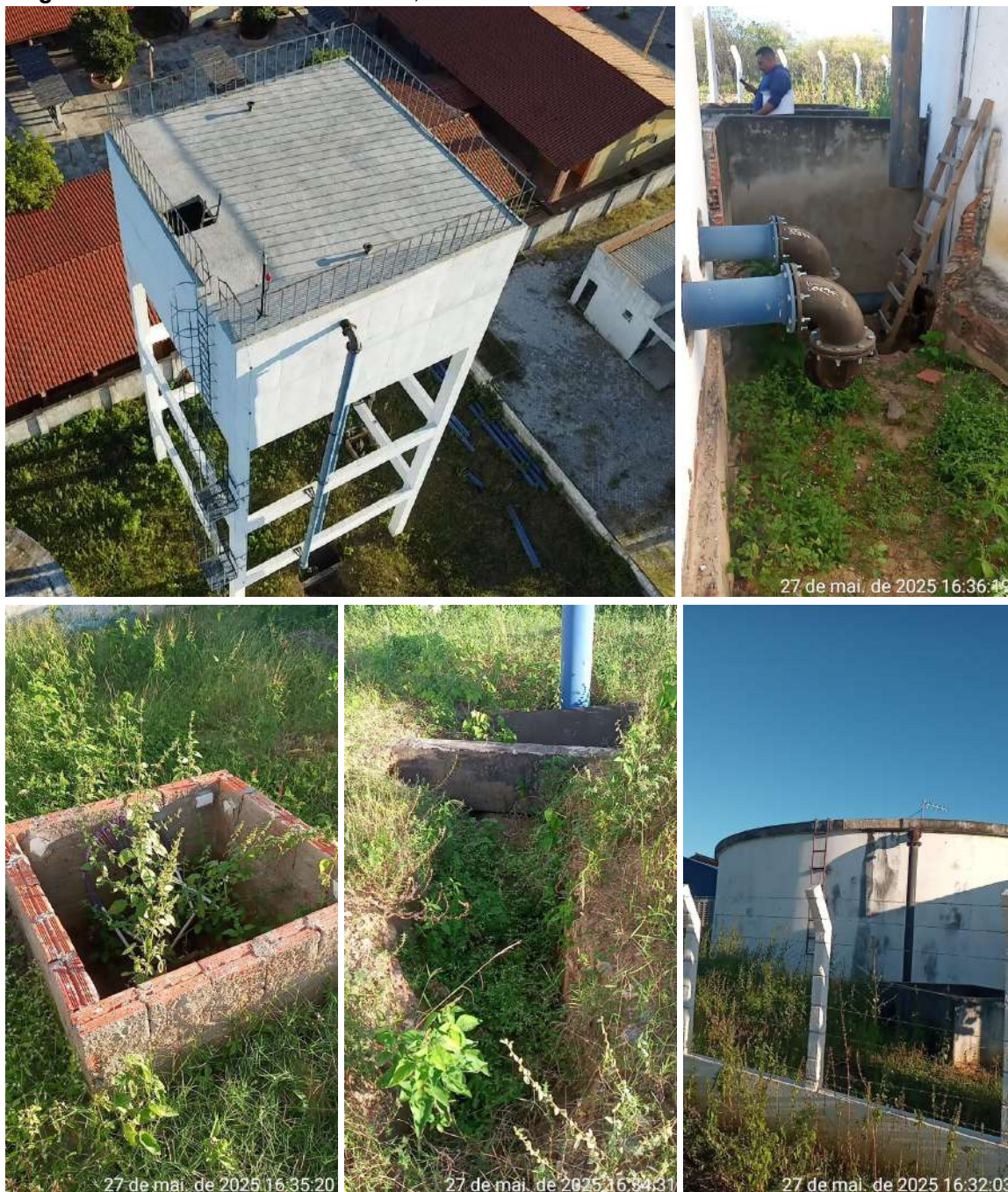
Figura 27 - Reservatórios Mutirão, com obras inacabadas.
