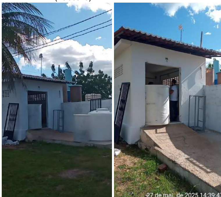
Figura 20 - Implantação da usina de cloro da Estação de Tratamento de Água do SAAE de Jaguaribe (Feiticeiro).
