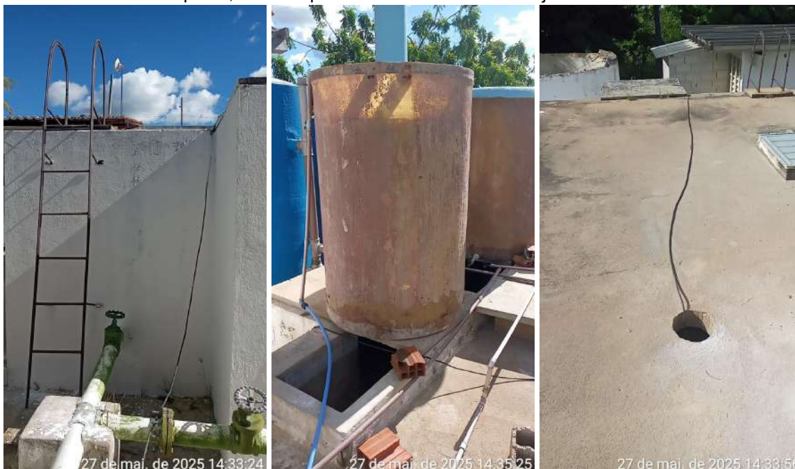
Figura 23 - Oportunidade de Melhorias - ETA (Sede): reservatório apoiado com escada inadequada, sem tampas herméticas e furos na laje.
