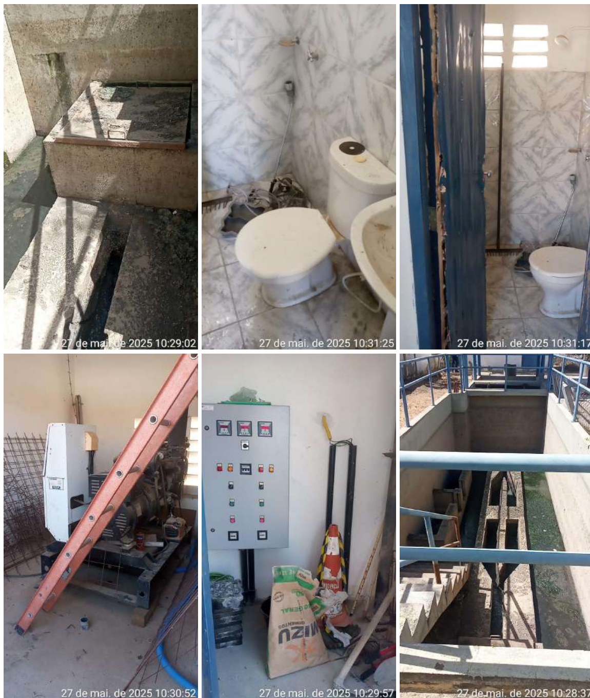
Figura 41 - Oportunidades de Melhoria - EEE-07: escada inadequada, sem proteção, fosso com sinais de inundação, material em local inadequado, porta do banheiro deteriorada.
