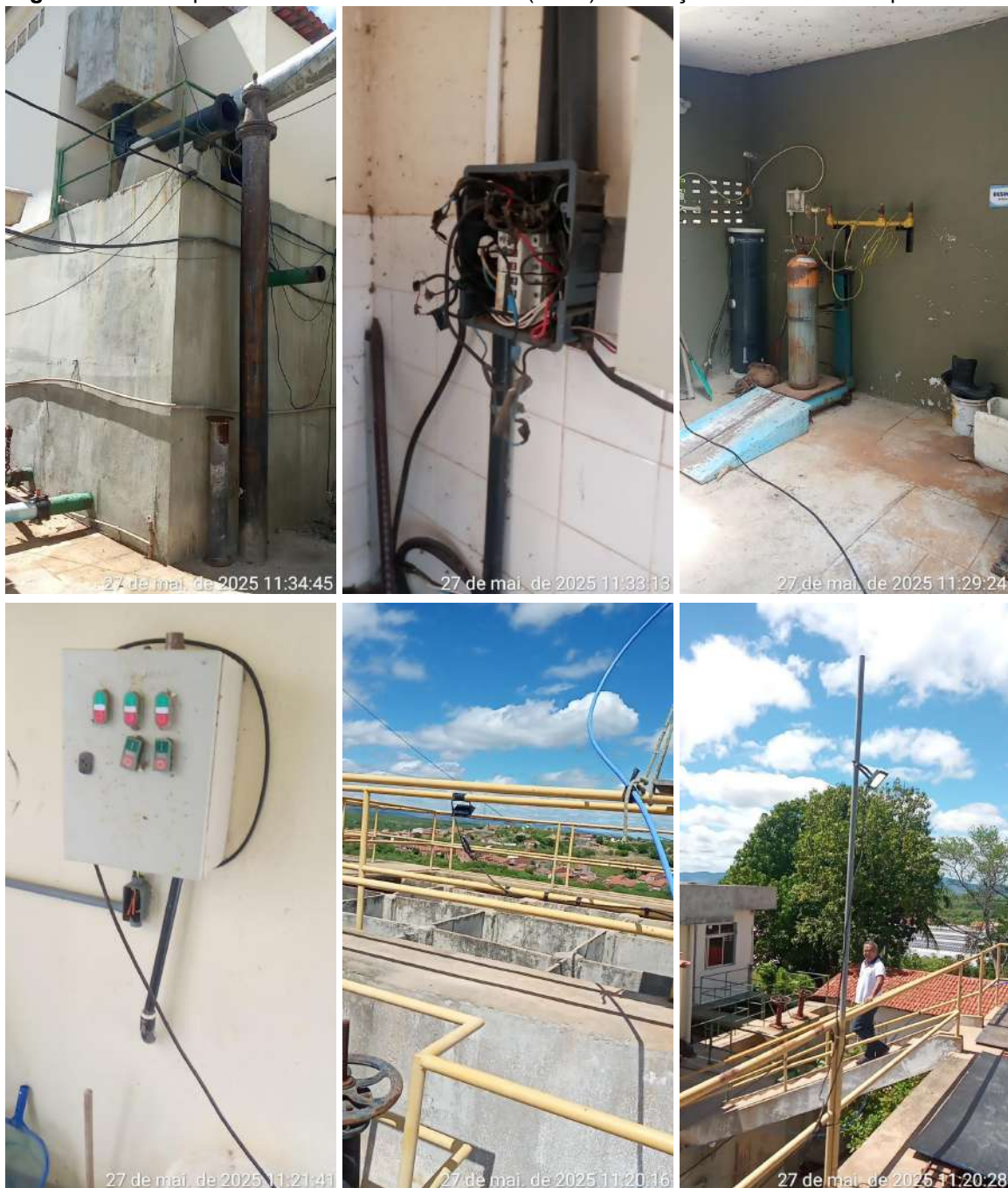
Figura 17 - Oportunidade de Melhorias - ETA (Sede): instalações elétricas inadequadas.
