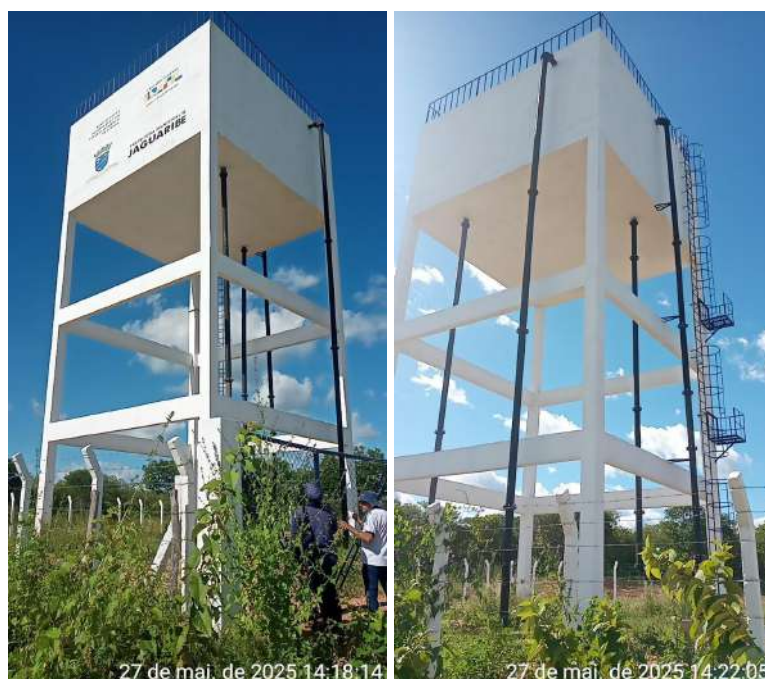
Figura 31 - Oportunidade de Melhorias - Reservatório Novo: vegetação crescida, sem identificação do SAAE.
