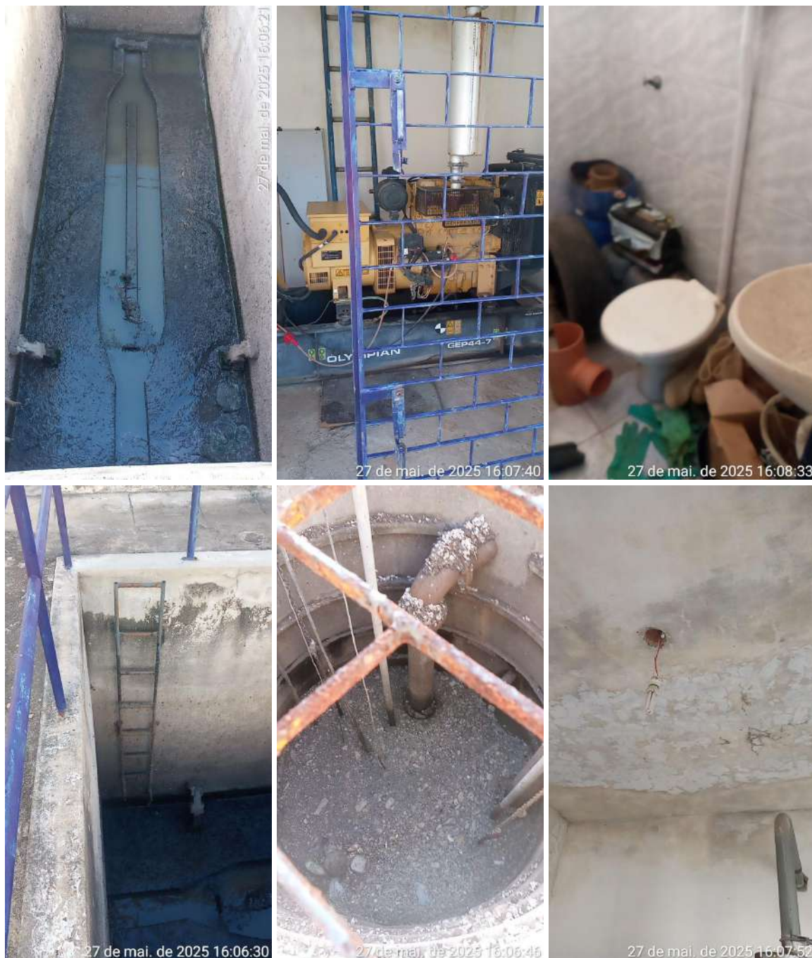
Figura 37 - Oportunidades de Melhoria - EEE-03: escada inadequada, sem proteção, fosso com sinais de inundação, sobrenadantes, fiação inadequada, material em local inadequado.
