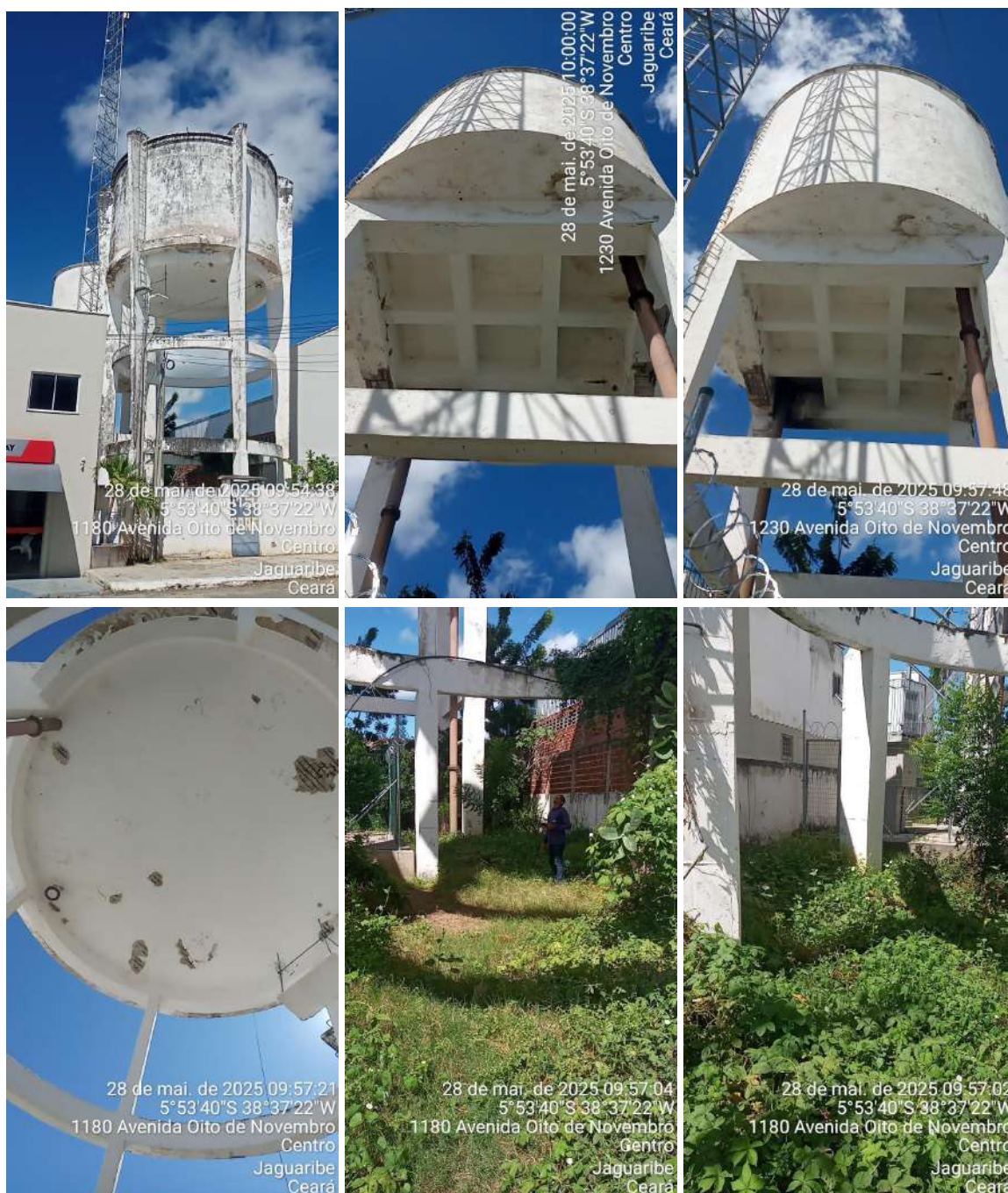
Figura 28 - Oportunidade de Melhorias - Reservatórios Elevados (Sede - Centro): sem identificação, deterioração da infraestrutura e área com vegetação crescida.
