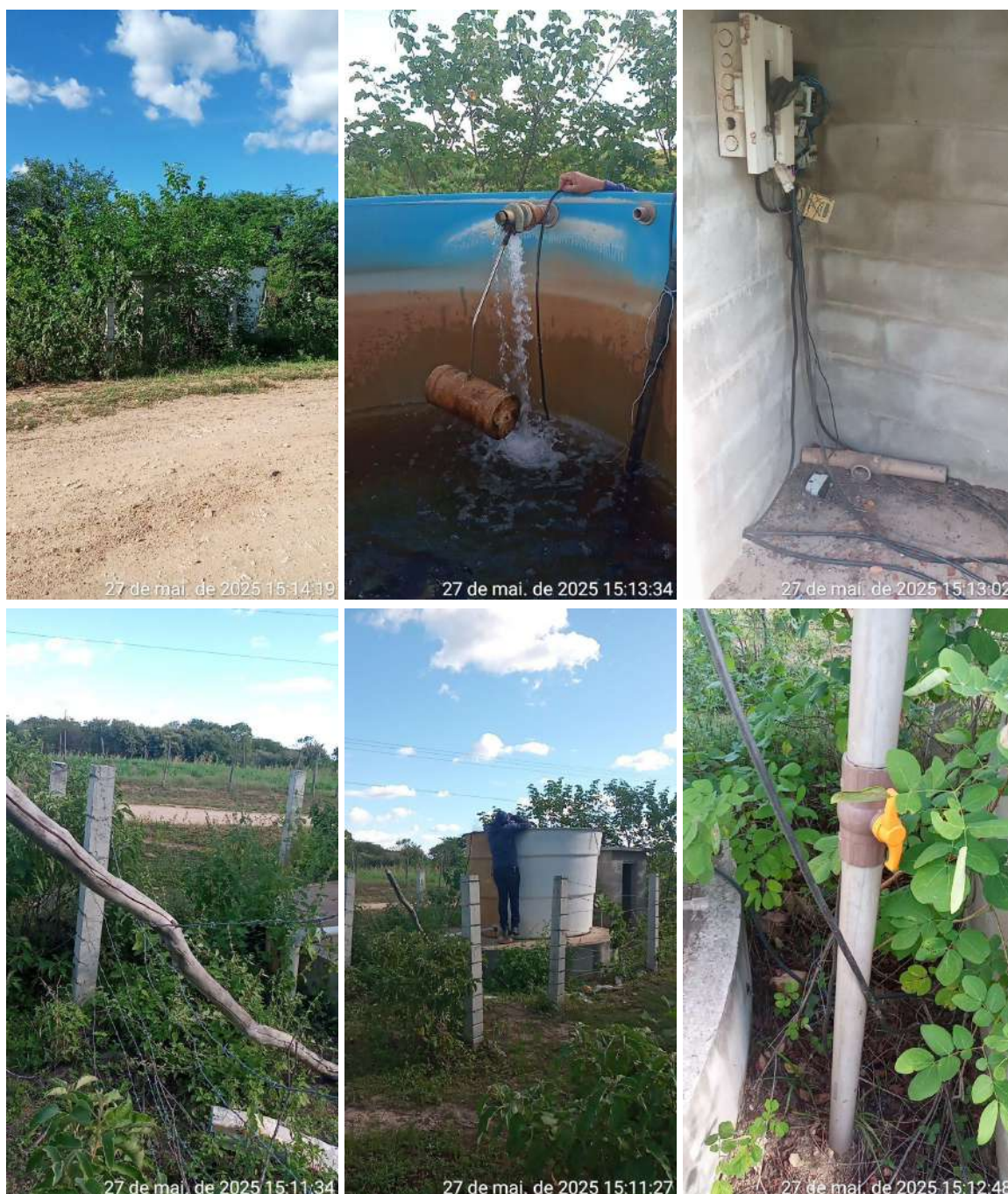
Figura 33 - Oportunidade de Melhorias - Reservatório Booster Jureminha: sem identificação, sem portão, vegetação crescida, sem tampa, instalações elétricas precárias.
