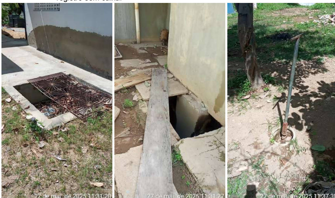
Figura 15 - Oportunidade de Melhorias - ETA (Sede): caixas de inspeção sem tampas e registro sem caixa.
