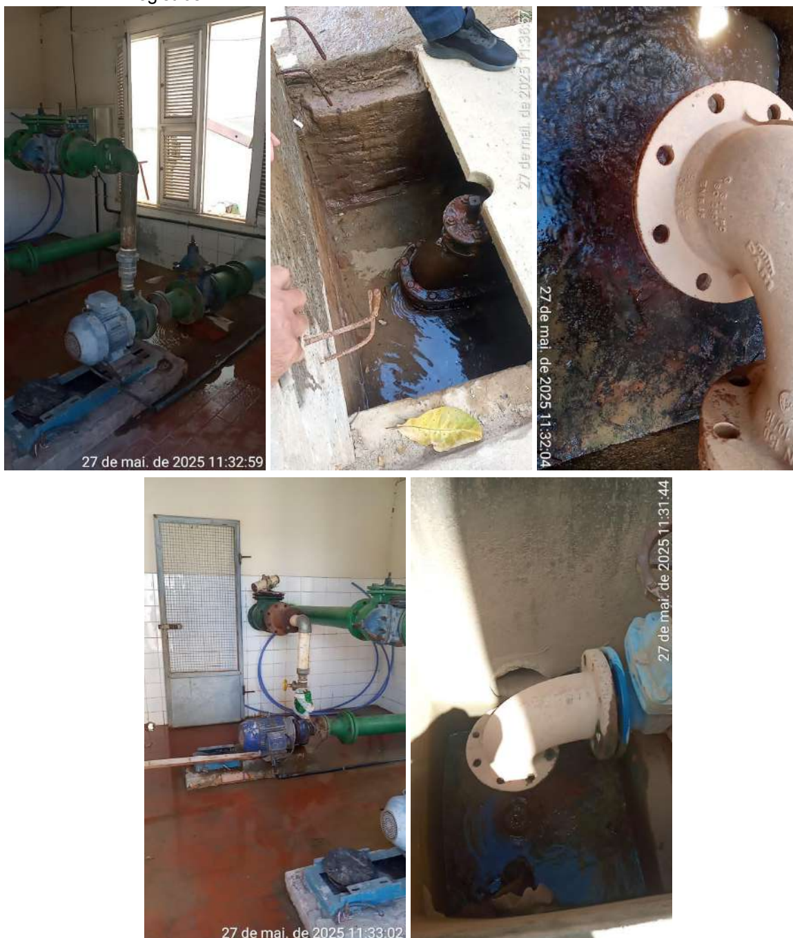
Figura 16 - Oportunidade de Melhorias - ETA (Sede): vazamentos na casa de bombas e em registros.
