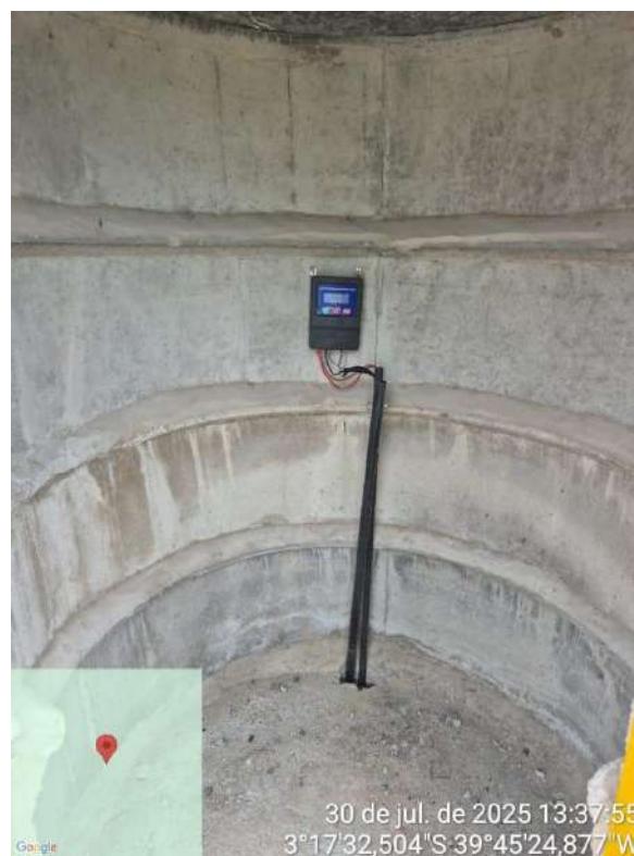
Foto 44 - Poço de Baixios.
