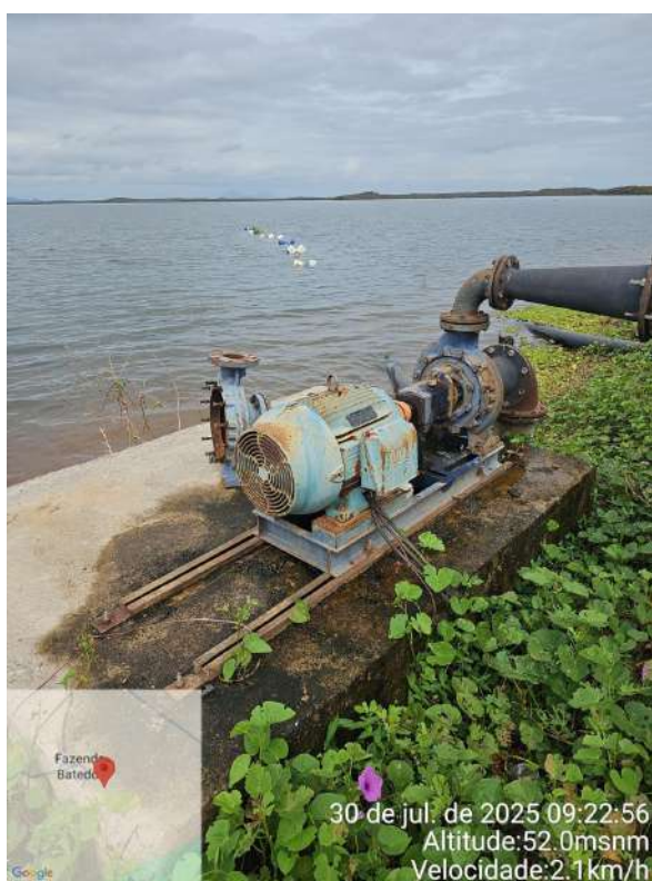
Foto 8 - Captação da Sede (Açude Missi).
