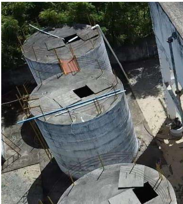
Foto 248 - Reservatórios com tampas deslocadas.
