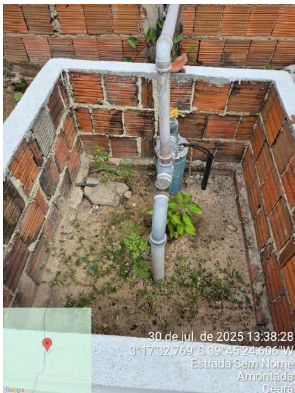
Foto 45 - Poço de Baixios.
