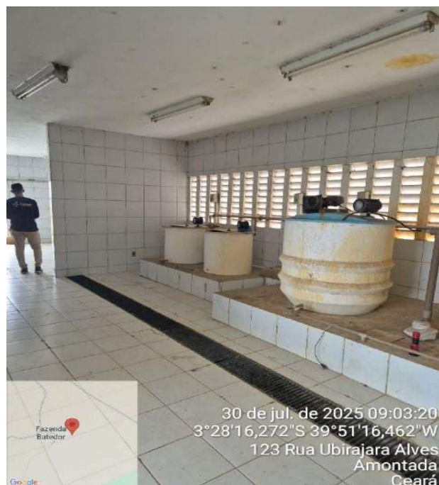
Foto 118 - Ausência de iluminação.
