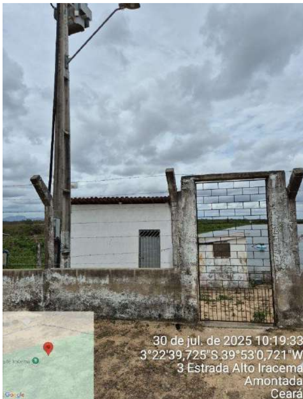
Foto 111 - Ausência de identificação e pintura deteriorada.
