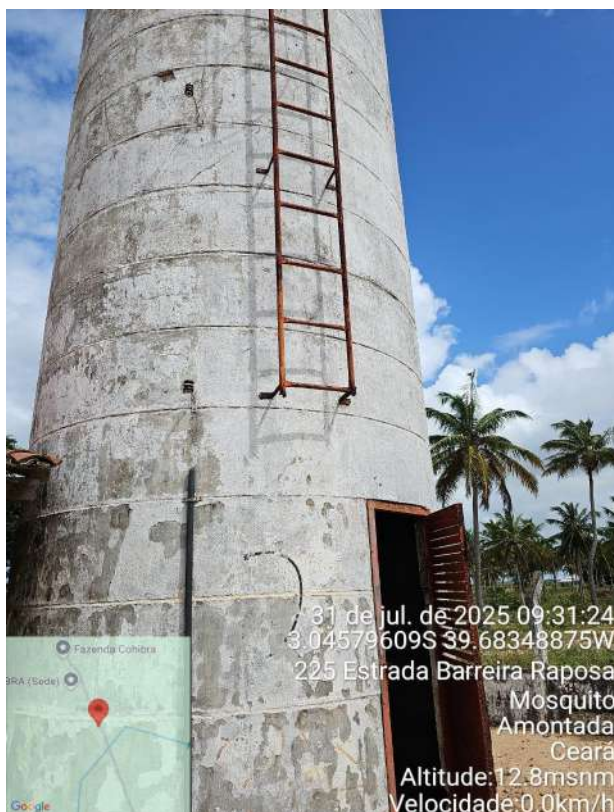
Foto 220 - Escada danificada e sem guarda-corpo.
