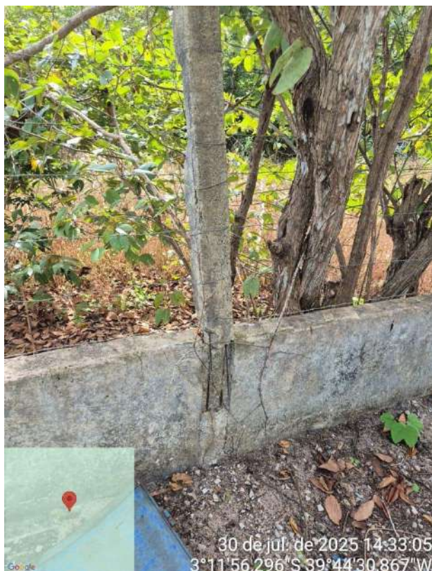
Foto 199 - Cerca com defeito.
