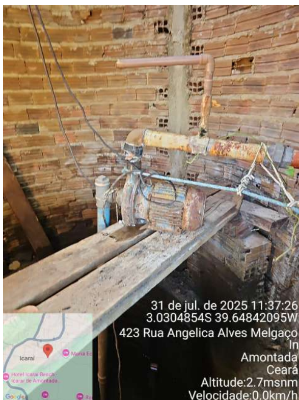
Foto 91 - Poço de Icarai.
