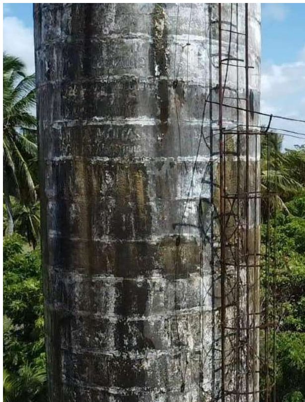
Foto 241 - Escada e guarda-corpo oxidados e danificados.
