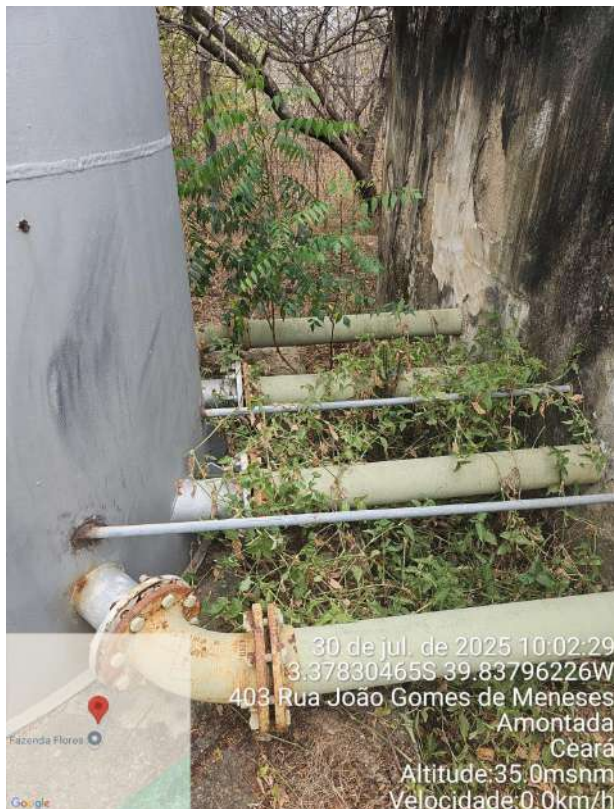
Foto 138 - Presença de oxidação.
