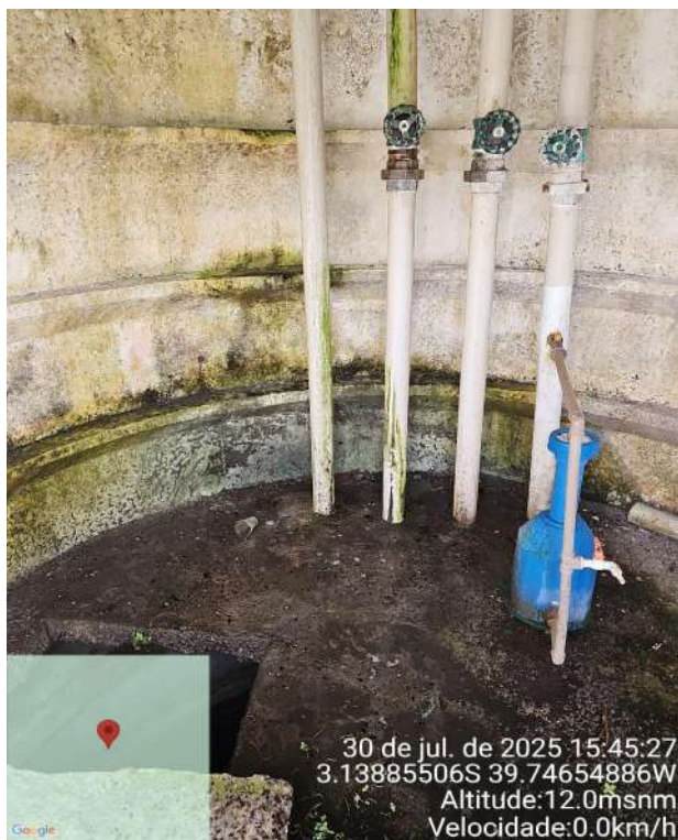
Foto 193 - Presença de vazamento.
