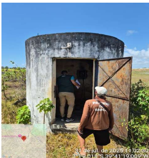
Foto 228 - Sem identificação, pintura deteriorada e portão de acesso oxidado.
