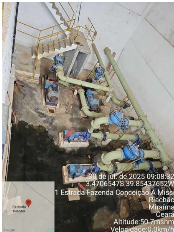
Foto 28 - ETA Missi (desativada) - Casa de bombas.
