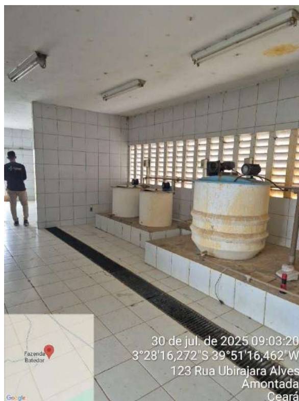
Foto 20 - ETA de Missi (desativada) - Químicos.
