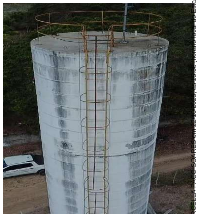
Foto 168 - Escada e guarda-corpo oxidados.
