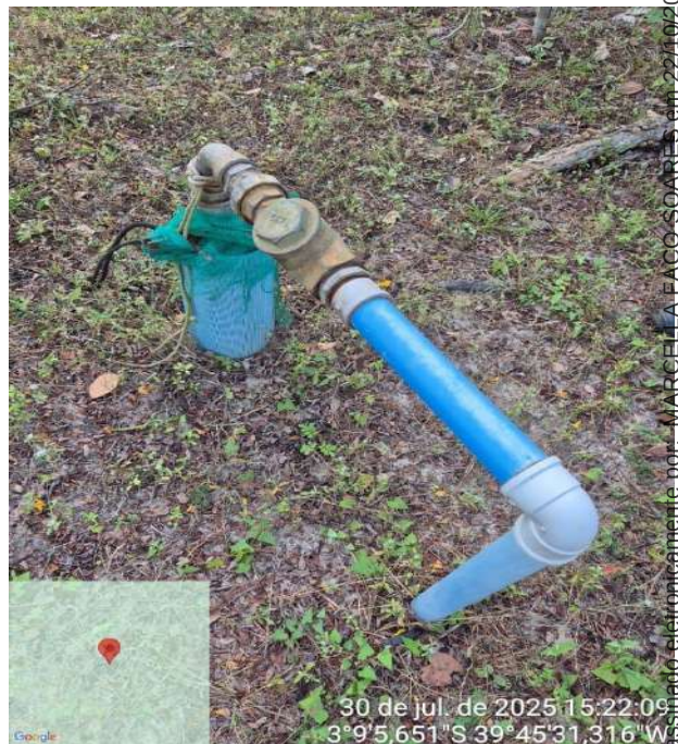
Foto 190 - Sem proteção e isolamento.
