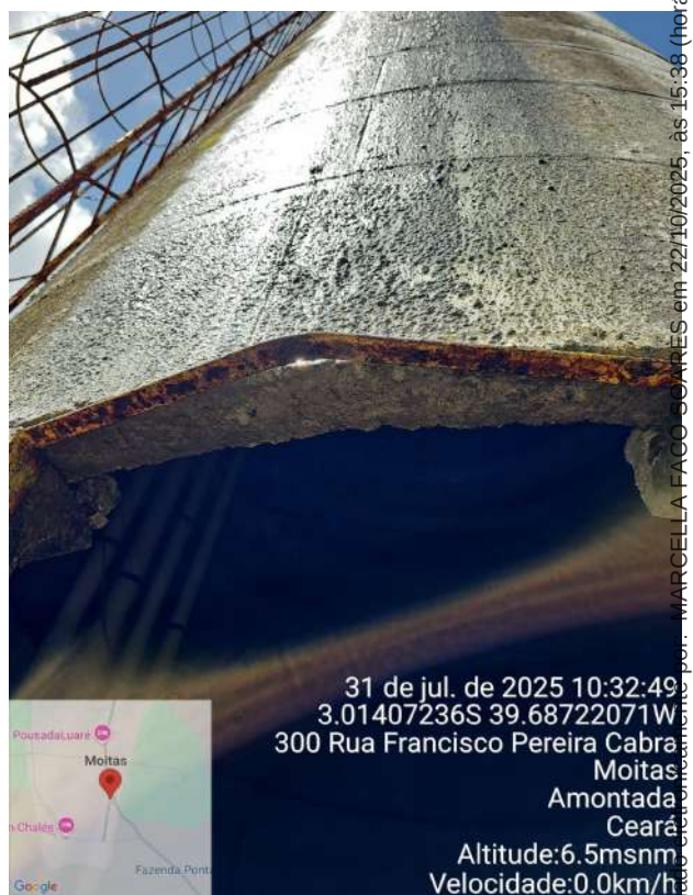
Foto 244 - Presença de vazamento.
