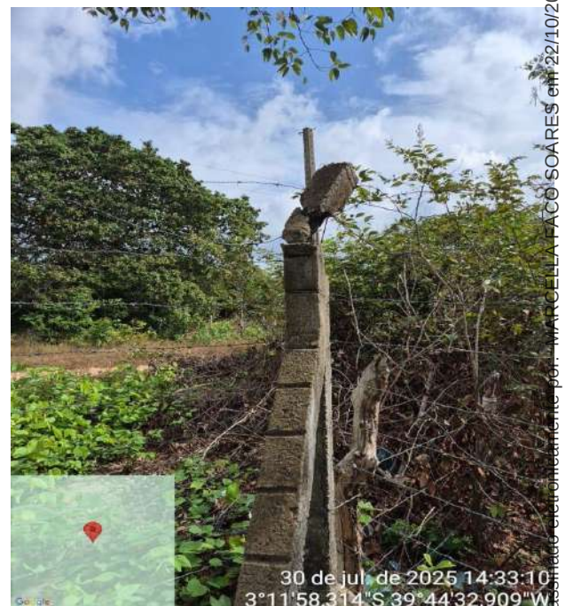
Foto 198 - Cerca com defeito.
