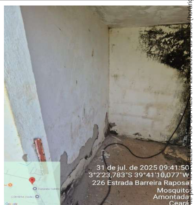
Foto 213 - Parede com reboco caindo.
