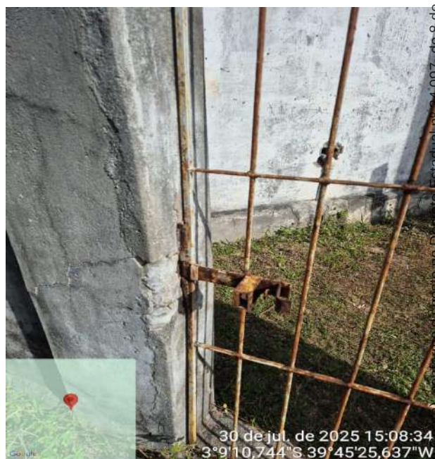
Foto 170 - Portão de acesso oxidado.
