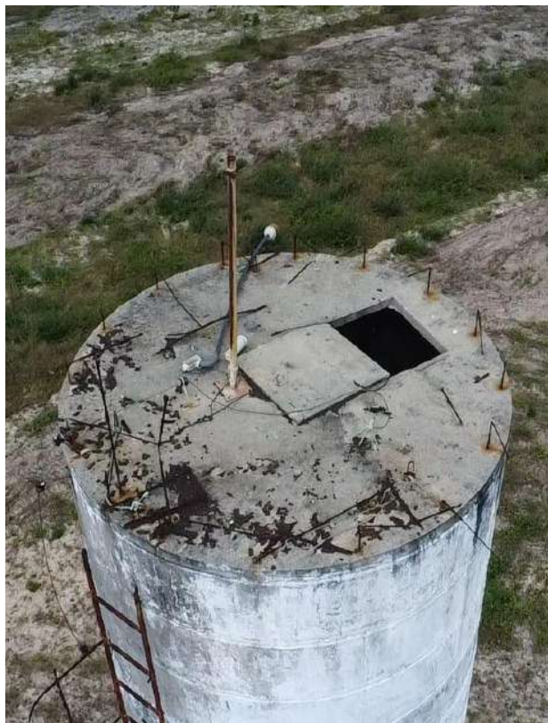
Foto 222 - Escada danificada e sem guarda-corpo.
