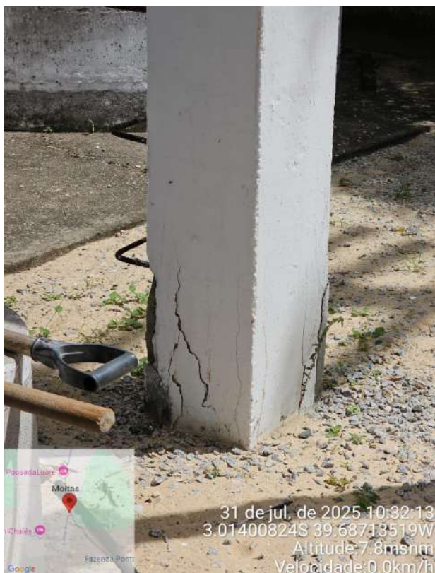
Foto 238 - Reservatório com rachaduras.
