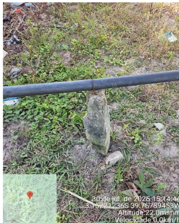
Foto 184 - Apoio da tubulação de descarte inadequado.
