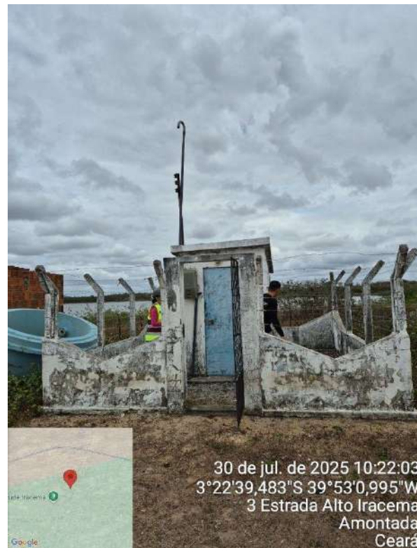
Foto 112 - Ausência de identificação e pintura deteriorada.
