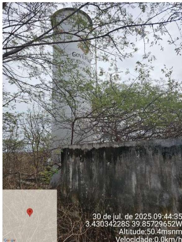
Foto 30 - Torre de Equalização 1 - Missi.
