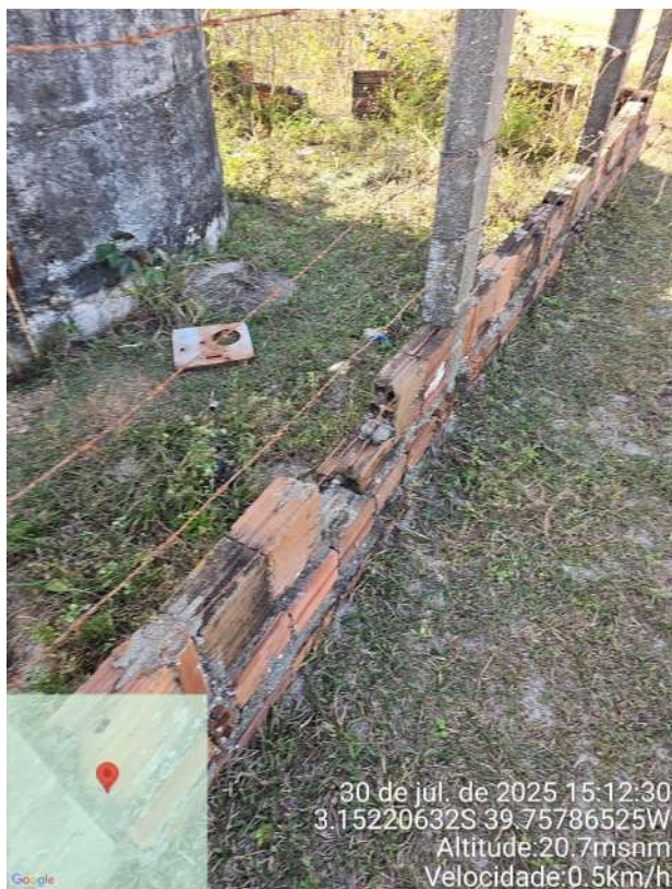
Foto 179 - Cerca com defeito e mureta quebrada.
