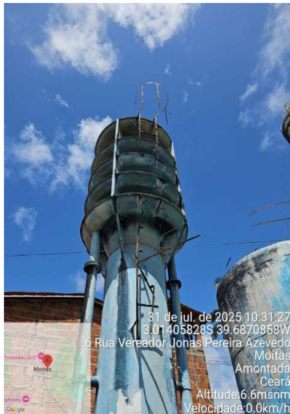
Foto 82 - ETA de Moitas.
