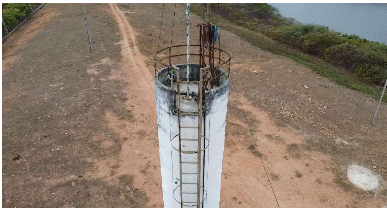
Foto 117 - Escada e guarda-corpo danificados
