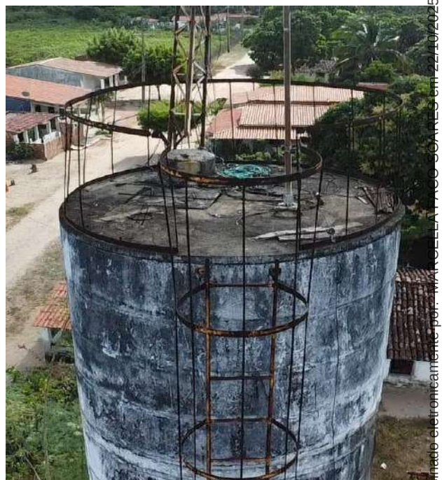
Foto 206 - Escada e guarda-corpo oxidados.
