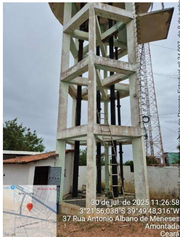
Foto 155 - Escada inadequada, sem guarda-corpo.
