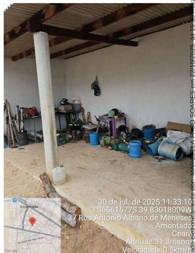
Foto 153 - Armazenamento inadequado de materiais.
