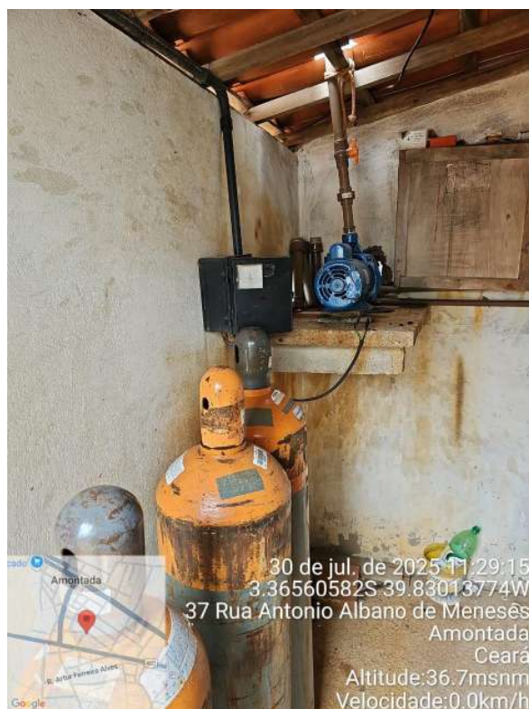
Foto 41 - REL da Sede (Casa de comando/Cloração).
