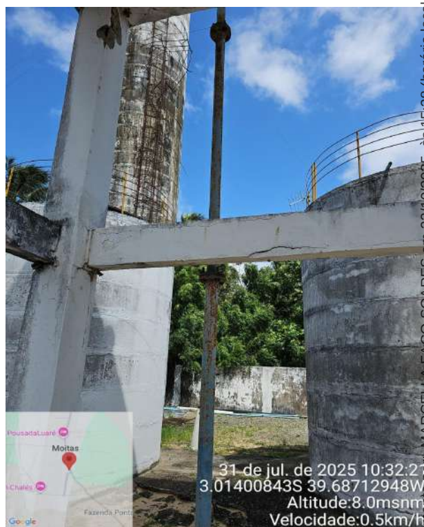
Foto 237 - Reservatório com rachaduras.
