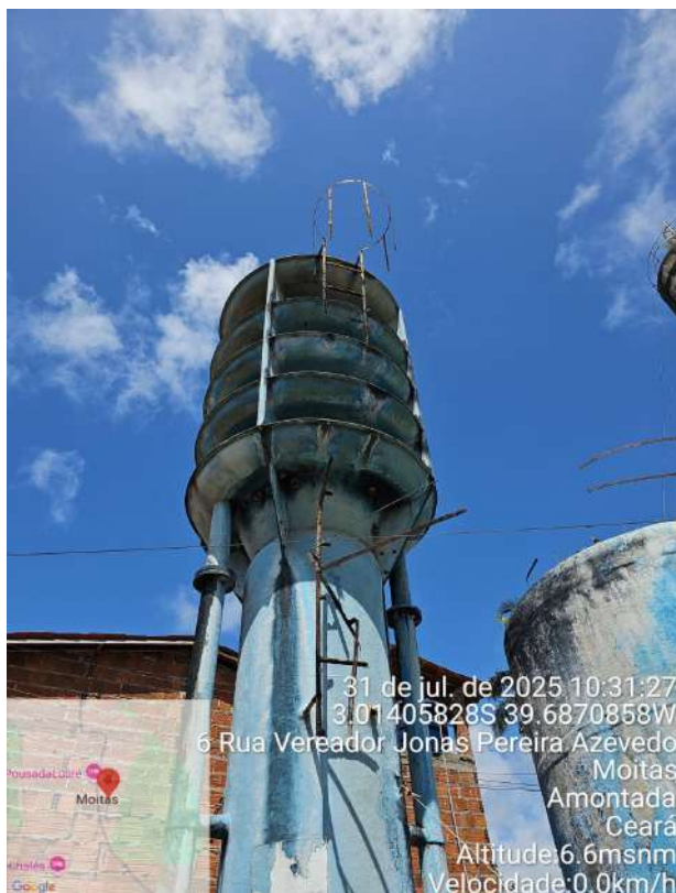
Foto 245 - Escada oxidada e danificada.
