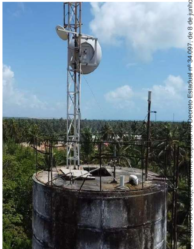
Foto 242 - Tapa deslocada e guarda-corpo oxidado e danificado.
