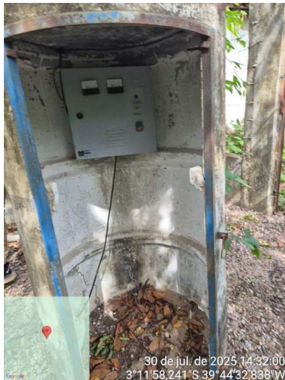
Foto 70 - Poço de Vila Nova (Casa de Comando).
