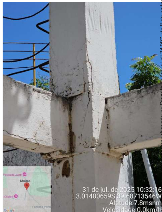
Foto 239 - Reservatório com rachaduras
