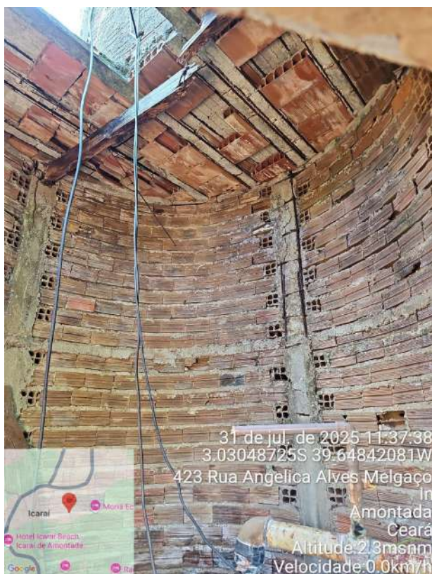
Foto 254 - Estrutura precária e fiação inadequada.
