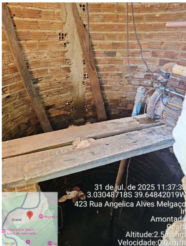
Foto 252 - Estrutura precária, base da bomba e fiação inadequadas.
