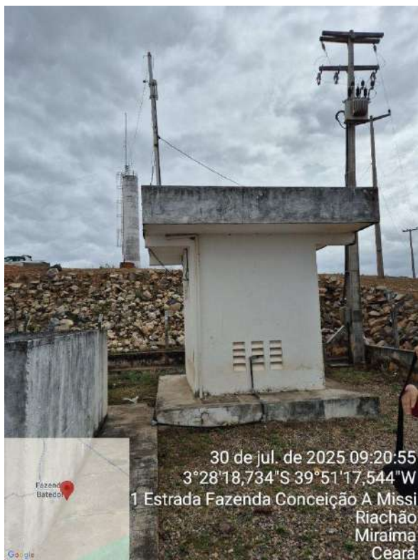
Foto 10 - Captação da Sede (Açude Missi).
