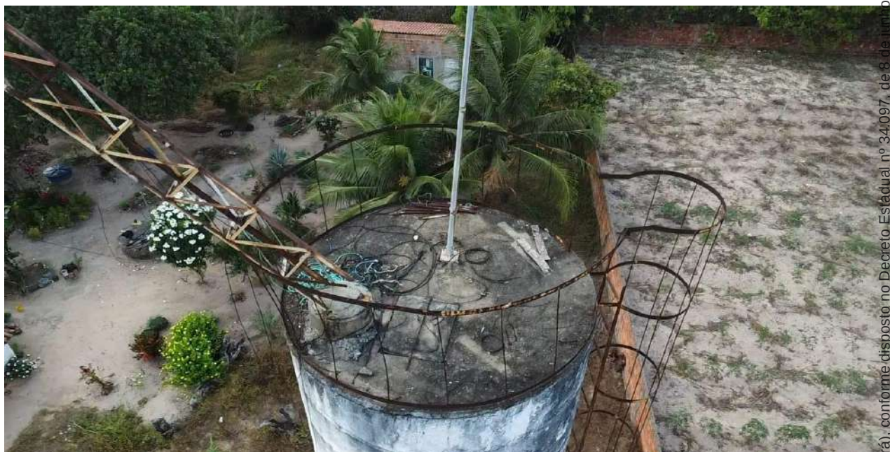
Foto 207 - Torre metálica inclinada.
