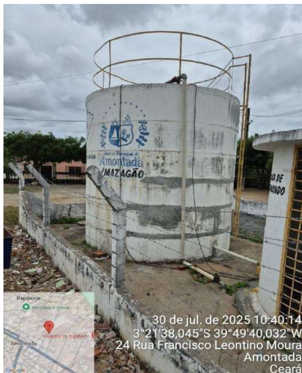
Foto 141 - Pintura desgastada e cerca com defeito.
