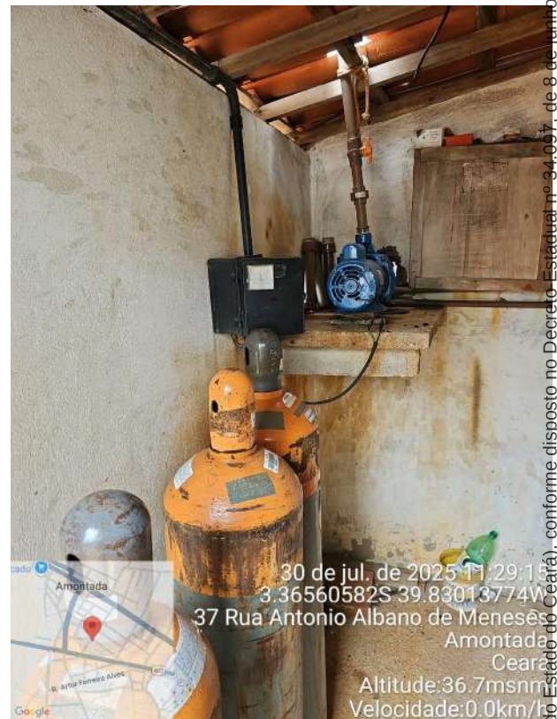
Foto 151 - Armazenamento inadequado de materiais.
