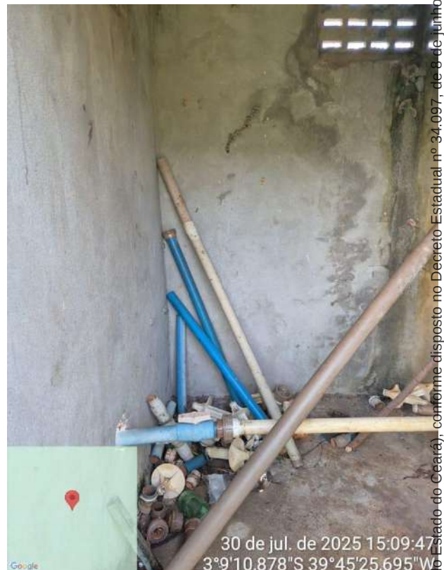
Foto 174 - Acúmulo inadequado de material.
