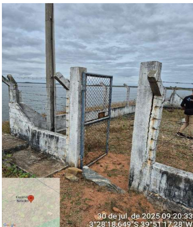
Foto 115 - Ausência de identificação.
