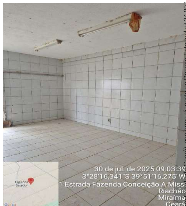
Foto 119 - Ausência de iluminação.
