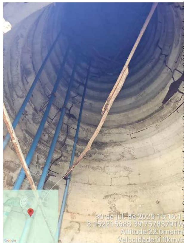
Foto 180 - Presença de cupim.
