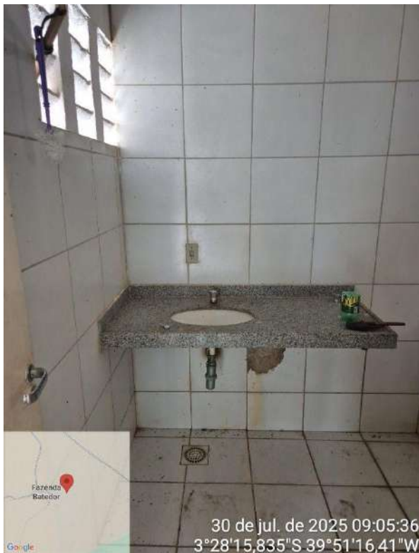
Foto 122 - Banheiro em péssimo estado de conservação.
