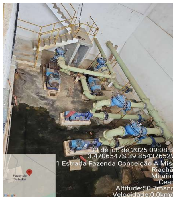
Foto 125 - Estação Elevatória - Presença de vazamento.
