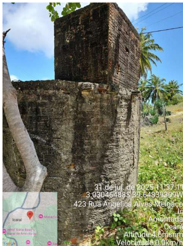
Foto 90 - Poço de Icarai.
