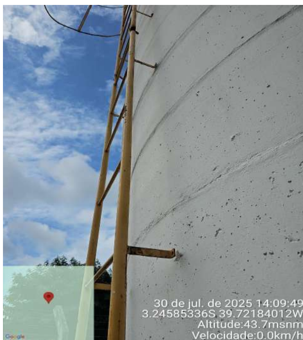
Foto 167 - Escada sem fixação adequada.
