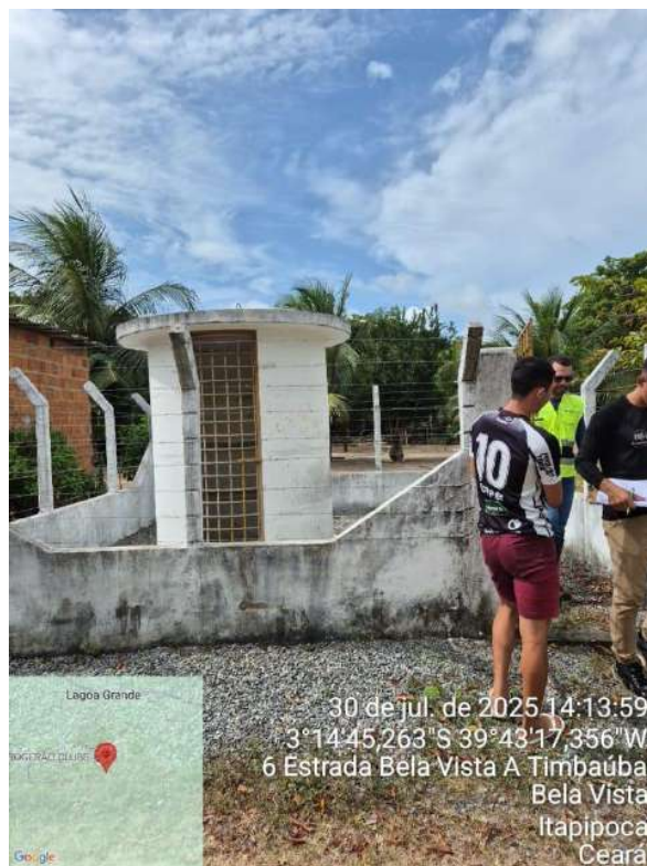
Foto 50 - Poço de Lagoa Grande 2.
