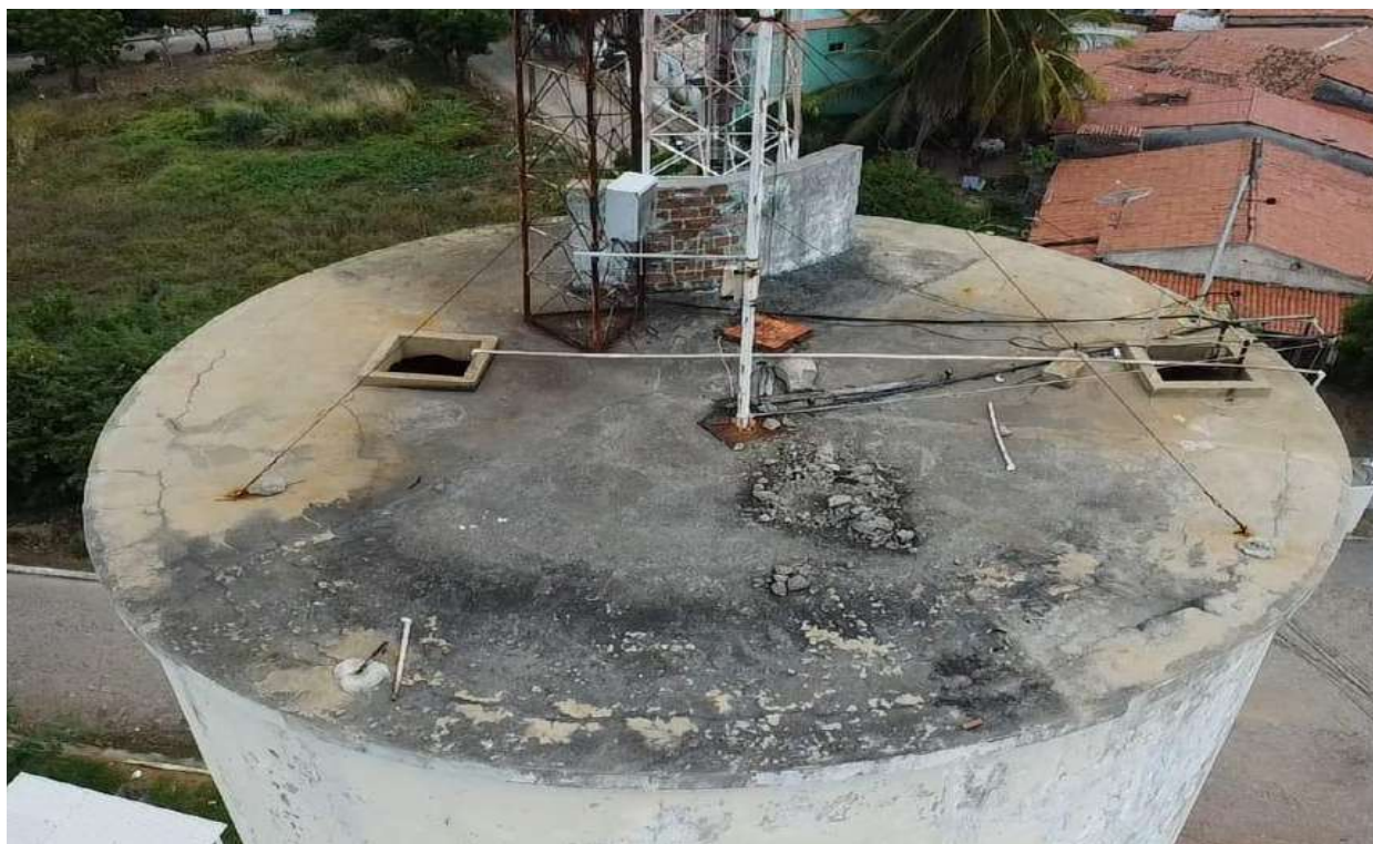
Foto 160 - Ausência de tampas e fiação inadequada.
