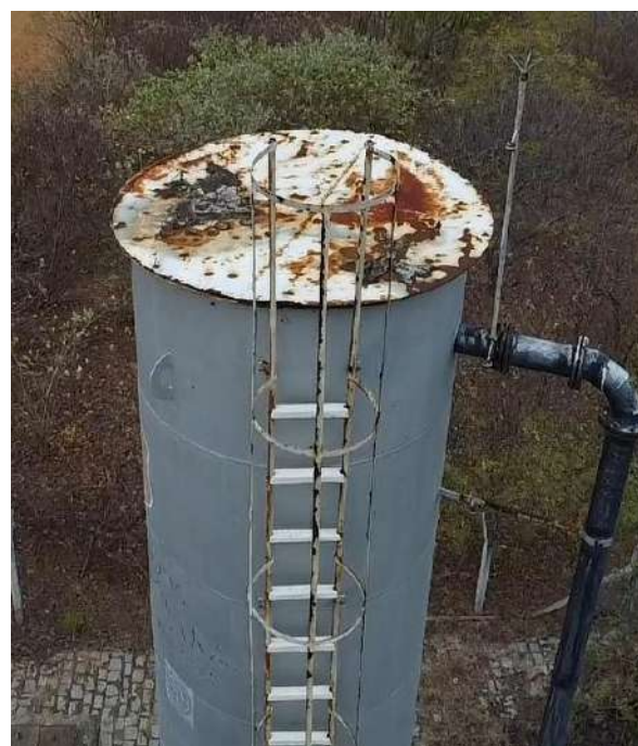
Foto 134 - Presença de oxidação.
