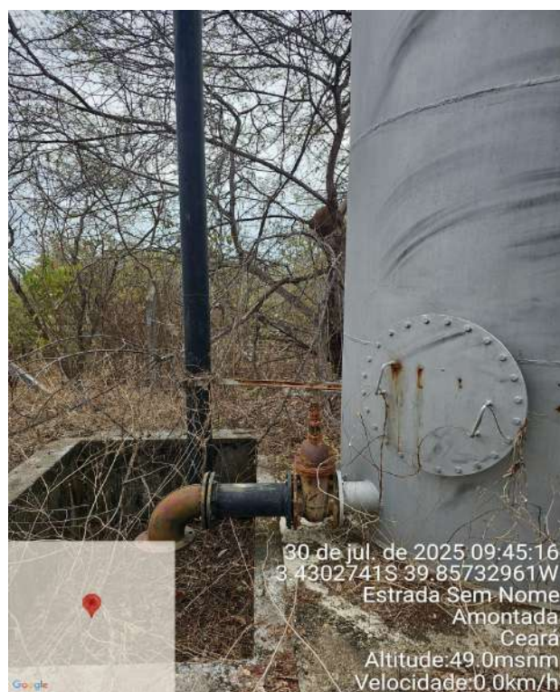
Foto 128 - Presença de oxidação.
