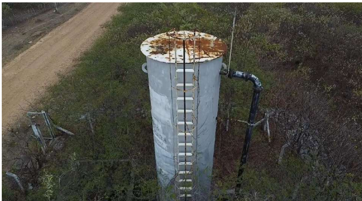
Foto 131 - Presença de oxidação.
