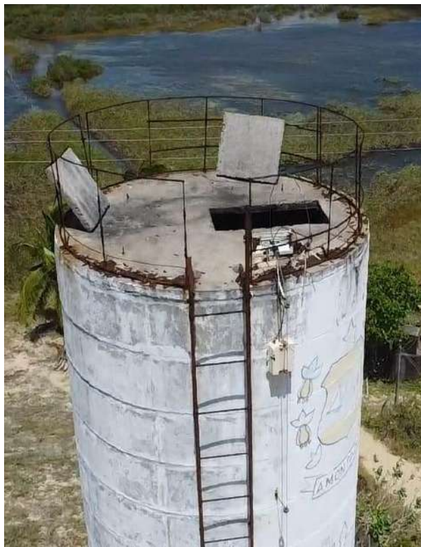
Foto 259 - Escada e guarda-corpo danificados.
