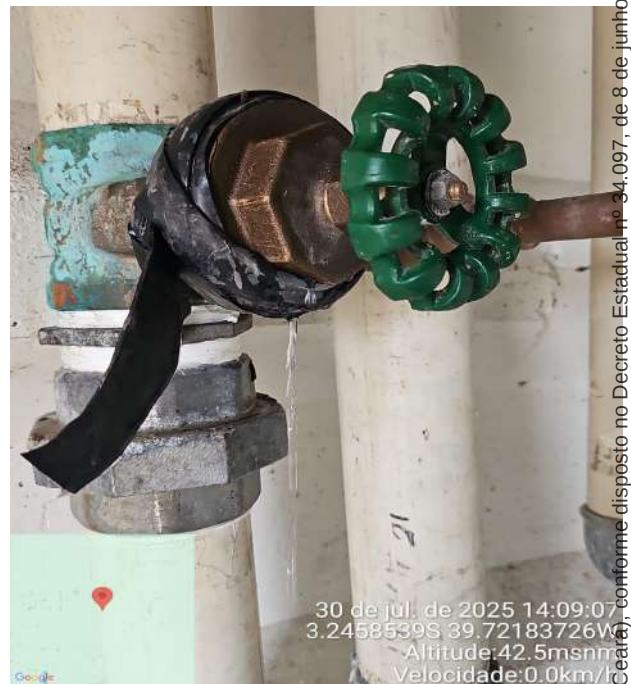
Foto 166 - Presença de vazamento.
