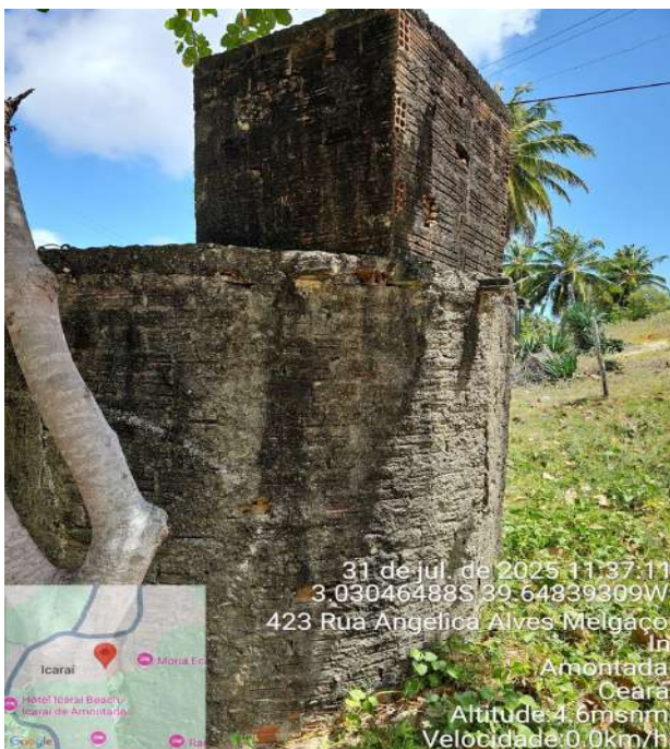
Foto 250 - Sem identificação e pintura deteriorada.
