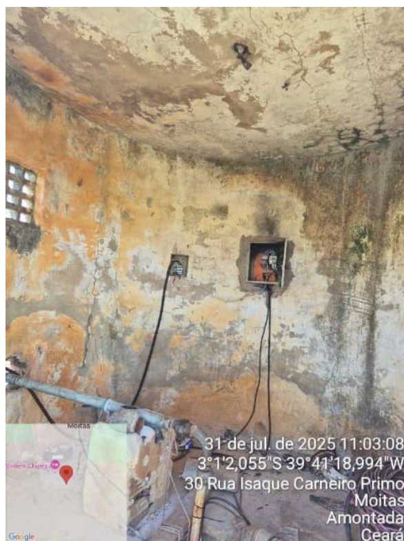
Foto 88 - Captação Moitas (Poço 3) - Casa do Valdo.
