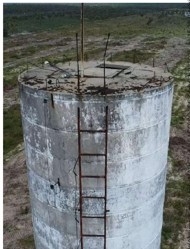
Foto 221 - Escada danificada e sem guarda-corpo
