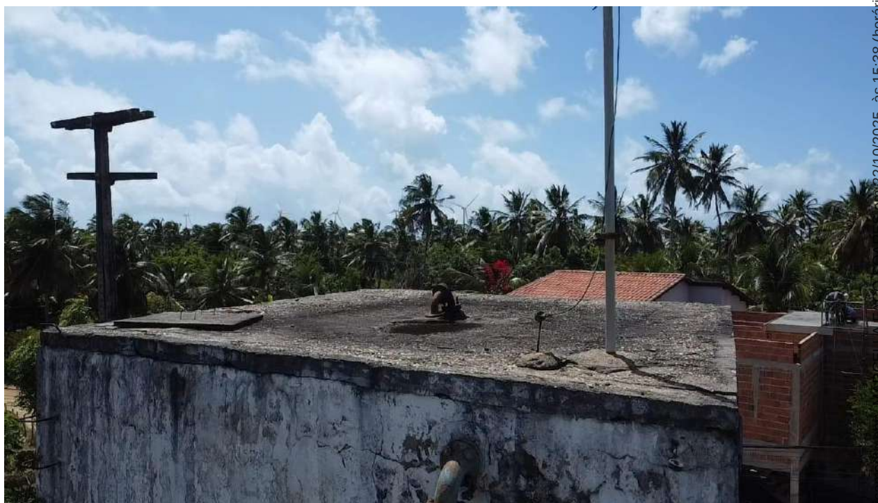
Foto 240 - Reservatório com rachaduras.
