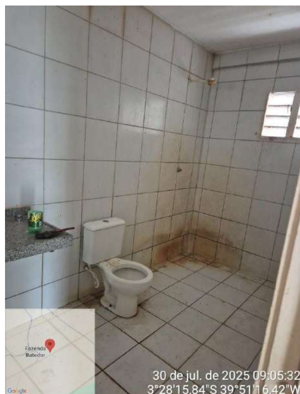
Foto 121 - Banheiro em péssimo estado de conservação.
