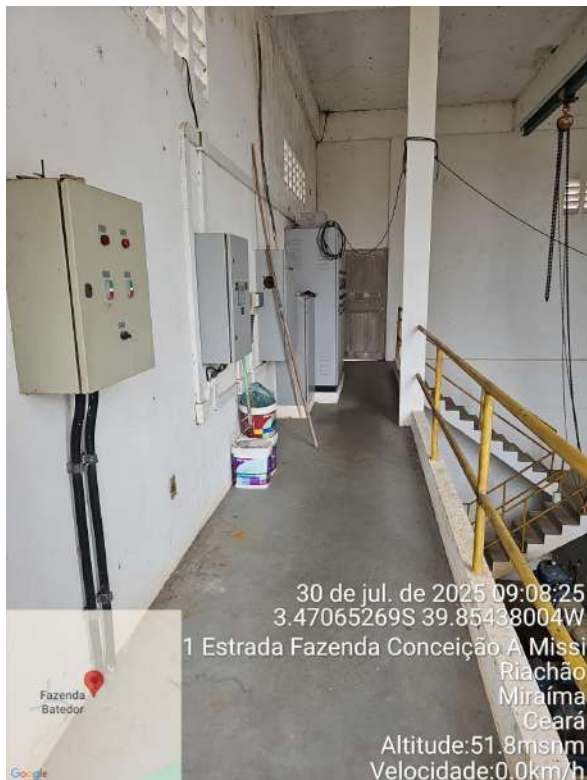
Foto 27 - ETA Missi (desativada) - Casa de bombas.
