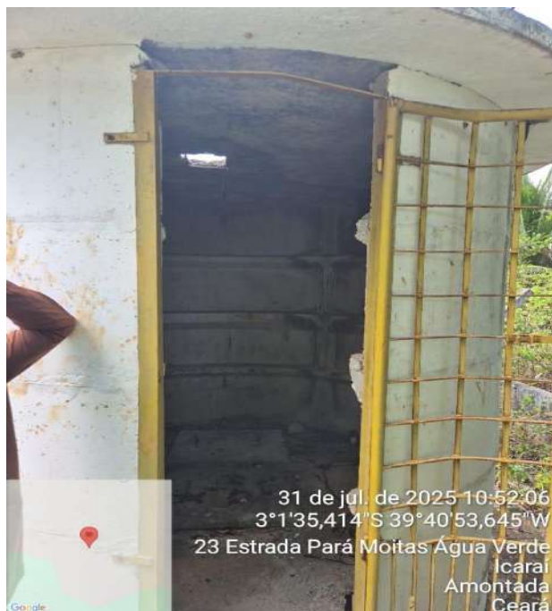
Foto 226 - Acúmulo de sujeira no fundo.
