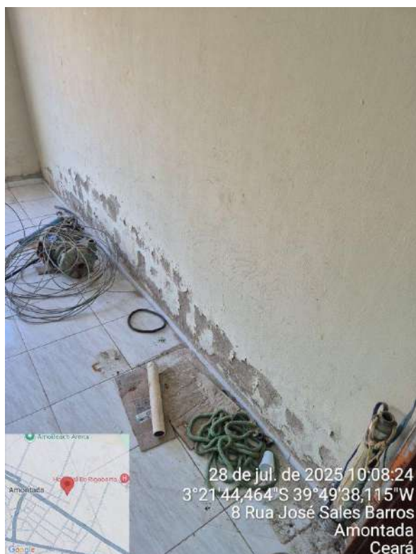
Foto 107 - Armazenamento inadequado de materiais.
