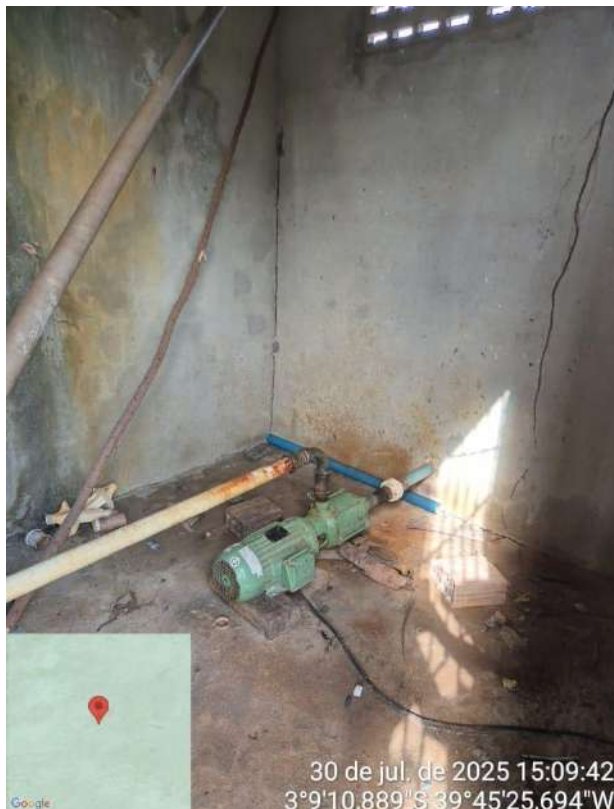
Foto 173 - Base da bomba inadequada.
