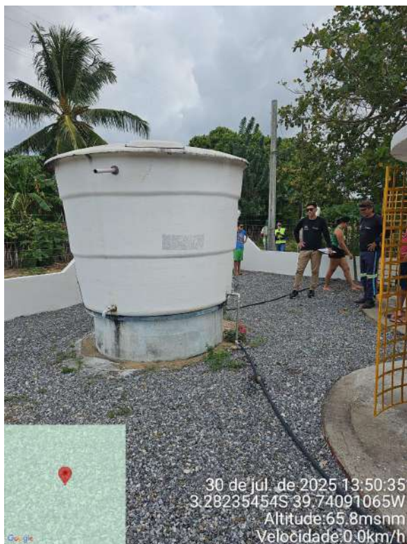
Foto 49 - Poço/Cloração de Arengas.
