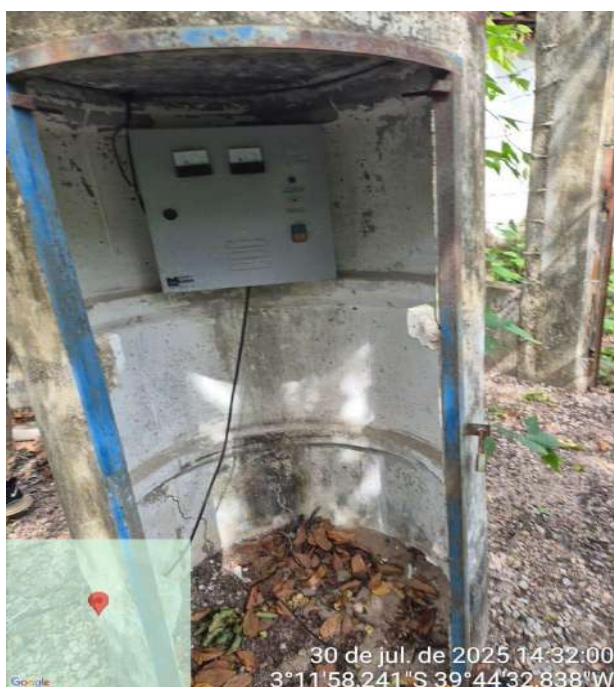
Foto 201 - Porta da casa de comando quebrada.
