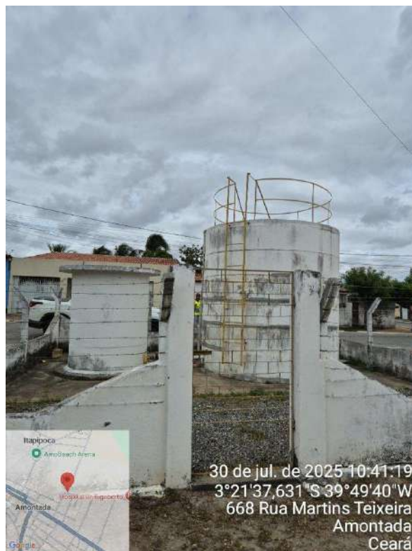
Foto 35 - Recalque do Cipoal/Mazagão.
