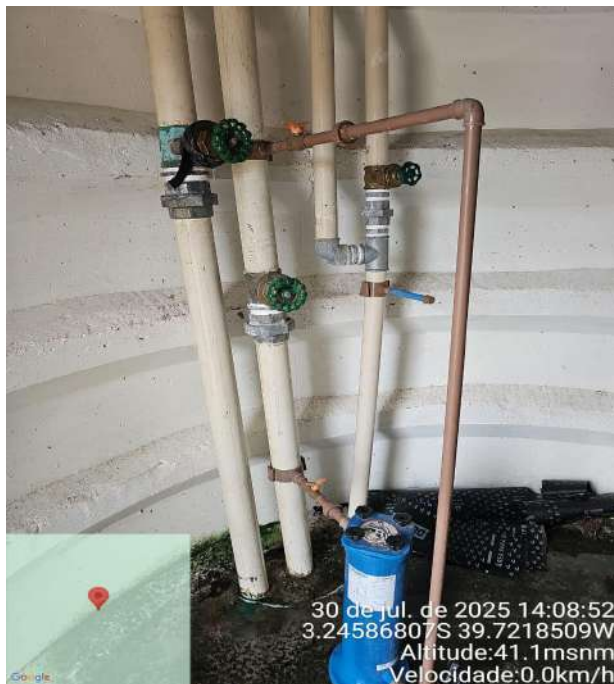
Foto 165 - Presença de vazamento.
