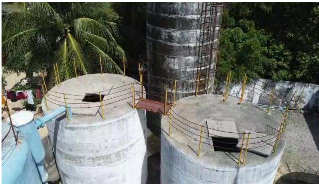
Foto 247 - Reservatórios com tampas deslocadas.
