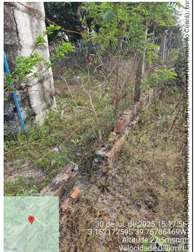
Foto 178 - Cerca com defeito e mureta quebrada.
