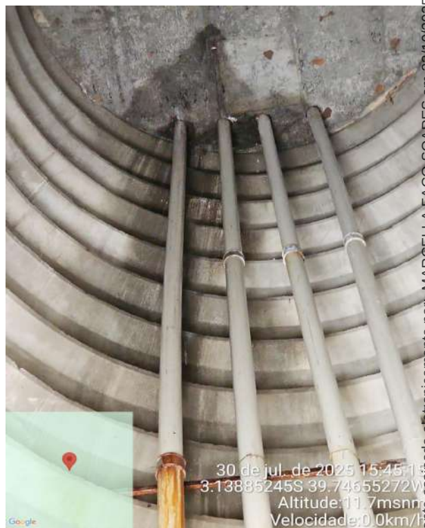
Foto 194 - Presença de vazamento.
