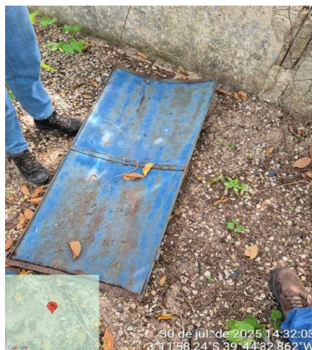
Foto 202 - Porta da casa de comando quebrada.
