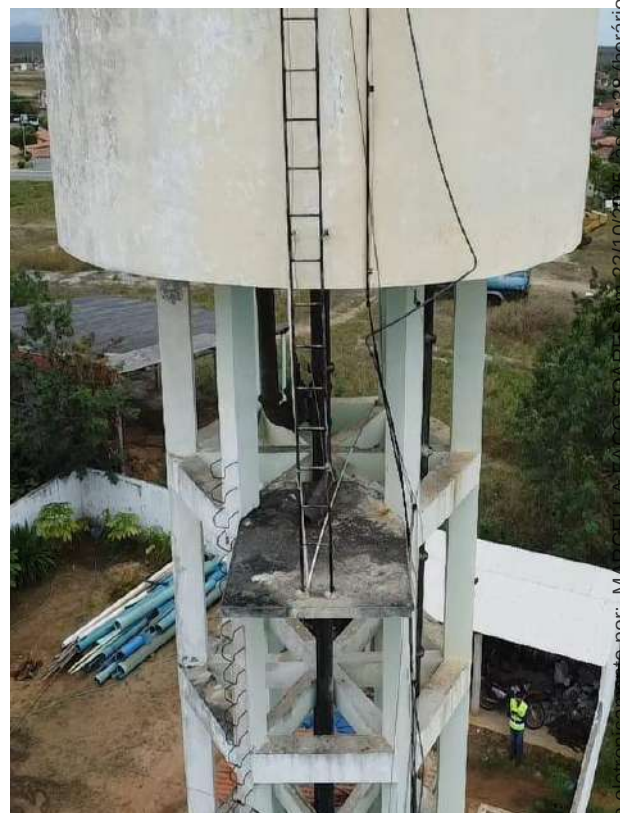
Foto 157 - Escada inadequada, oxidada e sem guarda-corpo.
