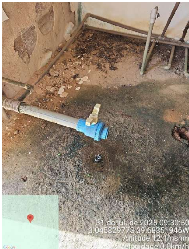
Foto 218 - Vazamento no registro.
