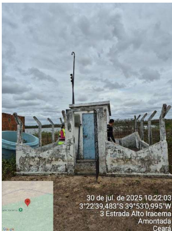
Foto 5 - Captação de Nascente/Casa de Comando (Açude Iracema).
