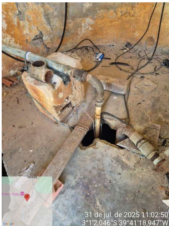
Foto 89 - Captação Moitas (Poço 3) - Casa do Valdo.
