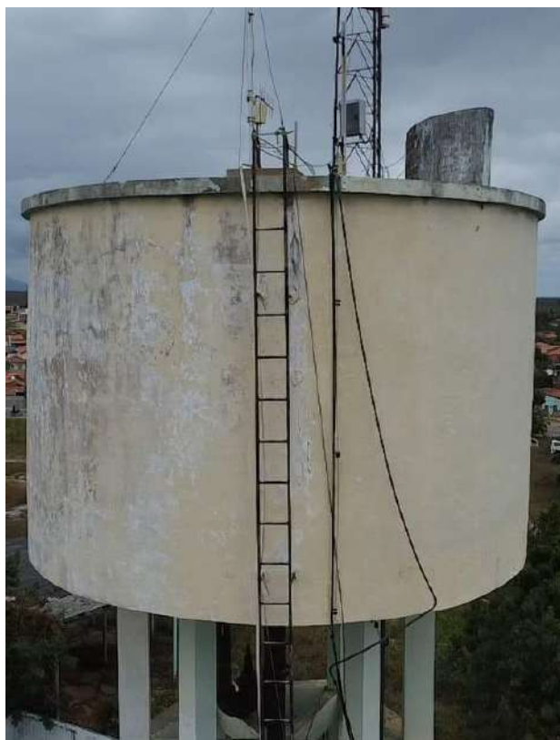
Foto 156 - Escada inadequada, oxidada e sem guarda-corpo.
