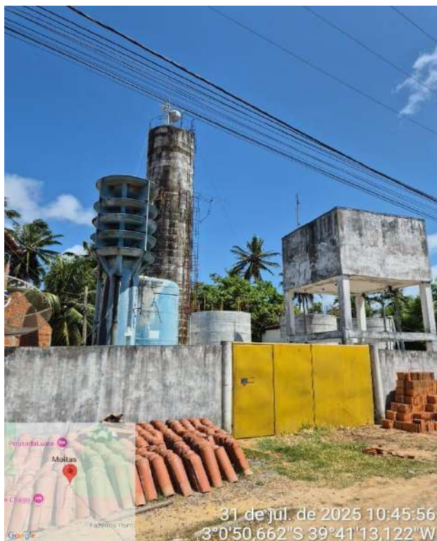
Foto 234 - Sem identificação e pintura deteriorada.
