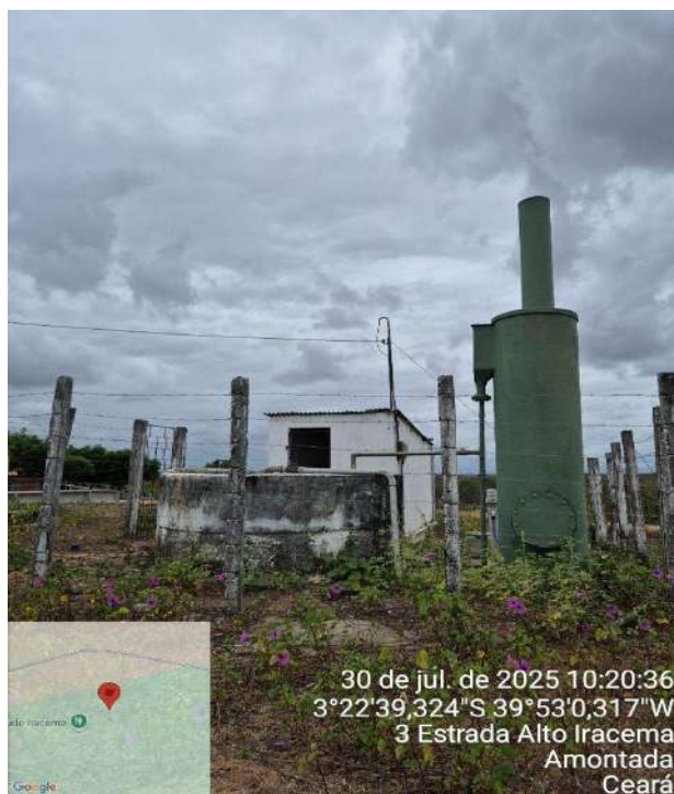
Foto 113 - Ausência de identificação e pintura deteriorada.
