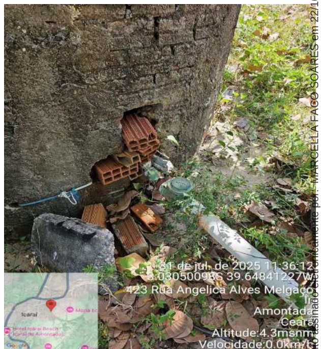
Foto 251 - Parede externa com defeito.
