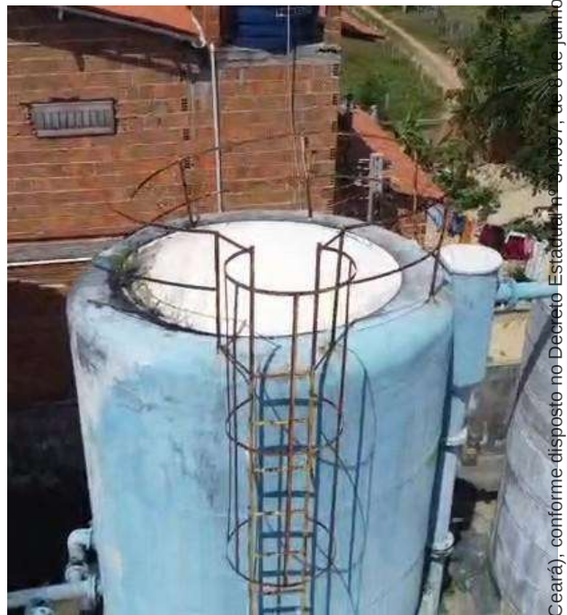
Foto 249 - Escada oxidada e guarda-corpo danificado.
