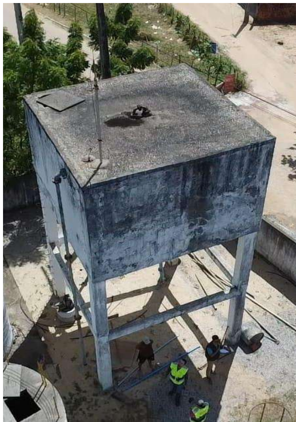
Foto 81 - ETA de Moitas/RAP (desativado).
