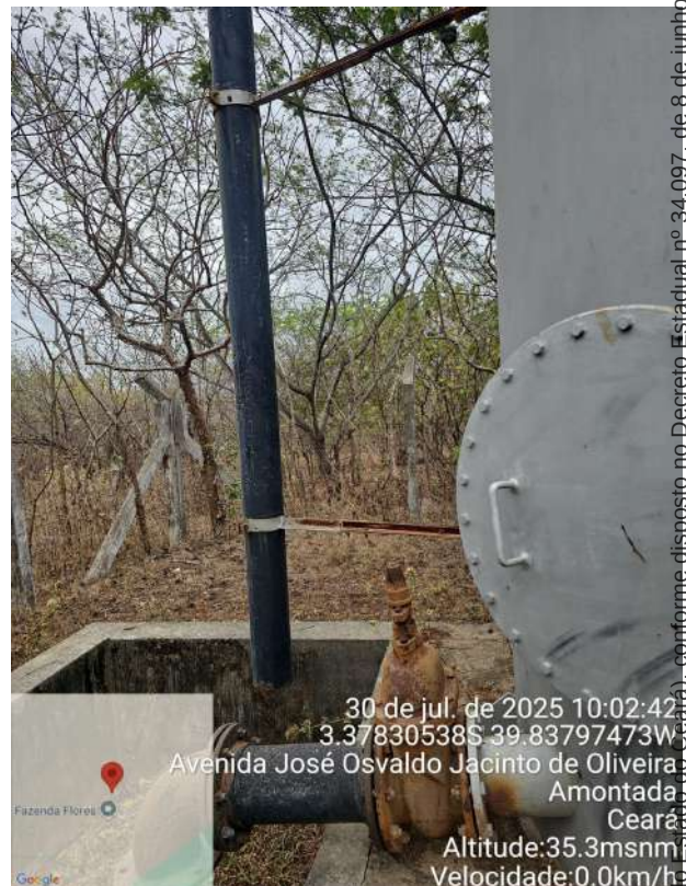
Foto 139 - Presença de oxidação.
