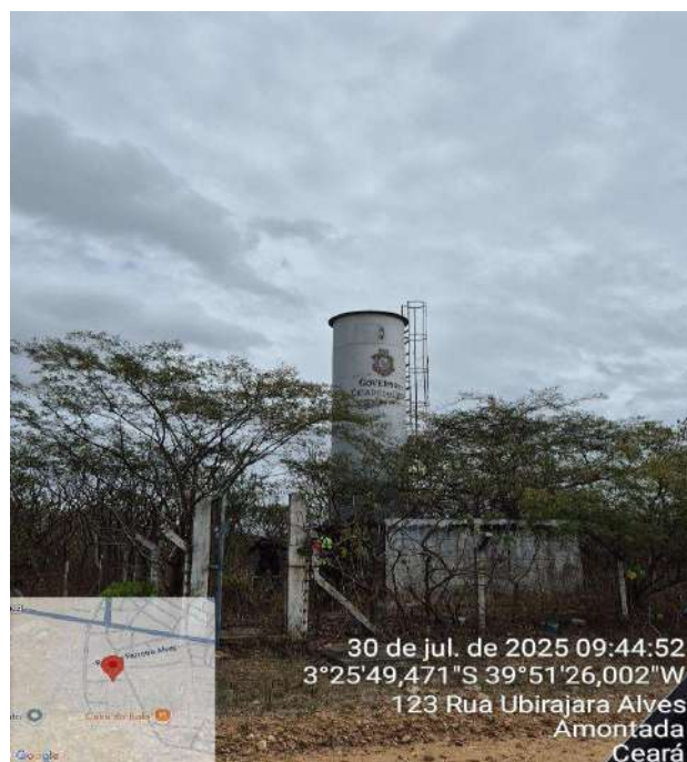
Foto 126 - Excesso de vegetação.
