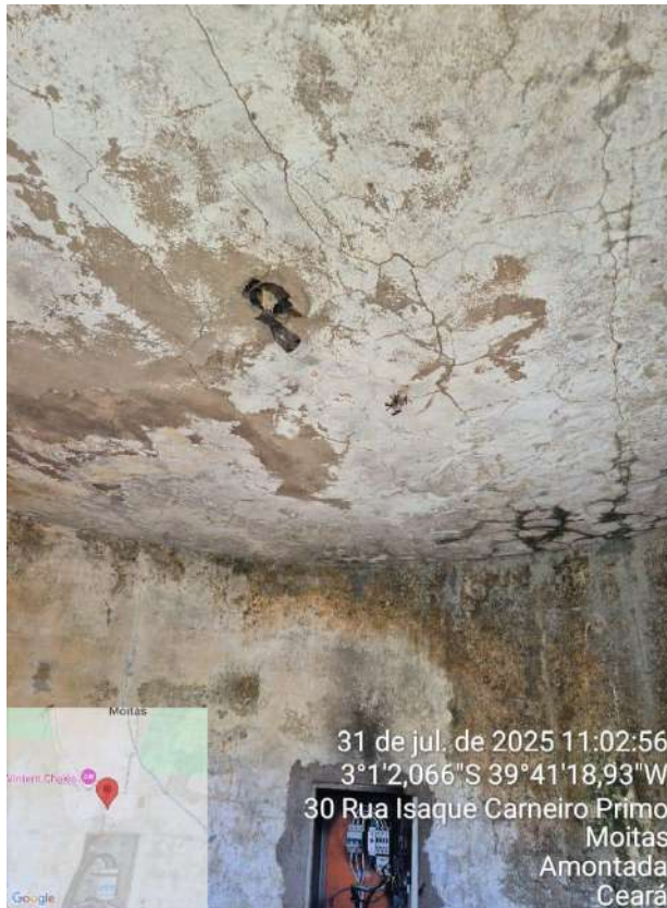
Foto 232 - Pintura deteriorada e ausência de iluminação.
