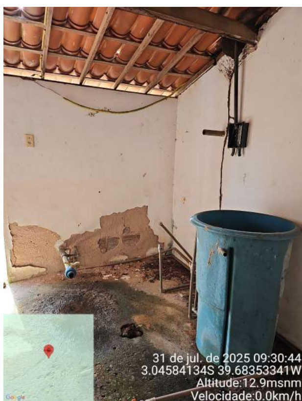
Foto 216 - Parede com reboco caindo e presença de cupim.
