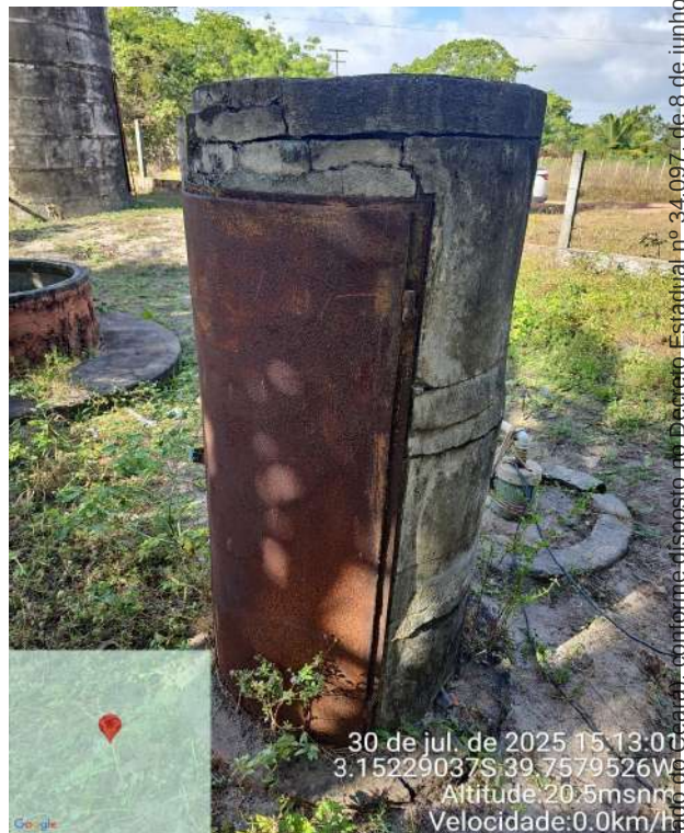
Foto 188 - Quadro de comando em péssimo estado de conservação.
