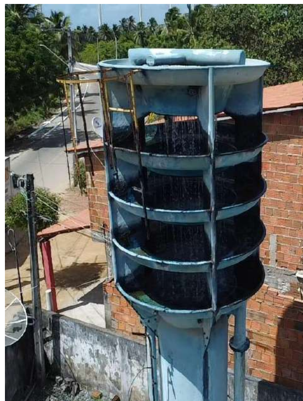
Foto 246 - Escada oxidada e danificada.
