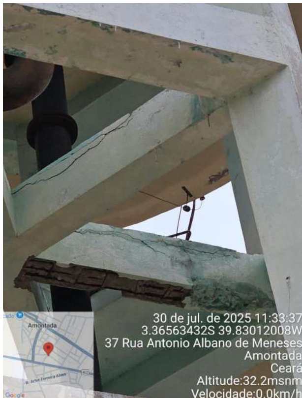
Foto 158 - Armadura exposta e rachaduras.
