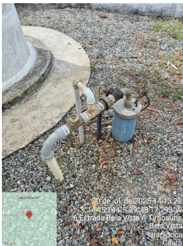
Foto 51 - Poço de Lagoa Grande 2.
