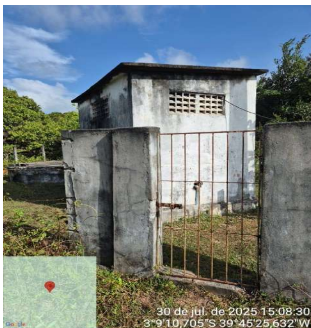
Foto 169 - Ausência de identificação.
