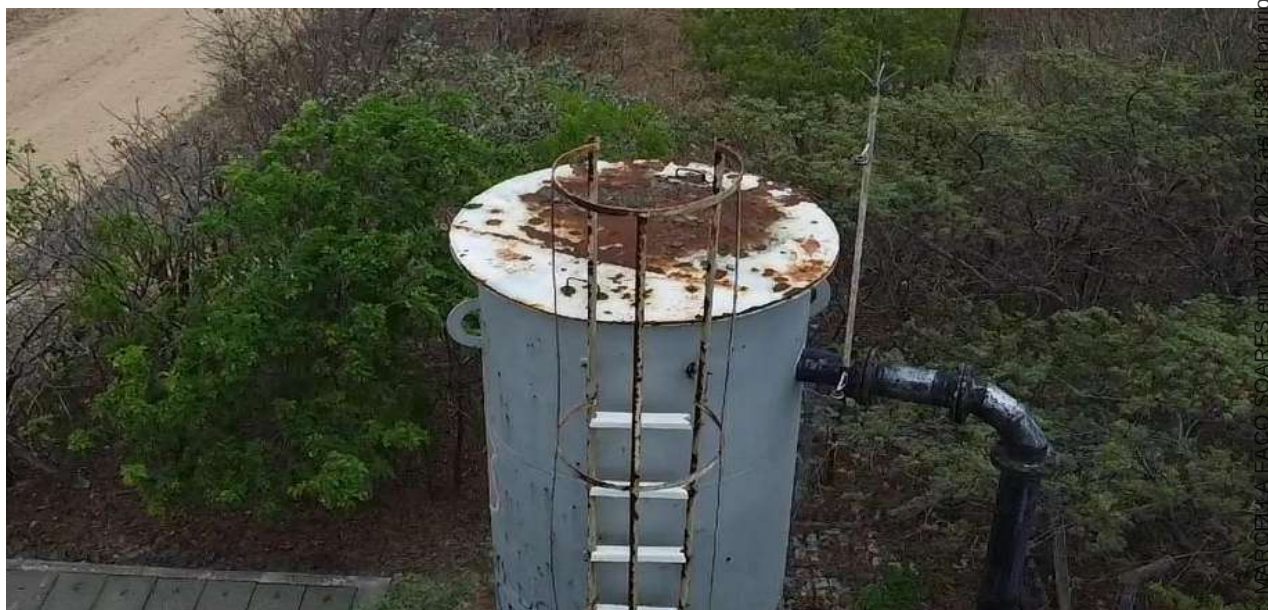
Foto 140 - Presença de oxidação.
