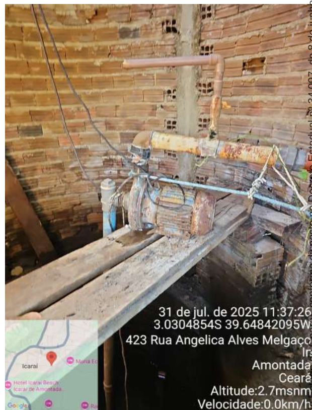
Foto 253 - Estrutura precária, base da bomba e fiação inadequadas.
