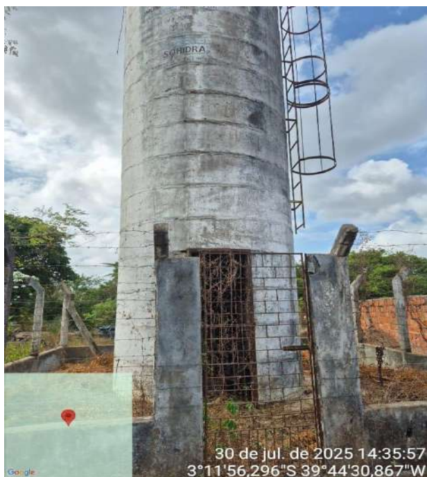
Foto 203 - Sem identificação e pintura deteriorada.
