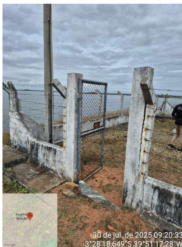
Foto 9 - Captação da Sede (Açude Missi).
