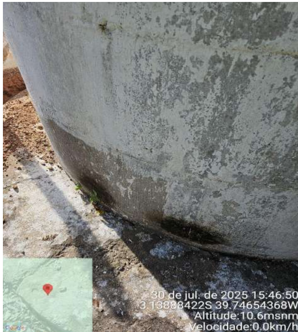
Foto 195 - Presença de vazamento.
