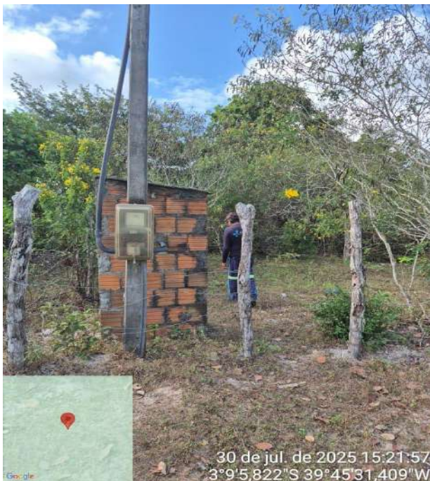
Foto 189 - Ausência de identificação.
