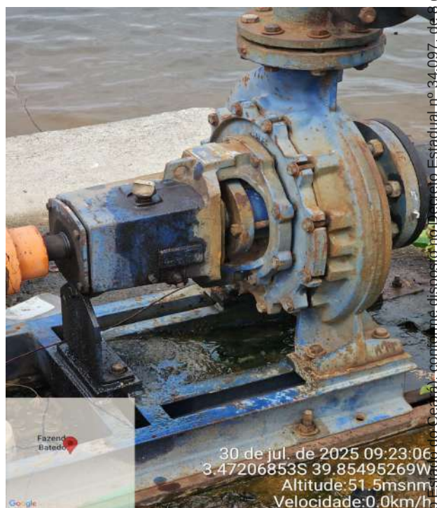
Foto 116 - Vazamento na bomba.
