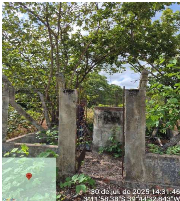
Foto 197 - Sem identificação e pintura deteriorada.
