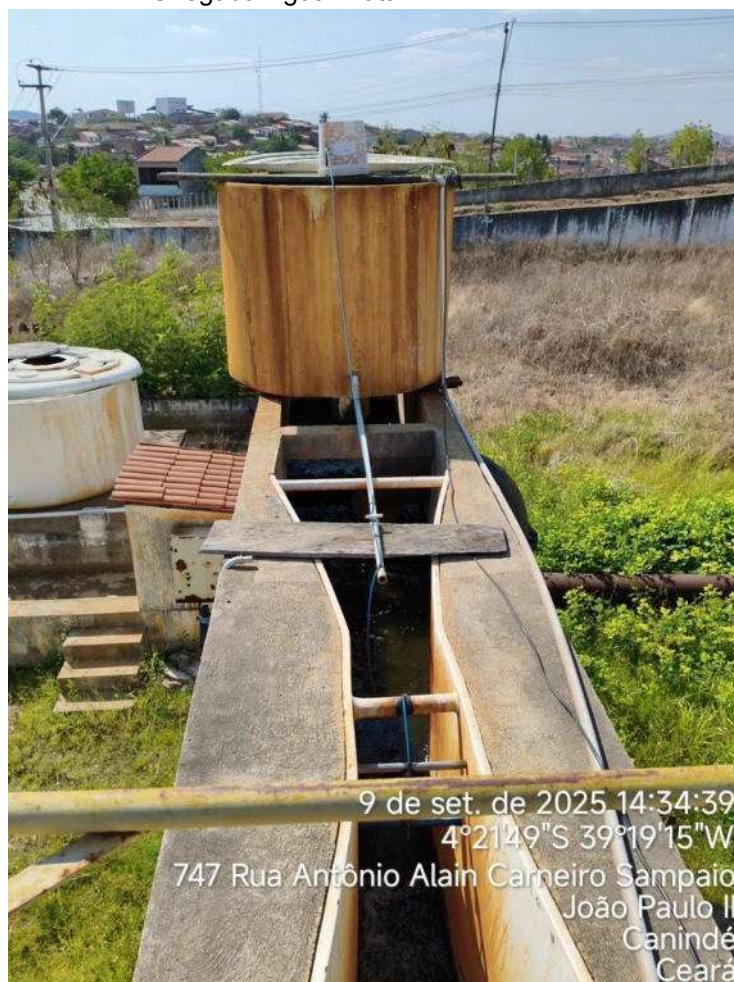
Figura 21 - ETA Nova – Oportunidades de Melhorias - Chegada Água Bruta.
