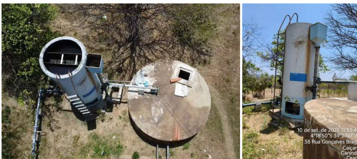
Figura 35 - Localidade de Caiçara – ETA - Filtro.
