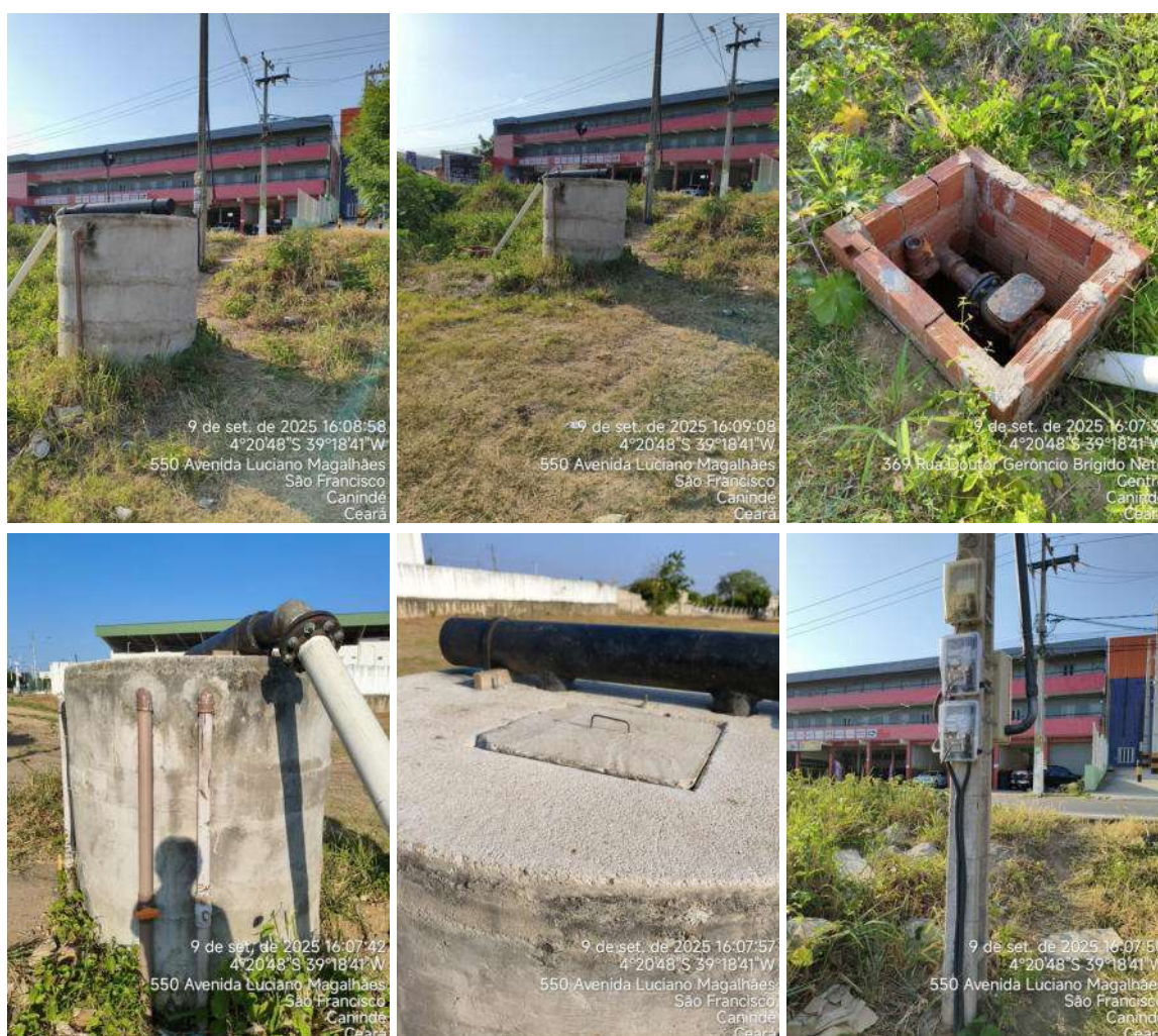
Figura 32 - Booster do Loteamento Juazeiro.
