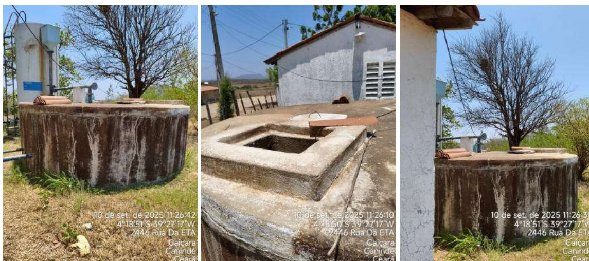
Figura 36 - Localidade de Caiçara – ETA - RAP.
