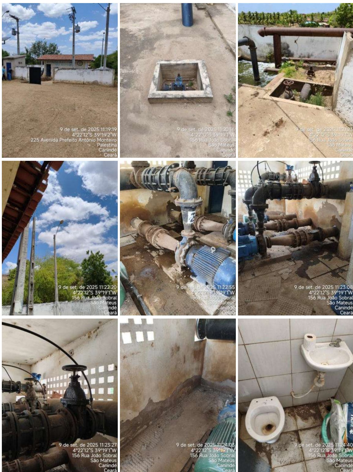
Figura 10 - Captação Açude São Mateus – Oportunidades de Melhorias.
