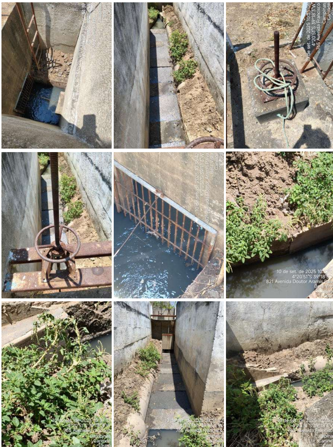
Figura 40 - EEE – SES da Sede de Canindé - Tratamento Preliminar.
