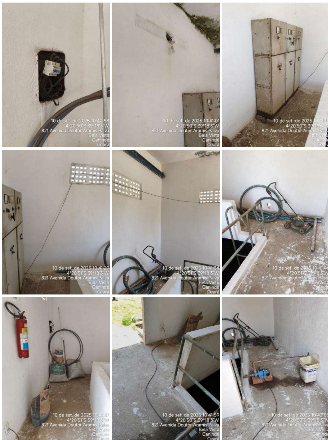
Figura 41 - EEE – SES da Sede de Canindé - Sala Quadro de Comandos.
