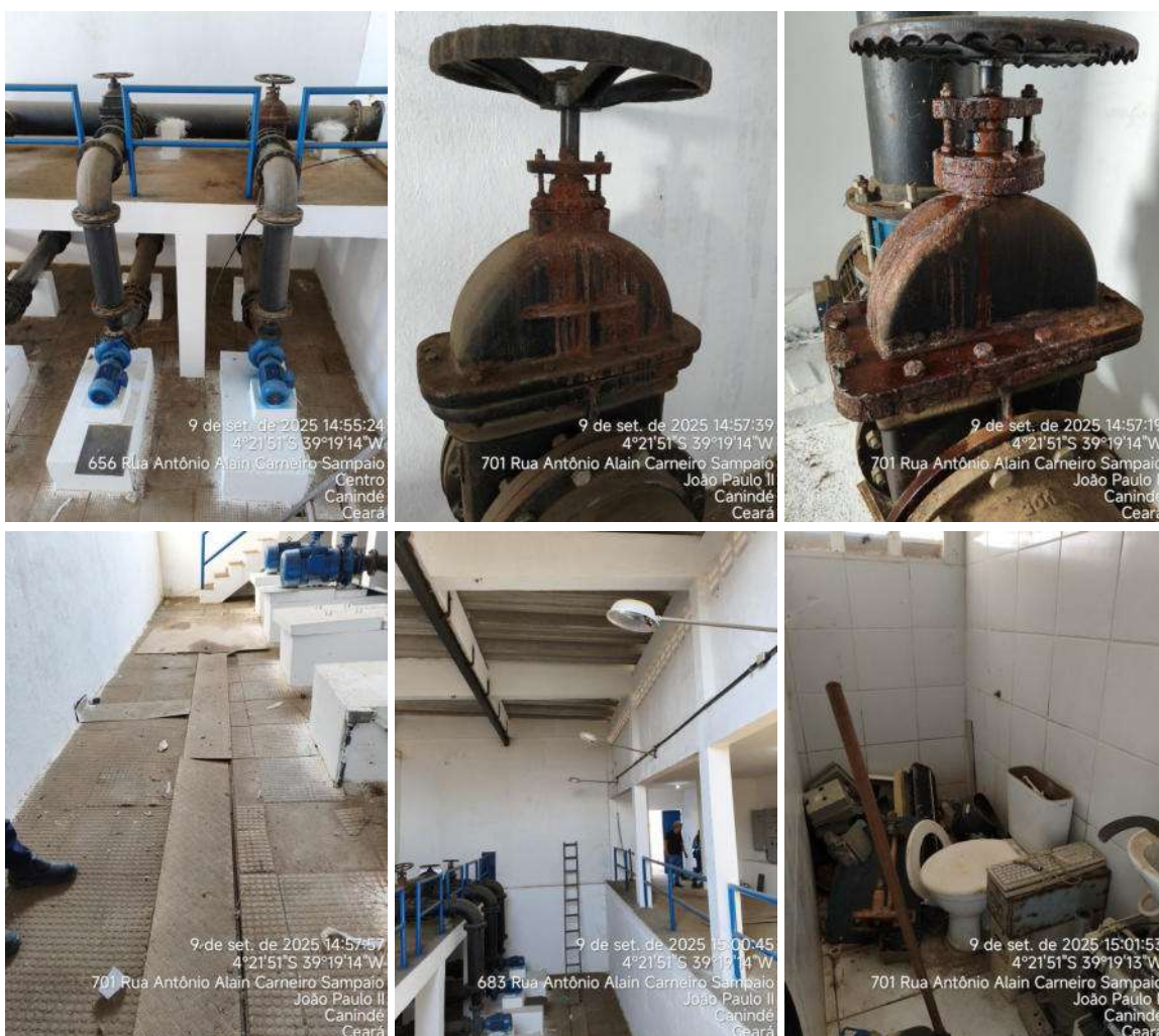
Figura 25 - ETA Nova – Oportunidades de Melhorias – Casa de Bombas.
