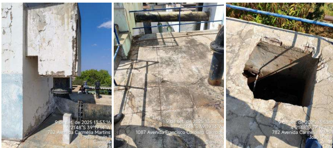
Figura 15 - ETA Antiga – Oportunidades de Melhorias – RAP_Pós-Filtros.
