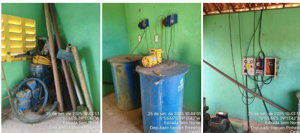
Figura 20 - ETA / Casa de Química e de Bombas.
