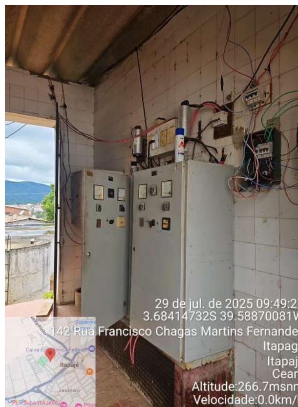
Foto 38 - Painéis de controle sem aviso de perigo, com fiação sem eletrodutos, sem iluminação.
