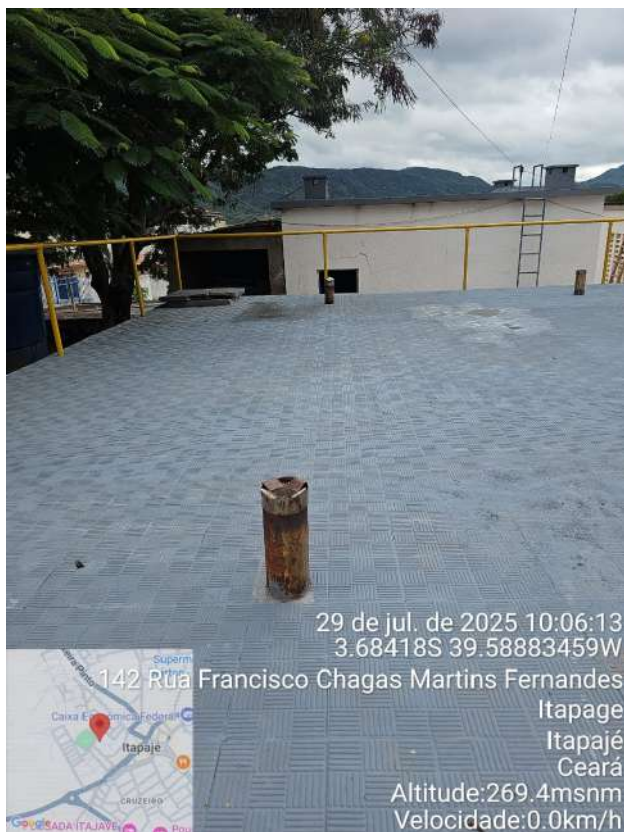
Foto 54 - Reservatório de desinfecção com suspiro sem proteção.
