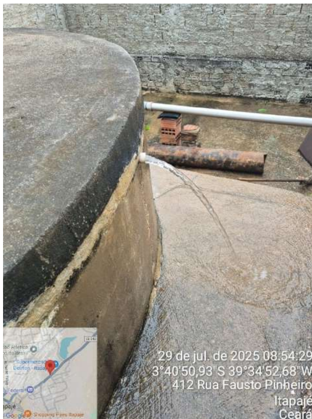
Foto 23 - EEAT automatizada mas com boia quebrada.
