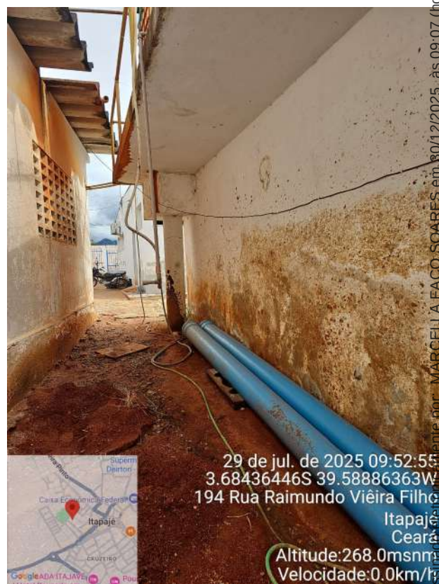
Foto 49 - Paredes e pisos com sujidades desgastados.
