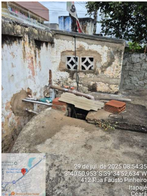
Foto 25 - RAP sem vedação, com fechamento precário e improvisado.
