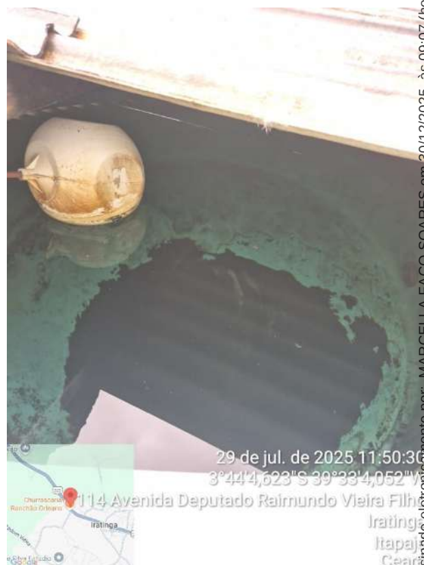
Foto 71 - Água com presença de lodo.
