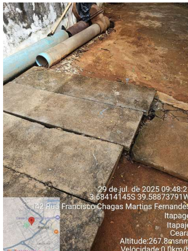
Foto 36 - Placas desgastadas, com rachaduras no piso.
