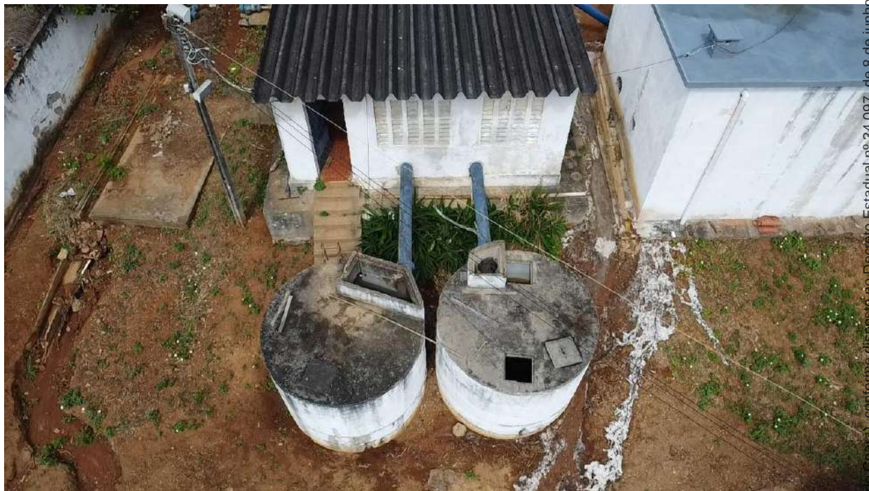
Foto 57 - Reservatórios sem vedação adequada, com tampa deslocada ou sem nenhuma.
