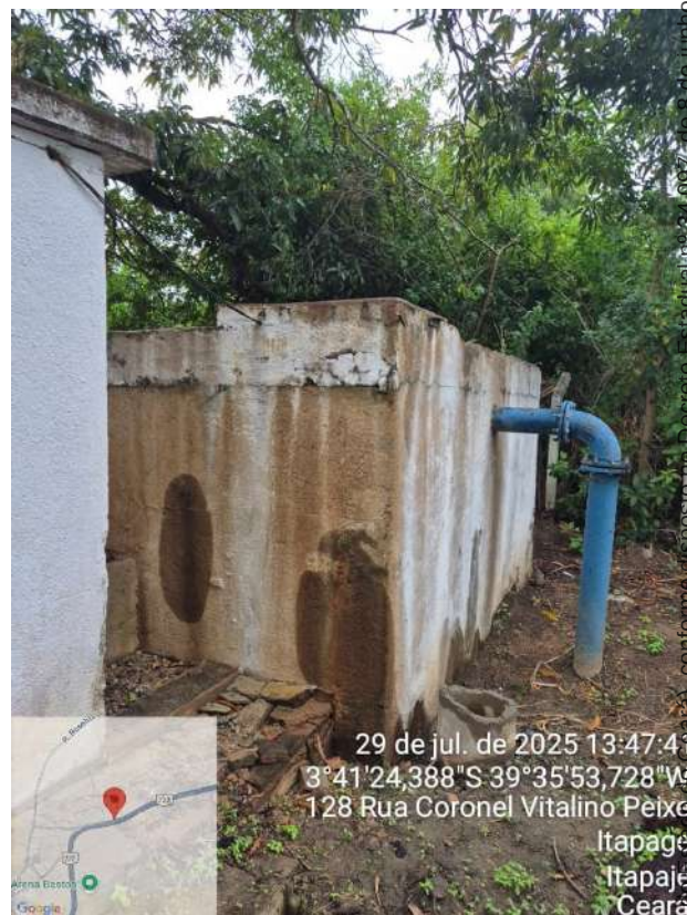
Foto 84 - Reservatório com pintura desgastada, sujidades, pontos de vazamento e rachaduras.
