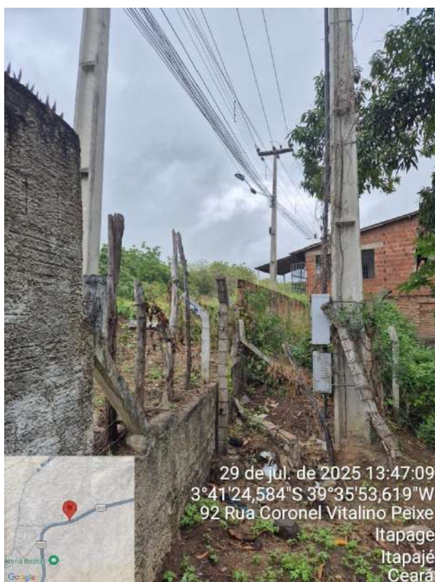
Foto 81 - Cerca parcialmente quebrada, sem isolamento adequado.
