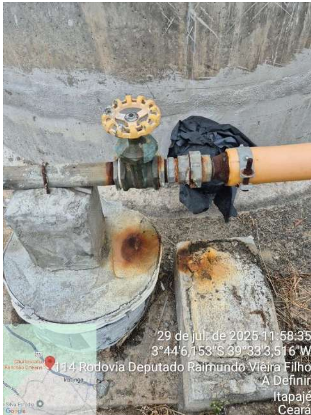
Foto 77 - Tubulações das bombas oxidadas, com vazamento e sacola improvisada como vedação.
