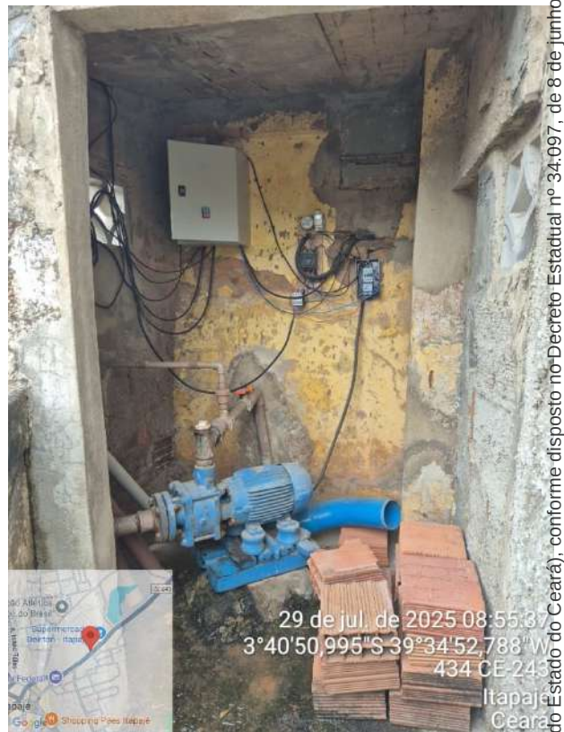
Foto 26 - Bomba sem apoio adequado, com fiação exposta sem eletrodutos e parede deteriorada, teto com armadura exposta.
