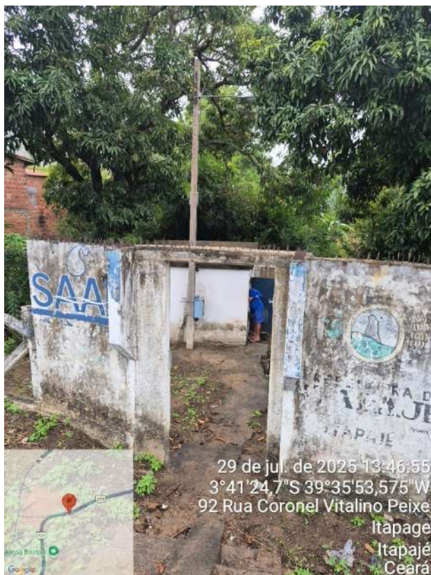
Foto 79 - Parede desgastada e sem portão para limitar o acesso.
