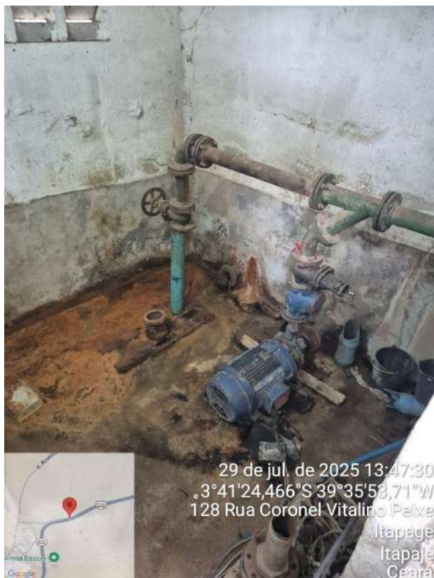
Foto 83 - Tubulações das bombas oxidadas, piso desgastado, com fiação exposta.
