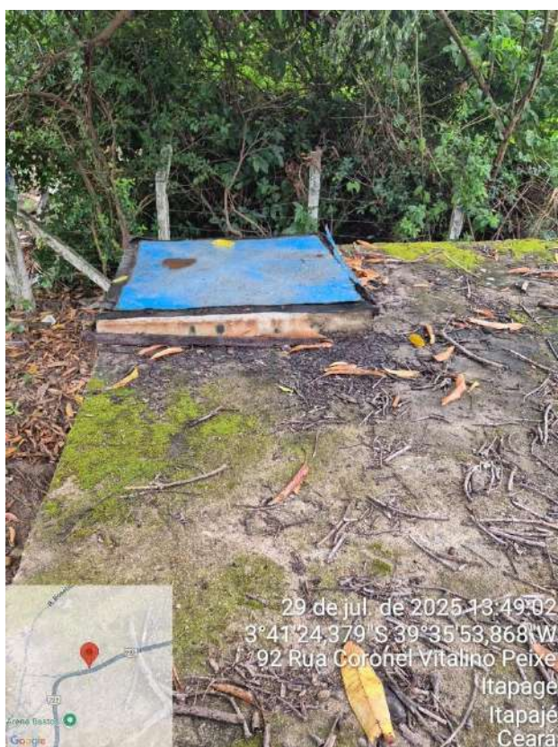
Foto 85 - Reservatório com pintura desgastada, sujidades, pontos de vazamento e rachaduras.
