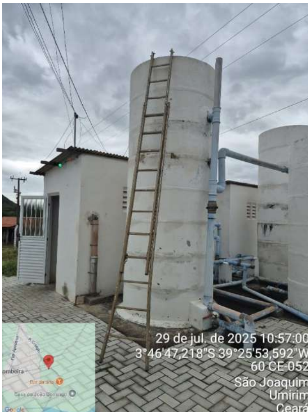
Foto 64 - Escada dos filtros improvisada e inadequada, sem apoio adequado ou guarda-corpo.
