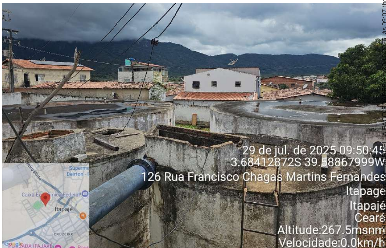
Foto 41 - Reservatório sem suspiro.
