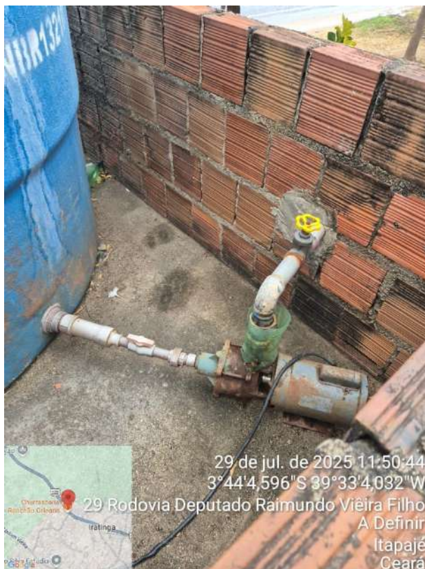
Foto 68 - Tubulação com peças oxidadas, com uso de materiais improvisados.
