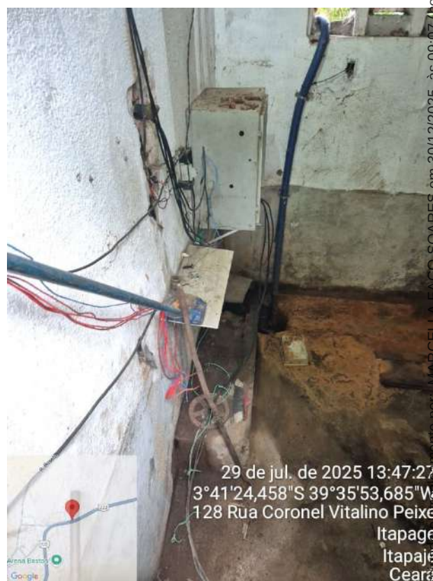
Foto 82 - Fiação exposta sem eletrodutos, com risco de acidentes.
