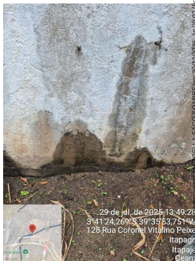
Foto 86 - Reservatório com pintura desgastada, sujidades, pontos de vazamento e rachaduras.
