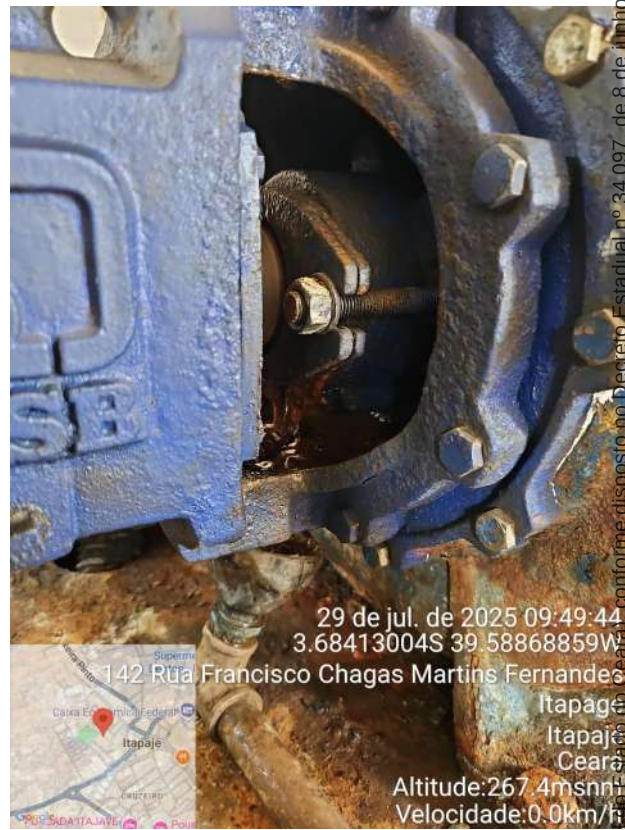
Foto 40 - Bomba com vazamento e válvula apresentando ruído.
