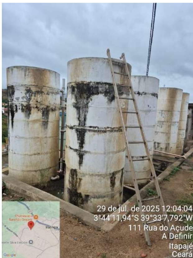
Foto 75 - Filtros desgastados, escada improvisada, sem apoio adequado ou guarda-corpo.
