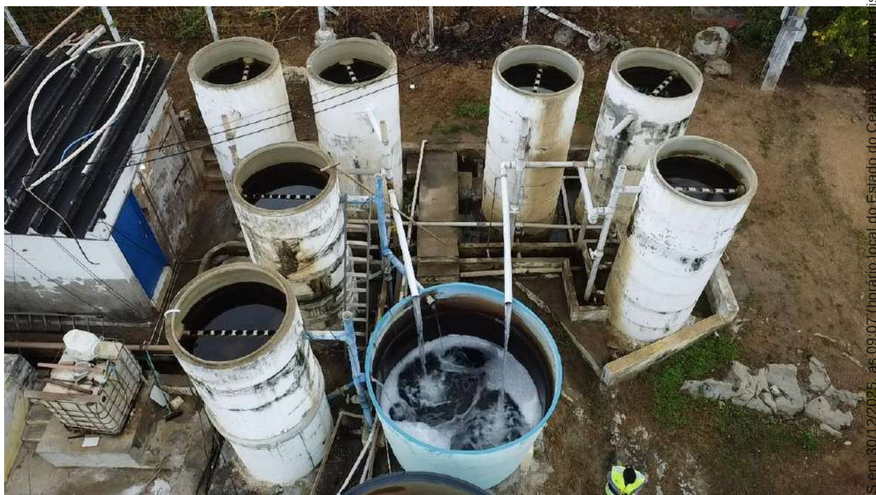
Foto 72 - Filtros, decantadores e floculadores com armadura exposta, vazamentos e pintura desgastada.
