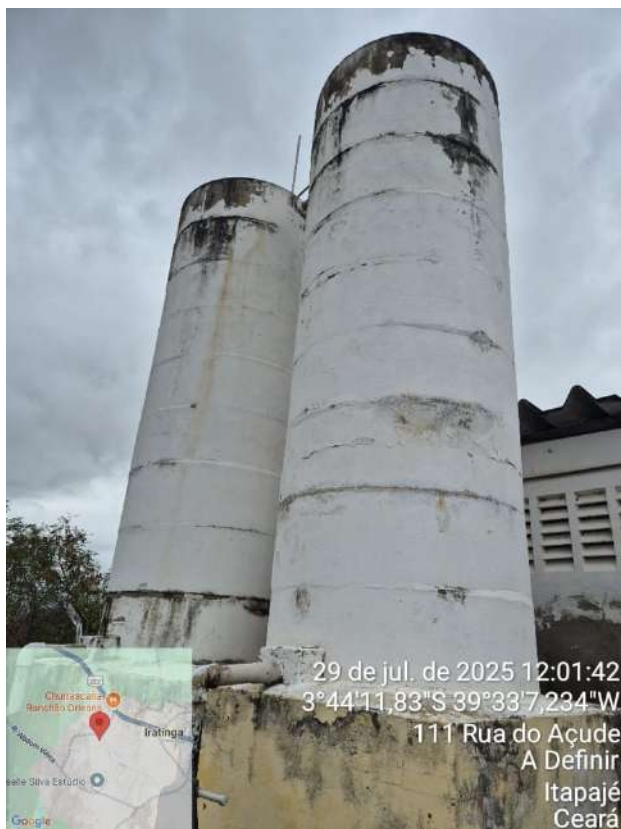
Foto 73 - Filtros, decantadores e floculadores com armadura exposta, vazamentos e pintura desgastada.
