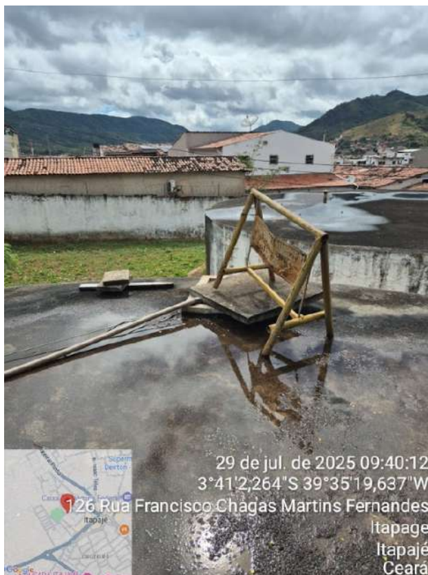
Foto 42 - Reservatório com tampa deslocada, com cavalete inadequado como apoio.
