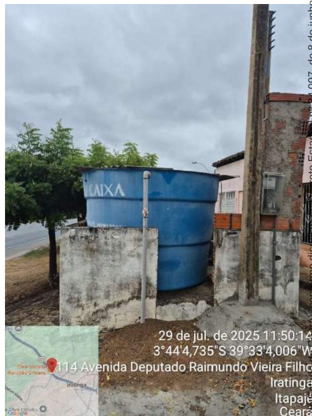
Foto 69 - Caixa d'água sem cercamento de proteção, acessível à população.
