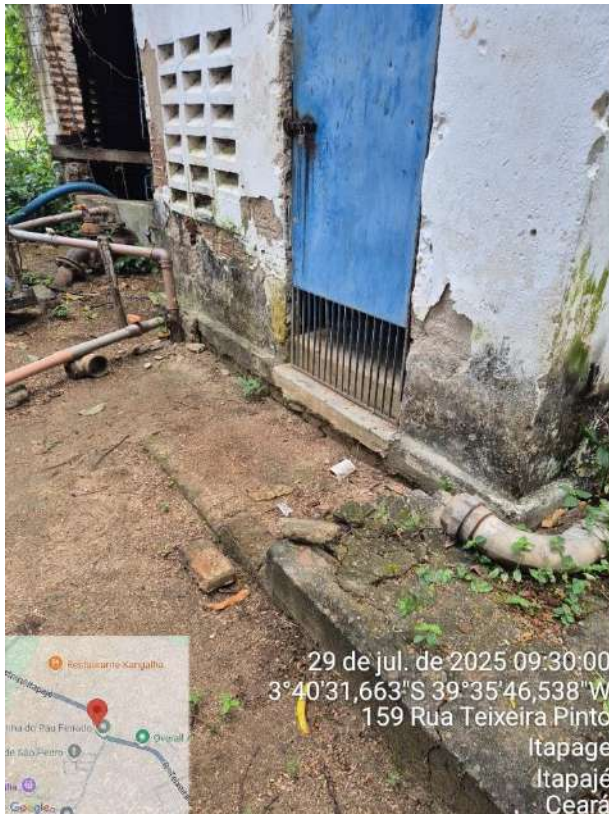
Foto 31 - Parede da estrutura deteriorada, com manchas de lodo e mofo e rachaduras.
