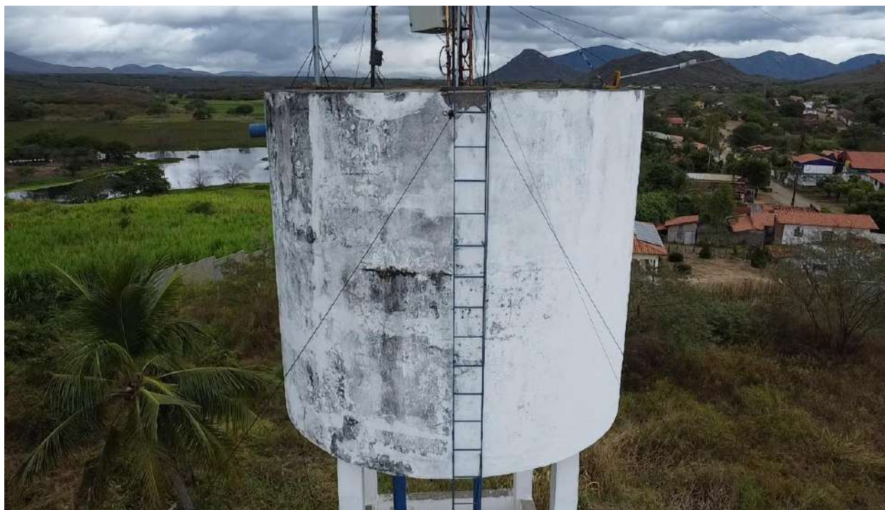
Foto 60 - REL sem tampa, escada e reservatório sem guarda-corpo, fiação solta na parte superior apresentando riscos operacionais, pintura desgastada e rachaduras.
