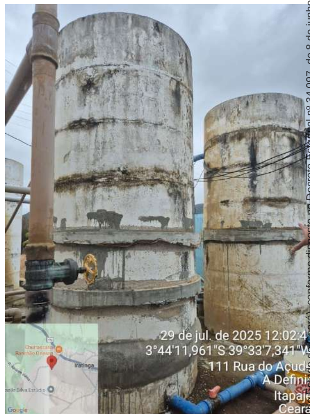
Foto 74 - Filtros, decantadores e floculadores com armadura exposta, vazamentos e pintura desgastada.
