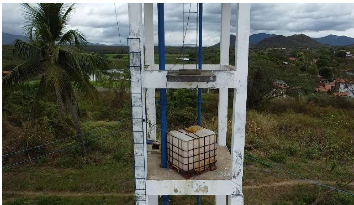
Foto 61 - REL com tanque de cloro no patamar intermediário com armaduras de proteção oxidadas e abertura inadequada, espaço sem guarda-corpo.
