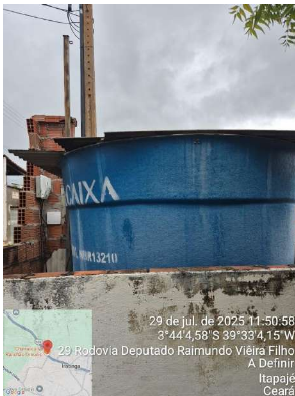
Foto 9 - Booster São Cristóvão.
