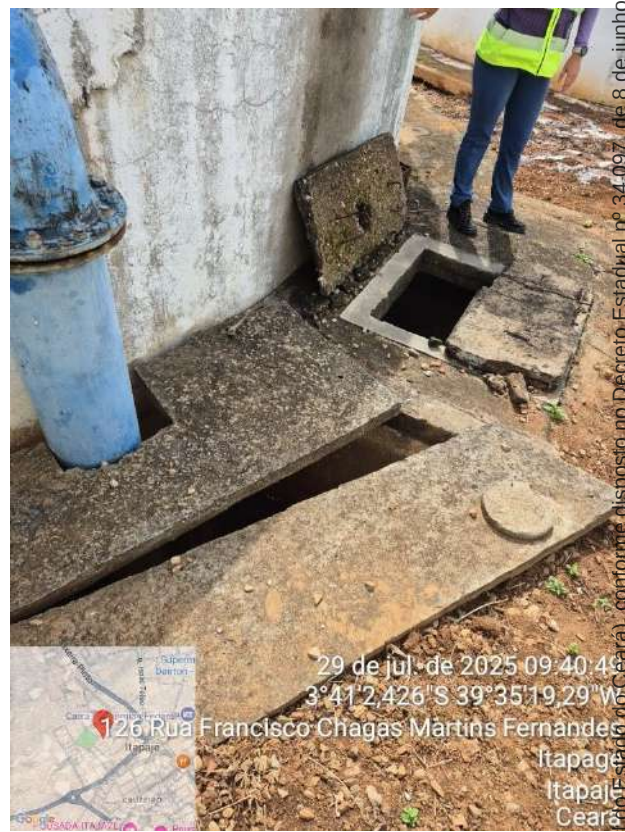
Foto 47 - Tampas quebradas ou deslocadas, sem proteção adequada.
