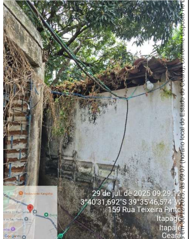
Foto 30 - Parede da estrutura deteriorada, com manchas de lodo e mofo e rachaduras, portão quebrado, sem identificação e proteção adequadas.
