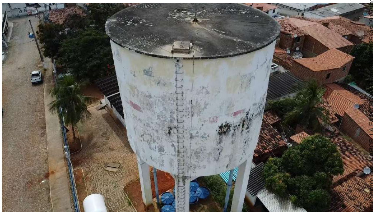
Foto 56 - REL com pintura desgastada, escada e parte superior sem guarda-corpo, fiação presa na escada.
