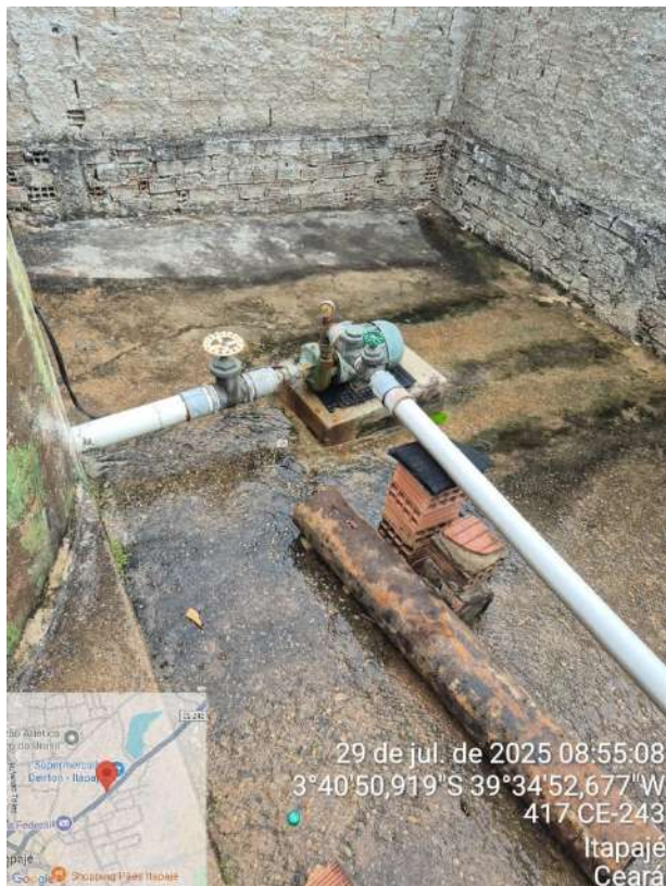
Foto 27 - Tubulação da bomba sem apoio adequado, improvisado.
