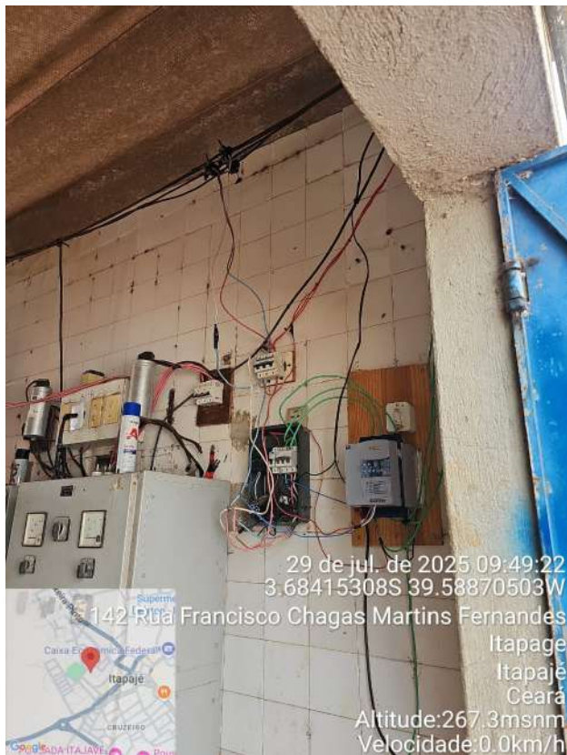
Foto 39 - Painéis de controle sem aviso de perigo, com fiação sem eletrodutos, sem iluminação.
