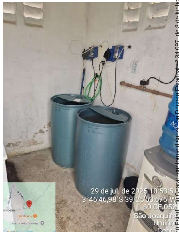
Foto 63 - Tanque de produtos químicos ao lado do bebedouro, sem fechamento.
