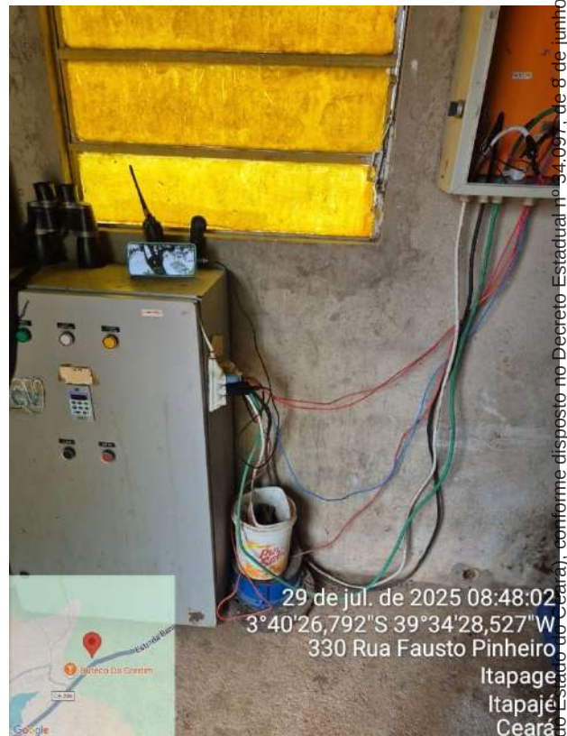
Foto 20 - Fiação exposta sem eletrodutos, com risco de acidentes.
