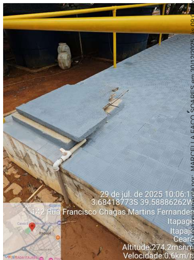
Foto 53 - Tampa do reservatório de desinfecção quebrada, com armadura exposta, paredes desgastadas.
