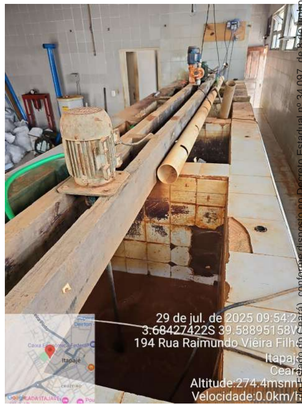
Foto 51 - Tanques de produtos desgastados, com azulejos quebrados e sujidades.
