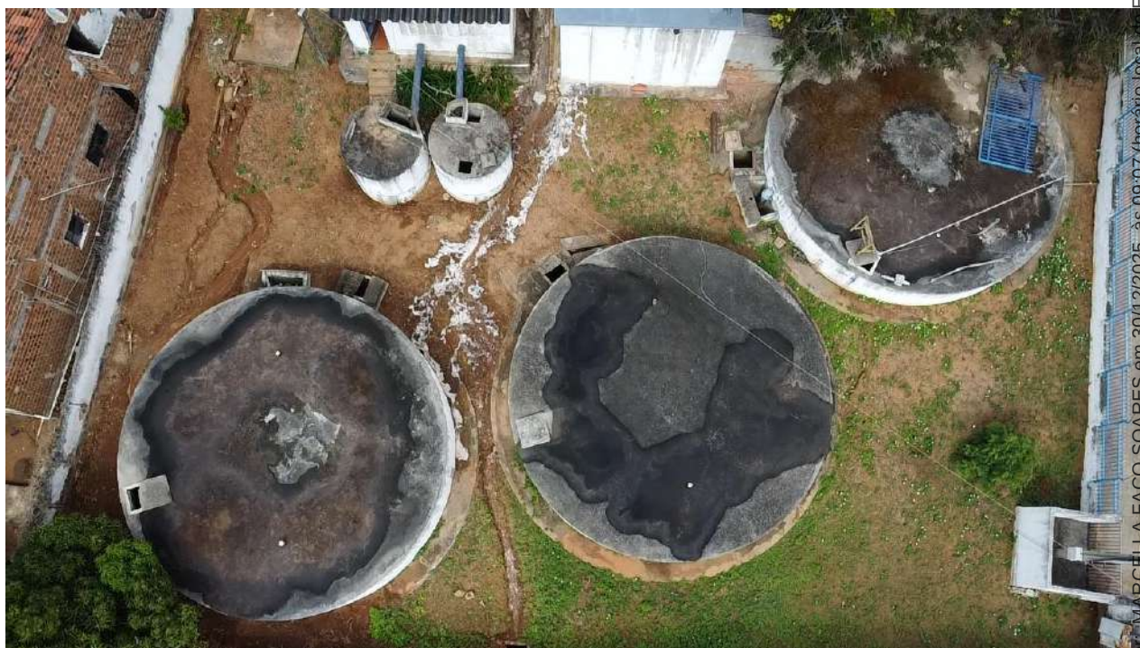
Foto 58 - Reservatórios sem vedação adequada, com tampa deslocada ou sem nenhuma.
