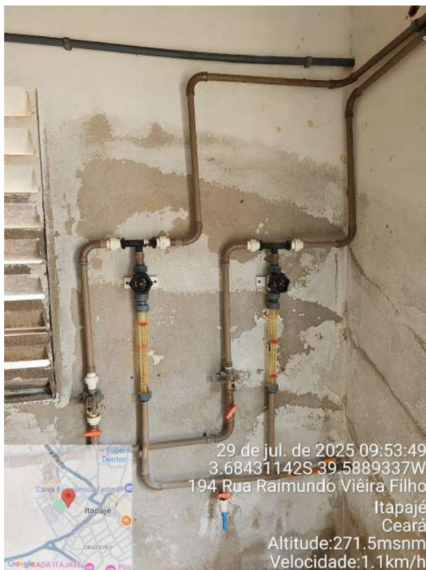
Foto 50 - Fiação exposta sem eletrodutos, com risco de acidentes.
