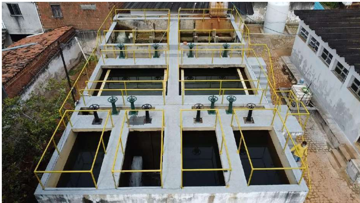
Foto 4 - ETA Itapajé - Tratamento.
