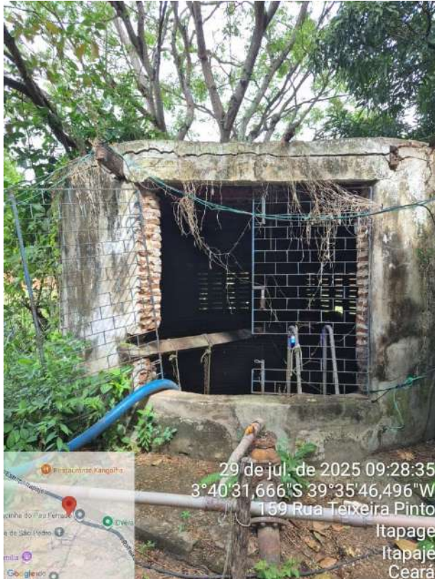
Foto 29 - Parede da estrutura deteriorada, com manchas de lodo e mofo e rachaduras, portão quebrado, sem identificação e proteção adequadas.
