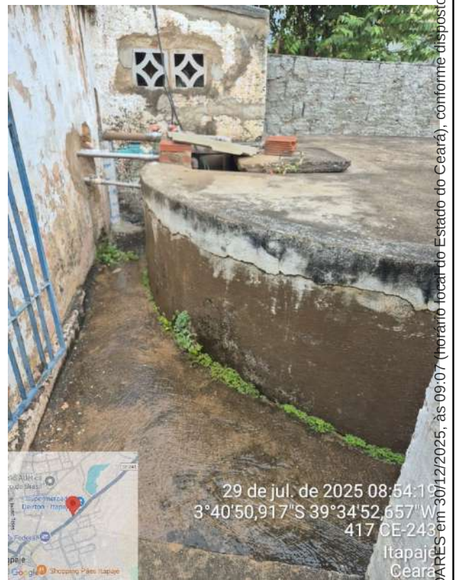
Foto 24 - RAP com pintura desgastada e rachaduras.
