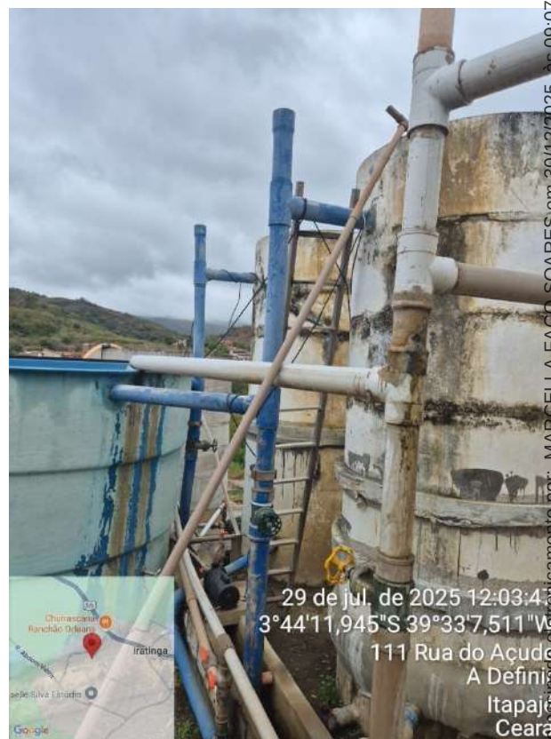
Foto 76 - Filtros desgastados, escada improvisada, sem apoio adequado ou guarda-corpo.
