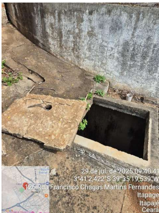
Foto 44 - Tampas quebradas ou deslocadas, sem proteção adequada.
