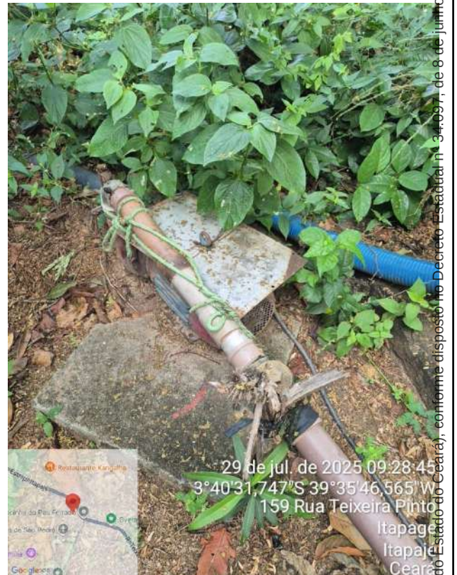
Foto 32 - Tubulação inadequada, com improvisos e peças oxidadas.
