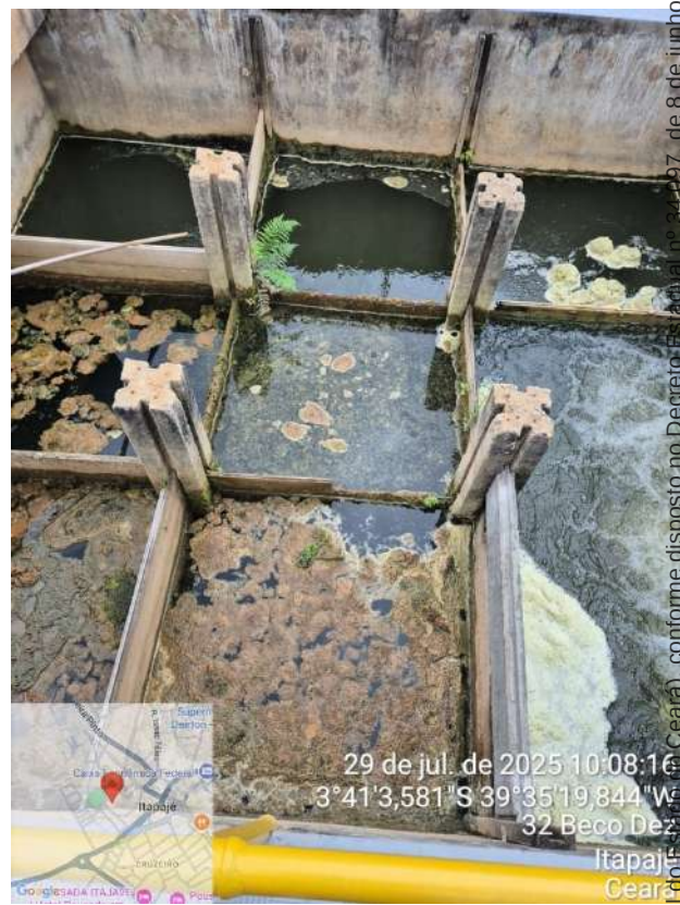
Foto 55 - Floculador com presença de vegetação e estrutura desgastada.
