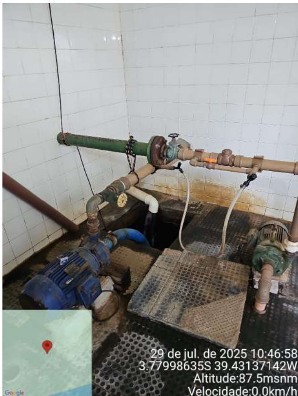
Foto 62 - Tubulação da bomba de recalque oxidada e segurada por cordas, sem fechamento adequado do piso.
