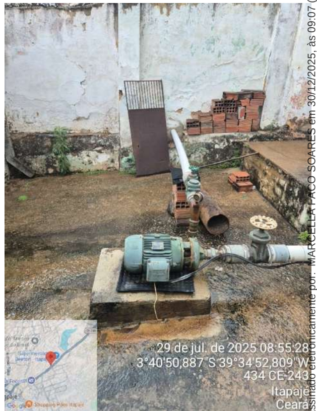
Foto 28 - Tubulação da bomba sem apoio adequado, improvisado.
