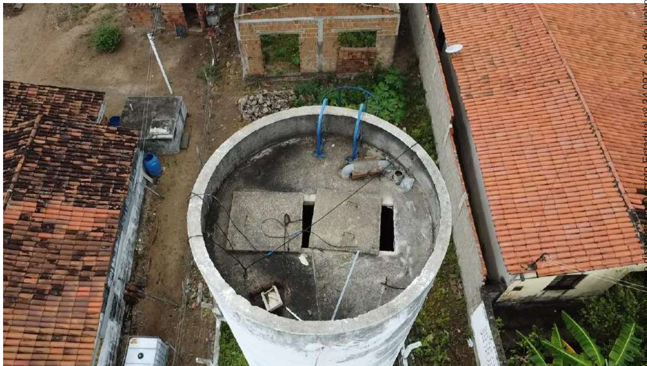
Foto 89 - REL com tampa deslocada, sem vedação adequada.
