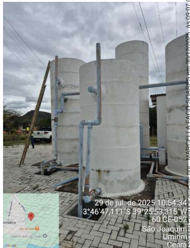
Foto 65 - Filtros com marcas de vazamento e oxidação, tinta das tubulações desgastadas.
