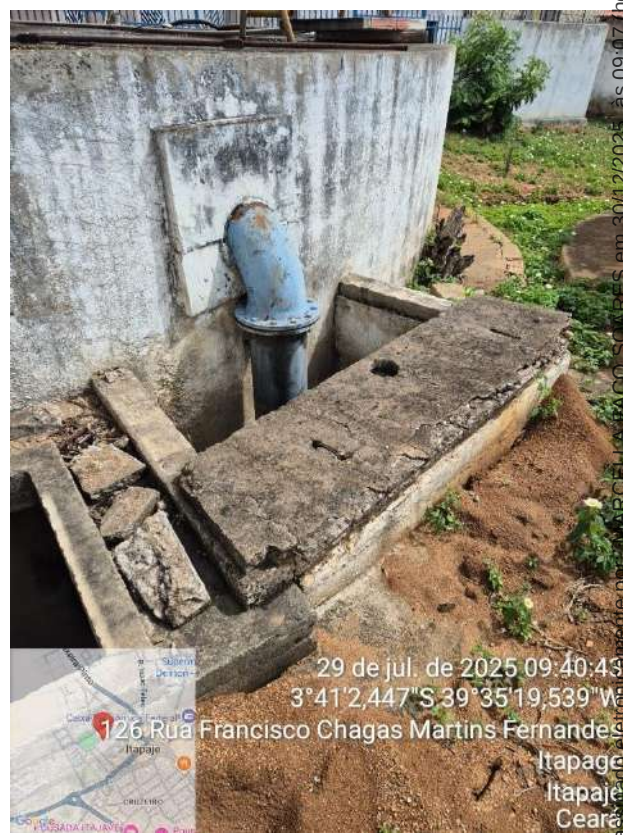
Foto 45 - Tampas quebradas ou deslocadas, sem proteção adequada.
