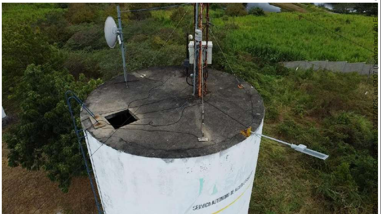
Foto 59 - REL sem tampa, escada e reservatório sem guarda-corpo, fiação solta na parte superior apresentando riscos operacionais, pintura desgastada e rachaduras.
