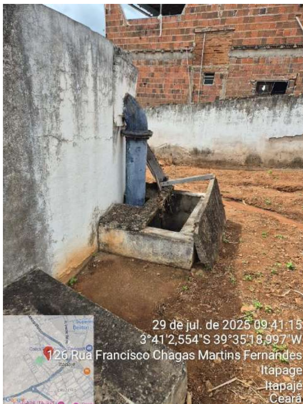
Foto 46 - Tampas quebradas ou deslocadas, sem proteção adequada.
