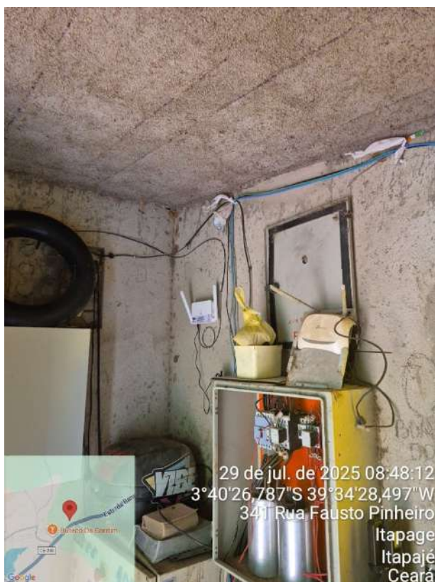
Foto 21 - Tubulações das bombas oxidadas e com vazamento.
