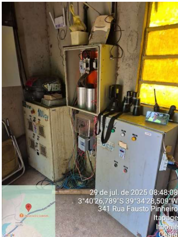
Foto 19 - Fiação exposta sem eletrodutos, com risco de acidentes.
