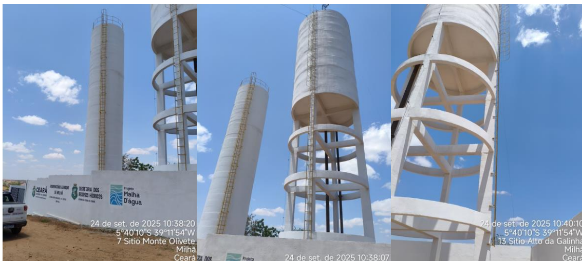
Figura 16 - Reservatório Elevado / Projeto Malha D'Água..
