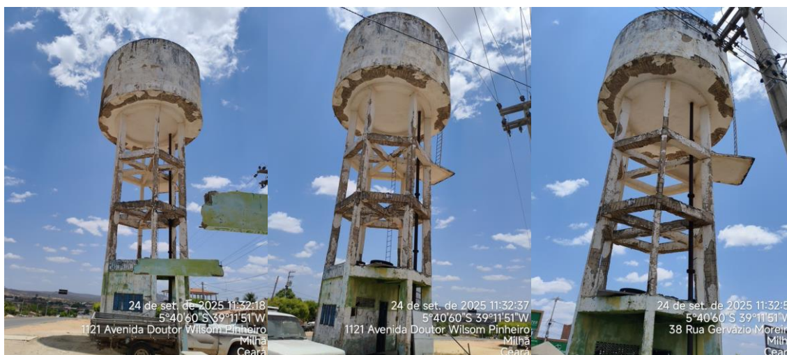
Figura 17 - Reservatório Elevado Desativado / Sede.
