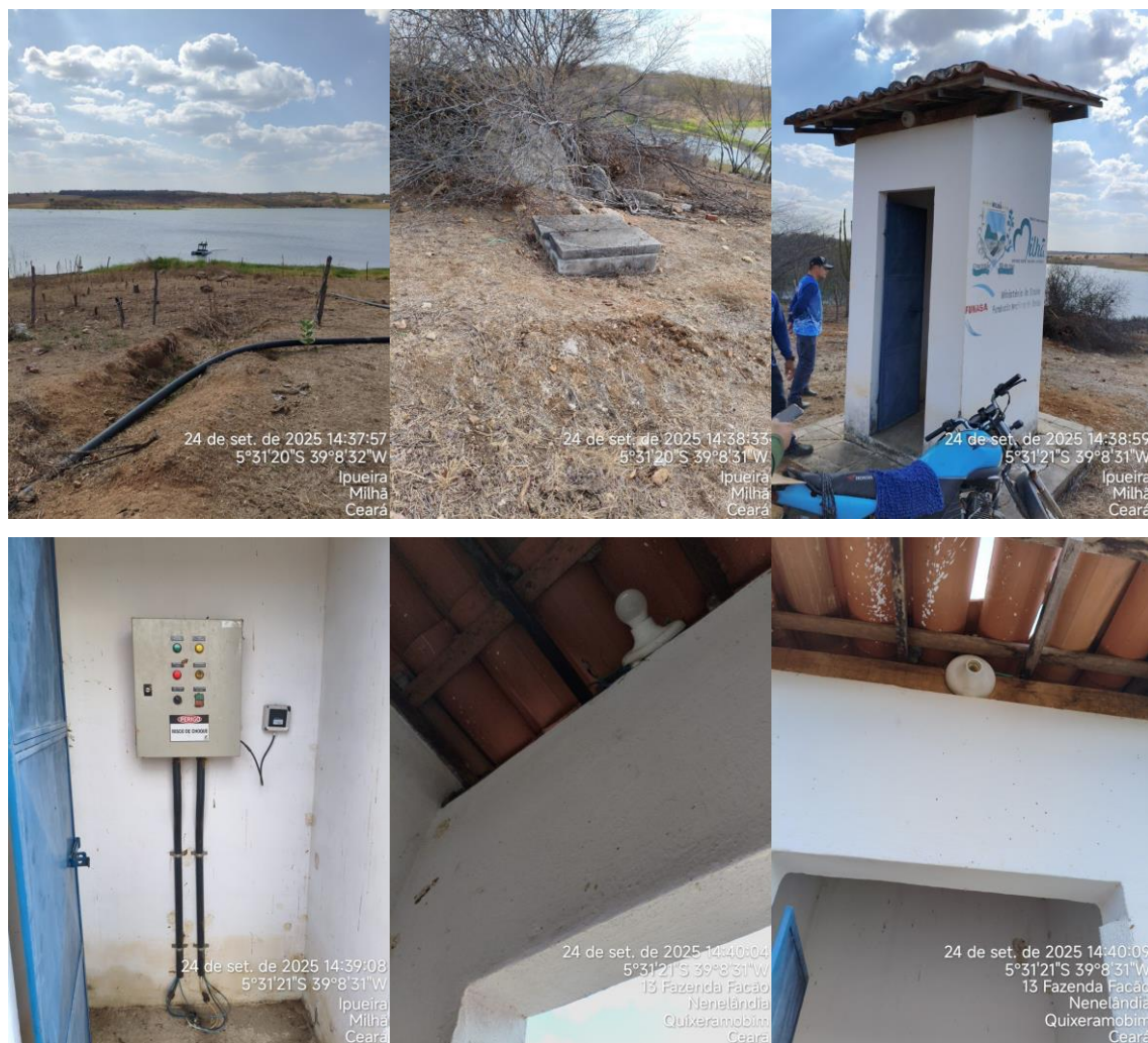
Figura 18 - Quadro de Comando - Captação / Carnaubinha.
