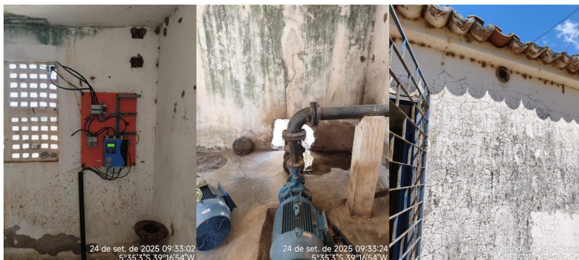
Figura 7 - Elevatória Jenipapeiro - Instalações Elétricas.
