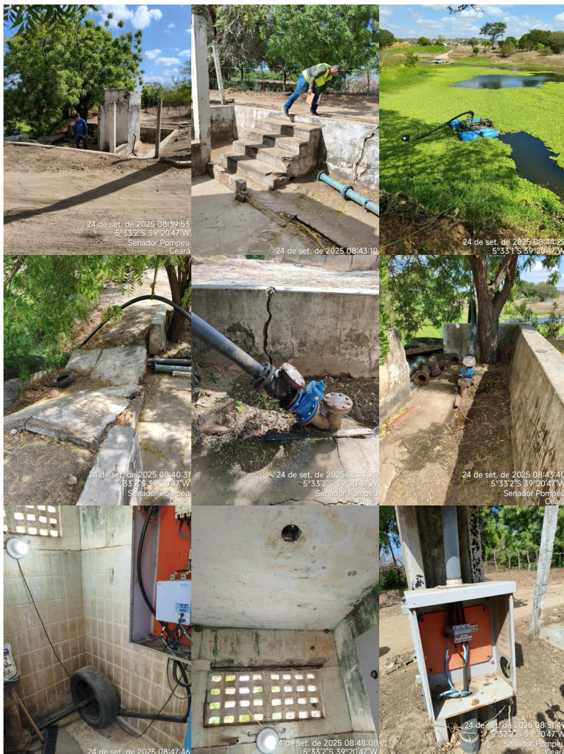
Figura 5 - Captação - Rio Banabuiú - Infraestrutura.
