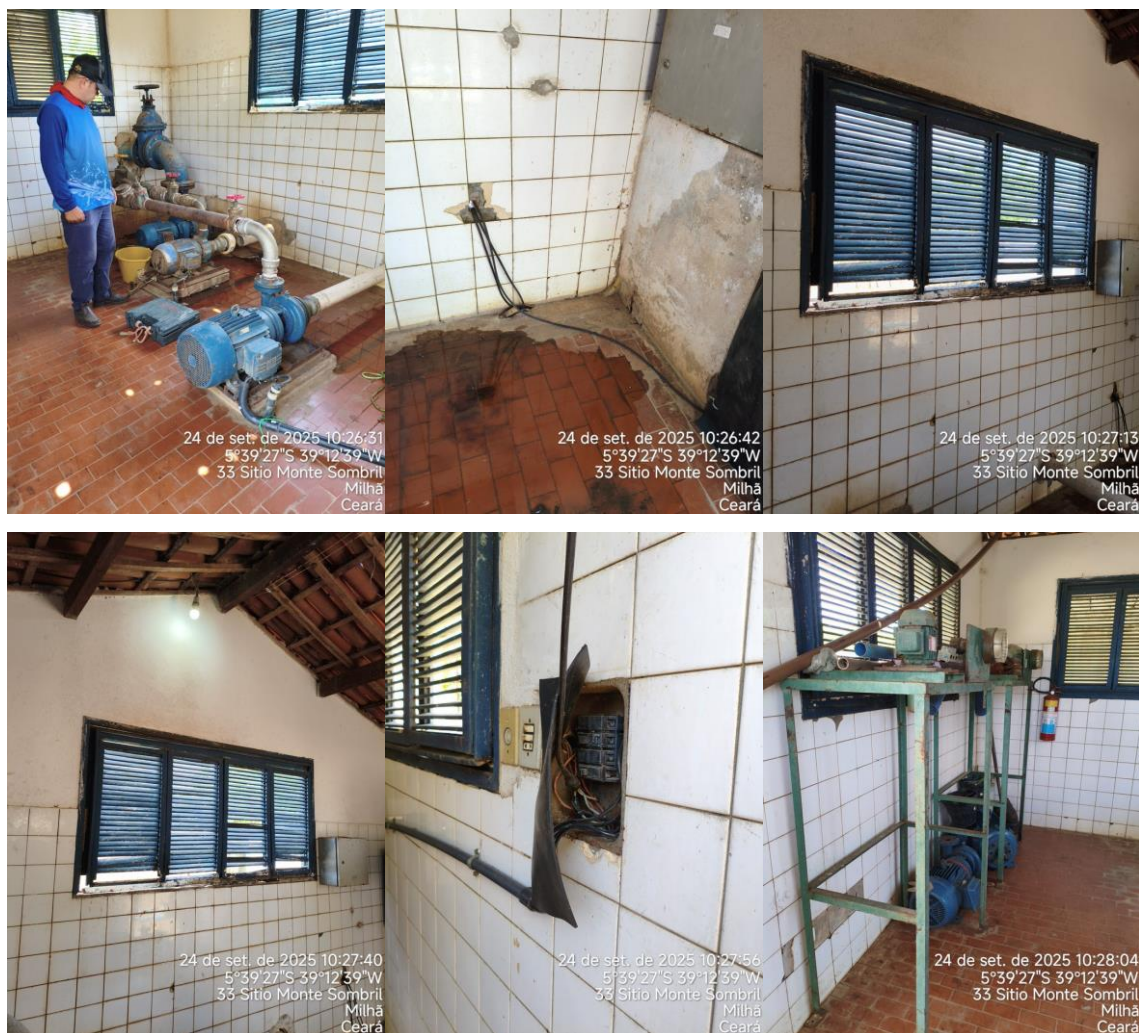
Figura 14 - ETA / Sede - Casa de Bombas.
