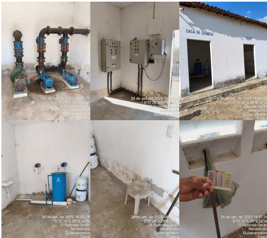
Figura 22 - ETA / Casa de Química e de Bombas - Carnaubinha.
