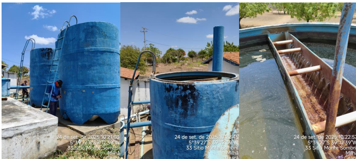
Figura 11 - ETA / Sede - Filtros.
