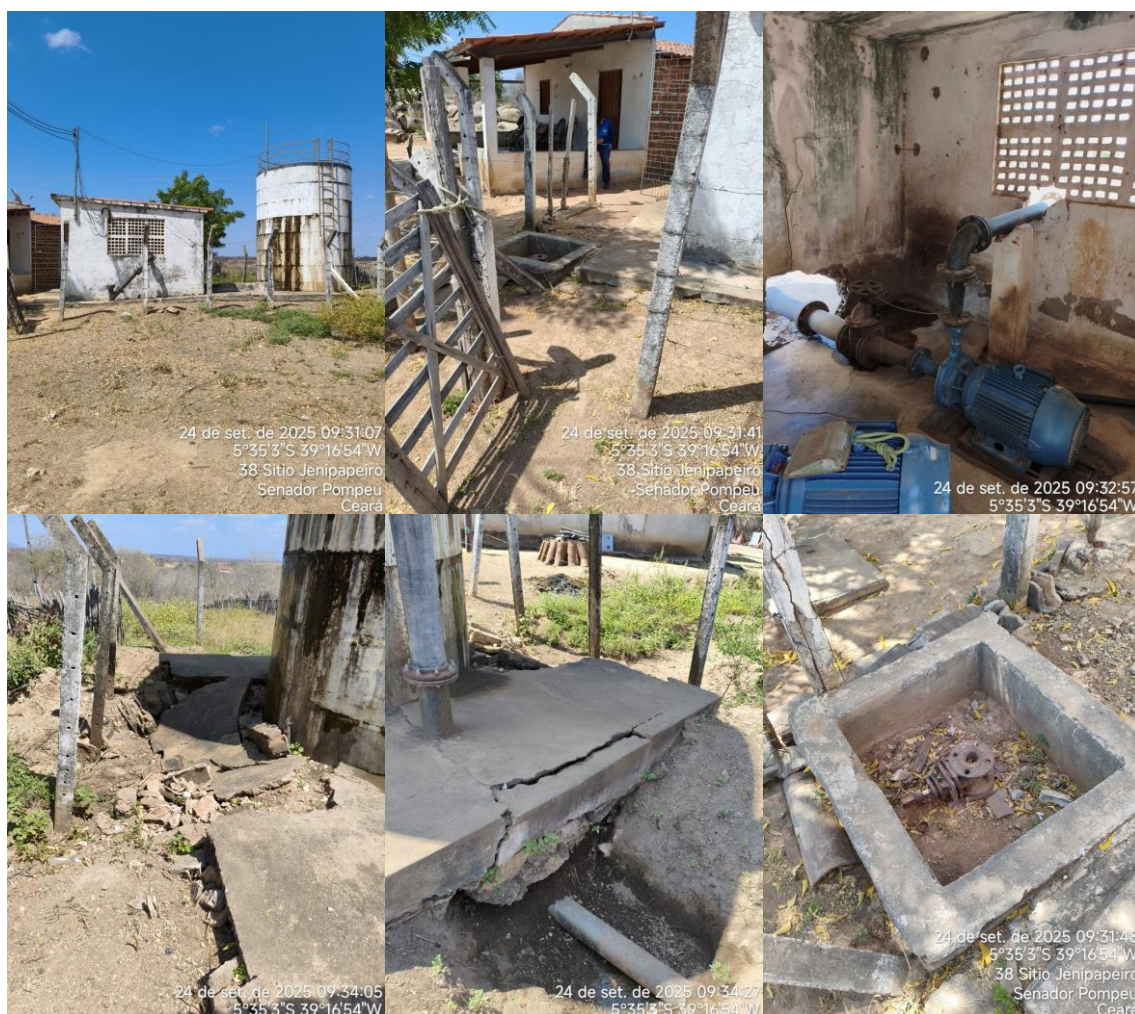
Figura 6 - Elevatória Jenipapeiro - Infraestrutura.
