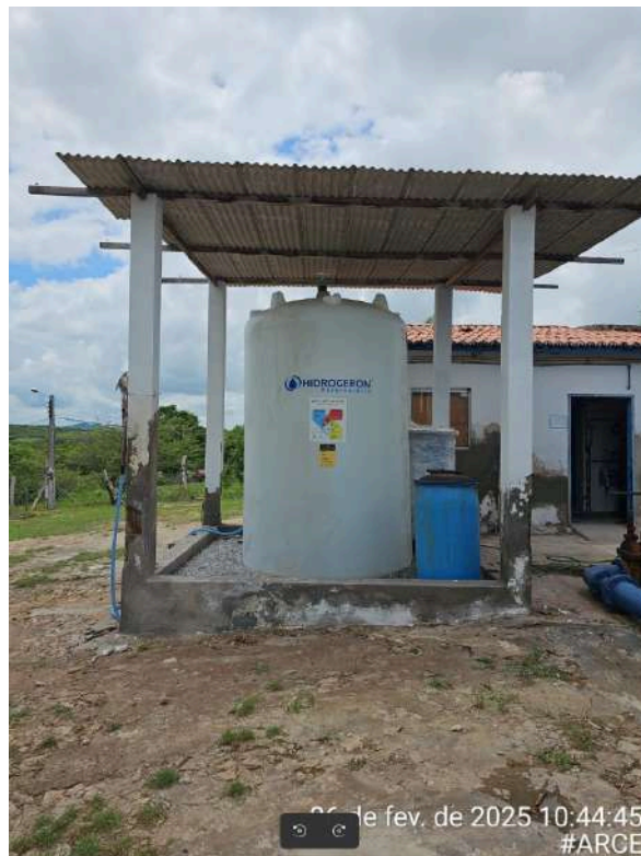
Foto 14 - Tanque de Cloração.
