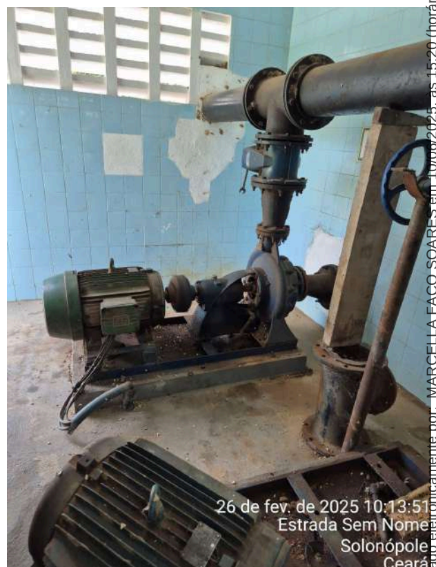
Foto 42 - Fiação exposta, sem eletrodutos, bomba desligada.
