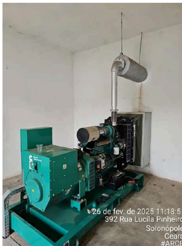
Foto 26 - Estação Elevatória - Gerador e bomba.
