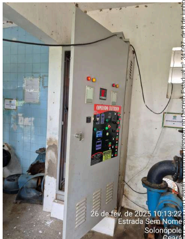
Foto 40 - Fiação exposta, sem eletrodutos.
