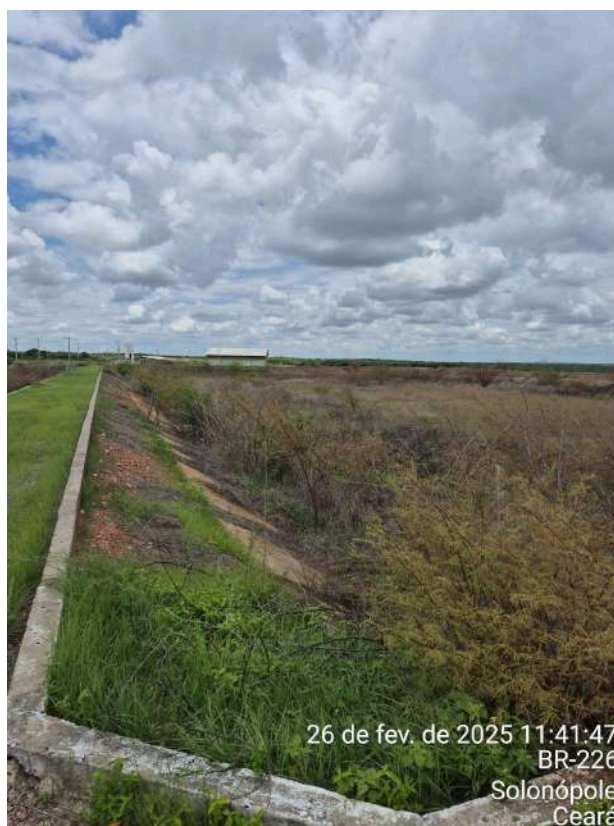
Foto 49 - Lagoa de Maturação: Vegetação alta, cobrindo toda a lagoa.
