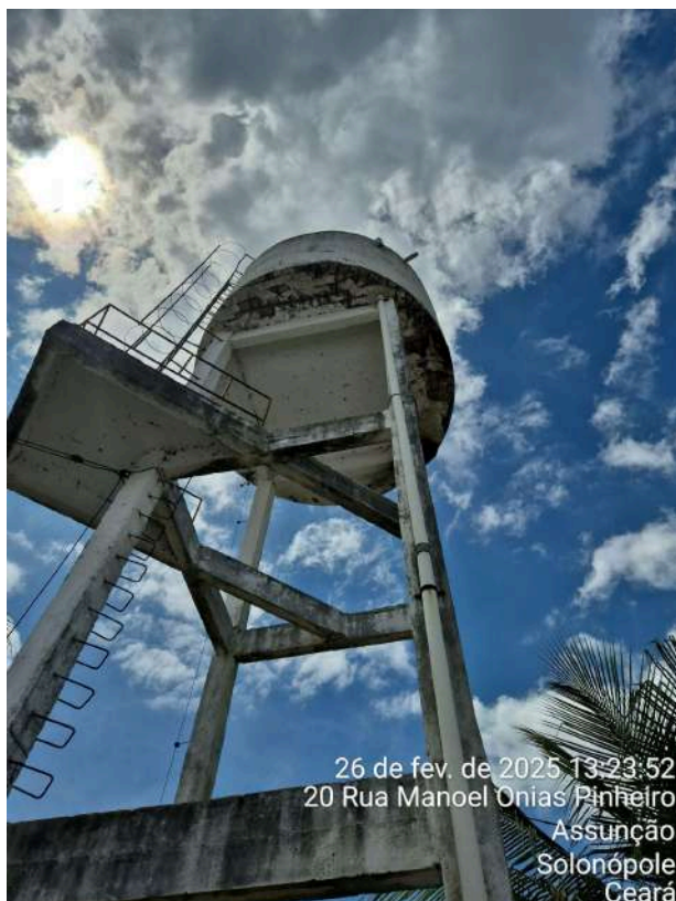
Foto 43 - ELV-6: Armadura exposta e pintura descascando.
