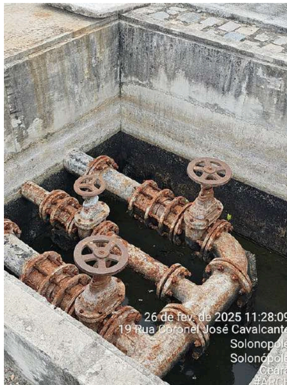
Foto 24 - Estação Elevatória - Tubulações.
