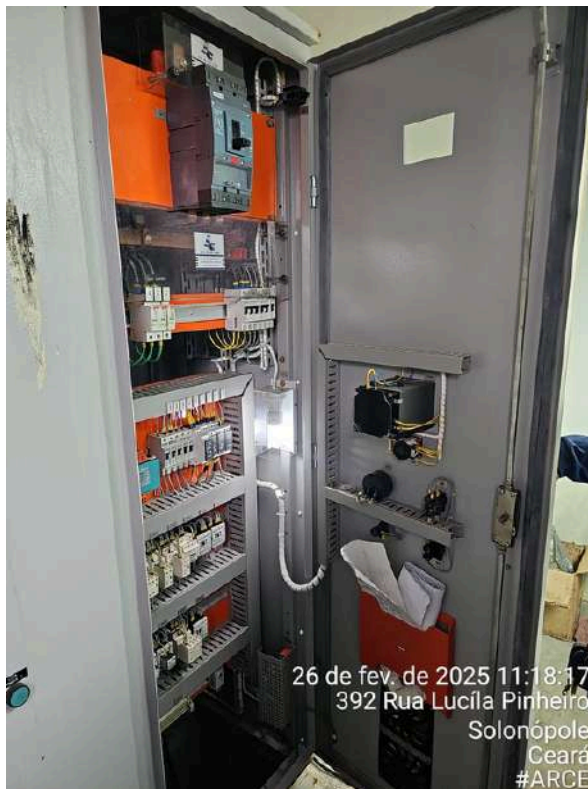
Foto 27 - Estação Elevatória - Casa de comando.
