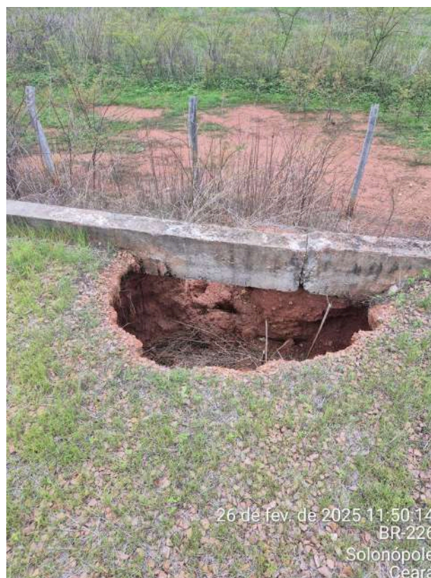
Foto 50 - Lagoa de Maturação: Parte da estrutura danificada.
