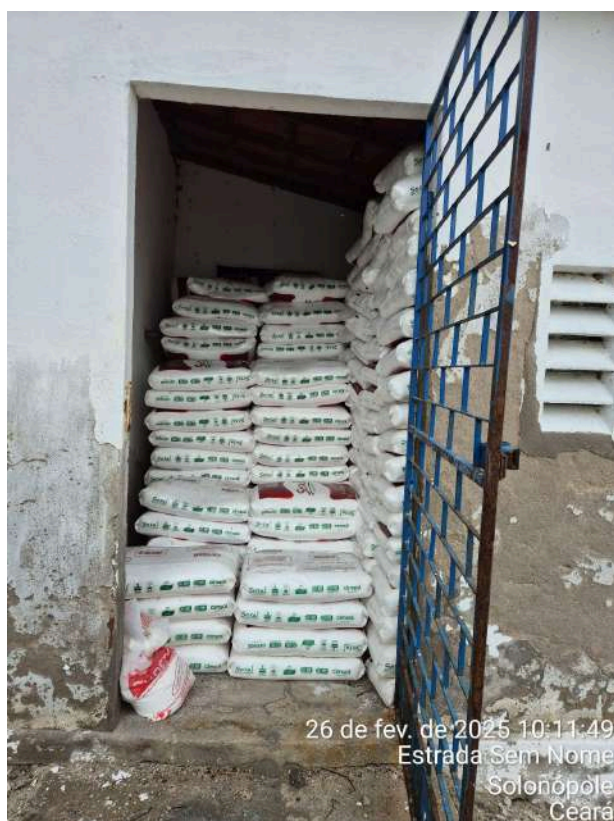
Foto 37 - Parede em processo de deterioração.
