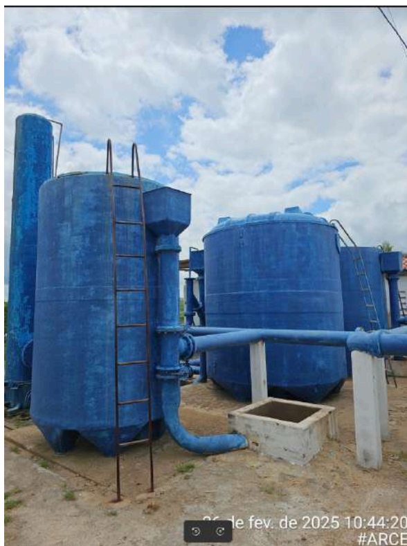
Foto 5 - Filtros do SAA.
