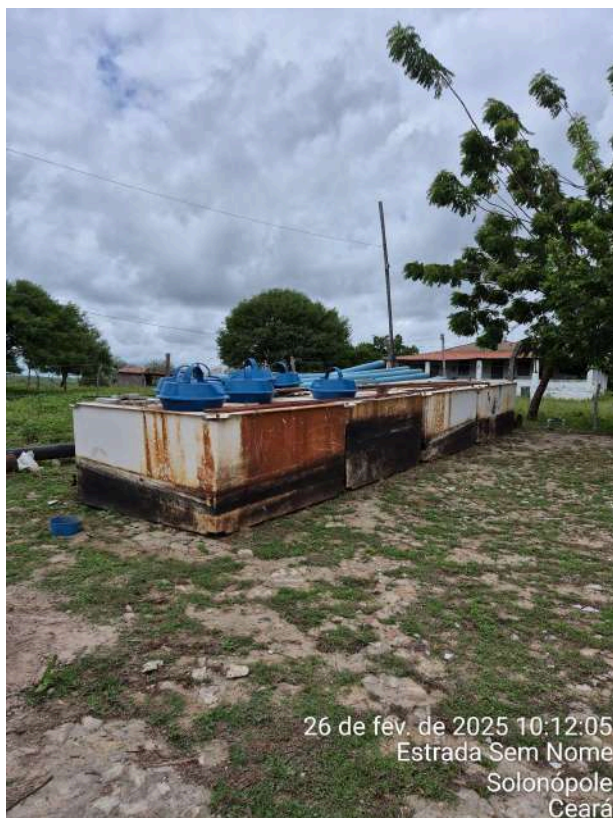
Foto 39 - Materiais em processo de corrosão
