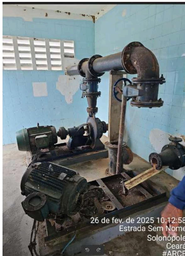
Foto 18 - Bombas de funcionamento da ETA.
