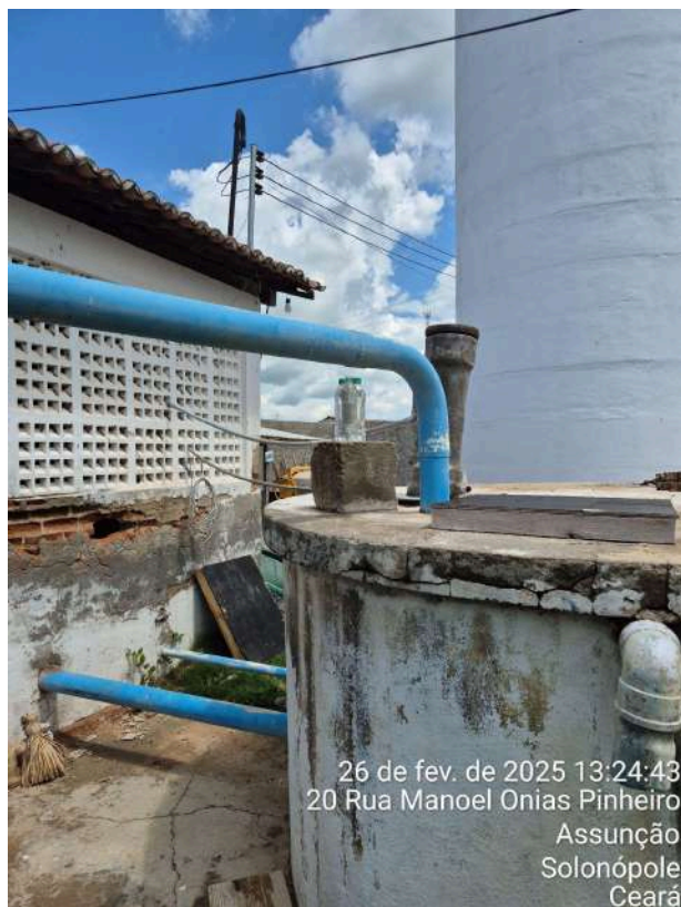
Foto 47 - ELV-3: Tampa com rachaduras.
