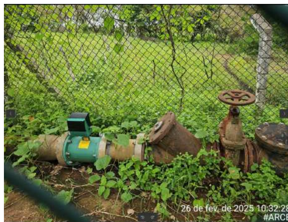
Foto 4 - Adutora de Água Bruta com macromedicação da COGERH.
