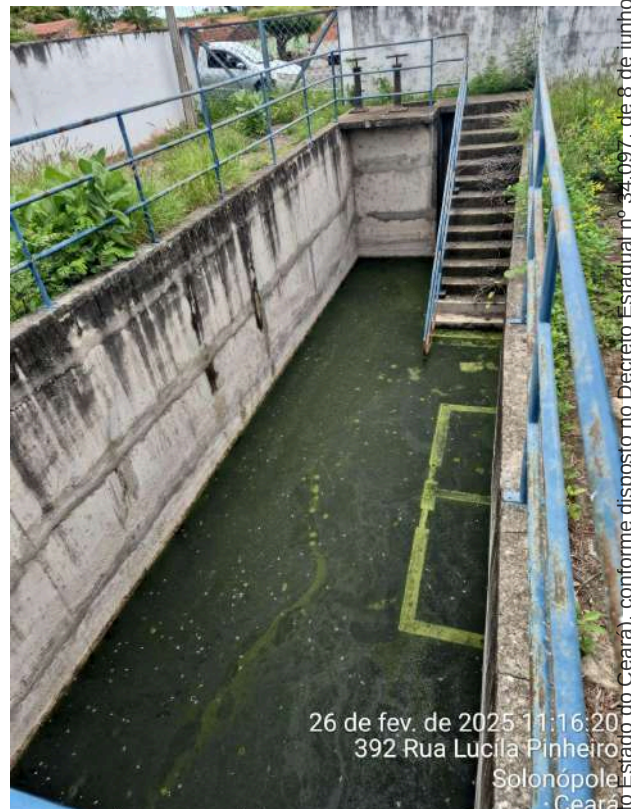
Foto 52 - EE-04: Vegetação alta, com acúmulo de água e lodo.
