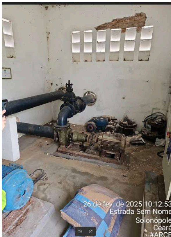
Foto 19 - Bombas de funcionamento da ETA.
