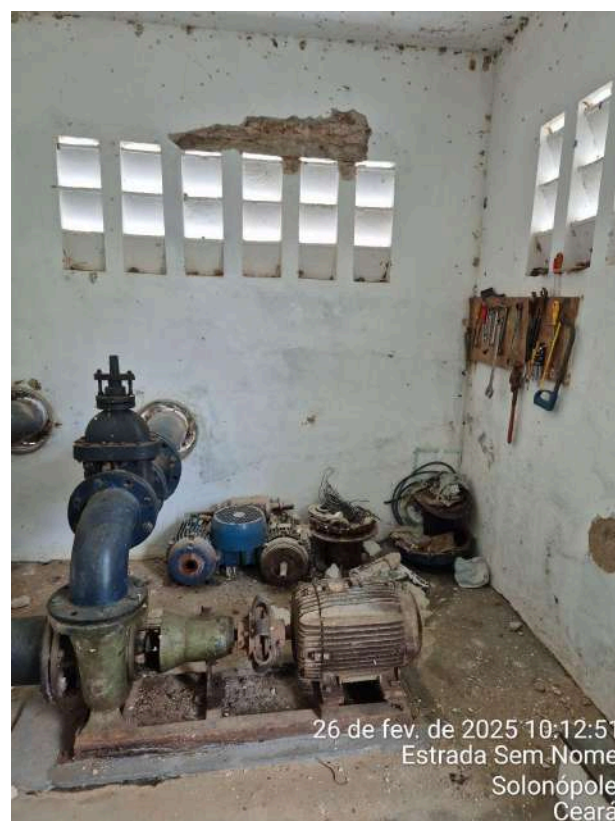
Foto 38 - Parede em processo de deterioração.
