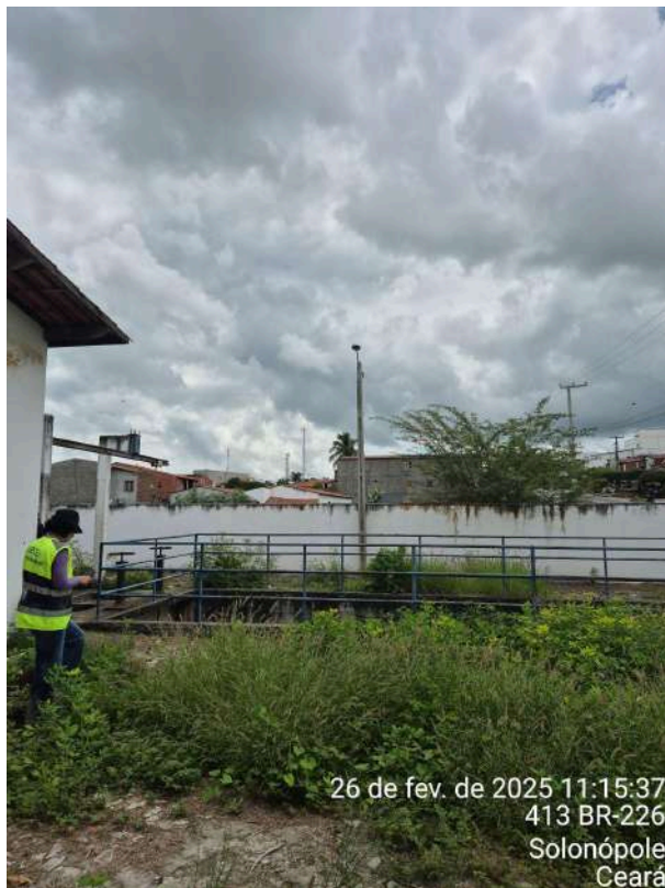
Foto 51 - EE-04: Vegetação alta, com acúmulo de água e lodo.
