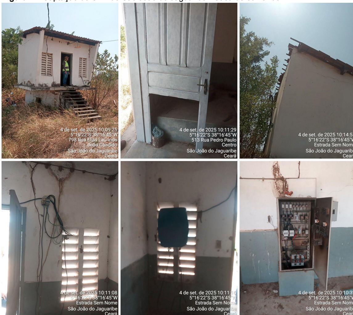
Figura 7 - Captação do SAA de São João do Jaguaribe - Casa de comando.
