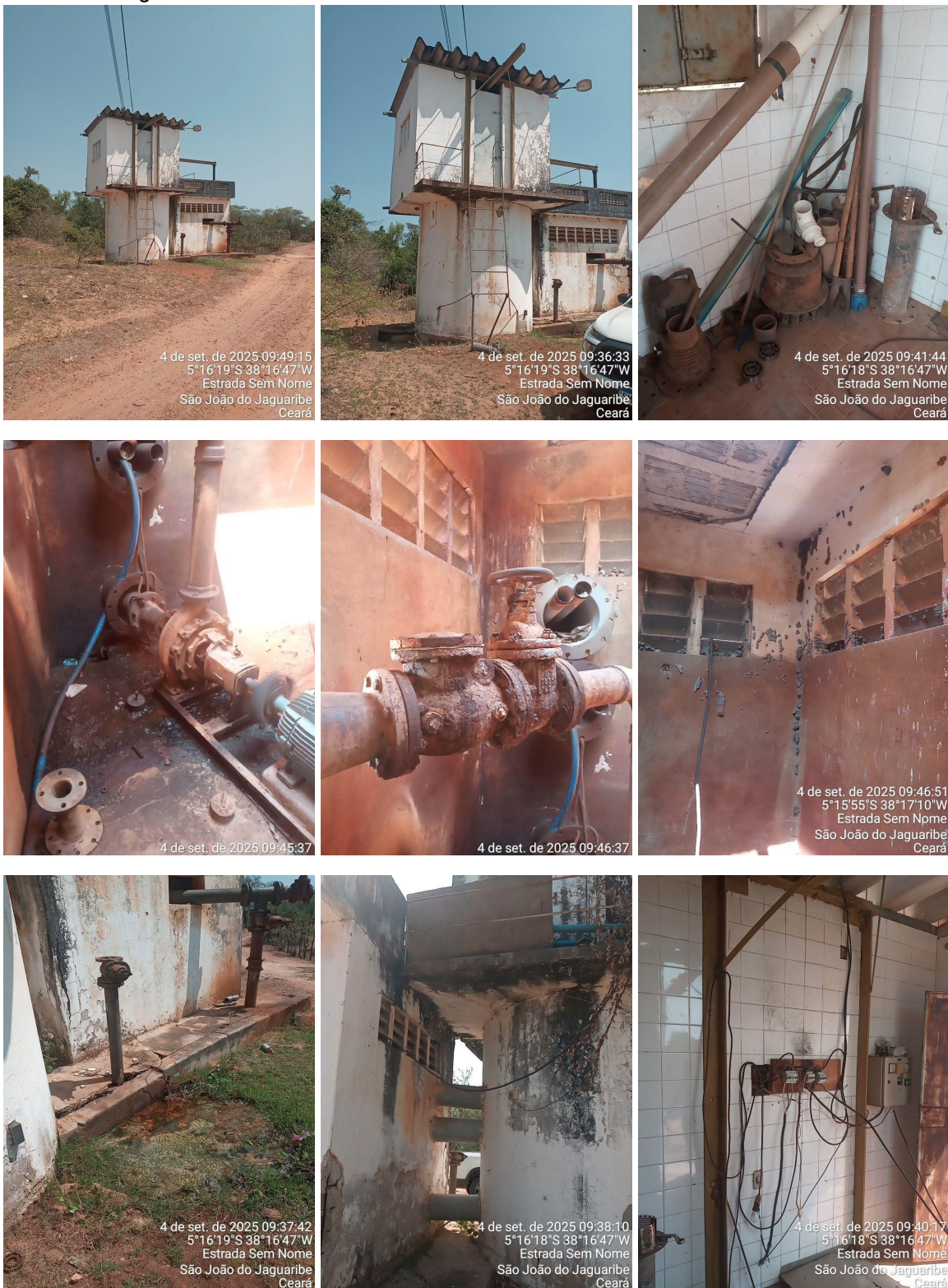
Figura 6 - Captação de água bruta do SAA de São João do Jaguaribe - Poço Amazonas no Rio Jaguaribe.
