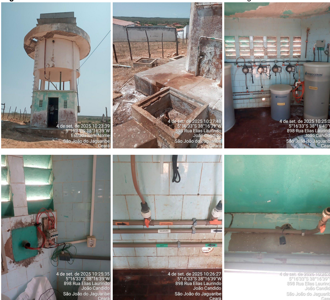
Figura 9 - Aerador / Reservatório elevado do SAAE de São João do Jaguaribe.
