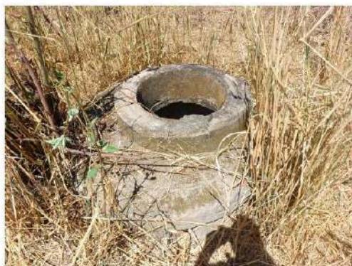
Foto 06. Recepção dos efluentes.
