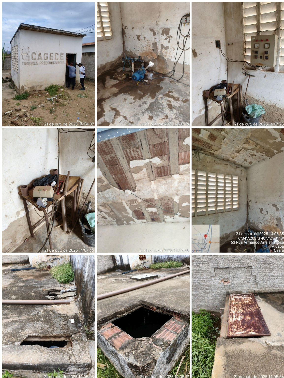
Figura 17 - Reservatório Apoiado - CRAS.
