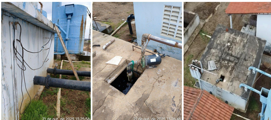
Figura 9 - ETA - Reservatório Apoiado.
