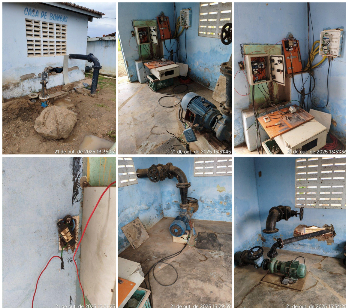
Figura 13 - ETA - Casa de Bombas.
